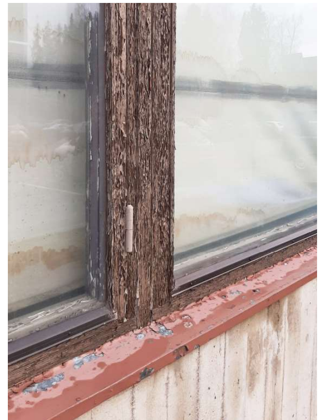
Varaston nauhaikkunarivin karmit ovat esillä. Pinnat ovat kauttaaltaan erittäin huonossa kunnossa.
