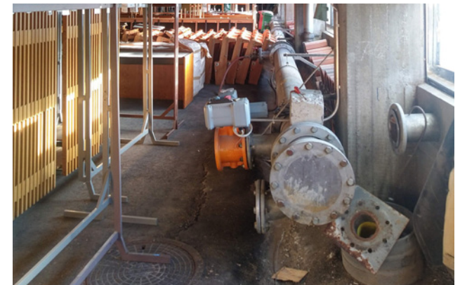
Putkistoa hallin eteläseinustalla. Samanlainen putkisto on myös vastakkaisella seinustalla.
