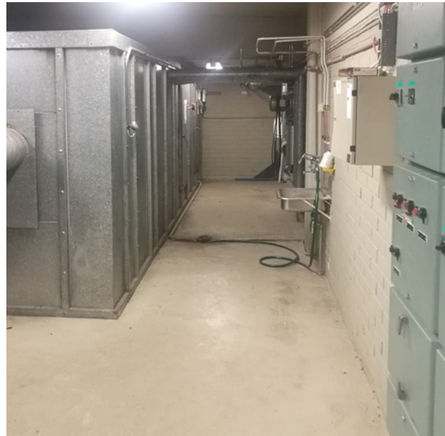
Alkuperäinen iv-konehuone mallien varusteluhallin alapuolella.
