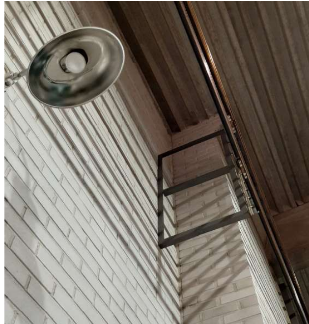
Tilassa on useita seinään kiinnitettyjä teollisuusvalaisimia. Taustalla näkyvät sähköjohtimet.
