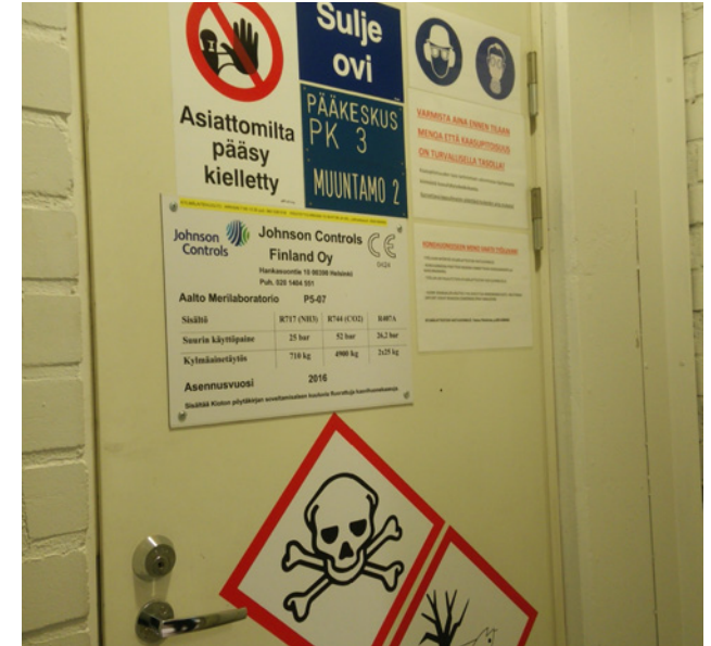
Varoituskylttejä toisen kerroksen kylmäkonehuoneen ovesta
