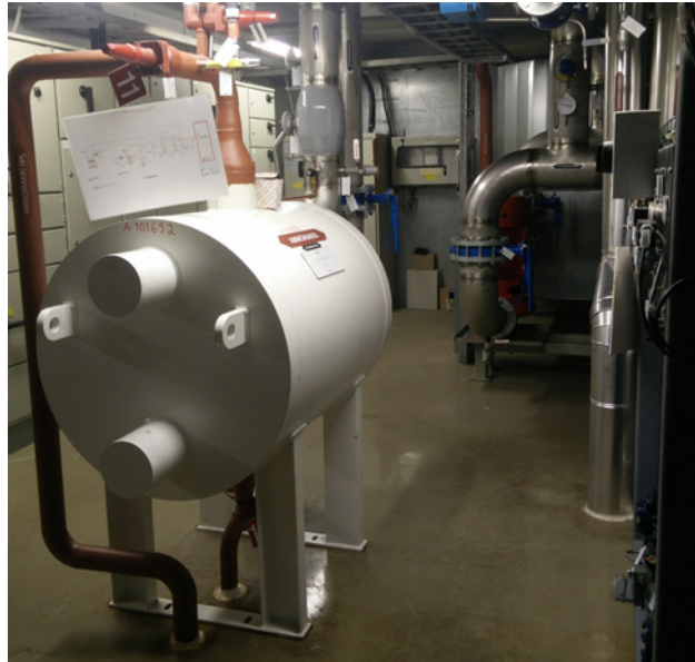
Toisen kerroksen kylmäkonehuone
