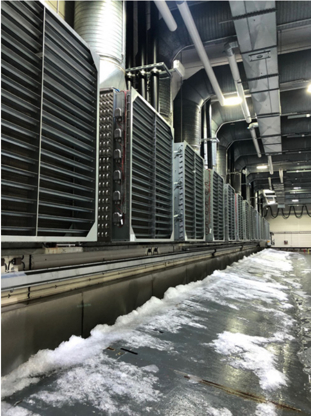
Jäälaboratorion jäädytyslaitteet täyttävät lähes koko länsi- ja itäseinät. Lisäksi altaan länsipäädyssä sijaitsevat allonvaimennuslevyt.
