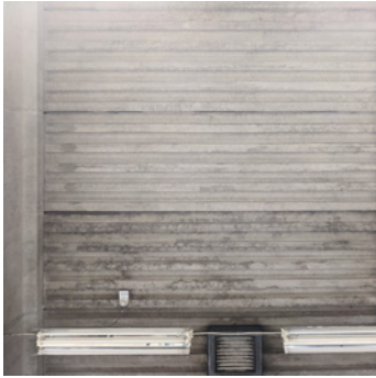
Uritettu betonikattolaatta koehallin katossa.
