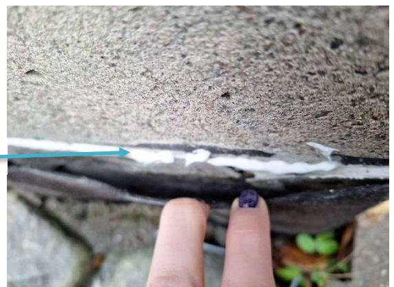
Kuva 48 Bitumikermi oli irti syöksytorven takana. Kermin yläpintaa on yritetty tiivistää valkoisella tiivisteellä.
