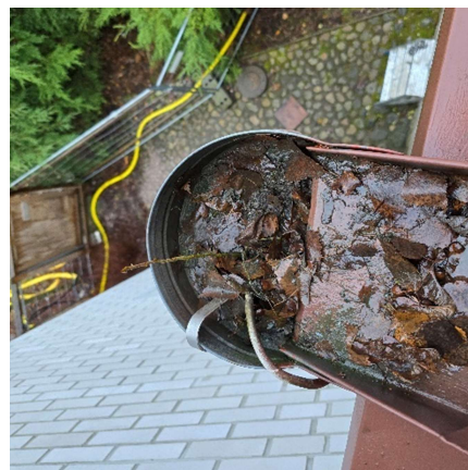
Kuva 65 Lehtiä oli päässyt maatumaan ränniin ja syöksy- putken päähän alkuperäisosan kulmalla lähellä ilmanvaihdon raitisilma-aukkoa.
