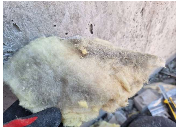
Kuva 44 Taaempänä eristevillassa oli hieman tummentumia.
