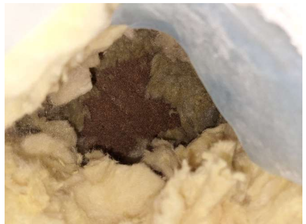
Kuva 28 Lasivillan takana oli mineraalivilla sekä ruskea tuulensuojalevy.
