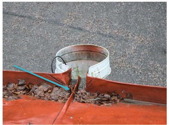
Kuva 63 Alkuperäisosan ränniin oli kerääntynyt lehtiä. Syöksyputkissa oli lämmityskaapelit.
