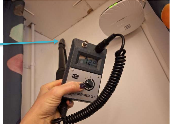
Kuva 16 Ulkokulman seinän pintakosteus vaihteli välillä 71...78.
