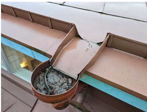
Kuva 64 Ylemmällä katolla oleva tukos syöksyputkessa.
