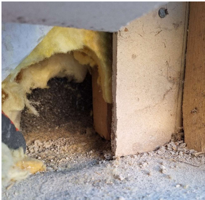
Kuva 43 Bitumi nousee reilusti betoniselle ulkoseinälle.
