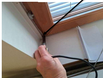
Oikean ikkunan alakulman sormiliitoksessa oli erittäin vähäistä vuotoa.
