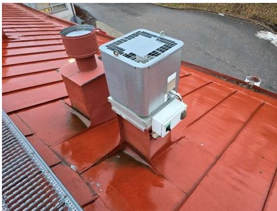
Kuva 62 Vesikatteella oli muutamia yksittäisiä maalipuut- teita.
