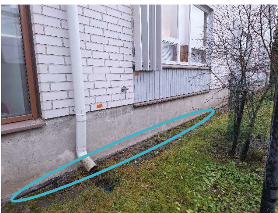
Kuva 59 Bitumi oli irronnut sokkelibetonista myös laajennososalla.
