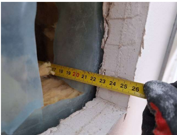
Kuva 27 Lämmöneristettä oli yhteensä noin 210 mm. Kipsilevyjä oli 2 kpl sisäpinnassa.
