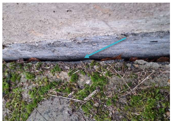
Kuva 60 Vesi pääsee bitumin ja sokkelin väliin yläreunasta.
