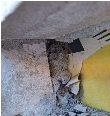
Kuva 55 Tuuletusväli oli toiselta puolen tukossa.
