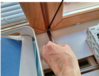
Oikean ikkunan ikkunoiden liitoskohdassa erittäin vähäistä vuotoa.
