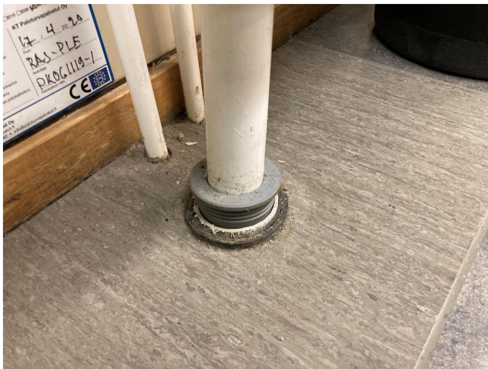
Kuva 5.1. Luokassa 2036 pesualtaan viemärin kalustekumi ei ole tiivis. Viemärinhajua saattaa päästä leviämään sisätiloihin tätä kautta.
