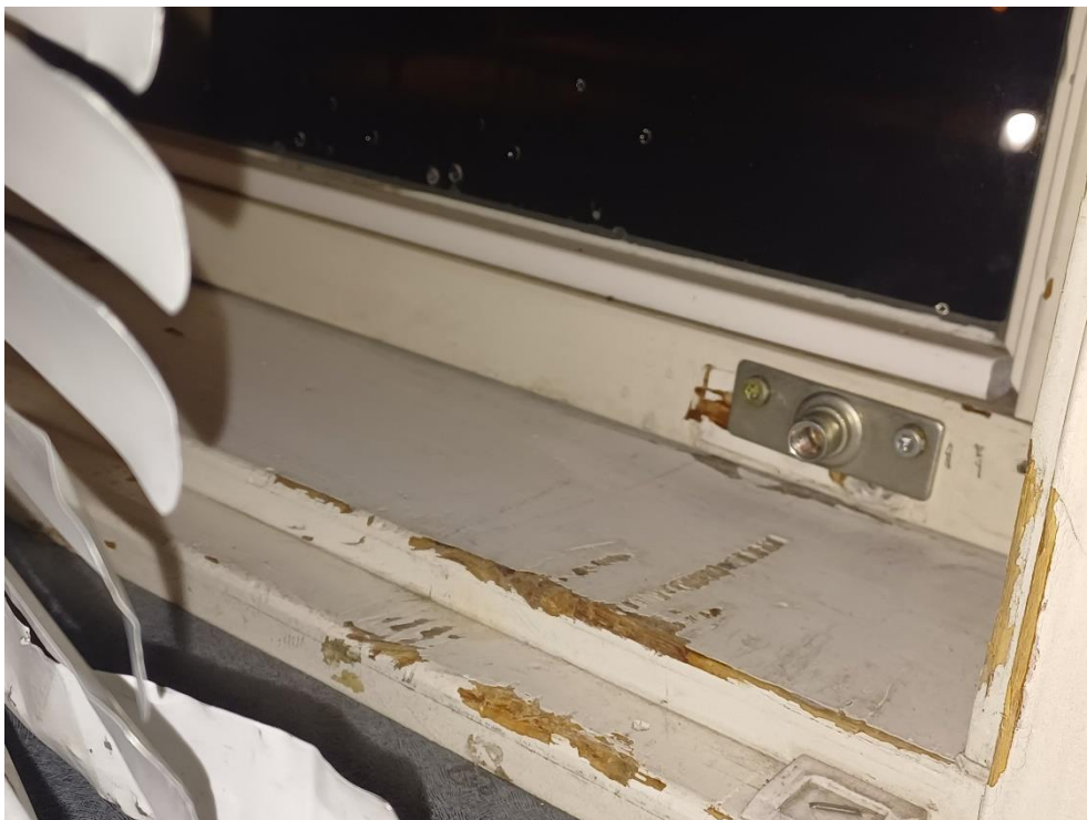
Kuva 4.9. Tuuletusikkunoiden aukipitolaitteita on rikkoutunut tai irti kiinnikkeistä useissa tiloissa.
