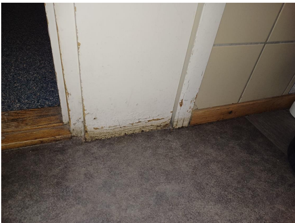
Kuva 4.8. Käytäväovissa, sähköpielien alaosat ovat turvonneet liiallisesta vedenkäytöstä lattiapesun yhteydessä useissa tiloissa.
