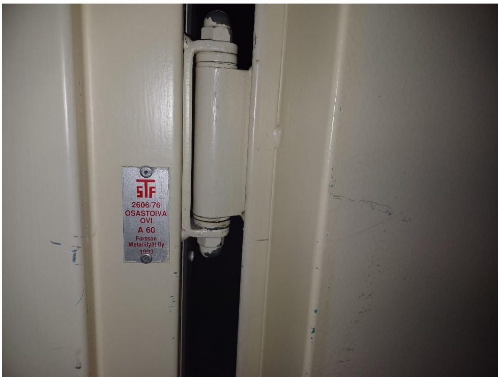
Kuva 4.12. IV-konehuoneiden osastoivista ovista puuttuvat tiivistimet.
