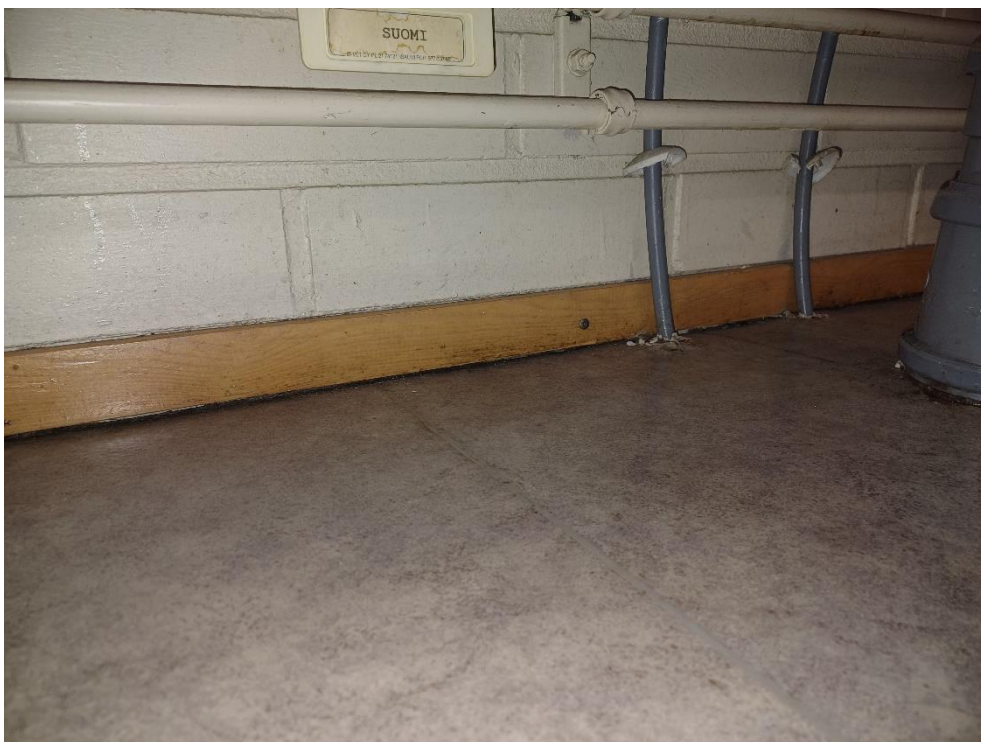
Kuva 4.10. 1ksr. lattiat ovat painuneet alaspäin ulkoseinien osalla useissa tiloissa.
