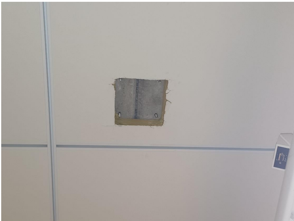
Kuva 4.7. 2037 alakaton akustointilevyssä on pinnoittamatonta mineraalivillaa näkyvissä poistetun laitteen kohdalla.
