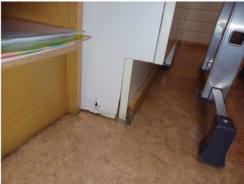
Kuva 4.3. 1061 OPO:n tila, kaapiston alaosa on turvonut liiallisesta vedenkäytöstä lattiapesun yhteydessä.
