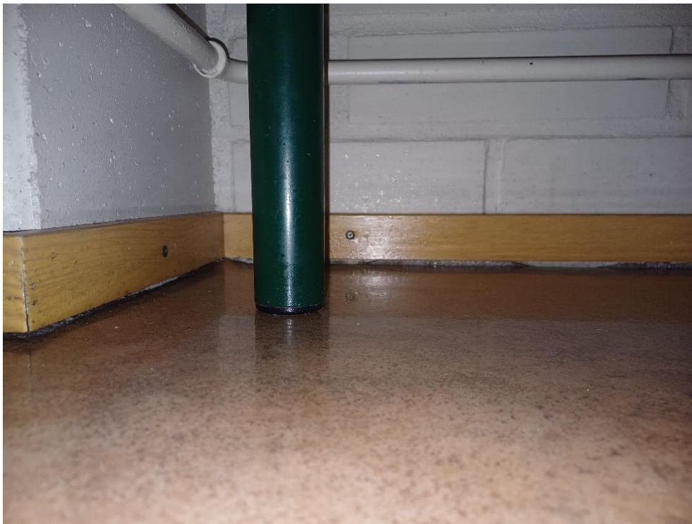
Kuva 4.1. 1061 OPO:n tila, lattia on painunut alaspäin ulkoseinien osalla.
