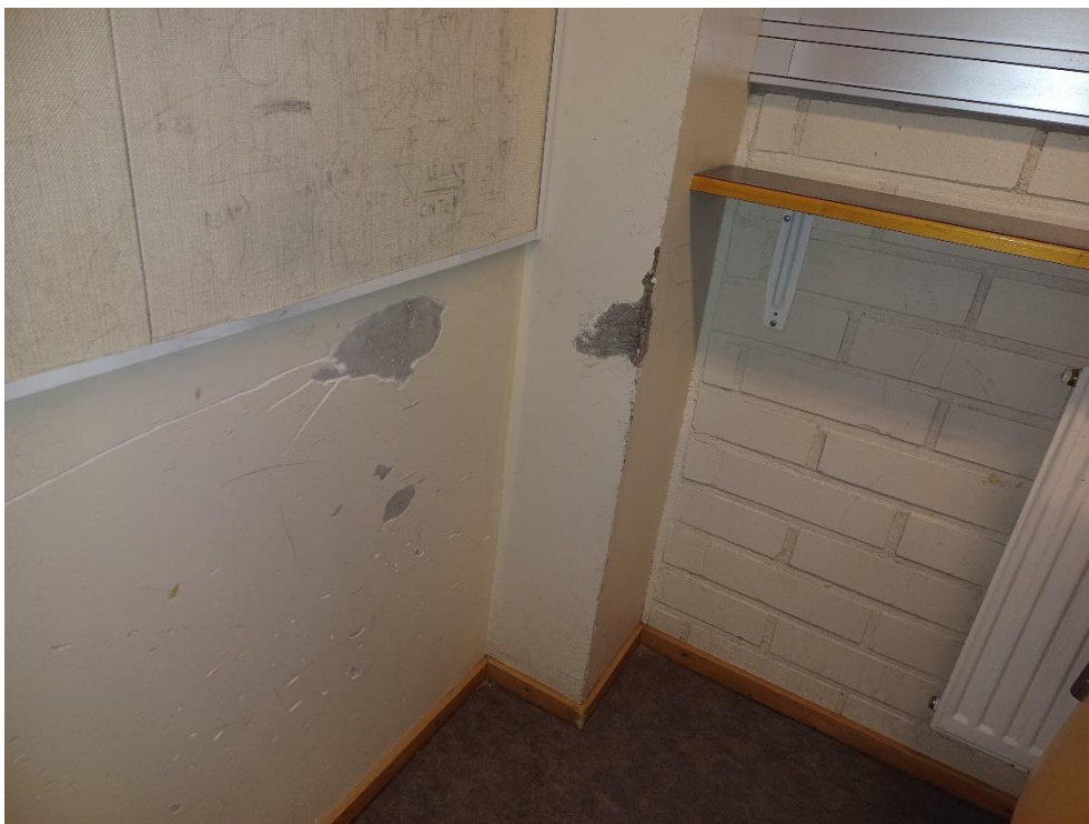
Kuva 4.6. 2035 seinästä sekä nurkkapilarista on kolhittu irti tasoitetta ja maalia.
