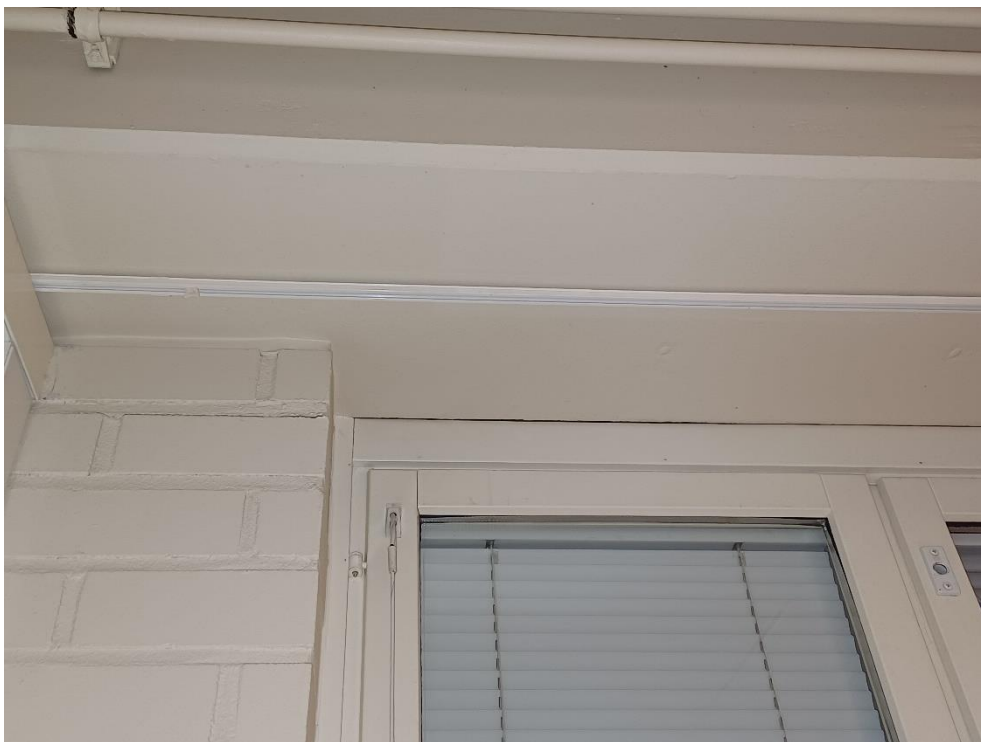
Kuva 4.2. 1061 OPO:n tila, ikkunaliittymät eivät ole tiiviit.
