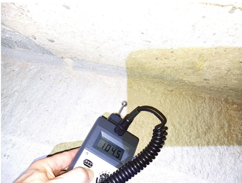
Kuva 4.4. V.K. 009 TELE-laitetilan yhteydessä olevan tunnelin lattiasta ja muottilaudoituksen seinäosalla mitattiin pintakosteudenosoittimella kohonneita vertailuarvoja.
