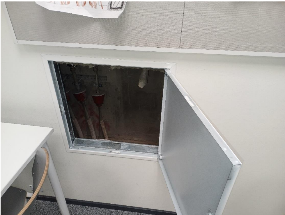
Kuva 4.8. Tiloissa V.1.010a, V.1.010b, V.2.008c, V.3.008a ja V.3.008c tekniikkakuilujen luukut eivät ole tiiviitä, mitä kautta luokkatilaan saattaa kulkeutua epäpuhtauksia.
