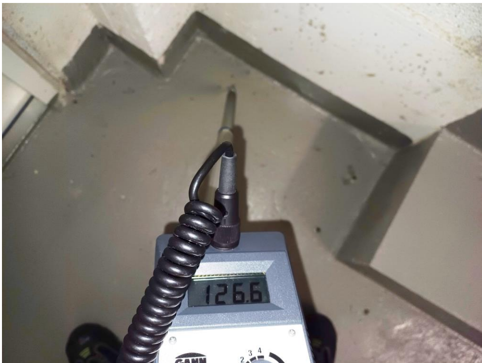
Kuva 4.2. V.K. 002 käytävä, lattiasta mitattiin pintakosteudenosoittimella kohonneita vertailuarvoja.
