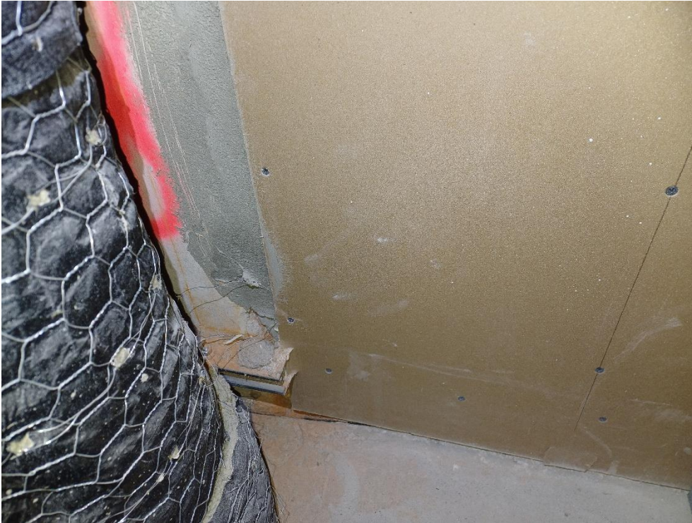
Kuva 4.7. V.1.010b alakaton yläpuolisissa rakenteissa on rakoja ja halkeamia, mitä kautta luokkatilaan saattaa kulkeutua epäpuhtauksia.
