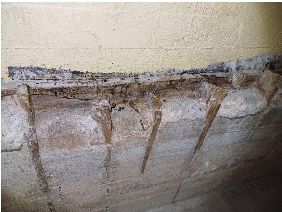
Kuva 4.3. V.K. 009 TELE-laitetilan yhteydessä olevassa tunnelissa on muottilaudoituksen materiaalina käytettyä puutavaraa.
