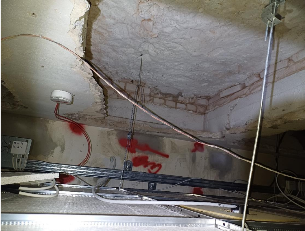
Kuva 4.9. Käytävätiloissa, alakattojen yläpuolisista rakenteista tulee voimakasta ”vanhan betonirakenteen” hajua käytävätiloihin.
