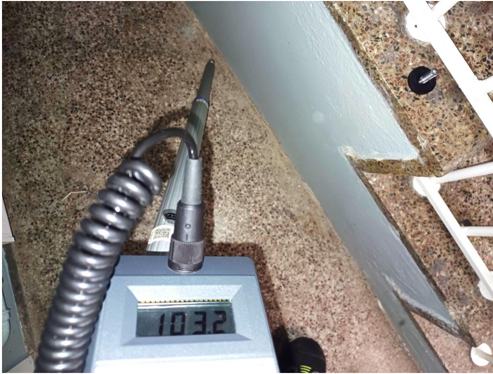
Kuva 4.1. V.K. 001 porrashuone, lattiasta mitattiin pintakosteudenosoittimella kohonneita vertailuarvoja.
