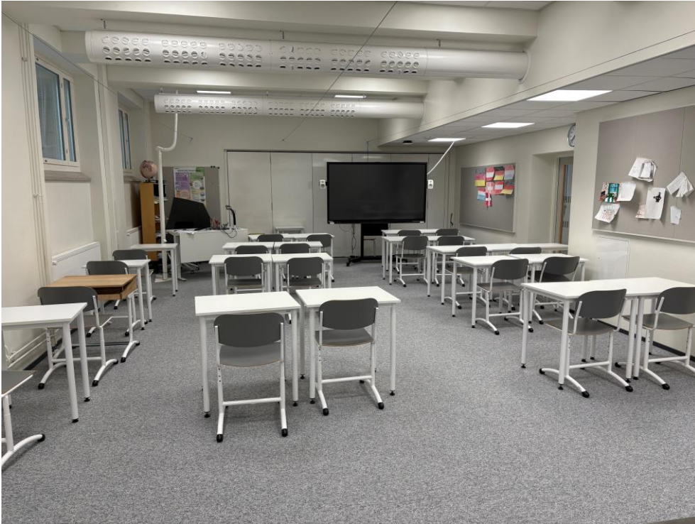
Kuva 5.1. Ilmanvaihto jaetaan luokkahuoneisiin suutinkanavien kautta.
