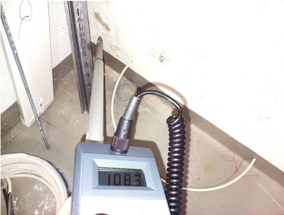
Kuva 4.5. V.K. 010 SPK, seinässä on kosteuden aiheuttamaa rapautumaa, sekä mitattiin seinästä ja lattiasta pintakosteudenosoittimella kohonneita vertailuarvoja.
