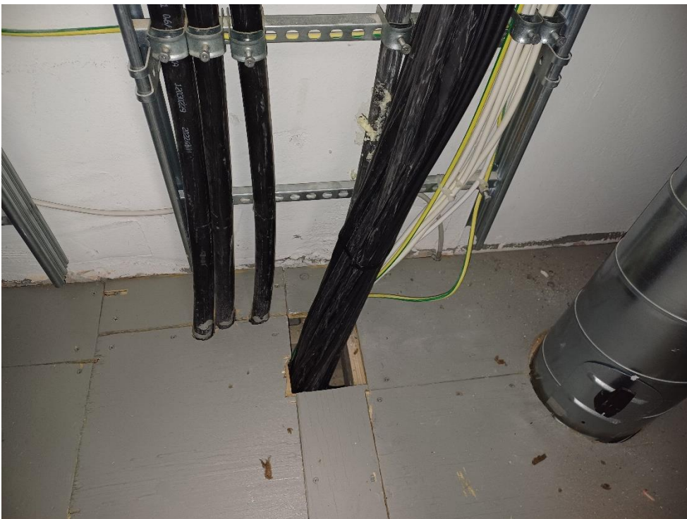
Kuva 4.6. V.1.009 luokan yhteydessä olevan tekniikkakuilutilan lattian läpiviennit eivät ole tiiviitä, mitä kautta luokkatilaan saattaa kulkeutua epäpuhtauksia.
