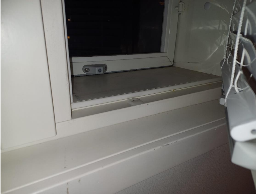
Kuva 4.2. 201 Leikkitila, tuuletusikkunan aukipitolaite on rikkoutunut.
