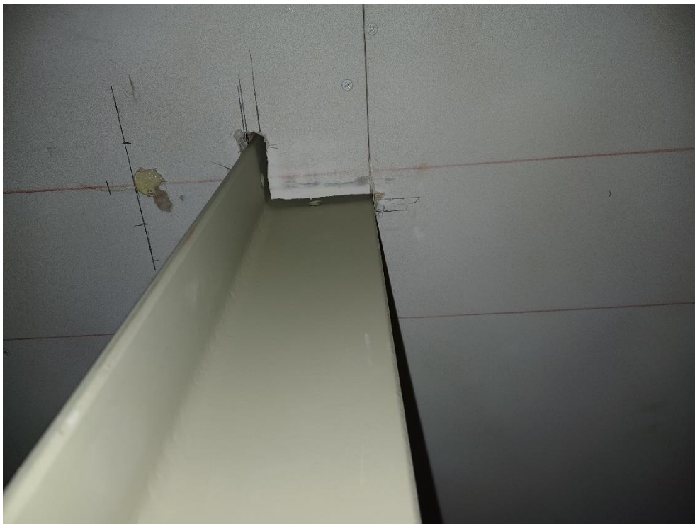
Kuva 4.6. Alakattojen yläpuoliset läpiviennit eivät ole tiiviitä.
