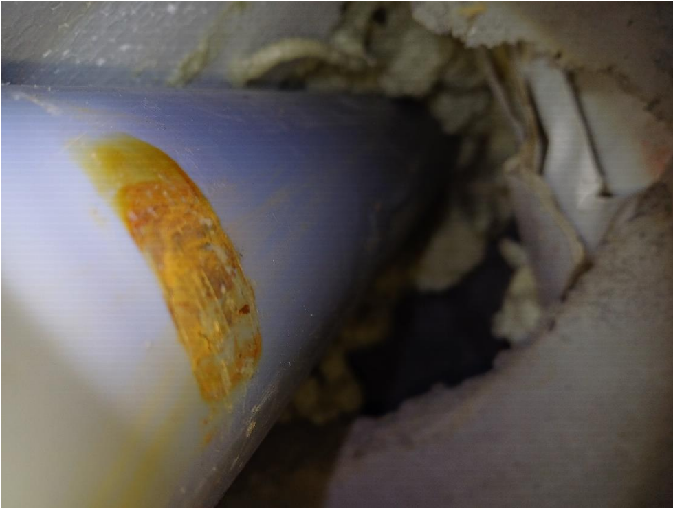
Kuva 4.8. Ryömintätilassa ylöspäin johtavat läpiviennit eivät ole tiiviitä.
