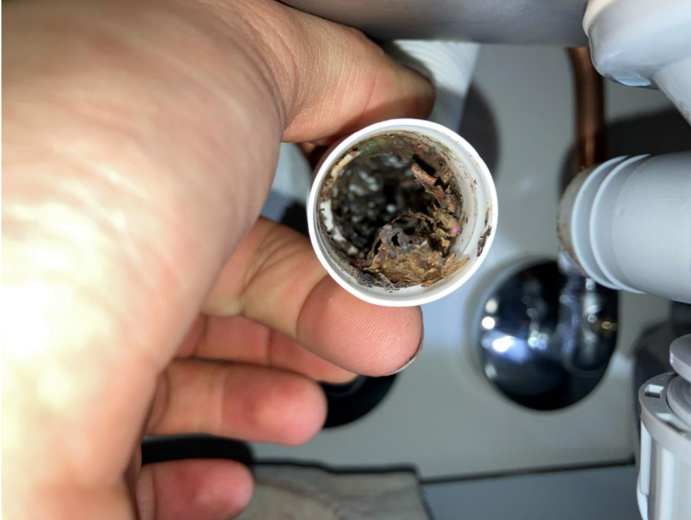
Kuva 5.1. Ryhmähuoneiden pesualtaiden viemäröintien ja ylivuotoputkien pinnoille kertynyt lietettä, jonka haju muistuttaa maakellarin tapaista hajua.
