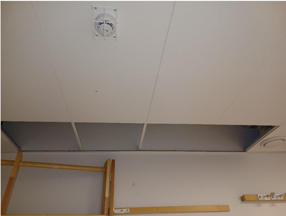
Kuva 4.4. 223 Monitoimitila, alakaton levyjä puuttuu.
