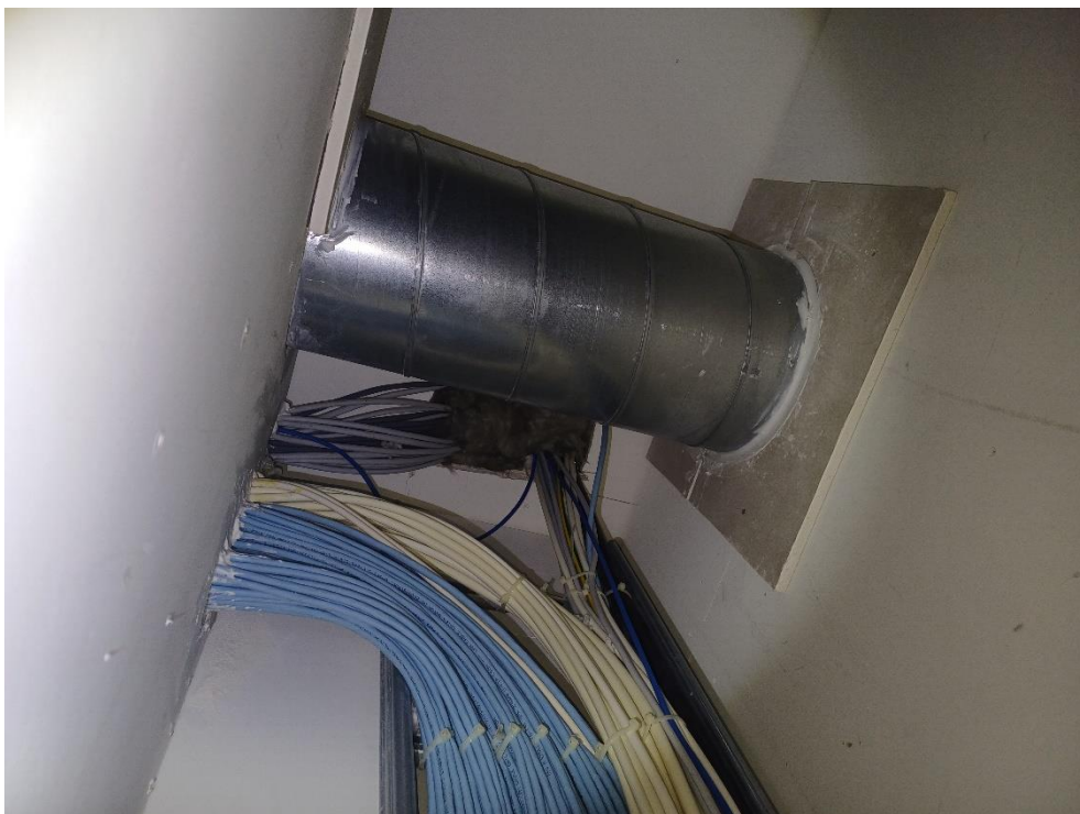
Kuva 4.7. Ryhmäkeskusten läpivienneissä on mineraalivillaa näkyvissä.
