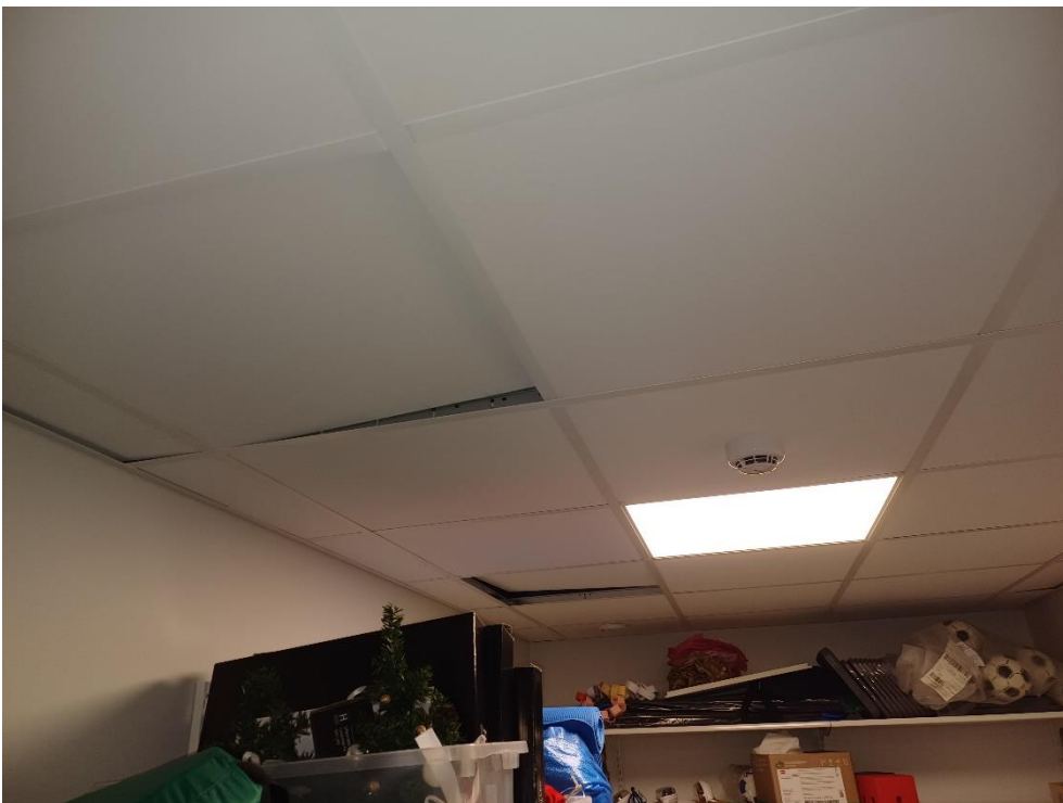
Kuva 4.5. 224 Monitoimitilan varasto, alakattolevyjä on pois paikoiltaan.
