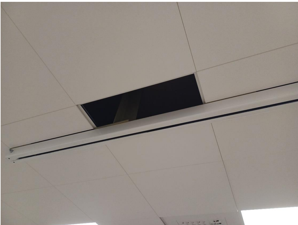
Kuva 4.3. 202 Lepohuone, alakaton levy puuttuu.
