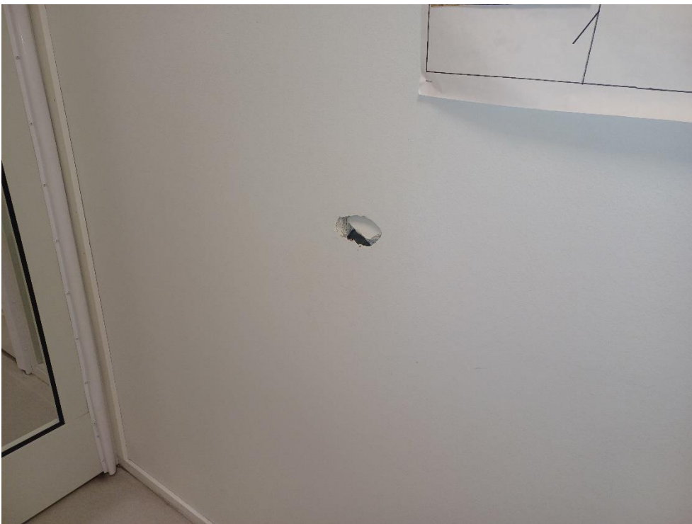
Kuva 4.1. 108 Käytävä, seinälevyssä on ovenkahvan osumasta tullut reikä.
