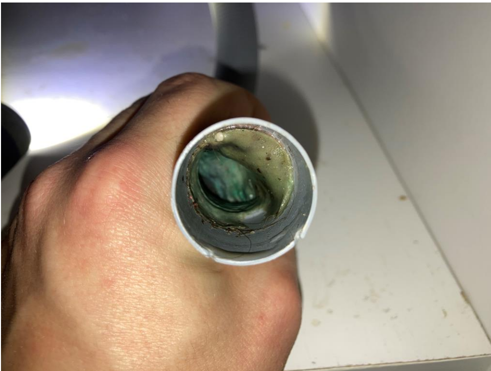
Kuva 5.1. Pesualtaiden viemäröinneissä ja ylivuotoputkissa ylimääräistä lietettä ja likaa, joka saattaa päästää hajua sisätiloihin.
