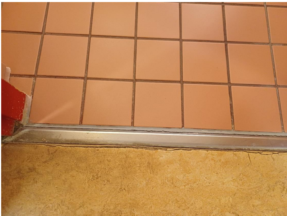
Kuva 4.2. 13 WC-tila, lattiamatto on halkeillut ovikynnyksen vieressä.
