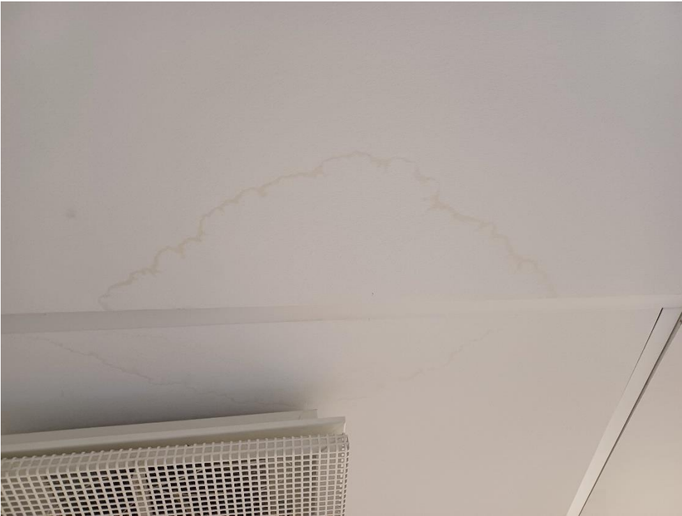
Kuva 4.4. 25 Käytävä, alakaton akustointilevyssä on kosteusvauriojälkiä.
