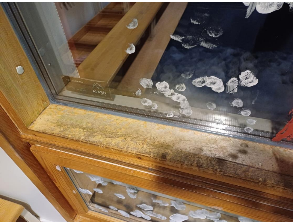
Kuva 4.5. Ikkunakarmit tarvitsevat huoltokunnostuksen.
