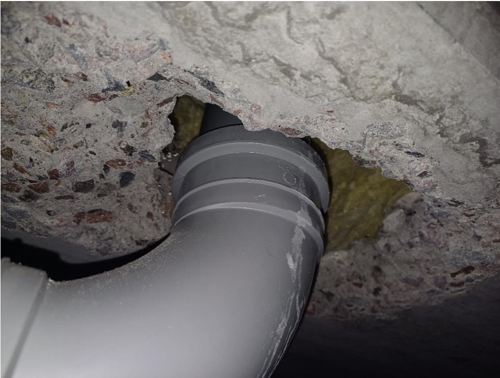
Kuva 4.6. Alapohjan läpiviennit ylöspäin eivät ole tiiviitä.
