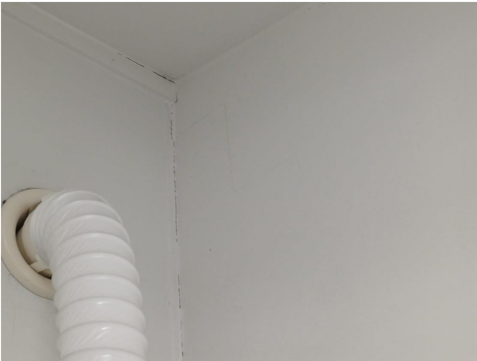
Kuva 4.1. Halkeamia ja rakenneliittymien ratkeamia useissa tiloissa.
