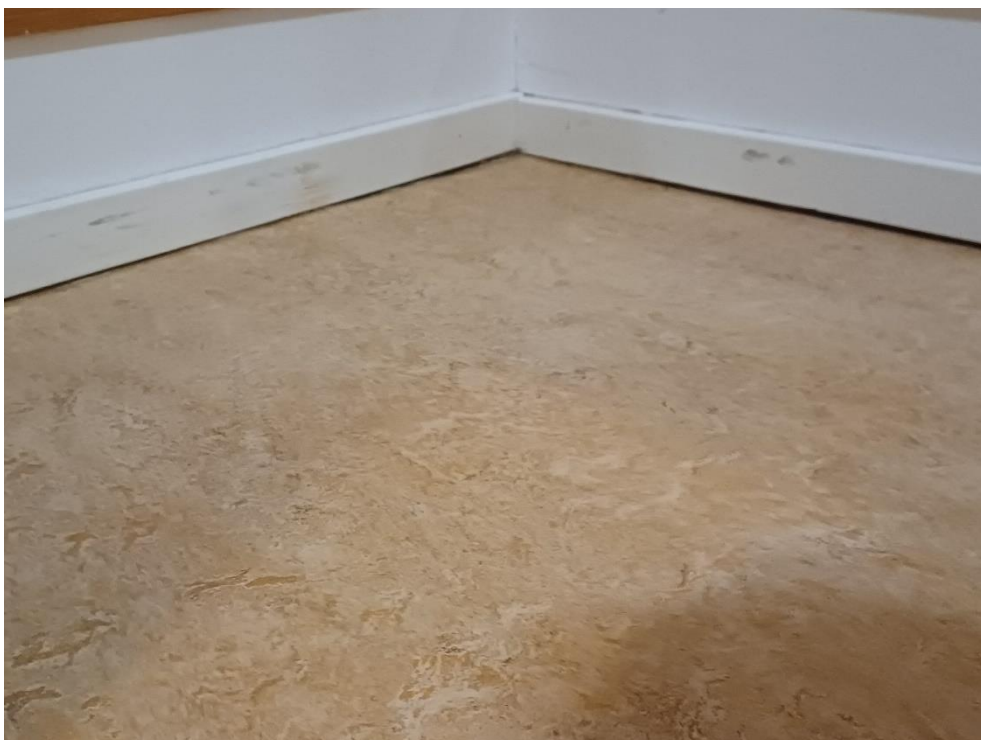
Kuva 4.3. 15 Lepohuone, lattia on painunut alaspäin ulkoseinän osalla nurkan alueella.
