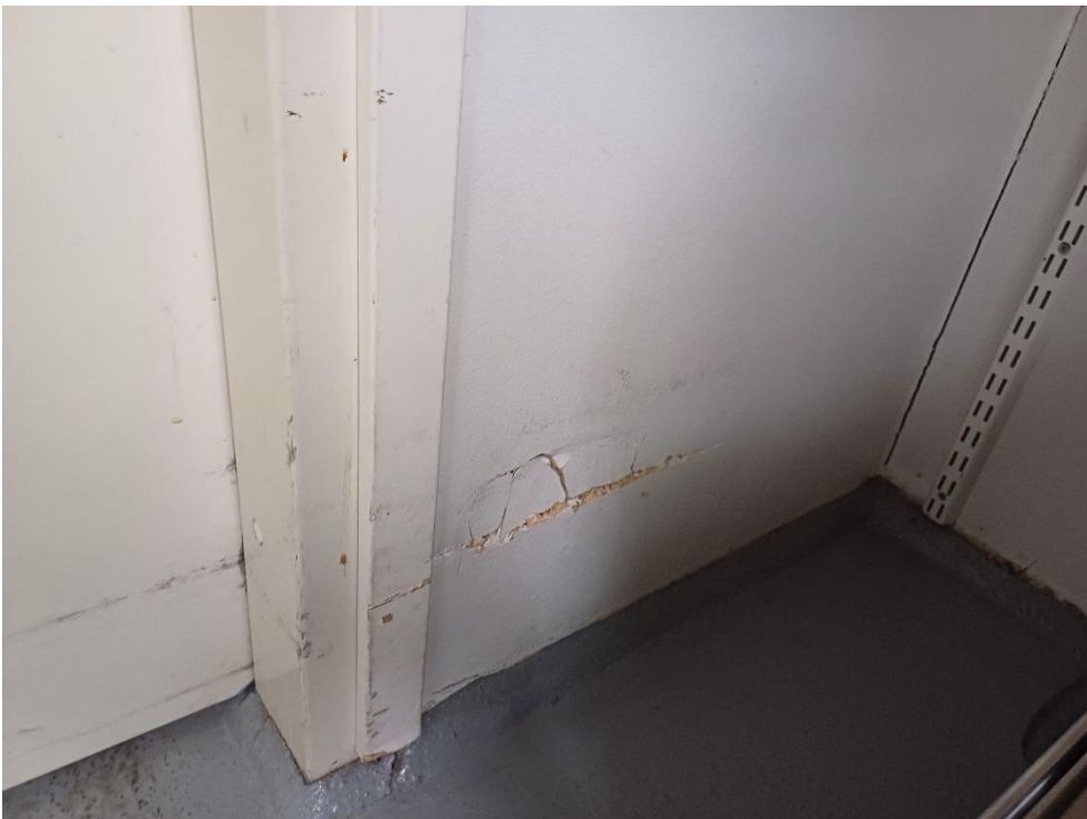
Kuva 4.2. Keittiön eteisen ulkoseinälevytyksessä on vaurio.
