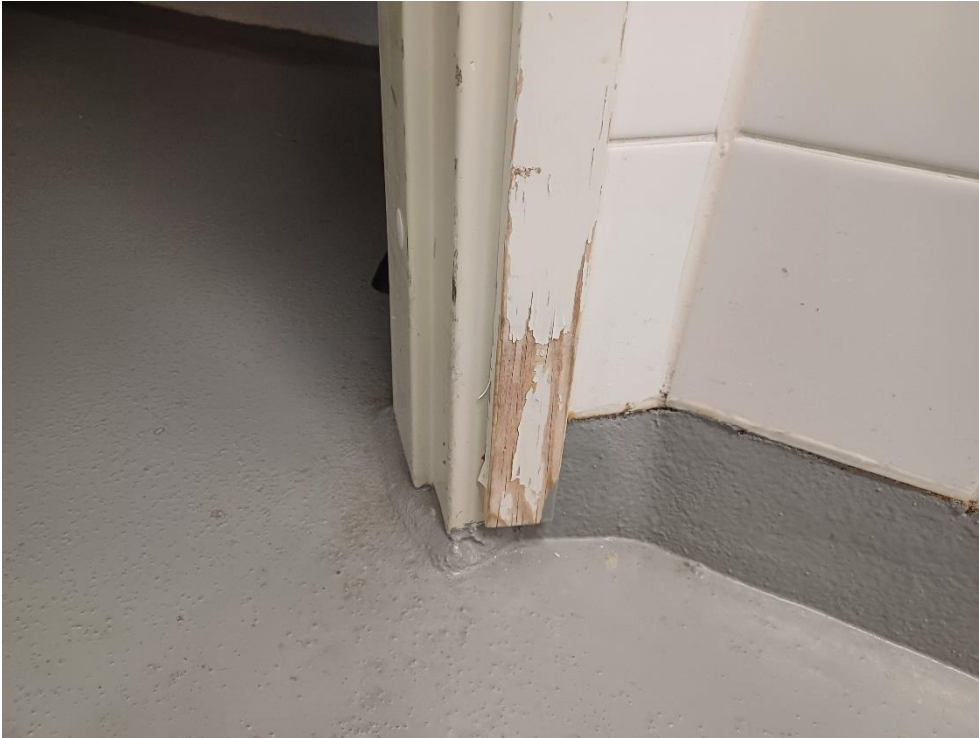
Kuva 4.1. Väliovien peitelistojen alaosat ovat kosteusvaurioituneita.
