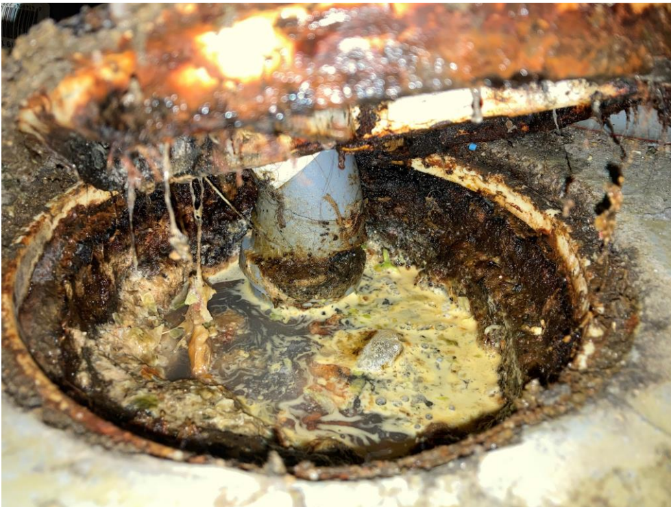
Kuva 5.1. Keittiön tiskikoneen lattiakaivo puhdistamatta. Lattiakaivo sijaitsee tiskikoneen alla.
