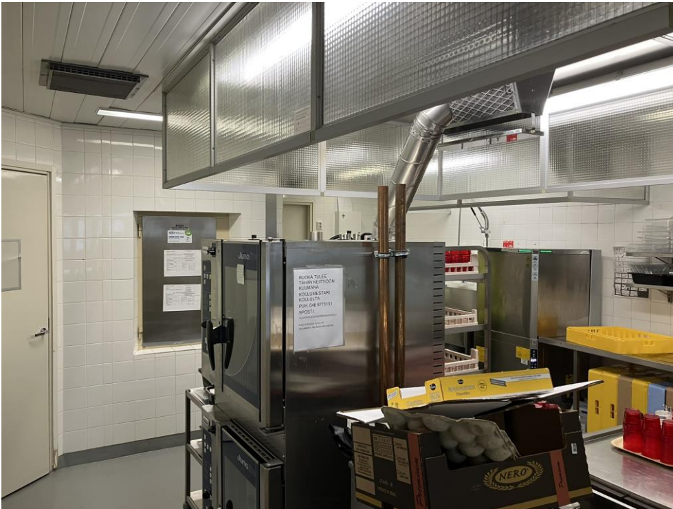
Kuva 5.2. Keittiön uuni on asetettu liian lähelle huuvin reunaa, uunin ovea avattaessa höyry karkaa huuvin reunojen yli huonetilaan.
