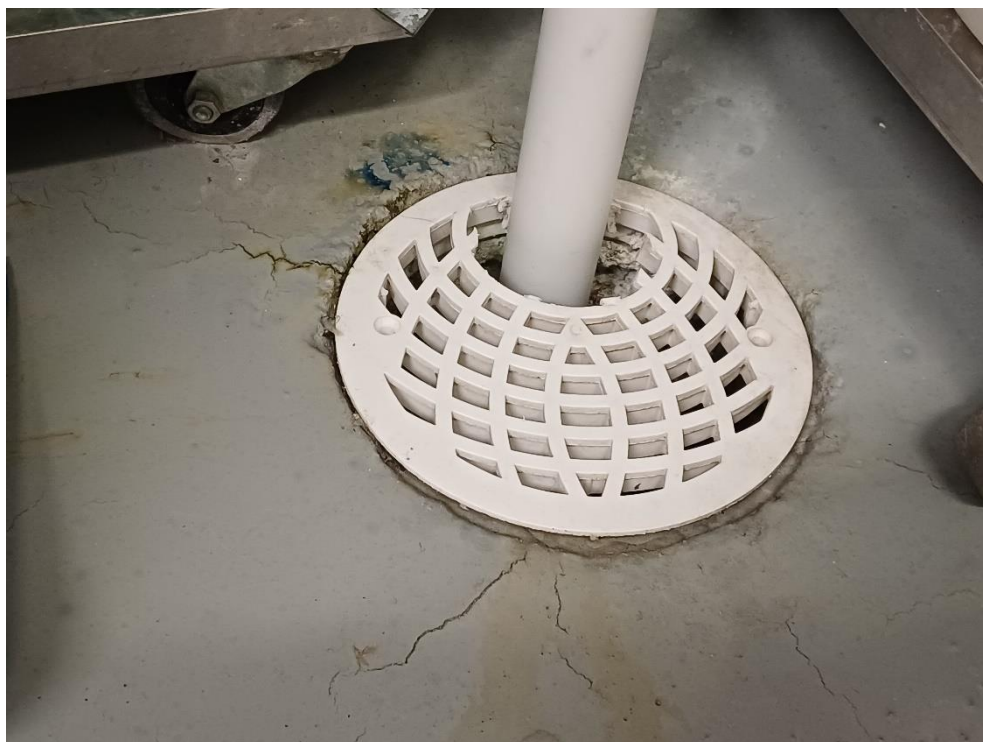
Kuva 4.3. Keittiön siivouskomeron lattiakaivon ympärillä on lattiapinnoitteen halkeamia.
