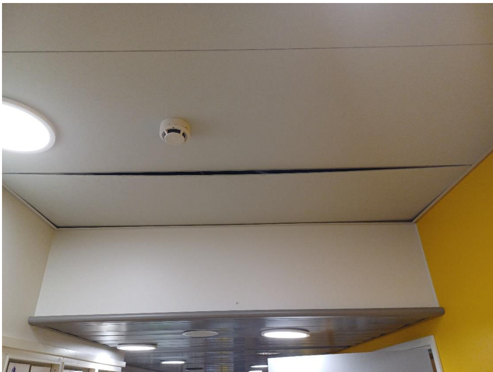
Kuva 4.3. 276 Käytävä, alakattolevy notkuu kiinnityksestään.
