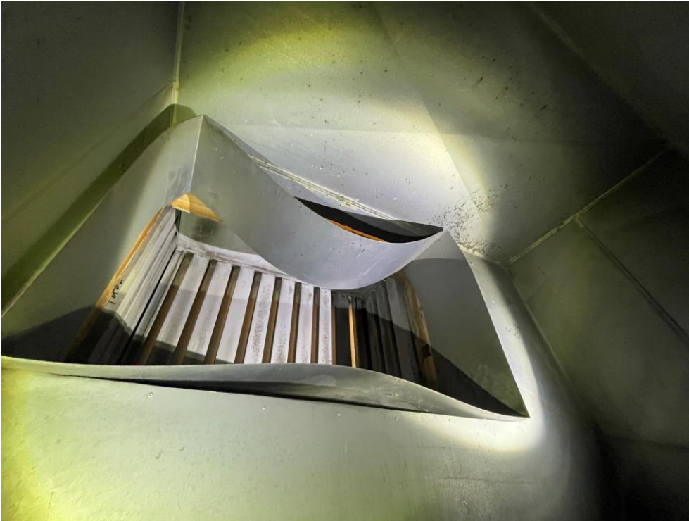
Kuva 5.2. Tuloilman raitisilmakanaviston pellitys on pois paikoiltaan ulkosäleikön kohdalla kanavan sisällä.
