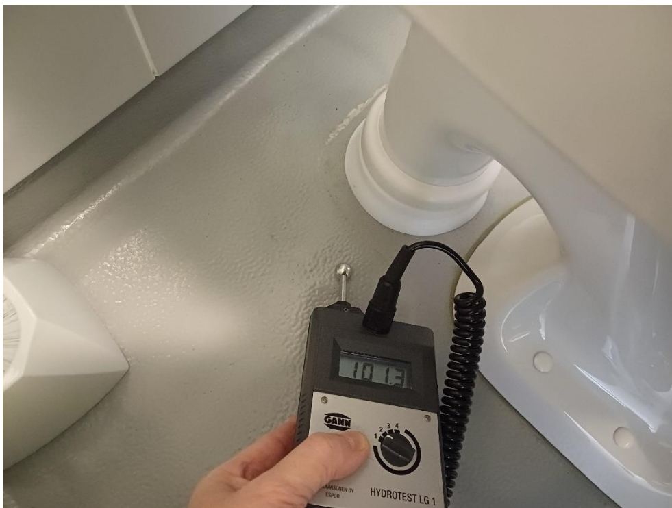
Kuva 4.4. 284 WC-tila, lattiasta mitattiin pintakosteudenosoittimella kohonneita vertailuarvoja.
