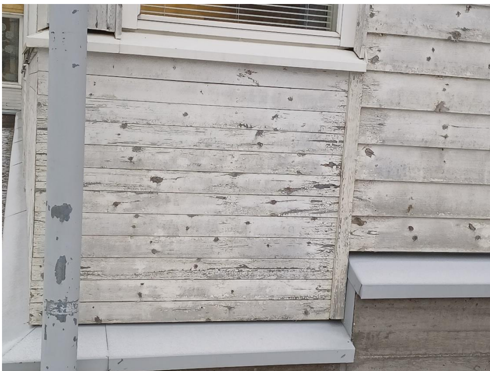
Kuva 4.8. Julkisivun puuverhous tarvitsee kauttaaltaan huoltokunnostuksen.
