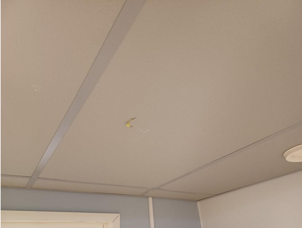
Kuva 4.1. 265 Ryhmähuone, alakaton akustointilevy on rikkoutunut.
