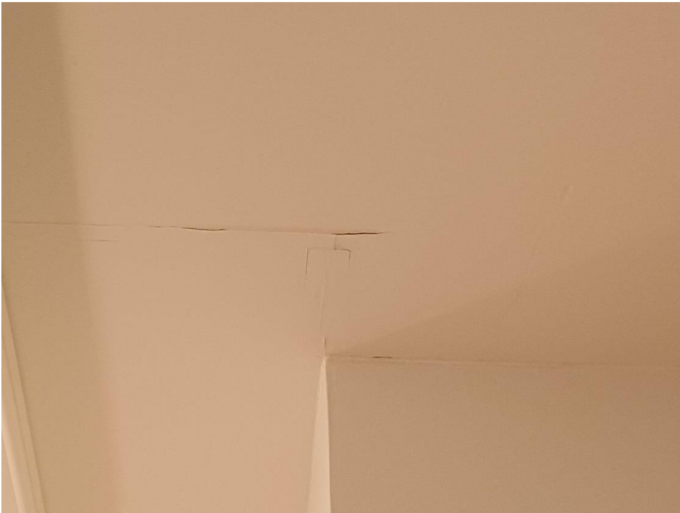
Kuva 4.2. 267 Lepohuone, alakaton levysaumauksia ratkeilee.
