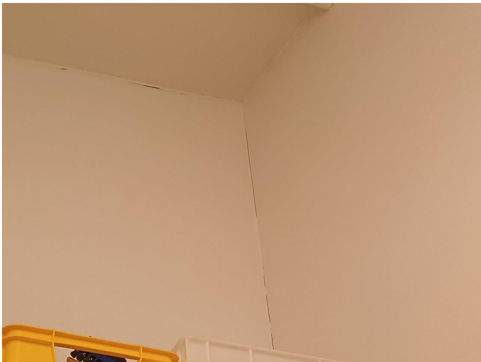
Kuva 4.7. Rakenneliittymien ratkeamia havaittiin useissa tiloissa.
