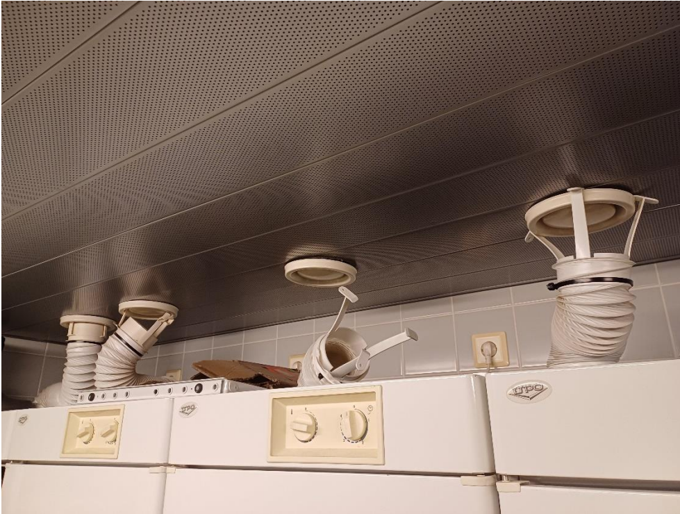
Kuva 4.5. 286 Eteinen, kuivauskaapin poistoilmaletku on irti kiinnikkeestään.
