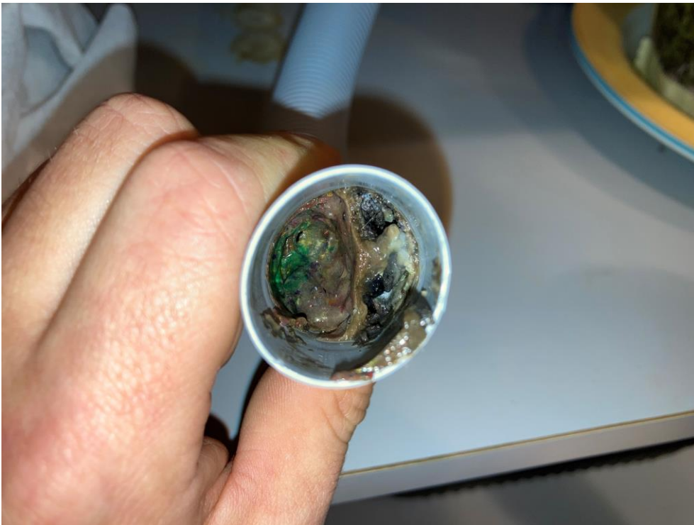
Kuva 5.1. Ryhmähuoneiden pesualtaiden ylivuotoputkistoon ja viemärin pinnoille on kerääntynyt sakkaa joka ajan mittaan alkaa haisemaan ja päästämään tunkkaista maakellarintapaista hajua sisätiloihin.
