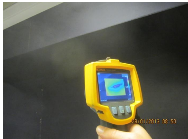
Kuva 22 1.kerroksen päätyhuoneen katonrajan kotelo on viileä.
