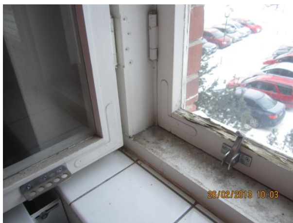
Kuva 2 Vesijälkiä ja likaa, ulkopuitteen maali on lohjennut.
