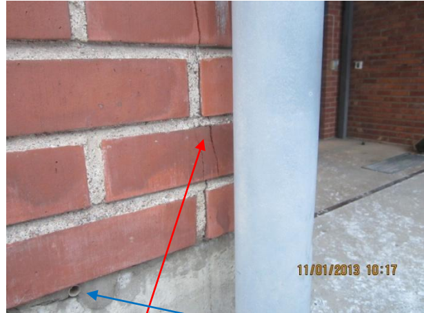
Kuva 2 Pitkien sivujen nurkilla muurauksessa on halkeamia, alareunassa "tuuletusputkia".
