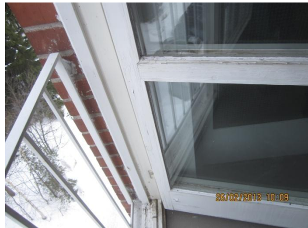
Kuva 6 Lasiovien ulkopinnat ovat huonokuntoiset.
