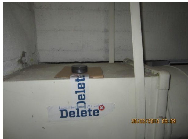
Kuva 30 Kellarin Radon-keräin lv-kanavan päällä katonrajassa.
