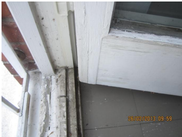
Kuva 5 Käytävän lasiparioven huonokuntoinen kynnyks.
