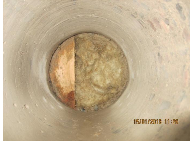
Kuva 14 AV5 kohdalla tb-sisäkuoren paksuus on n. 200 mm, sitten kehyspuu ja villa.
