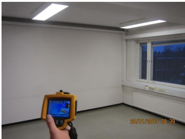
Kuva 21 6. kerroksen päätyseinä, jossa on sisäpuolinen levytys, todettiin olevan viileä.
