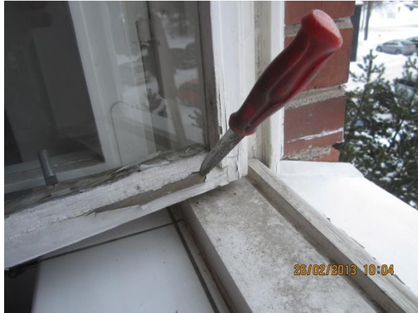
Kuva 3 Puun pinta on hieman pehmennyt, maali irtoaa. Ikkunakitti on uusittu.
