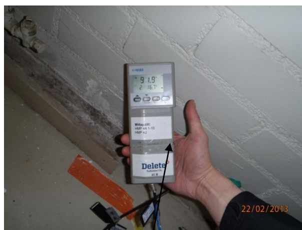
Kuva 16 Itäisivulla MP5/ PR2 alapohjan hiekkatäytön kosteus on selvästi koholla. Läheltä otettiin Mikrobinäyte 2.
