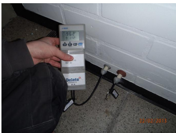
Kuva 15 Itäisivulla MP3/ PR1 portaan välitasolla, tiilimuuraus on selvästi kostea. Läheltä otettiin Mikrobinäyte 1.
