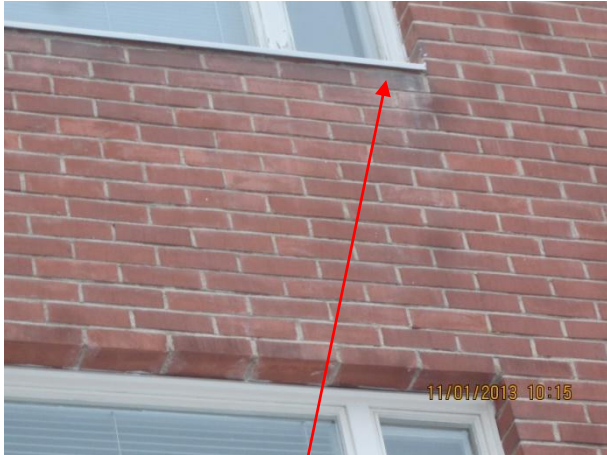
Kuva 1 Tiilien värjäytymää lyhyeksi jätetyn vesipelin alla.
