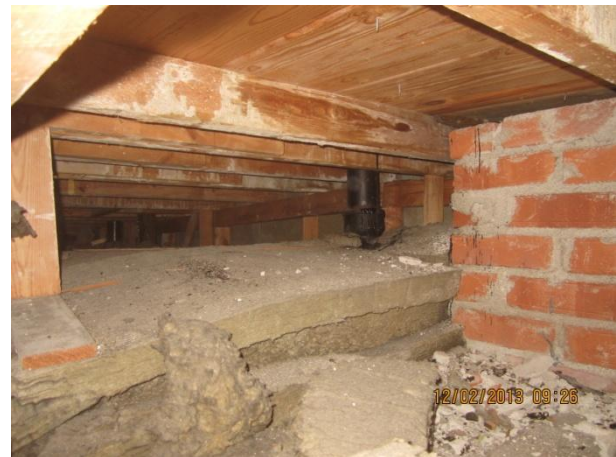
Kuva 24 IV-konehuoneeseen johtaa IV-kanavia, joita on eristeiden alla. Lisäksi on eristämättömiä valurautaviemäreitä.
