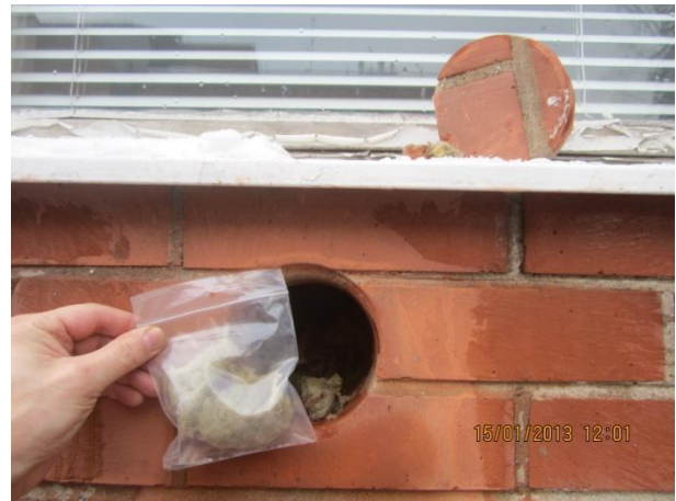
Kuva 18 AV1/ MAT3 itäisivulla 1. kerroksen ikkunan alapuolelta
