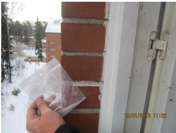
Kuva 19 MAT 6 pohjoisjulkisivun tiilimuurauksen ulkopinnan laastista, sisältää homekasvua.
