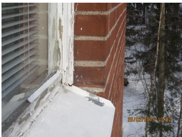
Kuva 1 Tyypillinen ikkunan ulkopinta, maali on irti, alapuitteen lasituskitti on irti.
