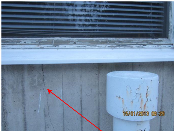
Kuva 3 Sokkelikorotuksen halkeama länsisivulla.
