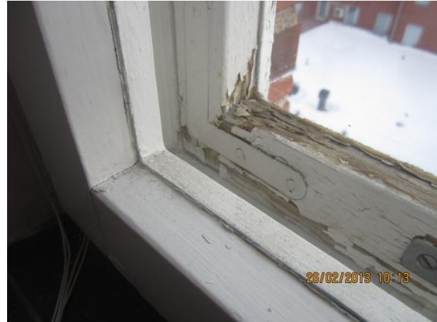
Kuva 4 Ison puitteen ulkoalapuite on jo vääntynyt liitoksessaan.
