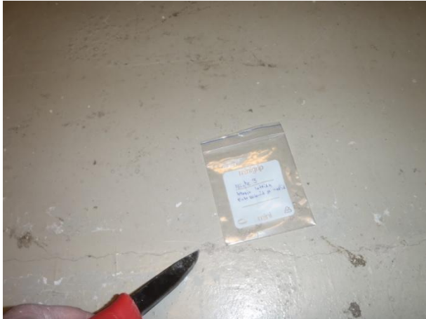
Kuva 17 Mikrobinäyte 3 lattian pintabetonista sisälsi erittäin runsaasti mikrobeja.
