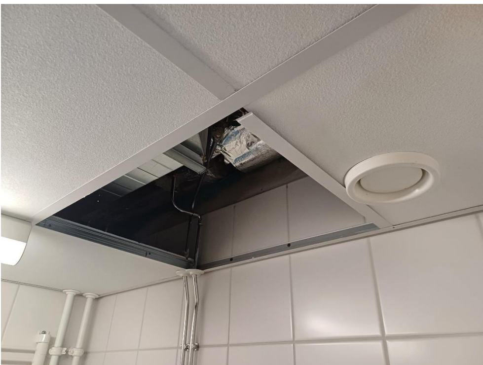
Kuva 4.7. 126 Siivous, alakaton akustointilevy puuttuu.
