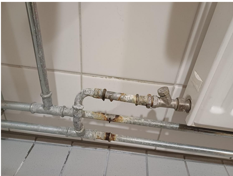
Kuva 4.3. 108 Pesuhuone, lämpöpattereiden putkiosia on hapettunut ja ruosteessa.
