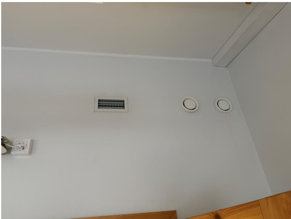
Kuva 5.2. Ilmanvaihdon päätelaitteet ovat iäkkäitä eikä niissä ole kunnollista säätömahdollisuutta.
