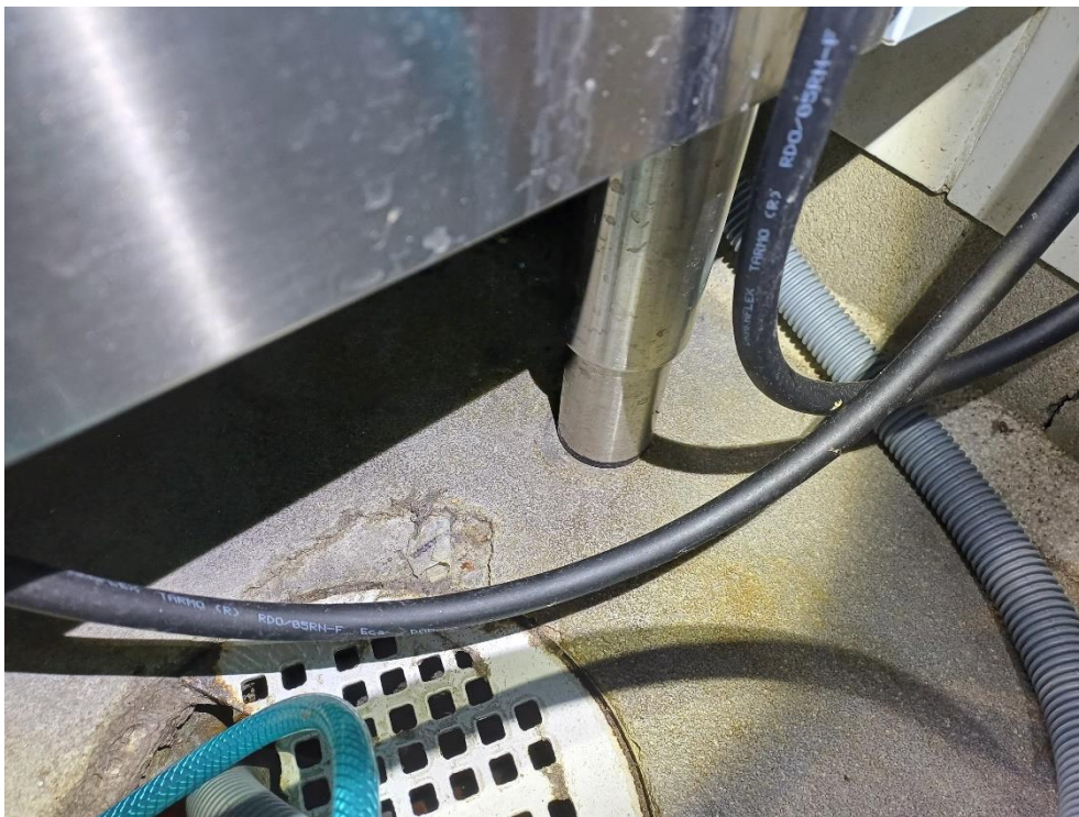
Kuva 4.8. 128 Keittiö, astianpesukoneen alapuolella olevan lattiakaivon ympärillä on lattiapinnan vaurioita.
