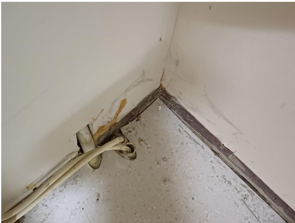
Kuva 4.2. 107 Ryhmäkeskus, alapohjaan menevien sähköputkien päät on tiivistämättä.
