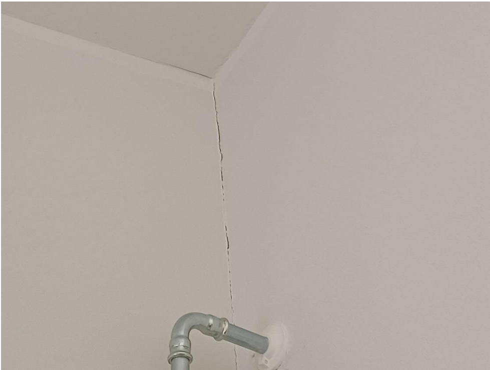
Kuva 4.14. Seinähalkeamia sekä rakenneliittymien ratkeamia on useissa tiloissa.
