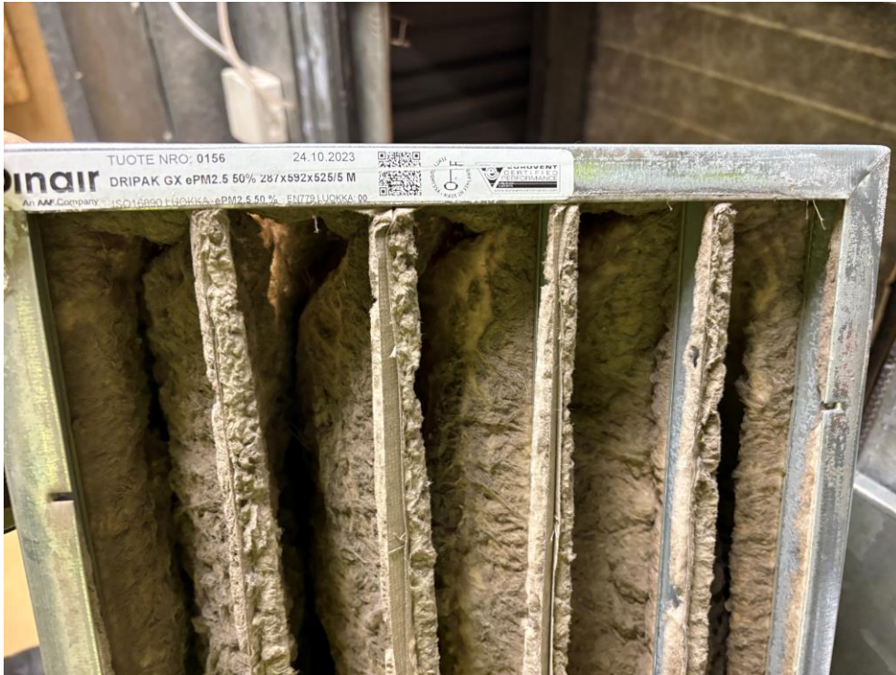
Kuva 5.1. Ilmanvaihdon suodattimet olivat likaiset. Tulo- ja poistoilman suodattimet vaihdettu tarkastuksen yhteydessä.
