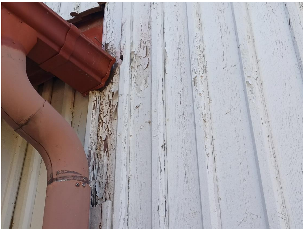
Kuva 4.16. Julkisivun puuverhoilut tarvitsevat kauttaaltaan huoltokunnostuksen.
