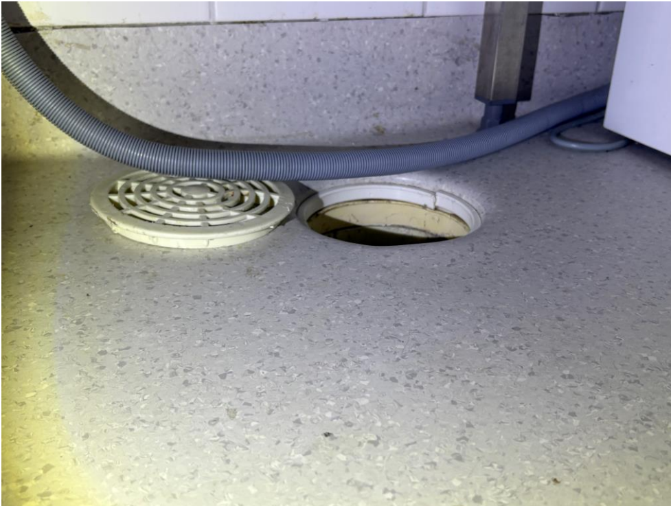
Kuva 5.3. Kodinhoitohuoneessa 116 on lattiakaivo, johon ei vesi laske mistään altaasta tai muustakaan vesipisteestä.
