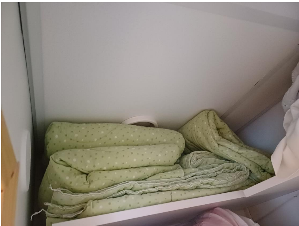
Kuva 4.5. 118 Liinavaatevarasto, liinavaatteita on pakattu hyllyille siten, että ne tukkivat poistoilmaventtiilin.
