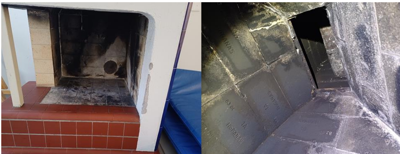
Kuva 4.11. 132 Liikuntatila, takka on avoin, mitä kautta mahdollisesti tulevat epäpuhtaudet saattavat heikentää sisäilman laatua.
