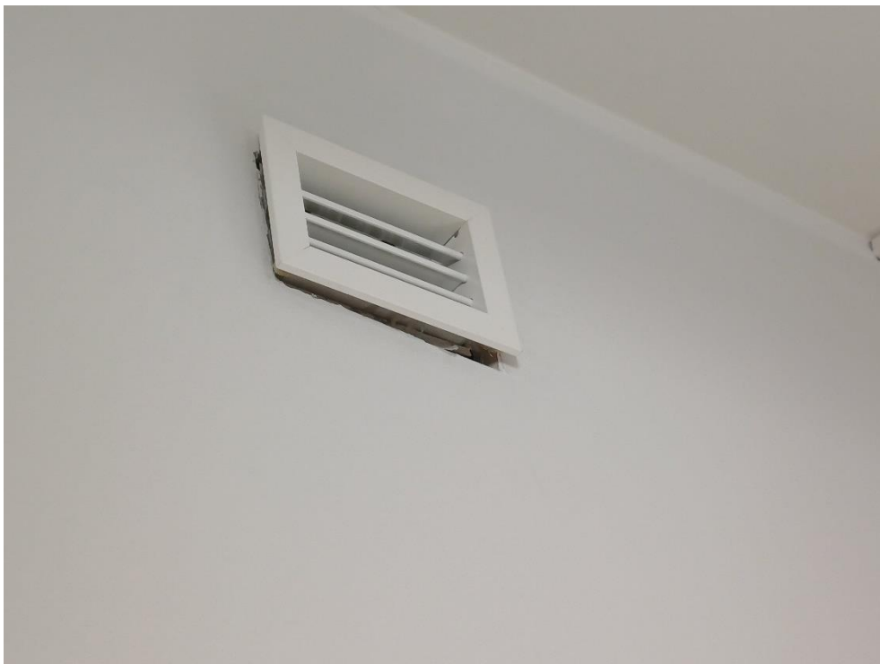
Kuva 4.4. 112 Toimisto ja 114 Henkilökunnan työhuone, tuloilman päätelaite ei ole tiiviisti kiinni seinäpinnassa.
