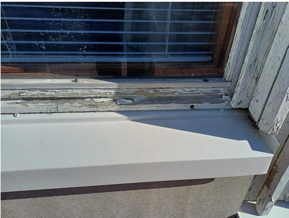
Kuva 4.15. Ikkunat tarvitsevat kauttaaltaan huoltokunnostuksen.
