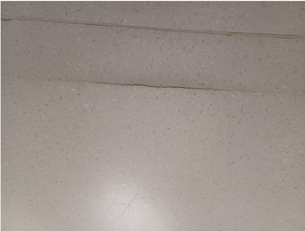
Kuva 4.12. 133 Veistohuone, oviaukon kohdalla on lattiapinnoitteen ratkeama.
