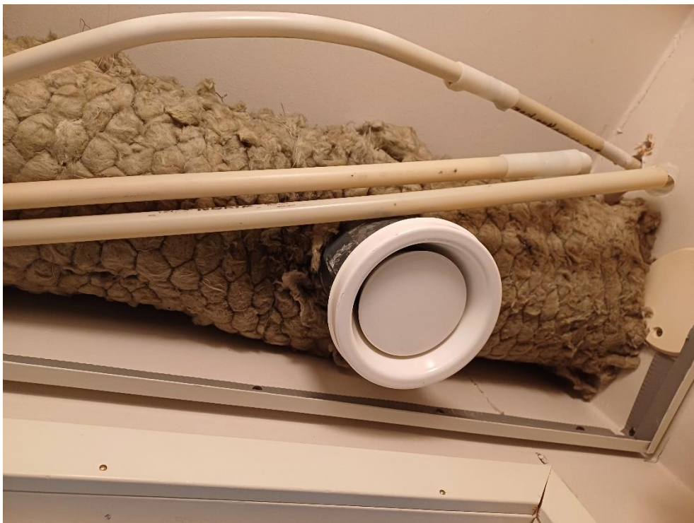
Kuva 4.10. 128 Keittiö, siivouskomeron katossa kulkevan IV-kanavan eristeenä käytetty mineraalivilla on pinnoittamatta.
