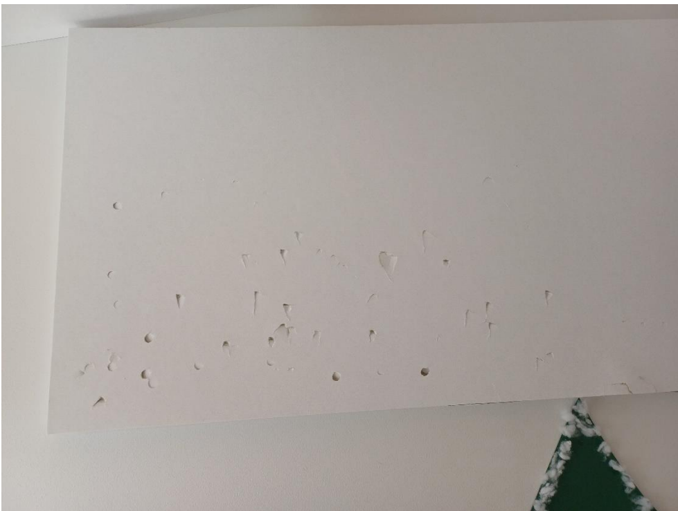
Kuva 4.1. 104 Pienryhmähuone, akustointilevyjen pintoja on rikkoutunut.
