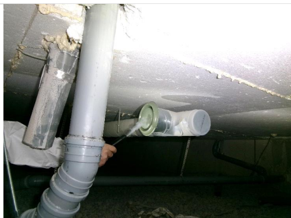
Kuva 16. Kuvassa ryömintätilan poistoilmakanavan päätyventtiili, jossa todettiin merkkisavun avulla olevan imu. Poistoilmaventtiilejä oli yhteensä 6 kpl ja kanava kulki ryömintätilan keskellä.
