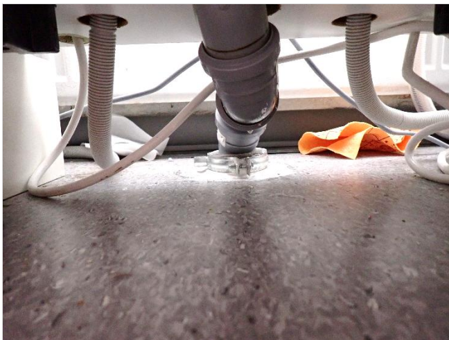
Kuva 5. Kotitalousluokan 1 (tila 015) astianpesukoneen jätevesiputken läpivienti oli tiivistetty, mutta kohdassa todettiin silti ilmavuotoa.
