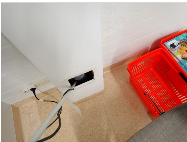
Kuva 7. Opo-tilan 025 pienemmän kotelorakenteen lattian läpivientikohdat ovat tiivistämättä.
