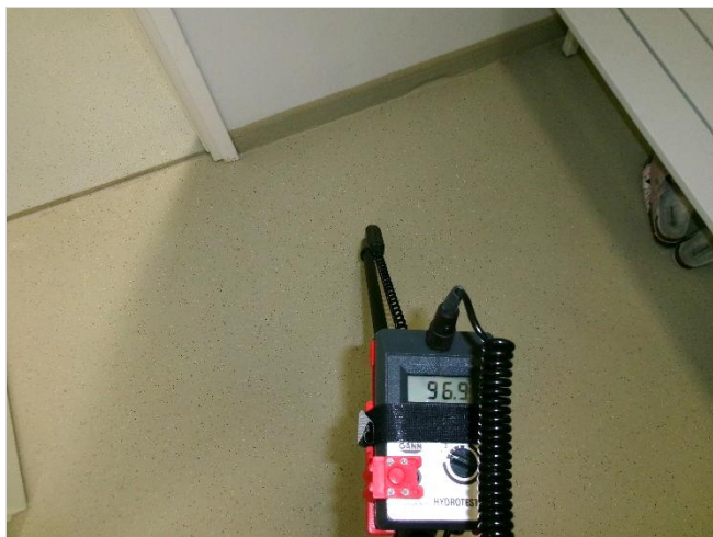
Kuva 3. B-osan pohjakerroksen väestösuojaan naisten pukuhuoneessa todettiin hieman kohonnut pintakosteudenilmaisimen lukemia (90–95) lattiapinnassa. Alue pukuhuoneen puolella oli n. 20 cm x 20 cm. Syy voi olla lattiarakenteissa ja kohdan pintakosteuslukemia suositellaan seurattavan säännöllisesti.
