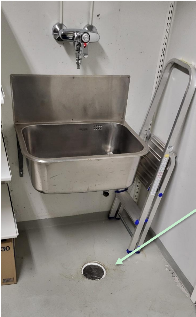
Kuva 20. Tilassa 13.1 havaitun hajuhaitan syynä on ollut todennäköisesti kaivo, jonka hajulukko pääsee kuivumaan käytöstä poistetun pesualtaan takia.
