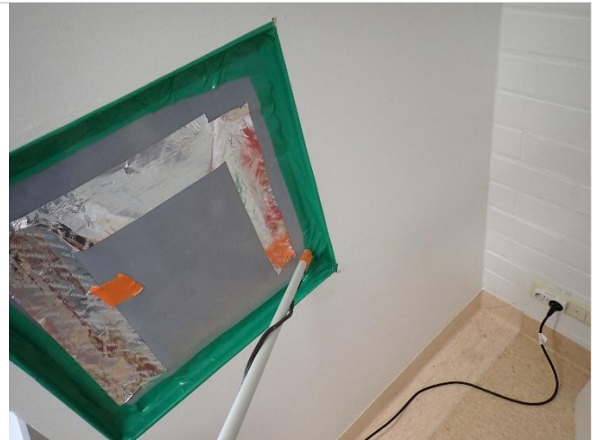
Kuva 10. Opo-tilan 025 isomman kotelorakenteen tarkastusluukun kohtaa oli tiivistetty, mutta teippaukset eivät olleet täysin tiiviitä.
