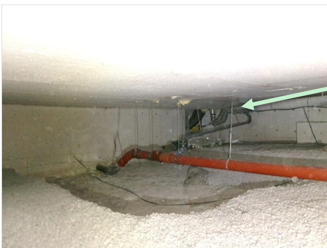
Kuva 17. Poistoilmakanava kulkee ulos Opo-tilan 025 kotelorakenteen kohdalta. Viemäriinjat kulkevat osittain maanvaraisena ja osittain ne on kannakoitu.
