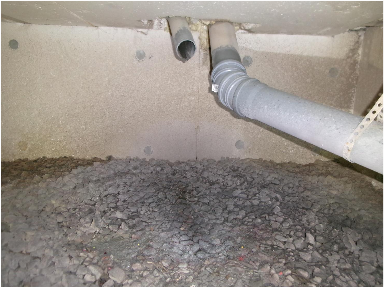
Kuva 19. Kuvaamataitoluokan 023 käytävän vastaisen seinän lavuaarin lattiakaivon viemäri on kytkemättä ryömintätilassa. Uusi kaivo on todennäköisesti lattiamaton alla ja vanha kaivo laskee lavuaarin pesuvedet suoraan maatäyttöön.
