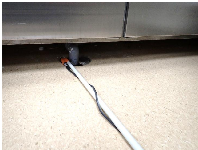
Kuva 6. Kuvisluokan (tila 023) lattiakaivon kohdalla todettiin epätiivelyskohta.
