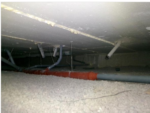
Kuva 15. Vanhat viemärit "törröttävät" ryömintätilassa. Uusia viemärien läpivientejä ei ole tiivistetty ryömintätilan puolelta, mutta niitä on tiivistetty ja tiivistyksiä paranneltu (Inlook Sisustus Oy, 3.4.2025) sisätilojen puolelta.
