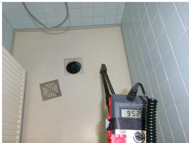
Kuva 4. Naisten pukuhuoneen suihkutilan lattiassa oli myös pistemäinen kohonnut alue (15 cm x 15 cm). Suihkun käyttöhistoriasta ei ollut tietoa. Kaivon liitoskohta mattoon näytti hieman epätiiviltä ja liitoskohta suositellaan tiivistettävän.
