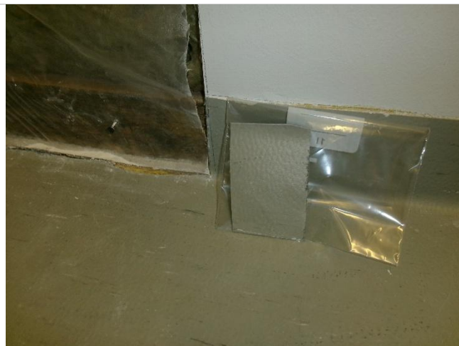
Kuva 4. 121 sähköpääkeskuksen muovimatossa todettiin DEHP pitoisuuden ylittävän vaarallisen jätteen raja-arvon.
