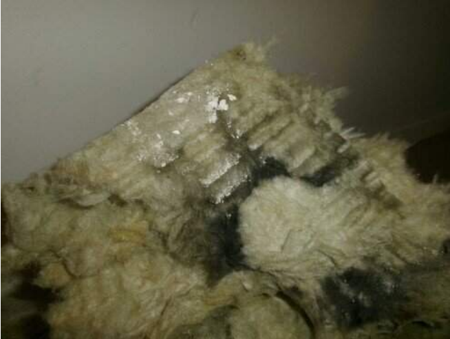
Kuva 44 Rikkoutuneen tuulensuojakipsilevyn kohdalta tummentuma lämmöneristeessä.
