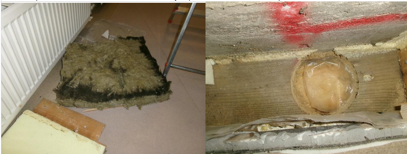
Kuva 37. Rakenneavaus RA12 tehtiin tilan 137 liikuntasali ulkoseinän alaosaan. Ulkopuolella havaittiin, että sadevesikourun yli roiskuu vettä, joka kastelee sokkeliä usean metrin matkalta. Ulkoseinän lämmöneristeissä havaittiin runsaasti ilmapuotojälkiä etenkin betonisokkelin ja puuverhouksen liittymässä. Lisäksi ilmapuotoa ja lämmöneristeiden likaantumista havaittiin sokkeli-lattialiitoksien kohdalla. Lämmöneristeestä kerätyssä materiaalinäytteessä M15 ei ollut mikrobikasvua ja muovin sisällä olevasta mineraalivillakaistasta M14 sekä sokkelin päällä olevasta huopakaistasta M18 otetuissa näytteissä oli mikrobikasvua.
