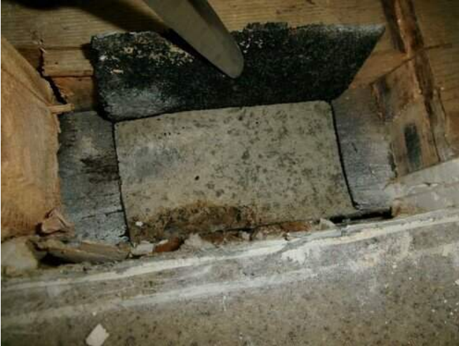
Kuva 35 Sokkelissa huopakaistan alta havaittiin kosteutta. Pintakosteus yli 150 (GANN)
