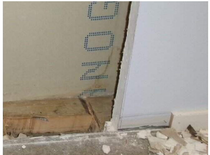
Kuva 34 Keittiön vastaisen seinän sisäpinnassa havaittiin vanha vesivahingon jälki. Keittiössä on seinän takana astianpesupiste.
