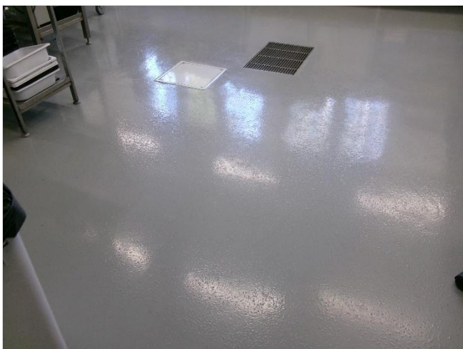
Kuva 18. Keittiön lattiapinnoite oli juuri uusittu epoksinnoitteeksi.
