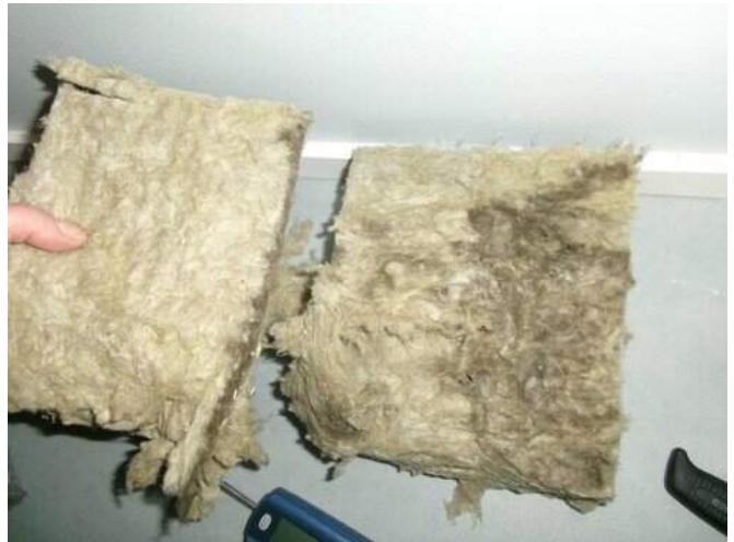
Kuva 21 Lämmöneristeessä hieman ilmavuodosta johtuvaa tummentumaa
