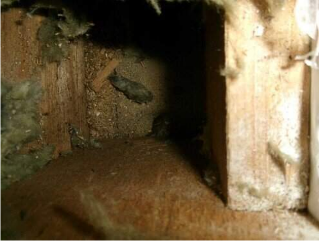
Kuva 3 Alaohjauspuun päälle jäänyt rakennusaikaista sahanpurua.
