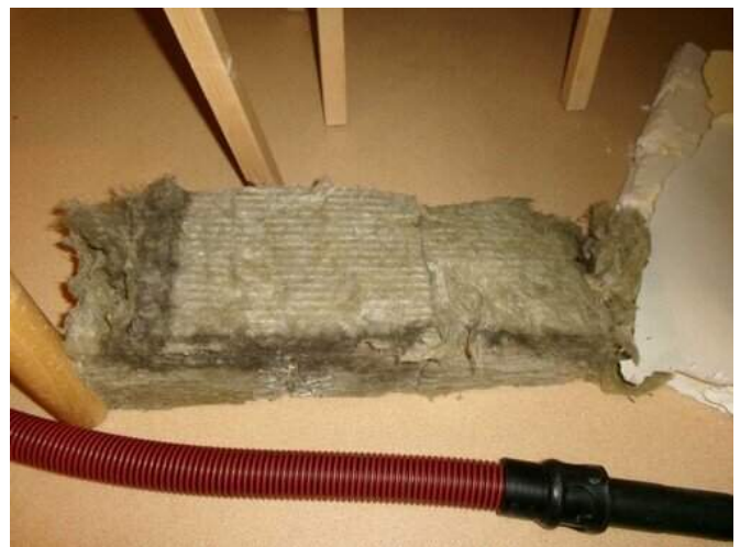
Kuva 40 Lämmöneristeessä paljon ilmavuodosta johtuvaa tummentumaa
