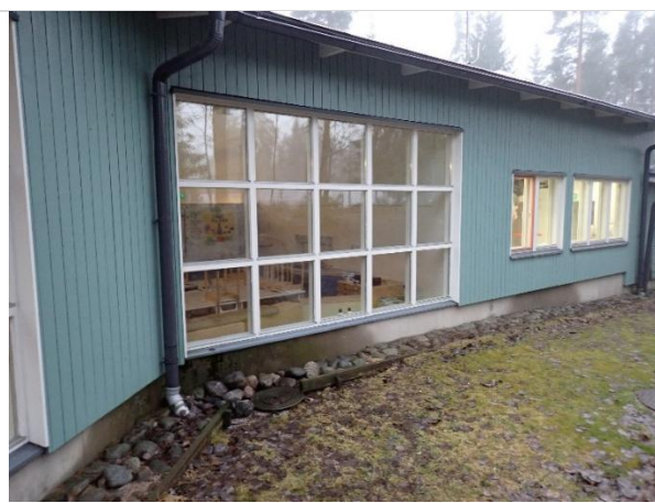
Kuva 31. Liikuntasalin ja ruokailutilan kohdalla sadevesikourun yli roiskuu vettä, joka kastelee sokkelia usean metrin matkalta.
