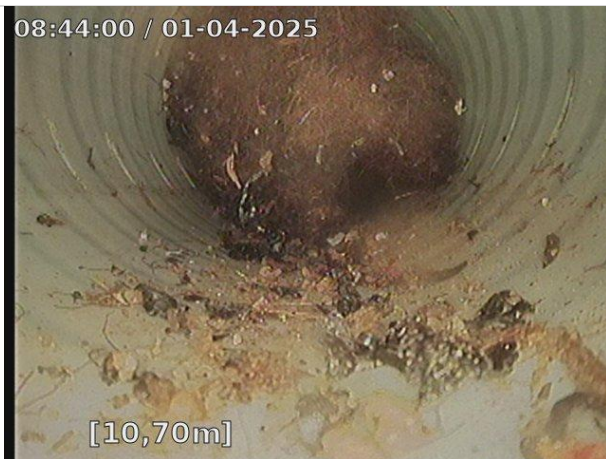
Kuva 10. Salaojakaivo 10 suunta salaojakaivo 11: 10 metrin kohdalla kuolleita juuria. Juuret eivät olleet kiinni vaan liikkuvat kameran mukana.
