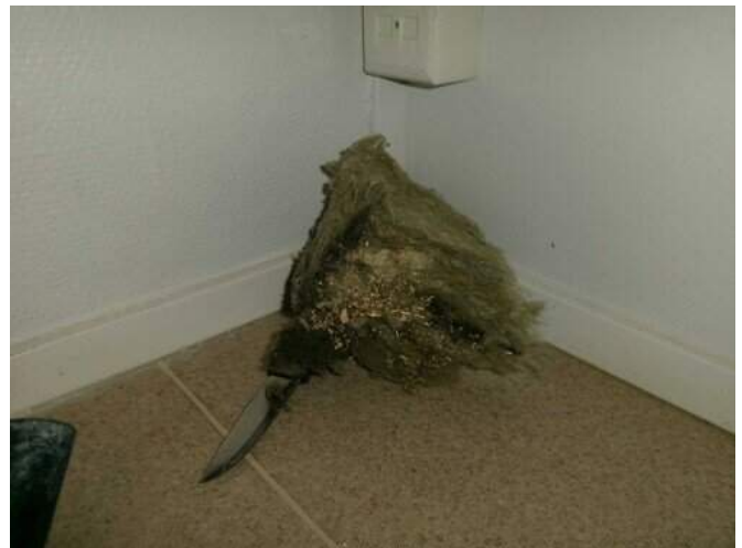
Kuva 2 Lämmöneristeessä paljon ilmavuodosta johtuvaa tummentumaa
