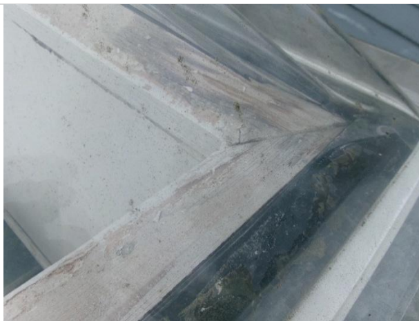
Kuva 69. Kattoikkunoiden puurakenteissa viitteitä pitkäaikaisesta kosteusrasituksesta.
