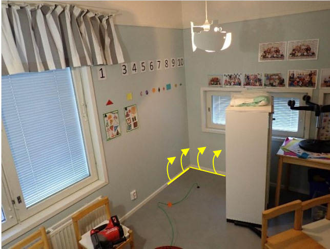
Kuva 22. Leikkitilassa 149 (MA2) ilmavuotokohtina olivat lattian ja ulkoseinien liitoskohdat, sekä lattian ja väliseinän liitoskohta.
