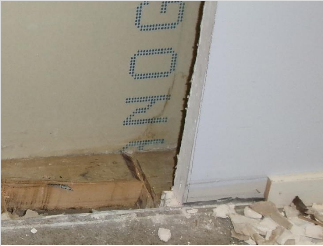
Kuva 44. Käytävään 127 keittiön vastaiseen väliseinään tehdyn rakenneavauksen RA15 kohdalla havaittiin vanha kuivunut kosteusvaurio.
