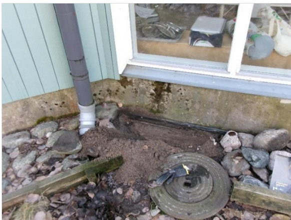
Kuva 5. Liikuntasalin ja ruokasalin kohdalla sokkeliin kohdistuu kosteusrasitusta yli vuotavasta sadevesikourusta. Sokkelin viereen kaivettiin kuoppa, jonka kautta tarkastettiin sokkelin routa- ja vedeneristykset.
