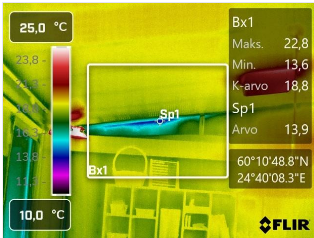
Kuva 58. Leikkitila 153 yläpohjan ja väliseinänä liitoksessa ilmapuotoa.
