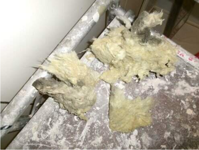
Kuva 30 Lämmöneristeessä paljon ilmavuodosta johtuvaa tummentumaa.
