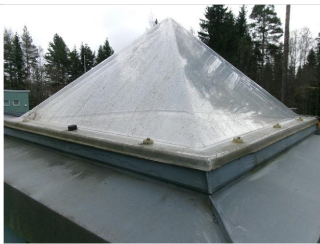
Kuva 67. Kattoikkunoiden kiinnikkeiden suojatulpat irronneet.
