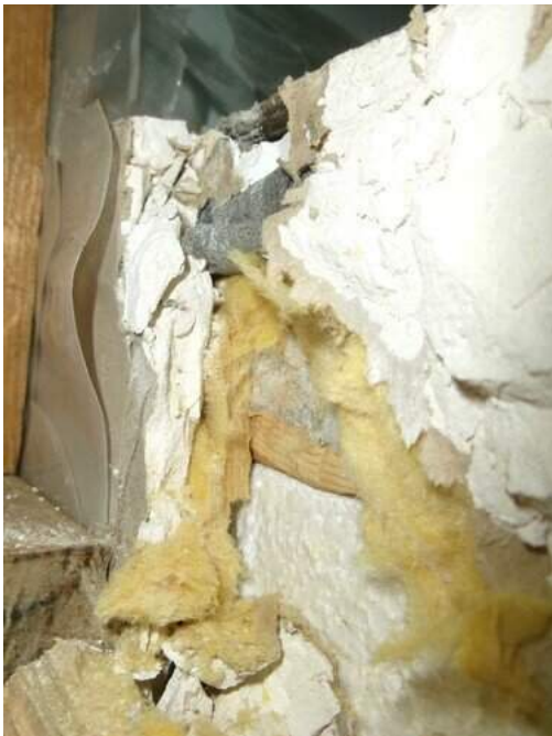
Kuva 9 Höyrynsulkumuovi päättyi alaohjauspuun alareunaan.
