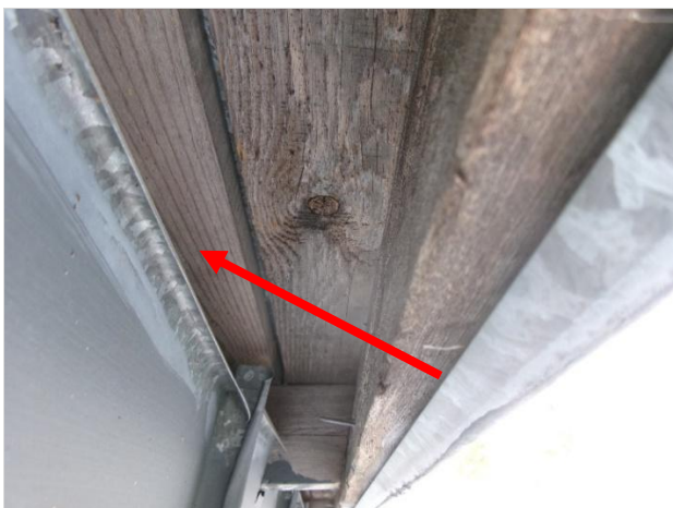
Kuva 70. Räystäältä puuttuu jyr sijäverkko.
