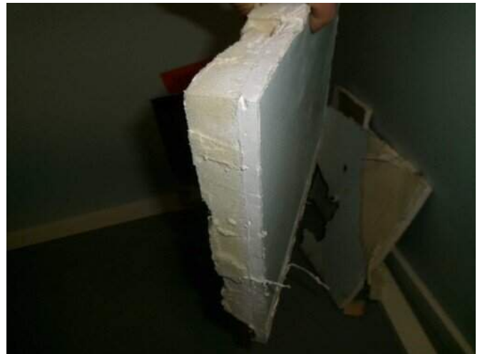
Kuva 19 Kipsilevyn pintaan lisätty polyuretaanilevy 30 mm ja kipsilevy 10 mm
