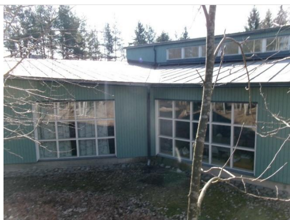
Kuva 8. Ylemmän vesikaton sadevedet laskevat liikuntasalin ja ruokailutilan väliseen sadevesikouruun. Sokkelin kastumisen perusteella vesi menee sadevesikourun yli sateella.
