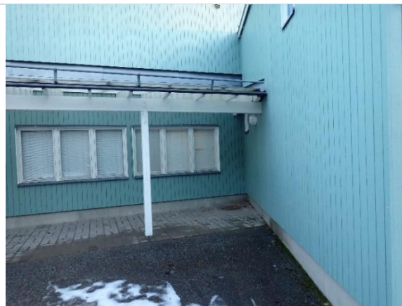
Kuva 27. Katoksen sadevesikourusta valuu vettä ulkoseinään päin ja kastelee mm. sokkelirakennetta.
