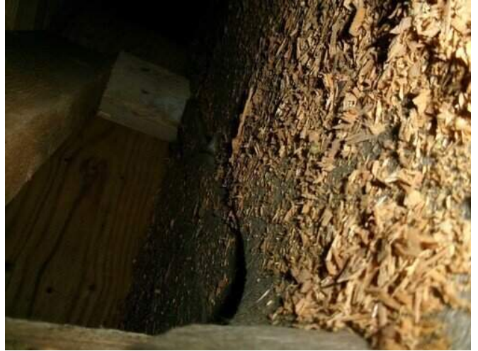
Kuva 31 Kovan mineraalivillan päällä paljon rakennusaikaista purua.
