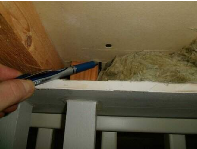
Kuva 13 Kaiteen pystypuun läpivienti oli epätiivis. Aistinvaraisesti raosta havaittiin ilmavuotoa.
