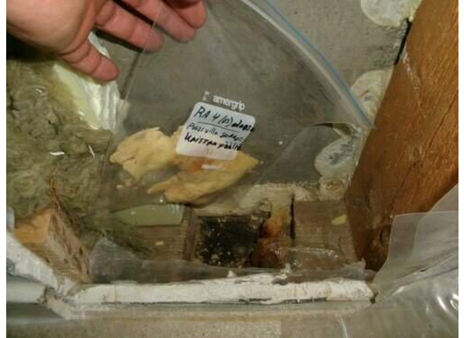
Kuva 8 Alaohjauspuun alla muovin sisällä olevasta mineraalivillasta otettiin näyte mikrobiviljelyyn. Näytteessä havaittiin mikrobikasvua.
