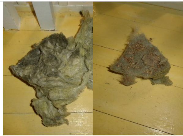
Kuva 49. RA6 lämmöneriste oli likaantunut ilmapuodon kohdalta ja kovan lämmöneristeen päällä oli runsaasti rakennusaikaista puupurua.
