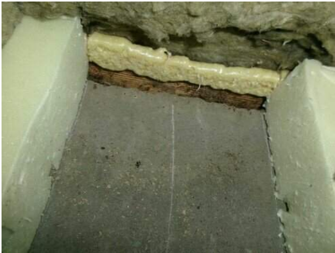
Kuva 20 Sokkelin ja julkisivuverhouksen liitoksessa jälkiä ilmavuodosta.
