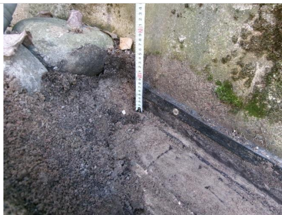
Kuva 6. Koekuopasta havaittiin reunalistan jäävän maanpinnan alapuolelle. Vedeneristystä ei ole suojattu patolevyllä.
