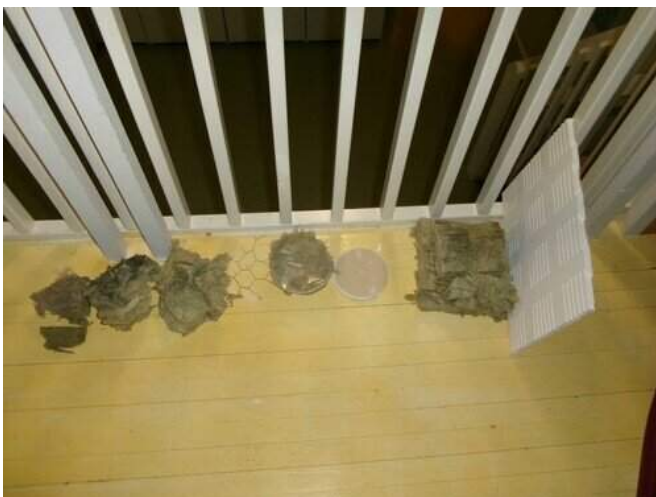
Kuva 11 Lämmöneristeessä paljon ilmavuodosta johtuvaa tummentumaa
