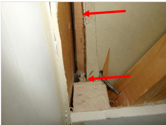
Kuva 52. Höyrynsulku päättyy ennen palkkia. Lämpökuvauksessa rakenneavauksen kohdassa (RA14) havaittiin merkittävä ilmavuoto ja ilmavuoto viilensi rakennetta usean neliön alueelta.
