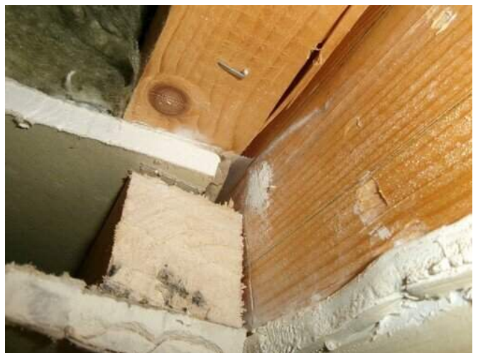
Kuva 29 Höyrynsulku muovia ei ole tiivistetty rakenteeseen.
