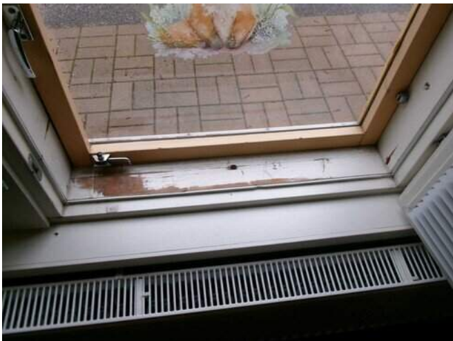
Kuva 50 Karmin maalipinnan on erittäin kulunut ikkunoiden välissä.
