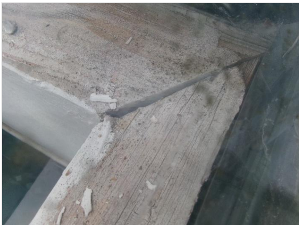
Kuva 68. Kattoikkunoiden puurakenteissa viitteitä pitkäaikaisesta kosteusrasituksesta.
