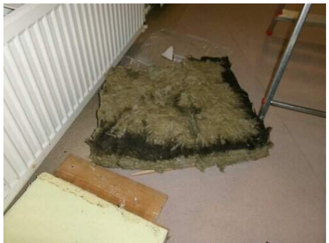
Kuva 26 Lämmöneristeessä runsaasti ilmavuodosta johtuvaa tummentumaa
