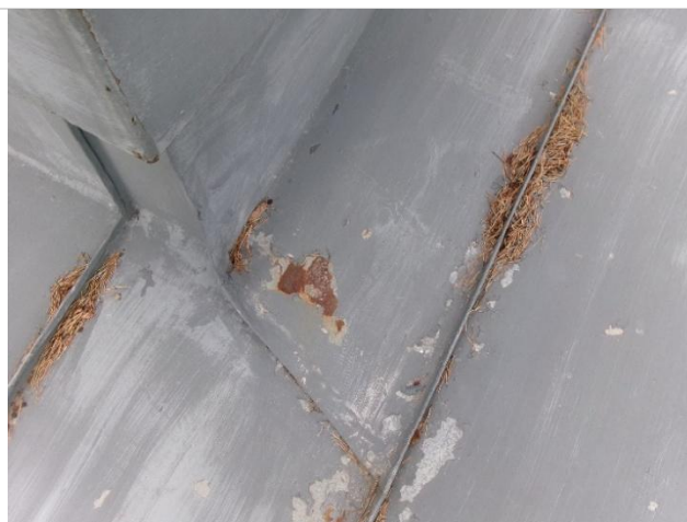
Kuva 65. Peltikatteessa oli paljon pistemäistä korroosiota.
