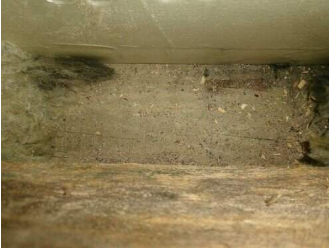
Kuva 38 Ilmavuoto jäljet alaohjauspuun ja xps-levyn saumasta.
