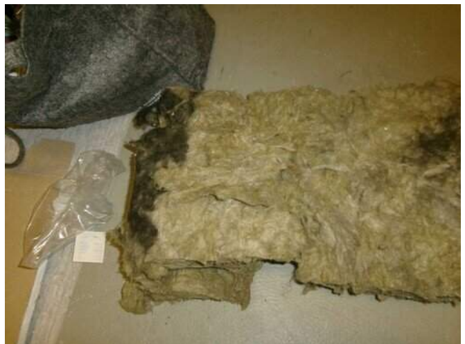
Kuva 37 Lämmöneristeessä paljon ilmavuodosta johtuvaa tummentumaa
