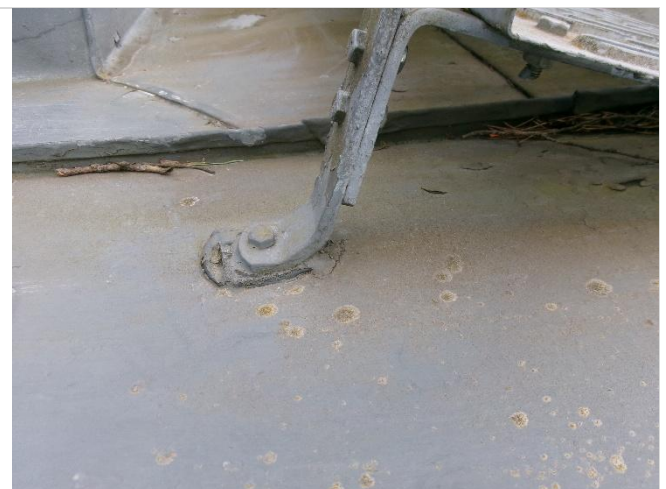
Kuva 61. Vesikaton kulkusillat on kiinnitetty suoraan peltikatteen läpi.
