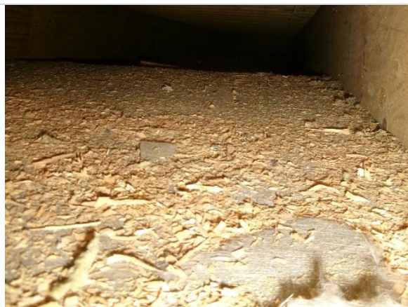
Kuva 53. RA14 avauksesta havaittiin runsaasti rakennusai-kaista puupurua kovan lämmöneristeen päällä.
