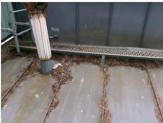
Kuva 64. Vesikatolla paikoin paljon kariketta.
