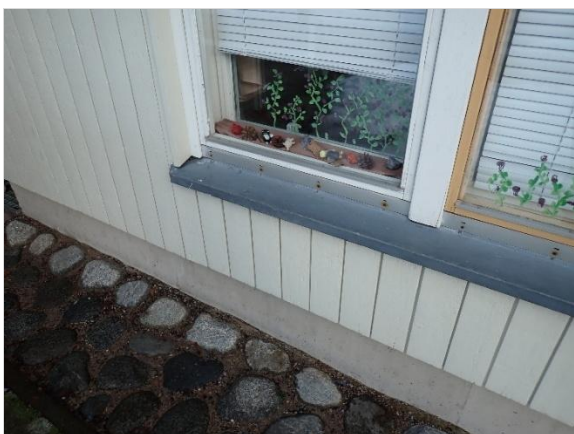
Kuva 28. Tilan 117 kohdalla havaittiin rakennuksen ainoa kohta, jossa ikkunapelti viettää reunoista ulkoseinärakenteeseen päin.
