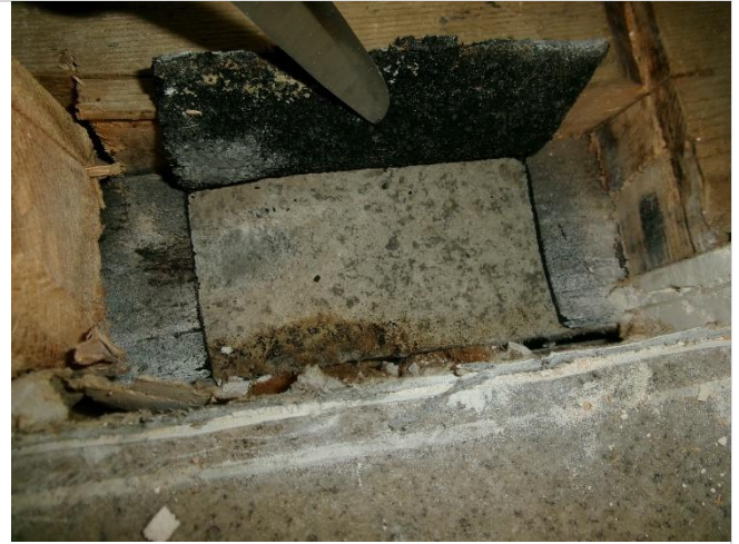
Kuva 45. Väliseinien alaohjauspuiden alle on asennettu huopakaistale. Alaohjauspuu on noin 50 mm lattiapinnan alapuolella. Kipsilevyn ja betonilaatan välissä on mineraalivillaa. Huopakaistaleen alla sokkeli oli kostea (pintakosteus yli 150)
