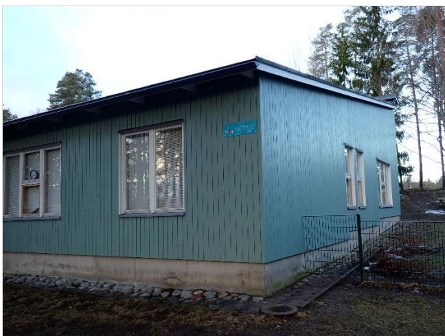
Kuva 34. Esimerkkinä rakennuksen yksi kolmesta ”päädyistä” (pohjois-koillis), jossa räystärakenteen antamaa suojaa ulkoseinälle on vähemmän.
