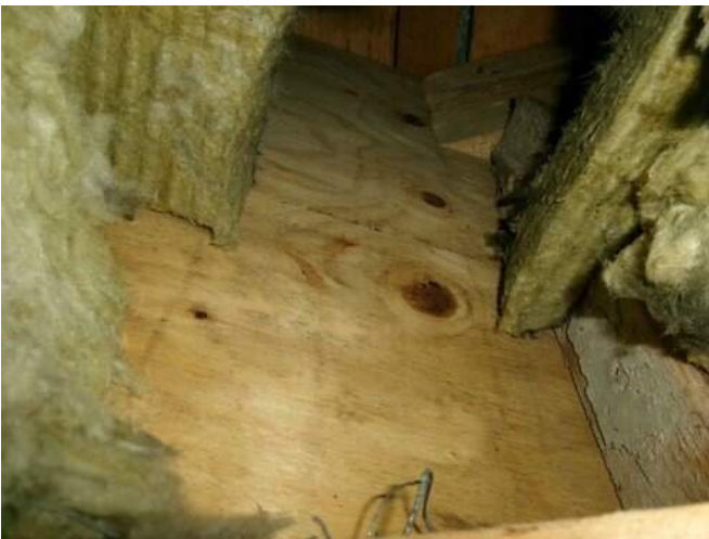
Kuva 32 Rakenteessa käytetty käytettyä puutavaraa ja puurakenteissa näkyvissä homepilkkuja.
