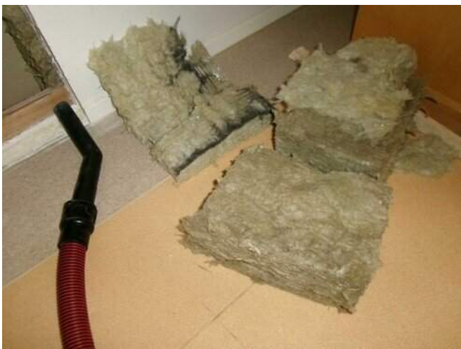
Kuva 42 Lämmöneristeessä paljon ilmavuodosta johtuvaa tummentumaa
