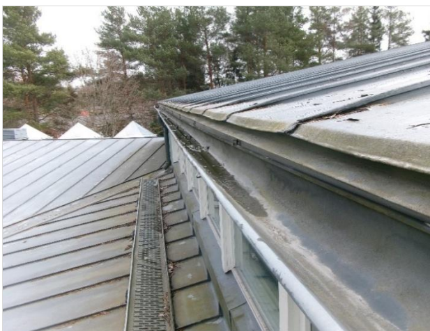
Kuva 72. Ilmanvaihtokonehuoneen sadevesikouru vääntynyt todennäköisimmin katolta alas tippuneen lumen ja jään voimasta.
