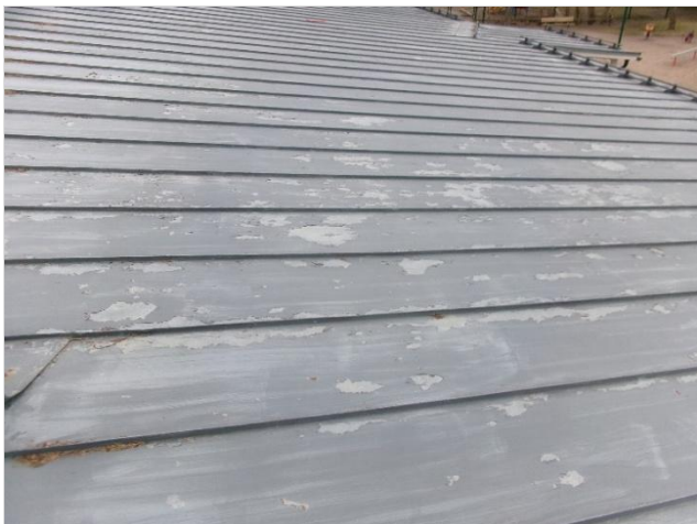
Kuva 62. Peltikatteen maalipinta on irronnut noin 15–25 % alueella.
