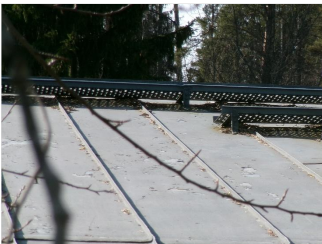
Kuva 60. Vesikaton kulkusillat on kiinnitetty suoraan peltikatteen läpi.
