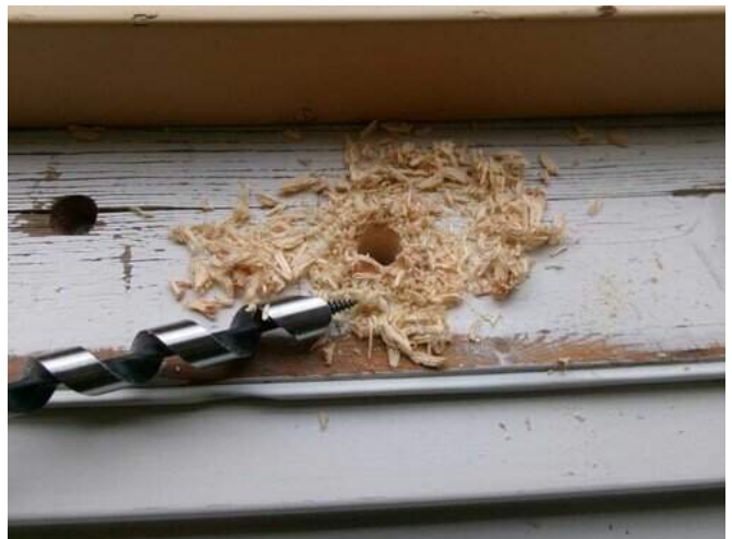
Kuva 51 Rakennusavauksesta havaittiin polyuretaanivaahdon tilkevälistä. Karmissa havaittavissa puun elämisestä johtuvaa halkeilua.
