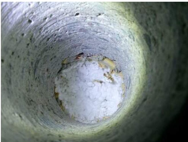
Kuva 46 Pintalaatan alapinnassa havaittiin kaapeli, joka meni timanttiporalla poikki.
