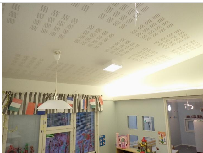
Kuva 55. Leikkihuoneessa 147 (MA6) merkkiaine kulkeutui yläpohjarakenteesta useasta eri kohdasta sisätiloihin: valaisimien läpivientikohdat, akustolevyjen välit, iv-kotelorakenteen läpivientikohdat.
