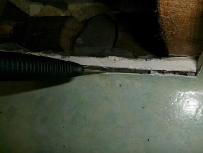
Kuva 16 Lattian ja kipsilevyn välistä havaittiin ilmavuotoa.
