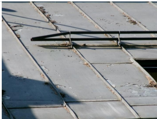
Kuva 63. Lumiesteet on kiinnitetty saumaan puristuskiinnikkeellä. Kuvassa myös näkyvillä maalipinnan hilseilyä.
