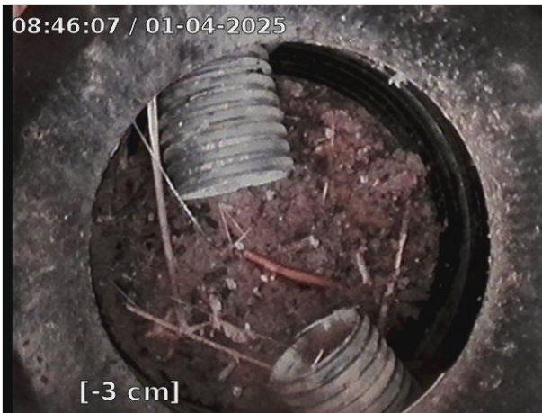
Kuva 9. Salaojakaivo 10 pohjalla hiekkaa, kiviä ja keppejä.
