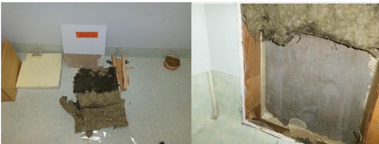
Kuva 36. Rakenneavaus RA7 tehtiin tilan 152 työtilan ulkoseinän alaosaan. Sokkelin-ulkoverhouksen liittymästä ilmapirta on päässyt liikkumaan eristeen ja betonisokkelin välissä ja liannut mineraalivillaeristeen. Mineraalivillaeristeestä otetussa mikrobinäytteessä M8 ei ollut mikrobikasvua. Alaohjauspuusta otetussa mikrobinäytteessä M9 oli mikrobikasvua.
