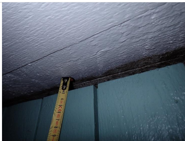
Kuva 33. Räystäs- ja seinärakenteen tuuletusrakoa oli alle 3 cm ja rakoa suojasi järeä jyr sijäverkko.
