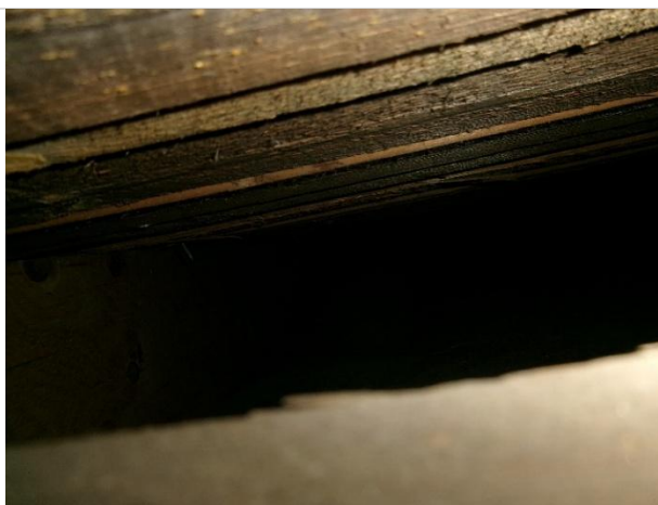
Kuva 71. Räystäällä noin 5 cm korkea ilmarako mistä puuttuu jyr sijäverkko.
