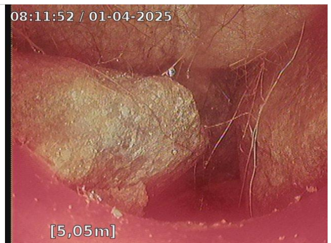
Kuva 12. Parkkipaikan puoleisen päädyn salaojakaivosta 1 lähtee purkulinja kivipesään.
