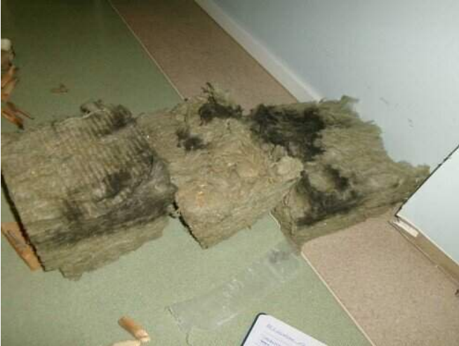
Kuva 7 Lämmöneristeessä paljon ilmapuodosta johtuvaa tummentumaa
