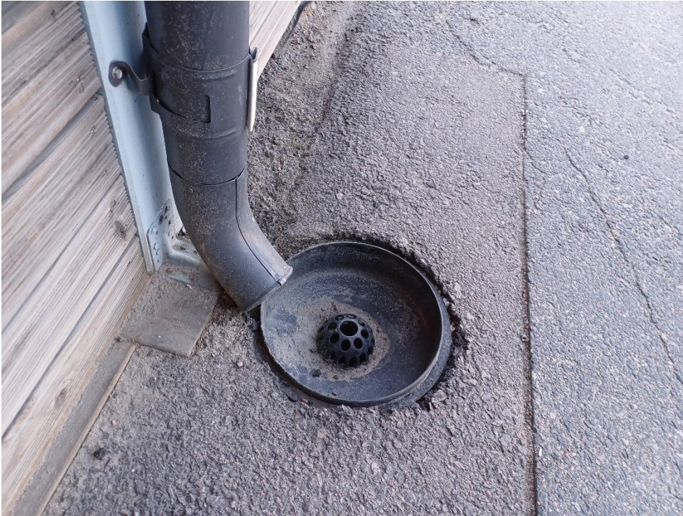
Kuva 4.8. Sadevesisyyöksen alakiinnike on painunut kasaan, eikä sadevesi enää ohjaudu kerääjäsuppilon.
