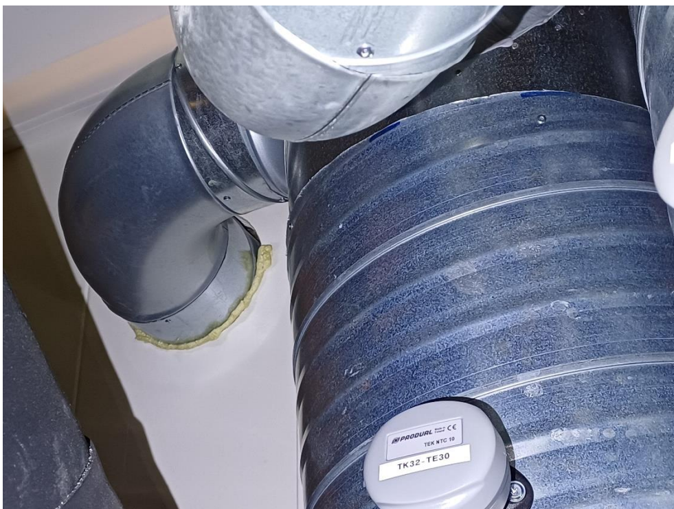
Kuva 4.5. 31 Tekninen tila, läpiviennit ympäröiviin tiloihin eivät ole tiiviitä.
