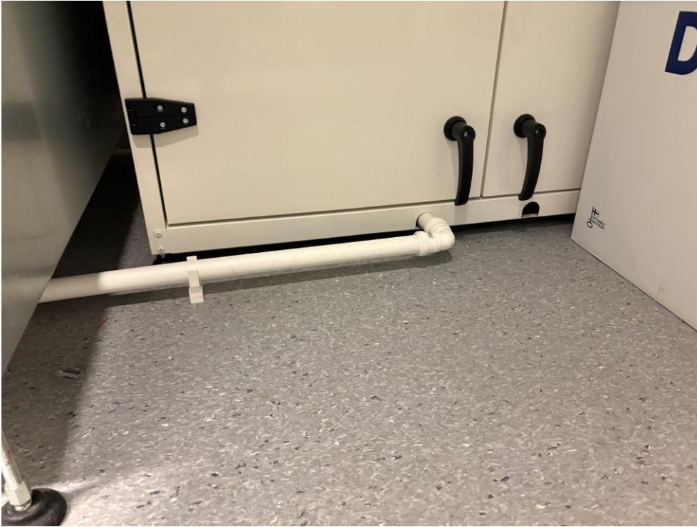
Kuva 5.4. TK32 ilmanvaihtokoneella ei ole viemäröinnin takaimusuojaa mikä estäisi viemärinhajujen kulkeutumisen ilmanvaihtokoneen sisälle, mikäli teknisen tilan lattiakaivosta nousisi viemärinhajua.
