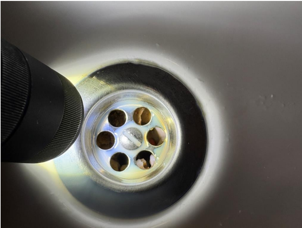
Kuva 5.2. Ryhmähuoneiden pesualtaiden viemärointeihin on kertynyt ruuantähteitä, mitkä maatuessaan aiheuttavat tunkkaista hajua tiloihin.
