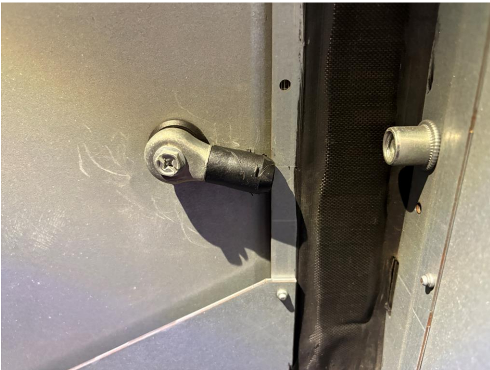
Kuva 5.3. Ilmanvaihtokoneen TK31 tuloilmapuhaltimen kammiossa ilmavuotoa. Ilmavuoto on koneen takaosassa. Seinää vasten olevan luukun salpa ei yletä pitämään ovea kiinni koneen sisäpuolella.
