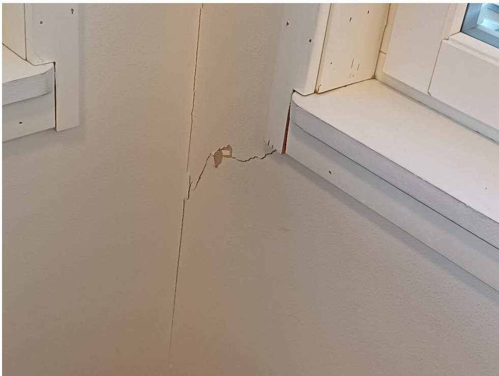
Kuva 4.6. Halkeamia sekä rakenneliittymien ratkeamia on runsaasti koko rakennuksessa.
