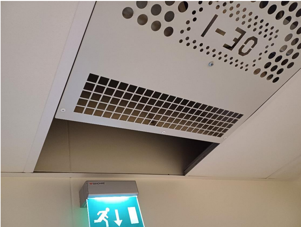
Kuva 4.2. 16 Kuraeteinen, alakatosta puuttuu akustointilevy.
