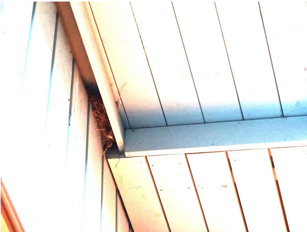
Kuva 4.9. Yläpohjan tuuletusraoista puuttuu pieneläinverkot, mistä syystä linnut ovat päässeet yläpohjaan rakentamaan useita pesiä.
