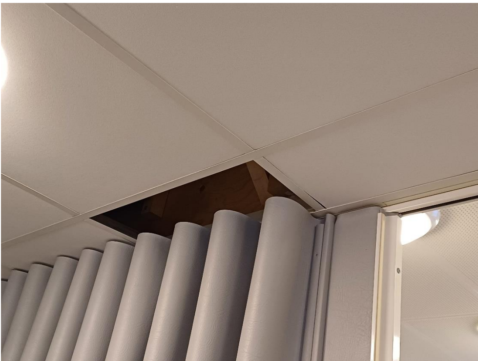
Kuva 4.1. 01 Lepuhuone, alakatosta puuttuu akustointilevy.
