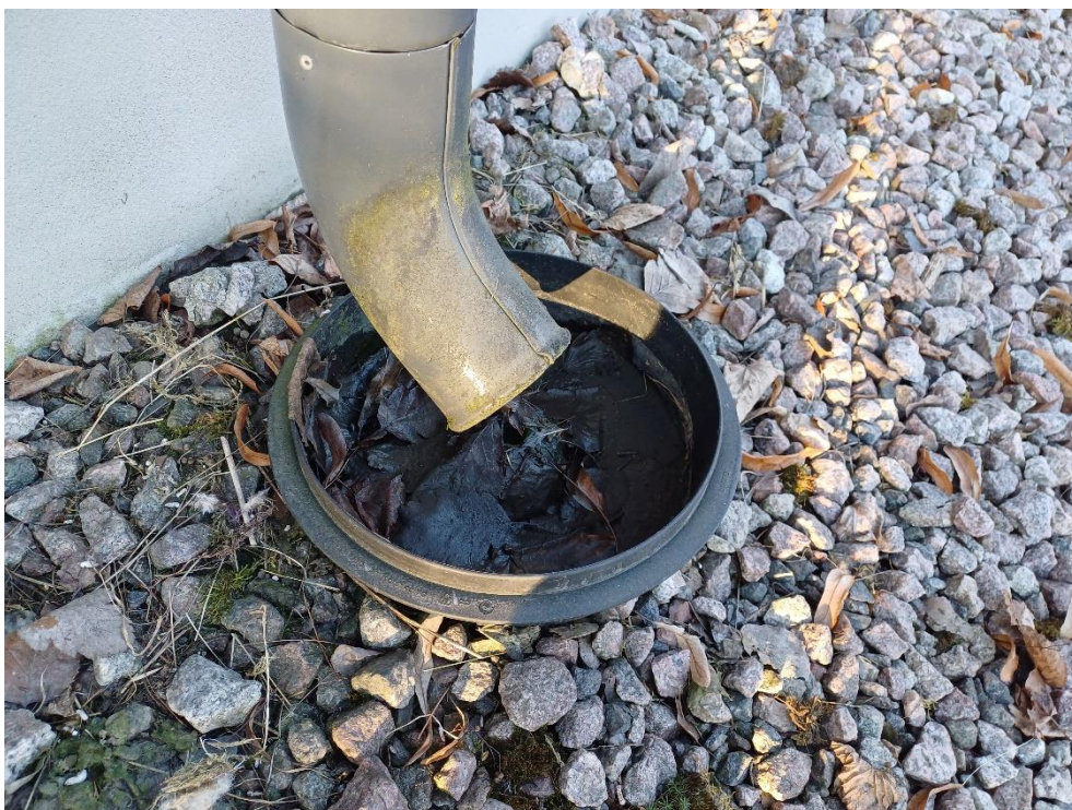
Kuva 4.7. Osa sadevesisyyöksyjen kerääjäsuppiloista oli tukkiutunut puiden lehdistä.
