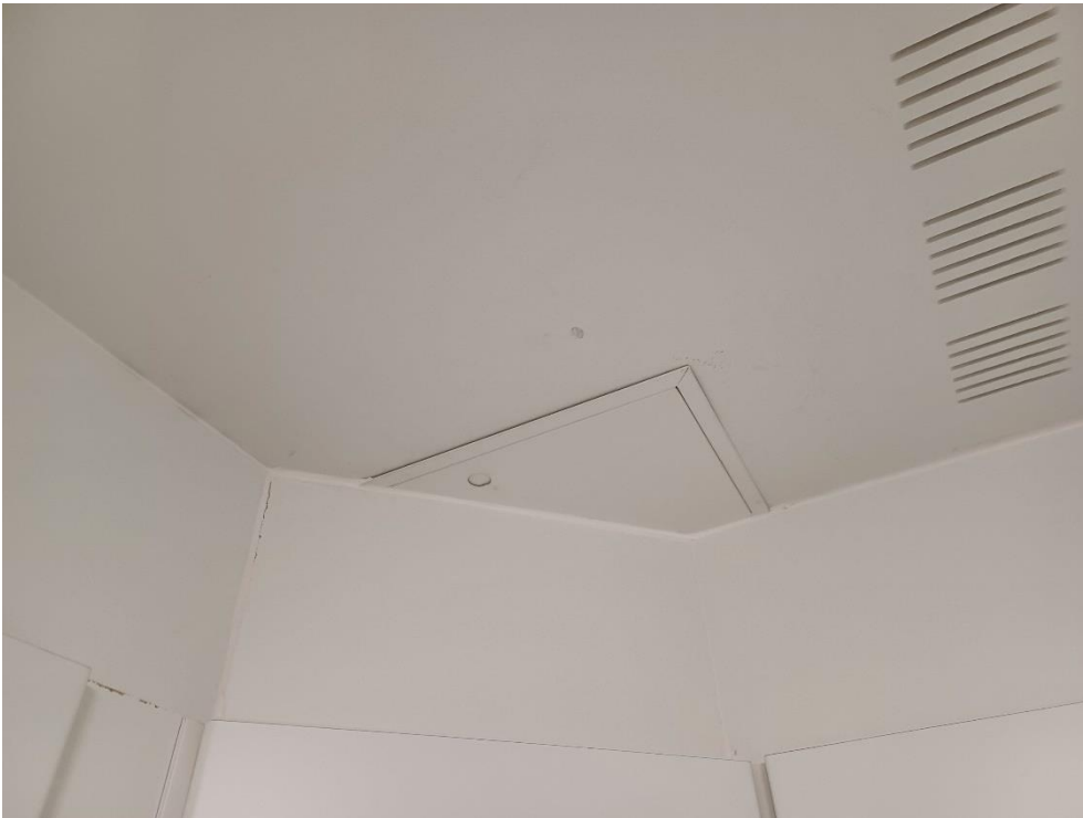
Kuva 4.5. 116 Keittiö, alakaton tarkistusluukku on jäänyt osittain seinälevytyksen alle.
