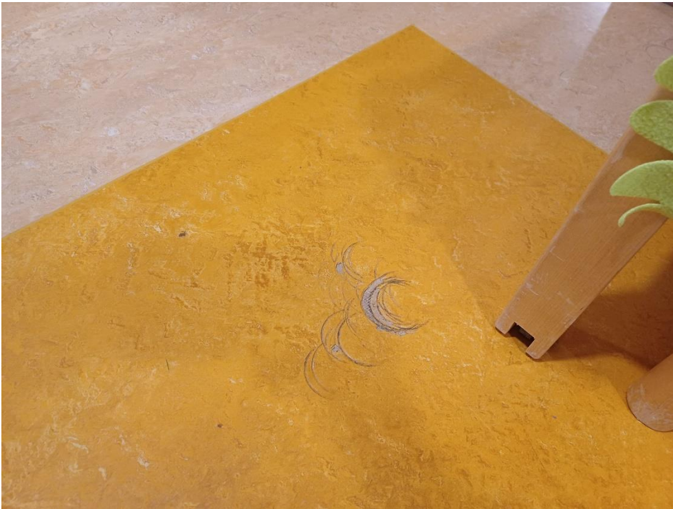
Kuva 4.13. 149 Lepohuone, lattiamatossa on pintavaurioita.
