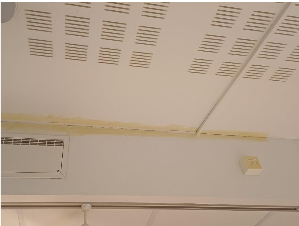
Kuva 4.14. Halkeamia ja rakenneliittymien ratkeamia havaittiin useissa tiloissa.
