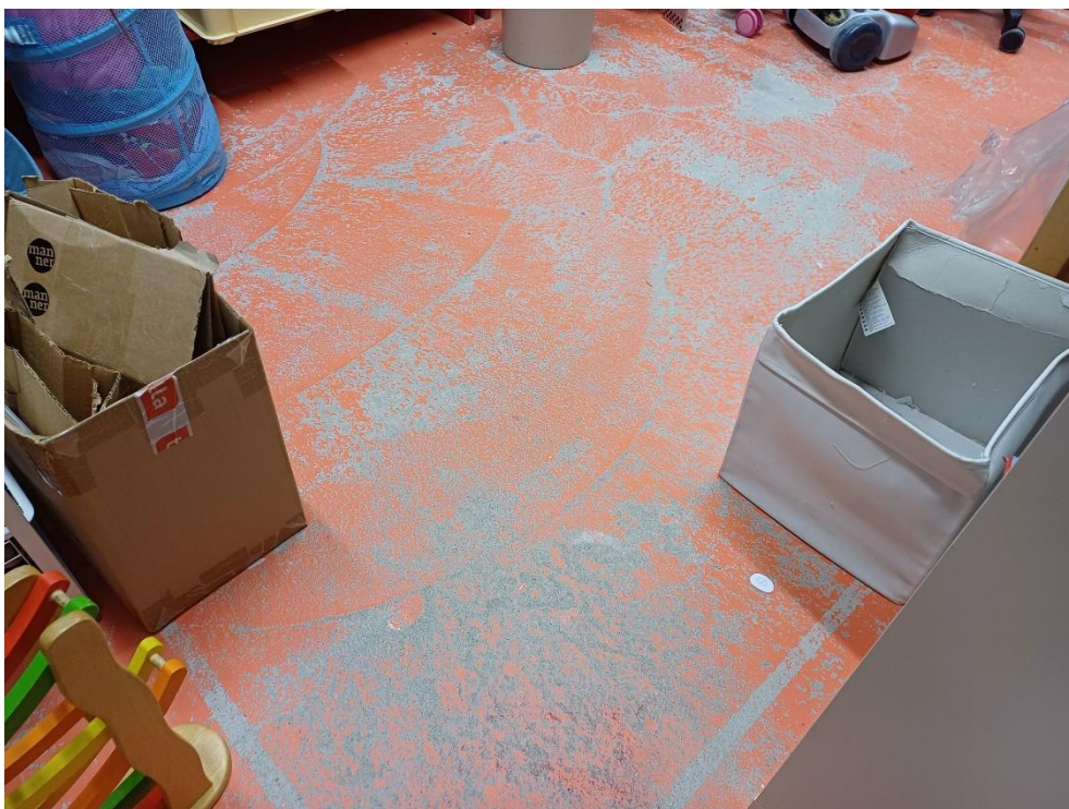
Kuva 4.2. 109 Leikkitila, lattiamaalaa irtoilee.
