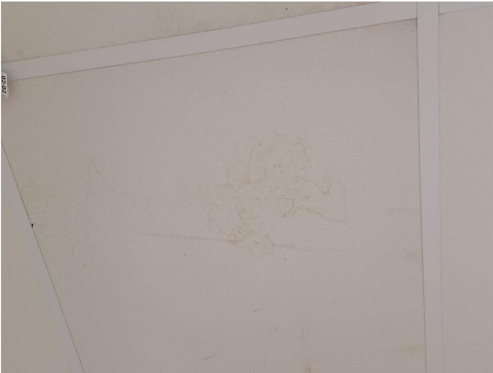
Kuva 4.3. 109 Leikkitila, alakaton akustointilevyissä on kosteusvauriojälkiä.
