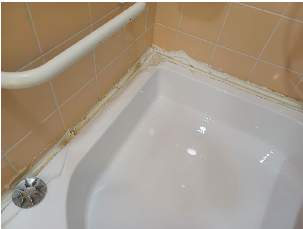
Kuva 4.1. 103 WC-tila, suihkutusaltaan silikonisaumauksen työnjälki on heikkoa.
