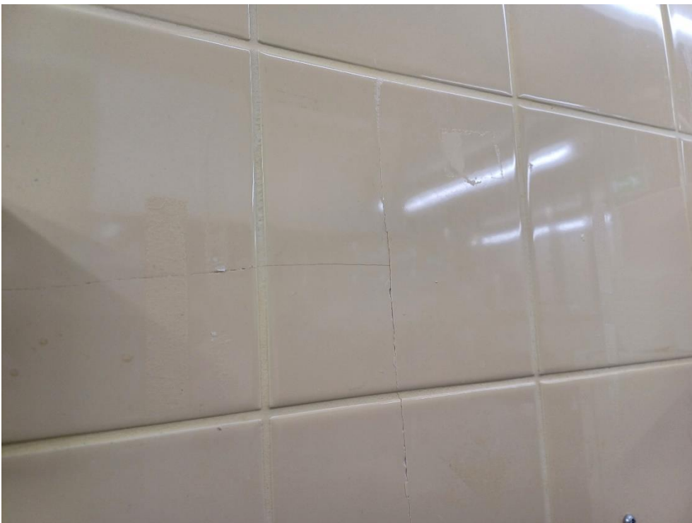
Kuva 4.4. 112 Keittiö, seinälaatoituksessa on halkeamia sekä laattasaumauksia aukeillut.
