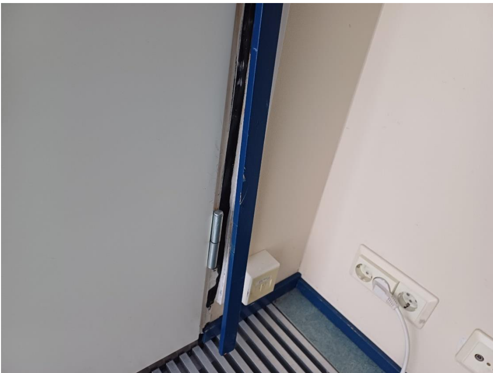
Kuva 4.6. 125 Monitoimitila, varauloskäynnin oven peitelista on osittain irti.
