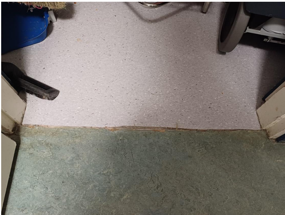
Kuva 4.7. 129 Siivouskomero, oviaukon muovikynnys puuttuu.
