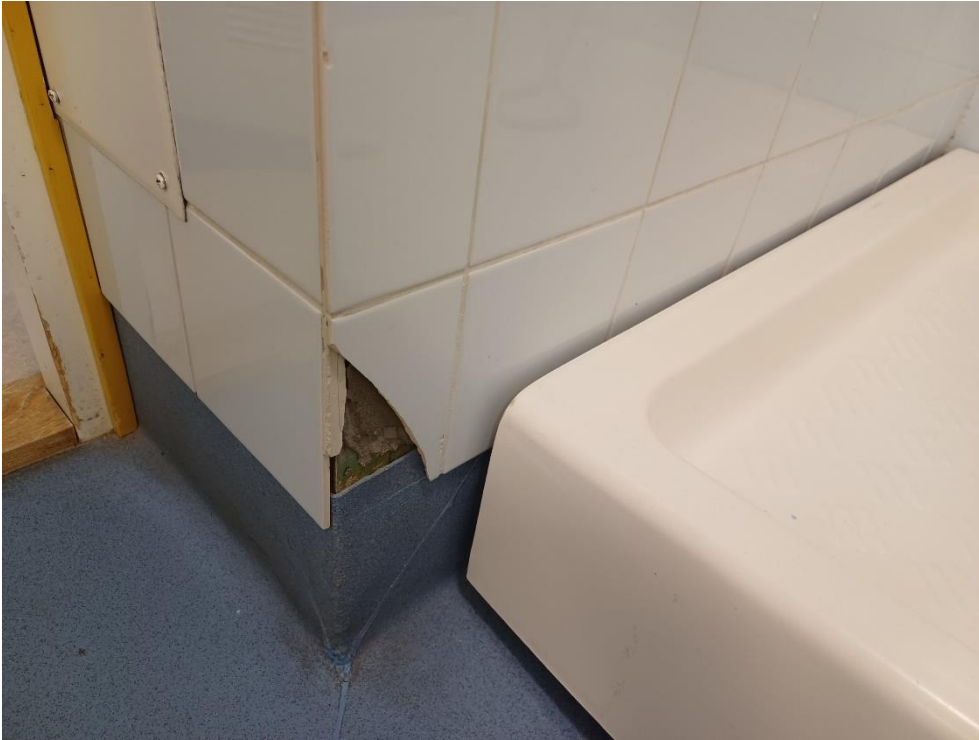
Kuva 4.9. 143 WC-tila, seinälaatoituksessa on vaurioita.
