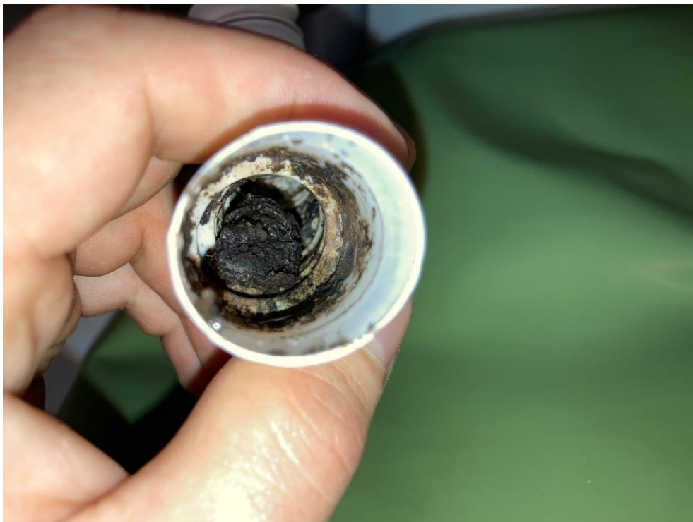
Kuva 5.1. Ryhmähuoneiden pesualtaiden ylivuotoputket ja viemärit keräävät lietettä, joka voi aiheuttaa tunkkaista hajua sisätiloihin.
