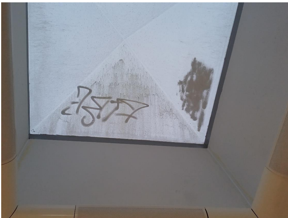
Kuva 4.8. 140 Aula, kattoikkuna on tuhrittu.
