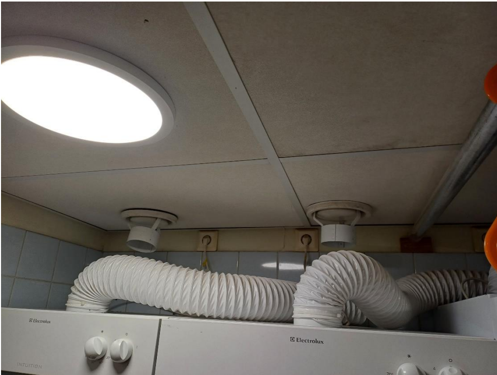
Kuva 4.11. 146 Eteinen, kuivauskaappien poistoilmaletkut ovat irti kiinnityksestään.
