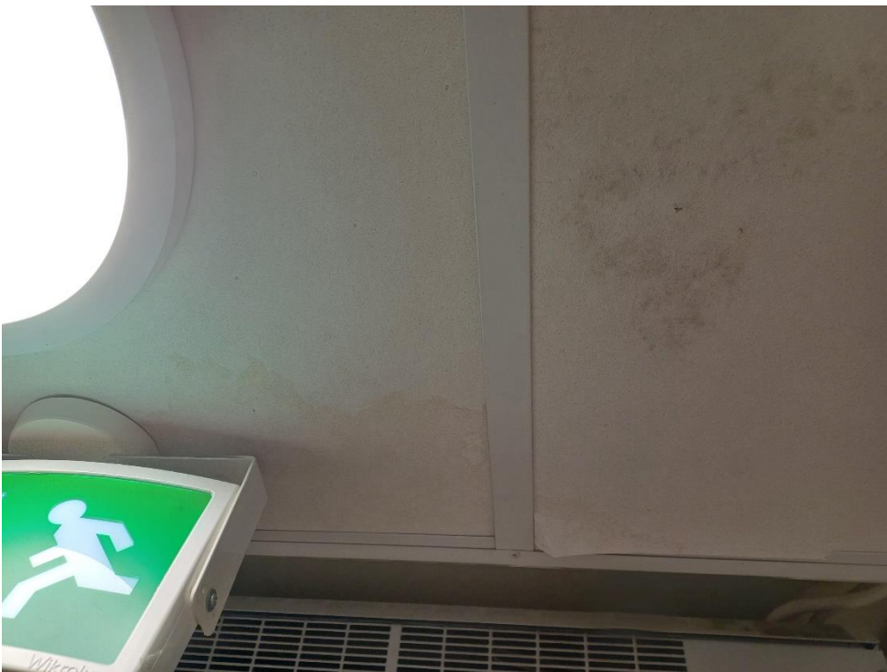
Kuva 4.10. 146 Eteinen, alakaton akustointilevyissä on kosteusvauriojälkiä.
