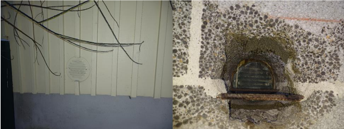
Kuva 4.11. Alapohjan korvausilmaventtiilit on asennettu julkisivun lautaverhoiluun.
