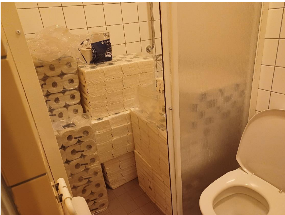
Kuva 4.2. 09 Suihkutila, täynnä tavaraa, eikä lattiakaivoa pääse täyttämään. Lattiakaivo aiheuttaa kuivuessaan viemärinhajua.
