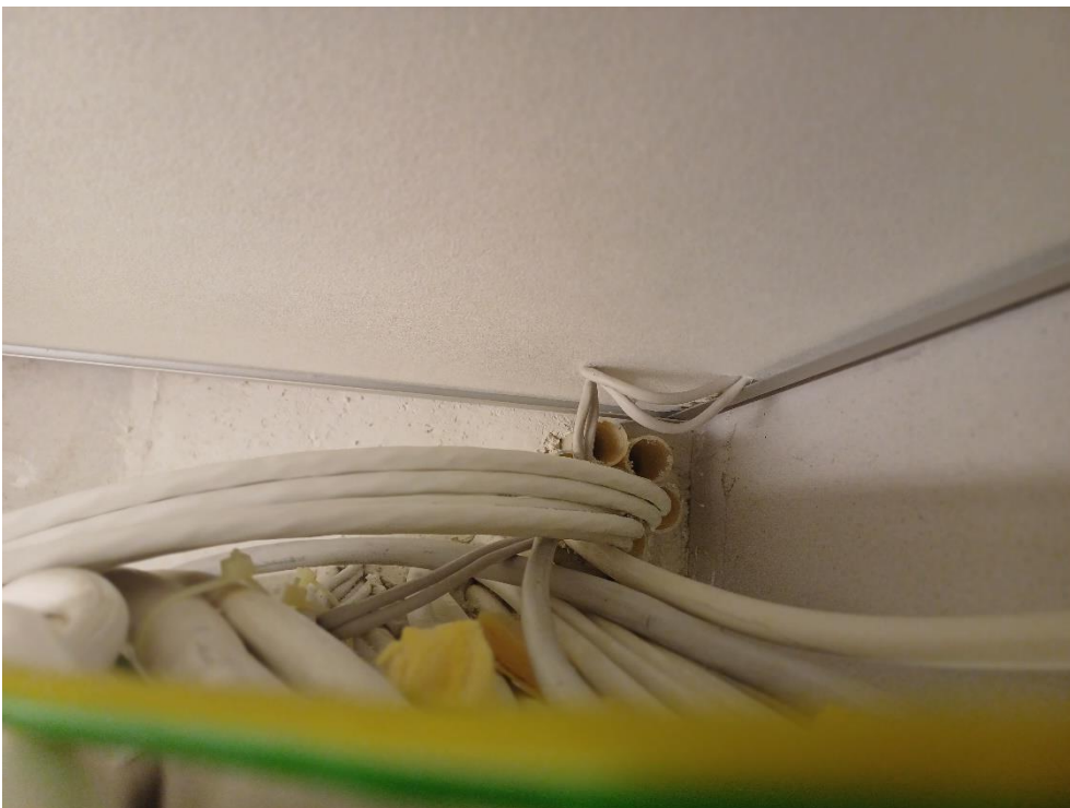
Kuva 4.6. 12 Sähköpääkeskus, rakenneliittymät ja läpiviennit eivät ole tiiviitä ympäröiviin tiloihin.
