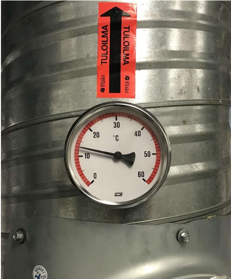
Kuva 6.1. Ilmanvaihtokoneen TK02 sisäänpuhallus lämpötila noin 13°C.
