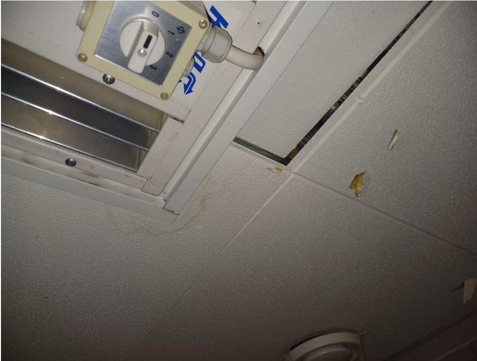
Kuva 4.7 19 Märkäeteinen, alakaton akustointilevyssä on kosteusvauriojälki.
