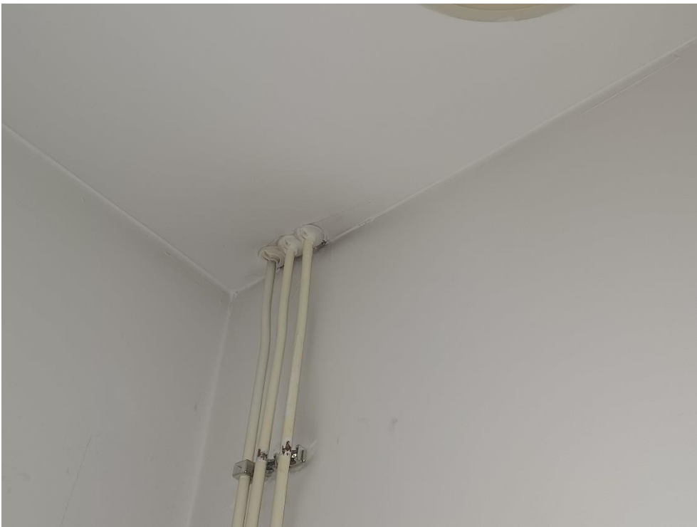
Kuva 4.4. 11 Siivouskeskus, vesijohtojen läpivienneissä on ilmavuotoja.
