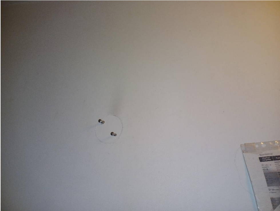
Kuva 4.3. 10 Siivouskomero, seinäpaikkauksen kohdassa, sekä vesijohtojen läpivienneissä on ilmavuotoja.
