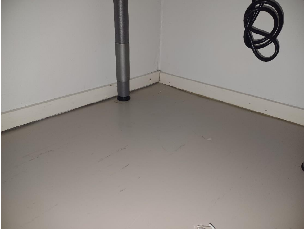
Kuva 4.1 07 Toimisto, lattia on painunut alaspäin.
