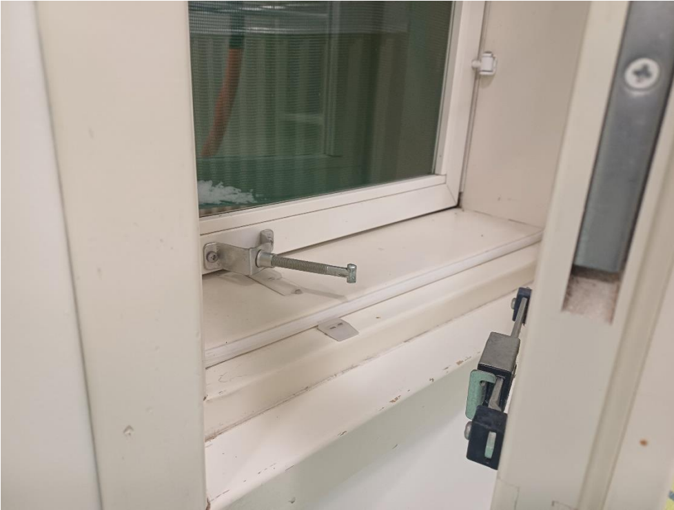
Kuva 4.9. Tuuletusikkunoiden aukipitolaitteita on irti tai rikkoutunut useissa tiloissa.
