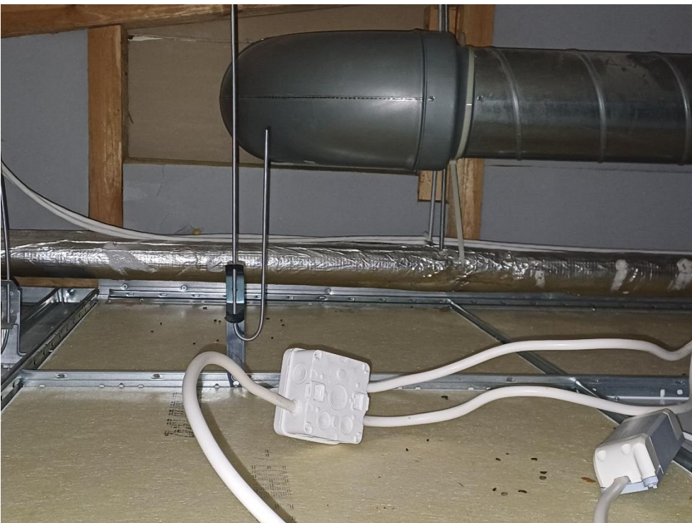
Kuva 4.10. Eteishallien ja käytävän alakattojen päällä on hiirenpapanoita.
