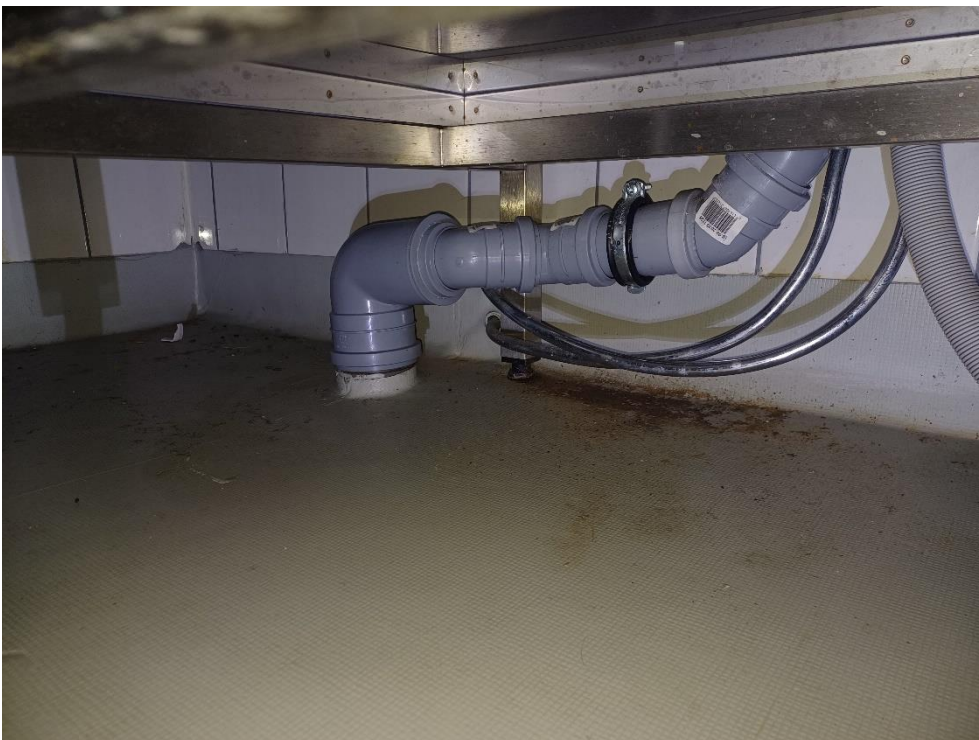
Kuva 4.8. 21 Jakelukeittiö, lattiamaton saumahitsauksia on auennut, keittiökaapistojen alapuolen siivous on puutteellista.
