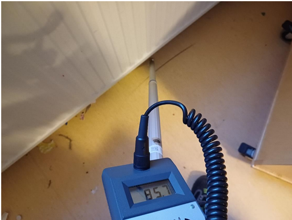
Kuva 4.1. 115 Päiväkerho, lattiasta mitattiin pintakosteudenosoittimella kohonneita vertailuarvoja ulkoseinän osalla.
