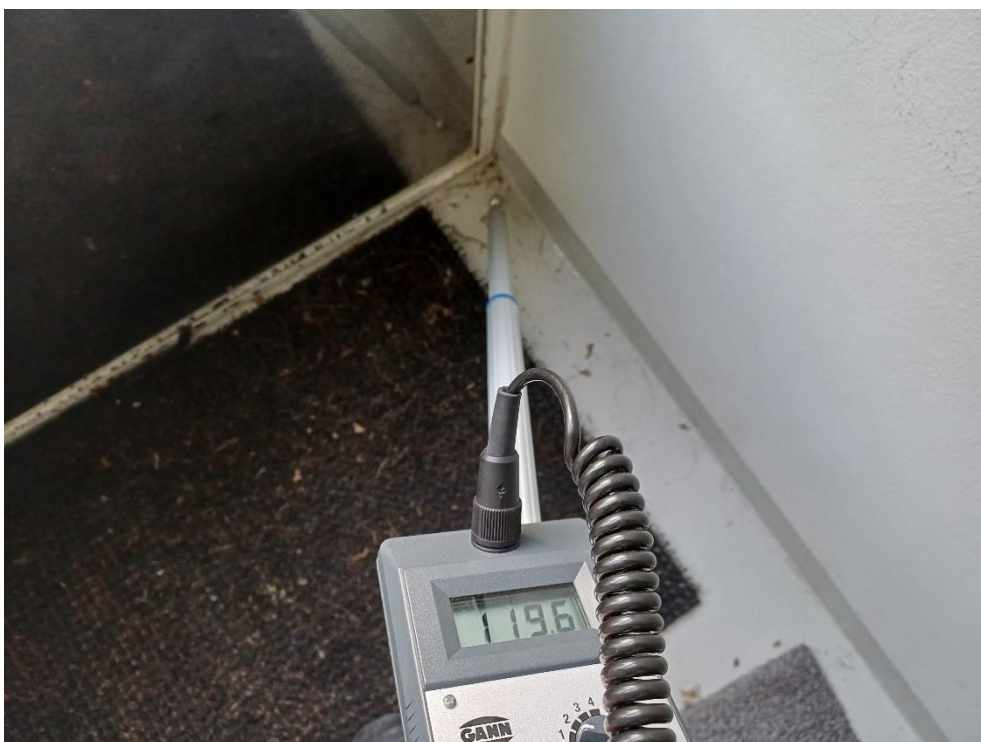
Kuva 4.2. 117 Tuulikaappi, lattiasta mitattiin pintakosteudenosoittimella kohonneita vertailuarvoja ulko-oven edustalla.
