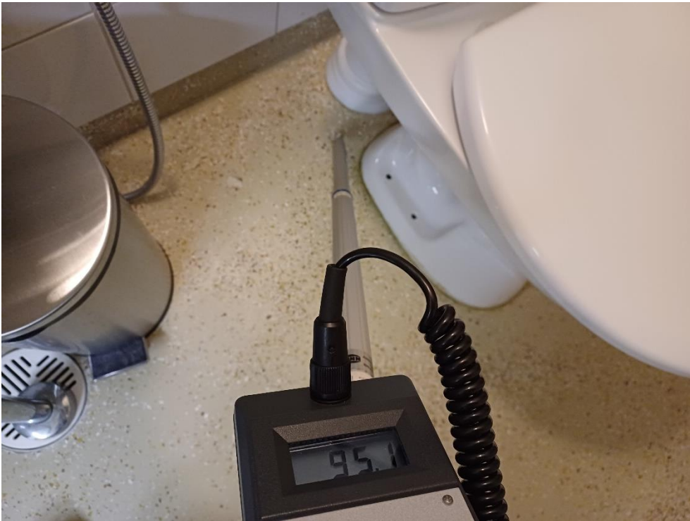
Kuva 4.3. 123 WC-tila, lattiasta mitattiin pintakosteudenosoittimella kohonneita vertailuarvoja lattiakaivon sekä wc-pöntön ympäristössä.
