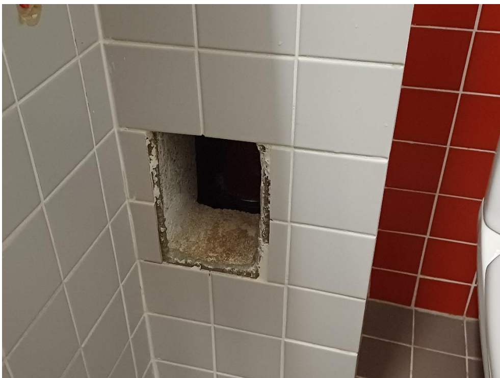
Kuva 4.3. A104 WC-tila, tekniikkakuiluun tehdyn tarkastusluukun kansi puuttuu.
