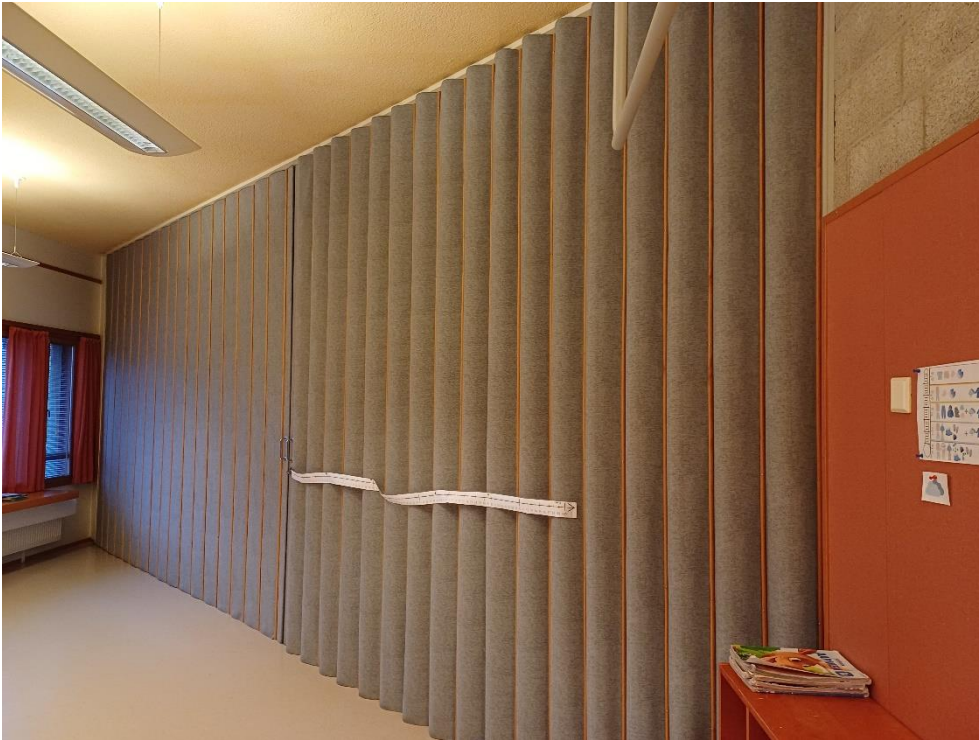
Kuva 4.6. A113 Luokka, tilanjakajana toimivasta vinyylipintaisesta paljeovesta tulee voimakasta hajua, joka saattaa heikentää sisäilman laatua.
