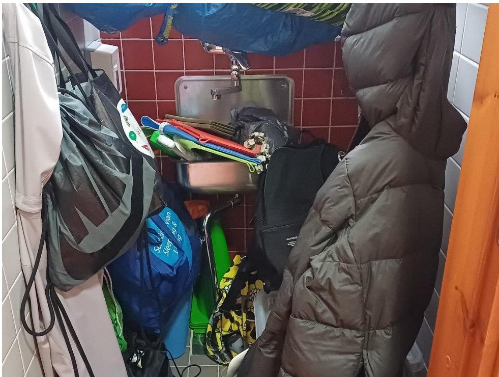
Kuva 4.4. A105 Siivouskomero, tilassa on ylimääräistä tavaraa, eikä tilassa olevaa lattiakaivoa pääse täyttämään vedellä, kaivon kautta voi viemärin hajua päästä ympäröiviin tiloihin.
