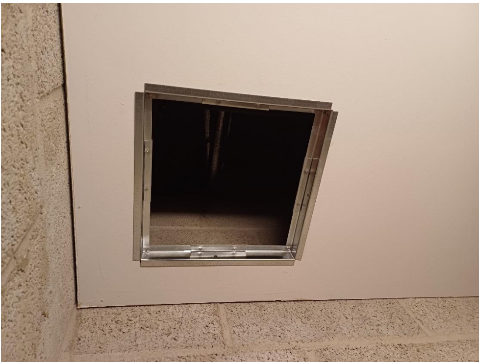
Kuva 4.1. A102 WC-tila, alakattoon asennetun tarkastusluukun kansi puuttuu.
