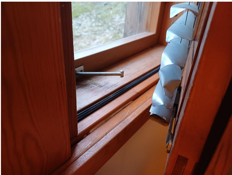
Kuva 4.9. Tuuletusikkunoiden aukipitolaitteita on rikki tai irti kiinnikkeistään useissa tiloissa.
