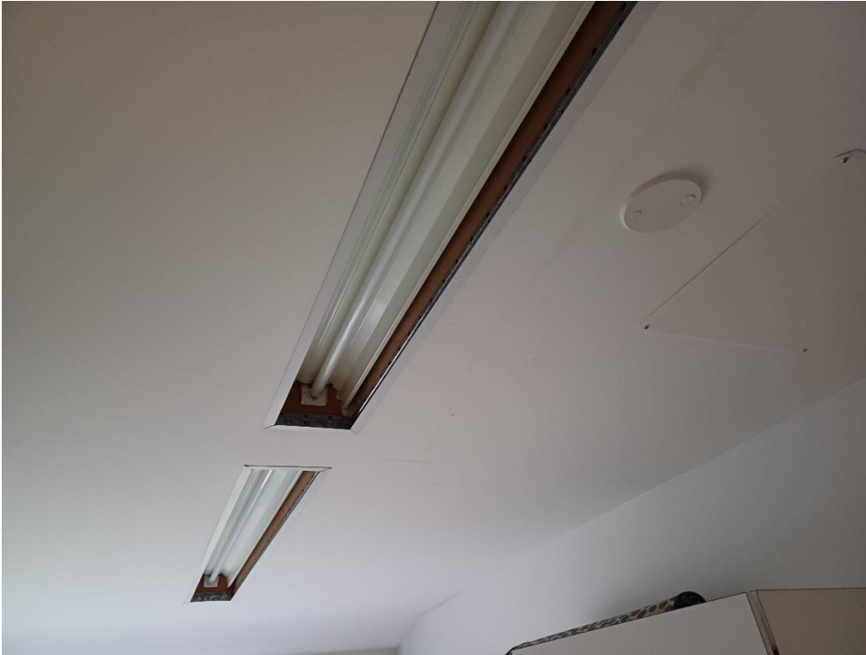
Kuva 4.4. 19 Työtila, alakattoon asennettujen valaisinten suojaritilät puuttuvat.
