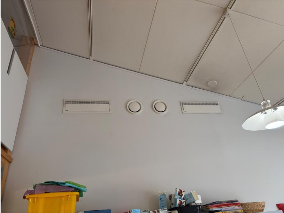
Kuva 5.1. Tulo- ja poistoilmapäätelaitteet on sijoitettu lähekkäin, ja tuloilma suunnataan suoraan kattoon. Tämä voi aiheuttaa sen, että poistoilma vetää osan tuloilmasta takaisin, heikentäen ilmanvaihdon tehokkuutta.
