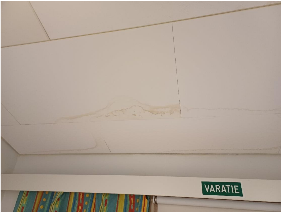
Kuva 4.2. 14 Lepohuone, alakaton levytyksessä on kosteusvauriojälkiä.
