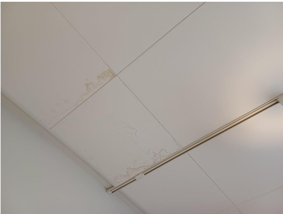
Kuva 4.5. 25 Leikkitila, alakaton levytyksessä on kosteusvauriojälkiä.
