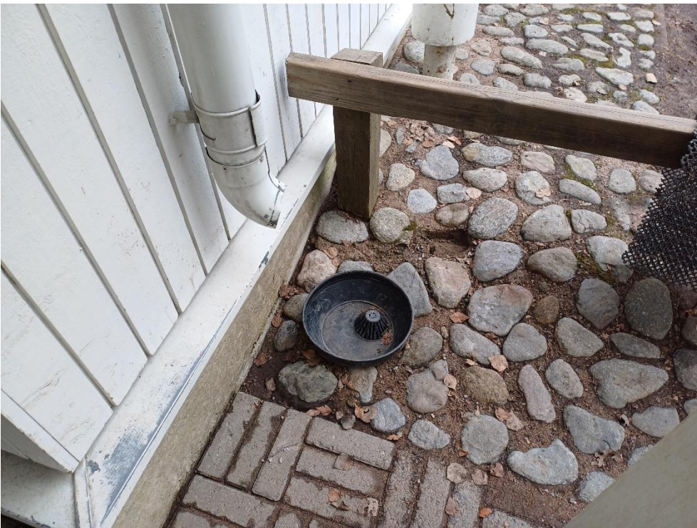
Kuva 4.19. Sadevesisyöksyistä puuttuu paikoin osia, eikä sadevesi ohjaudu keräyssuppiloon.
