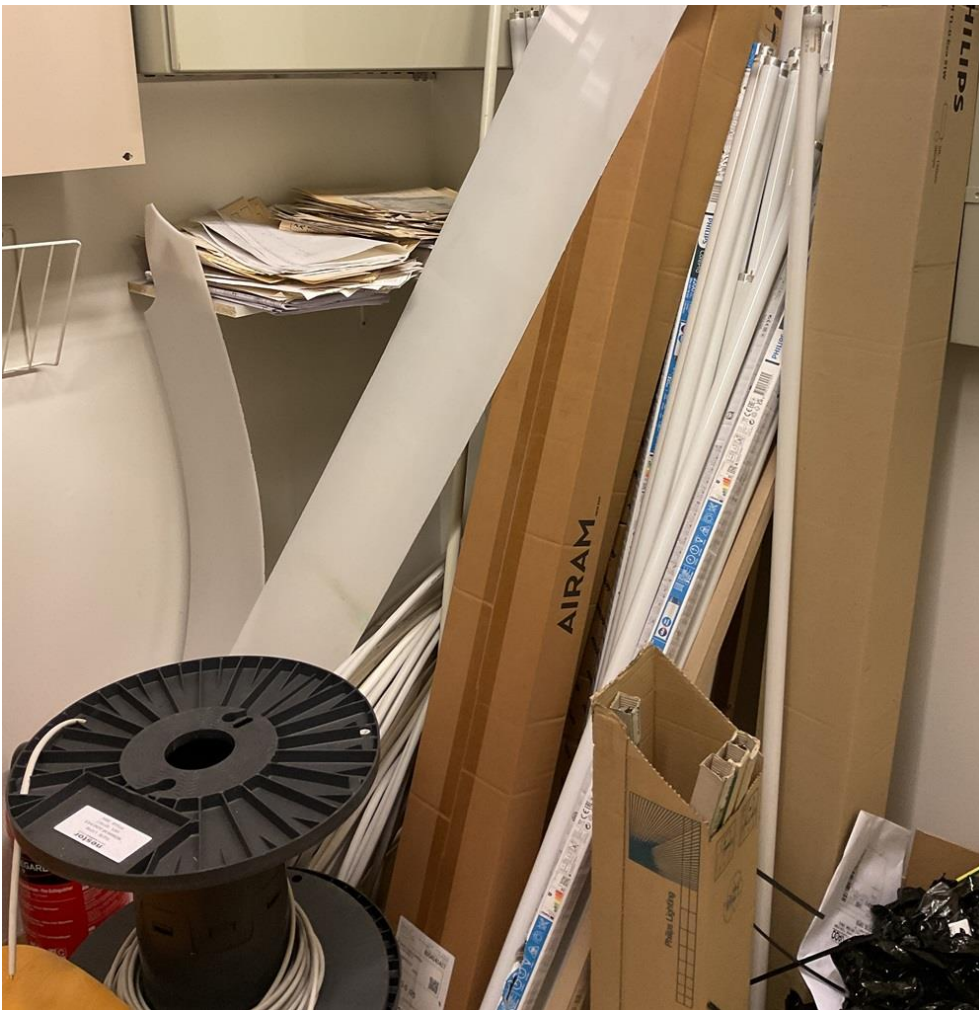
Kuva 6.4. Sähköpääkeskuksessa on paljon ylimääräistä tavaraa, paloturvavariski.
