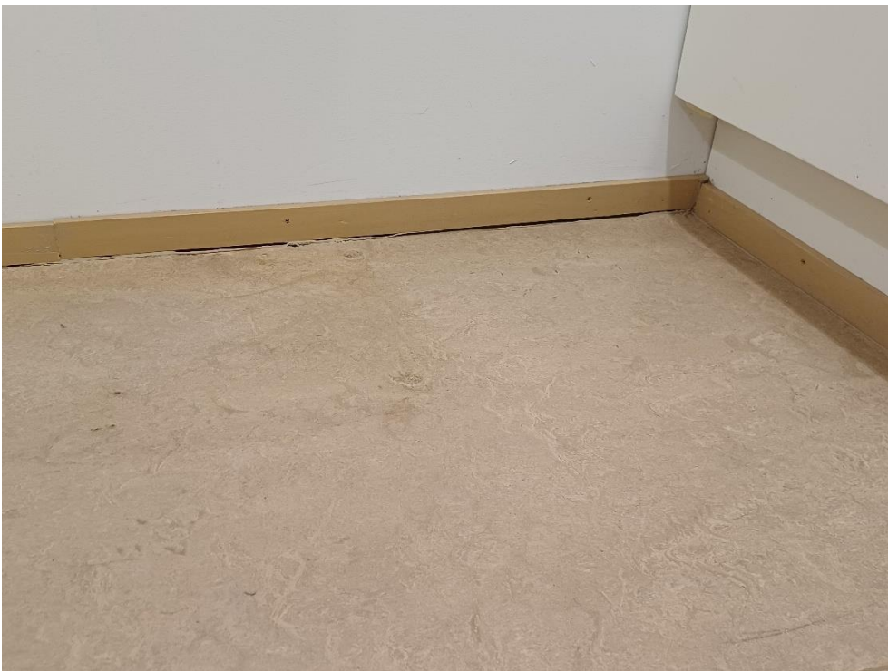
Kuva 4.7. 34 Toimisto, lattia on osittain painunut alaspäin.
