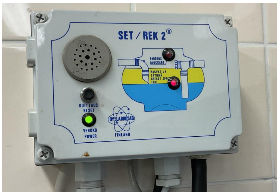
Kuva 6.2. Rasvaerotuskaivo on täynnä.
