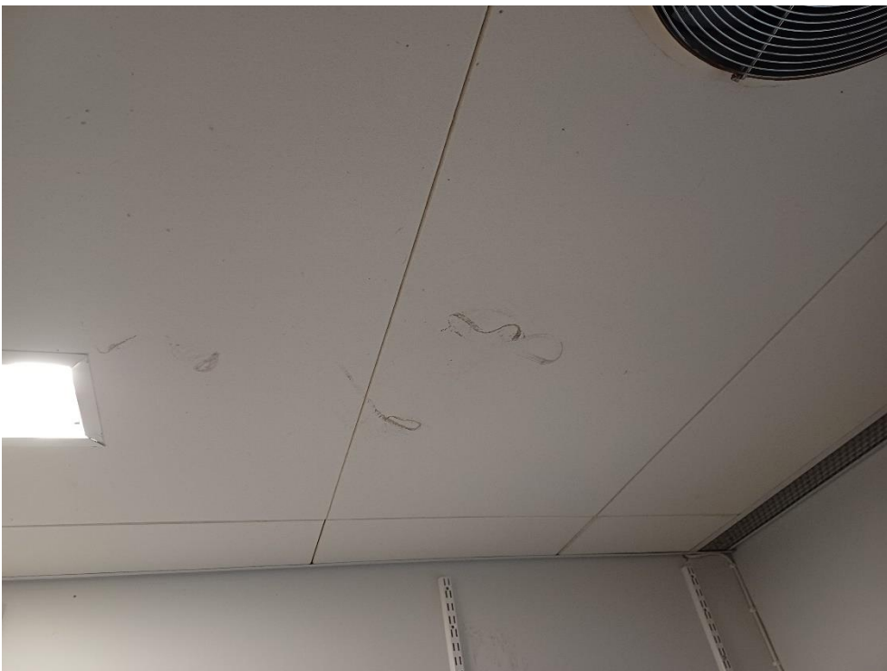
Kuva 4.11. 65 Käytävä, alakaton levyjä on likaantunut.
