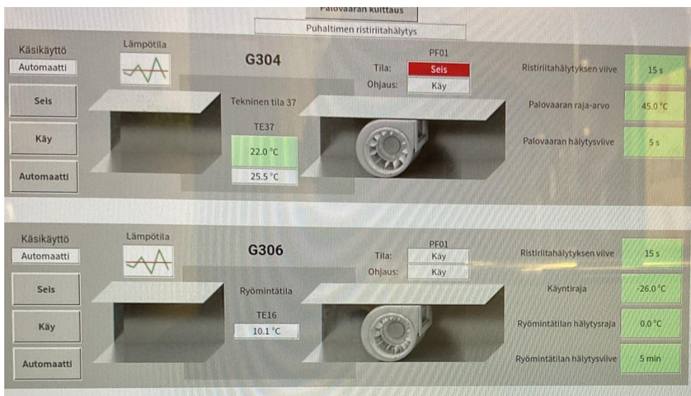
Kuva 6.1. Teknisentilan poistoilmapuhallin PK304 on seis, vaikka ohjaus on käy asennossa.
