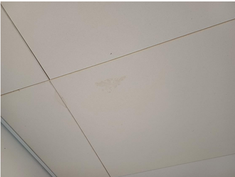
Kuva 4.9. 52 Kuraeteinen, alakaton levytyksessä on kosteusvauriojälki.
