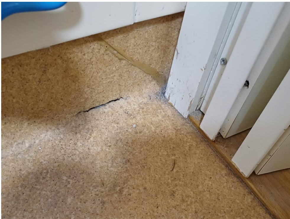
Kuva 4.12. 1 Ryhmäperhepäiväkoti Tuohiset, pesuhuoneen lattiamatossa on halkeamia.
