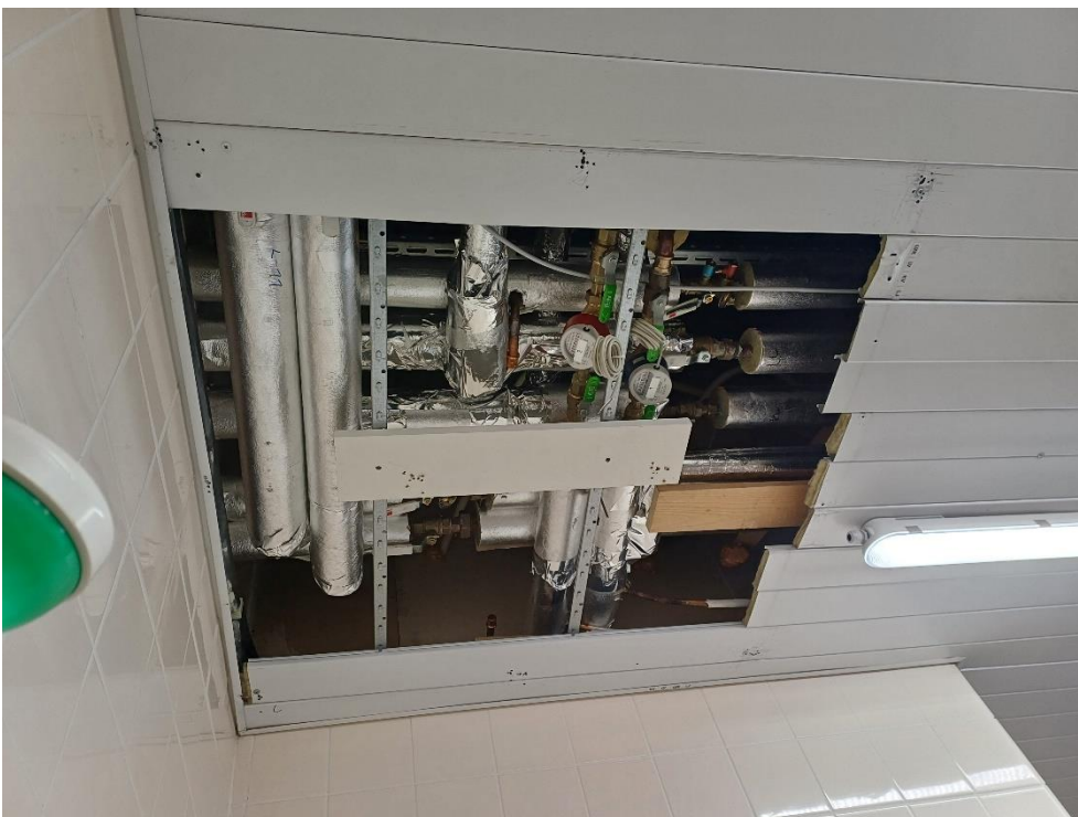
Kuva 4.1. 11 Keittiö, alakatosta puuttuu tarkastusluukun kansipelti
