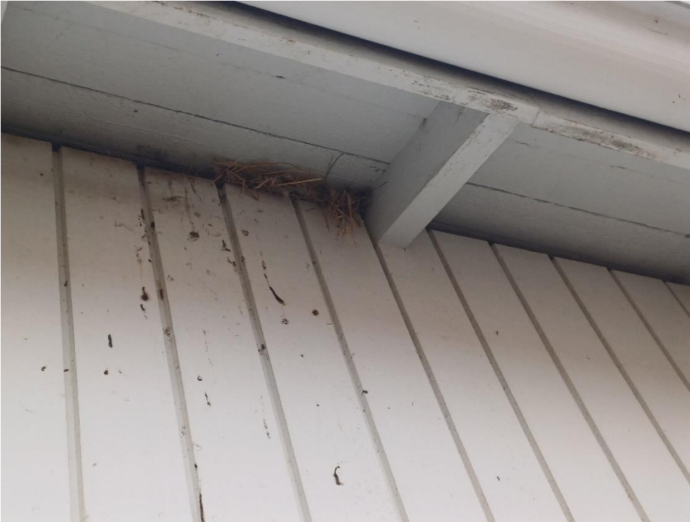
Kuva 4.18. Yläpohjan tuuletusrakojen pieneläinverkoissa on paikoin puutteita mm. linnunpesä.
