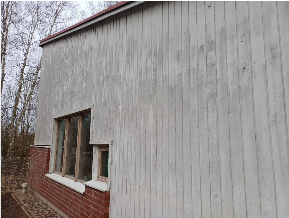
Kuva 4.17. Julkisivun puupinnat tarvitsevat kauttaaltaan huoltokunnostusta.
