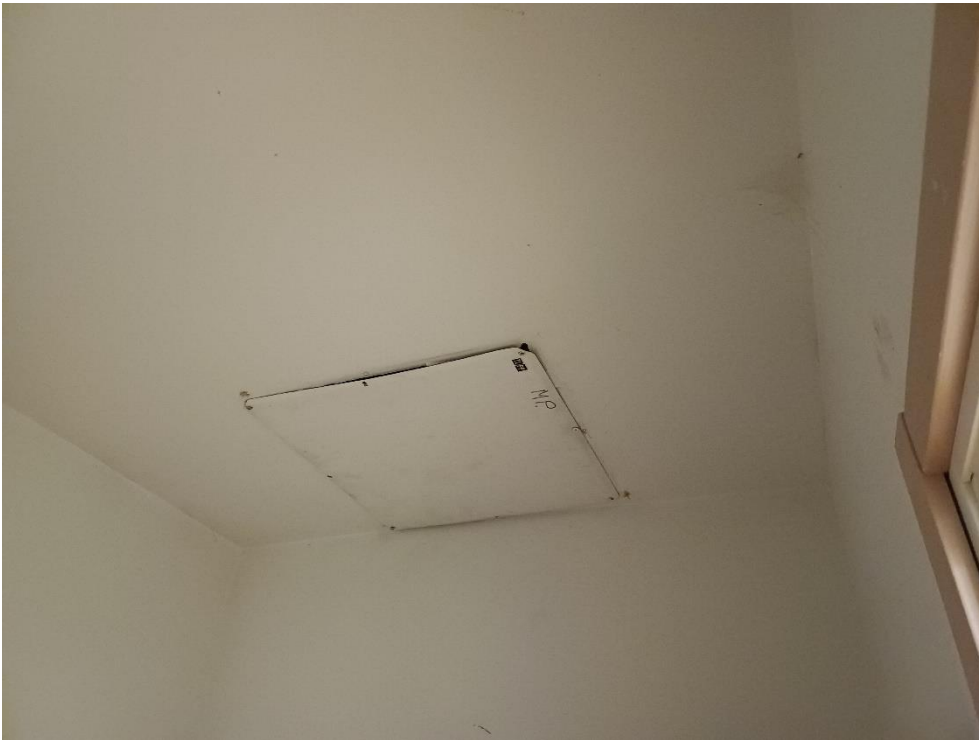
Kuva 4.6. 33 Siivouskeskus, alakaton tarkistusluukun kiinnitys ei ole tiivis.
