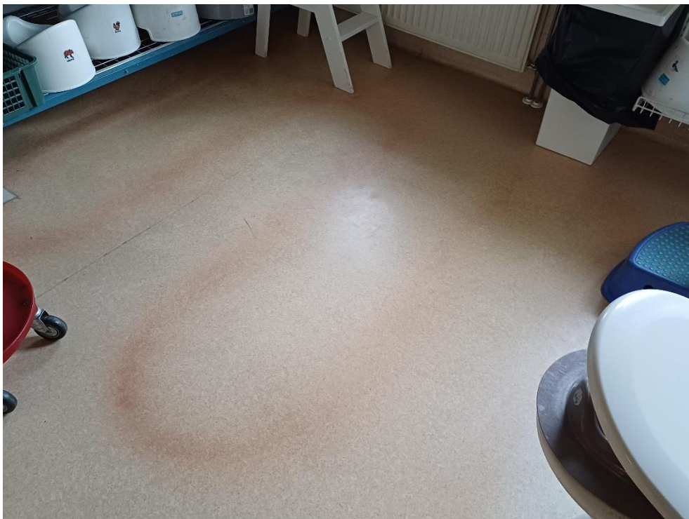
Kuva 4.14. Märkätiloissa, joissa käytetään lattialämmitystä, on lattiapinnoitteessa lämmitysjärjestelmän aiheuttamia jälkiä.
