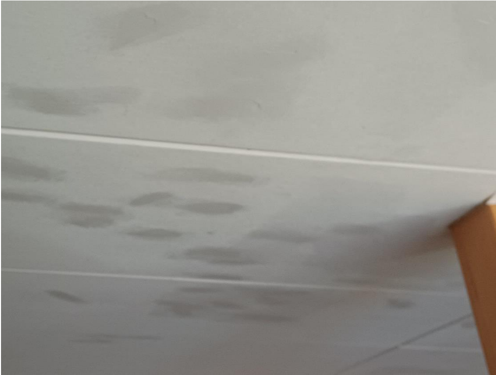
Kuva 4.10. 55 Leikkihuone, parven alakattolevyjä on paikkamaalattu.
