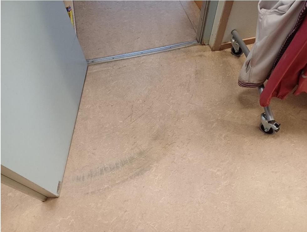
Kuva 4.16. Lattiapinnat ovat pääosin alkuperäisiä ja yleisesti kuluneita koko rakennuksessa.
