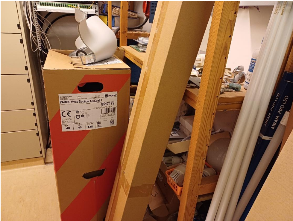
Kuva 4.8. 38 Sähköpääkeskus, tilassa säilytetään paljon ylimääräistä tavaraa.
