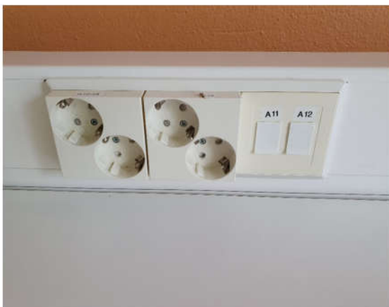
Koulun uusittuja sähkökalusteita.
