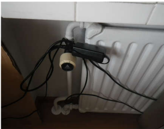
Pattereissa oli termostaattiventtiilit.
