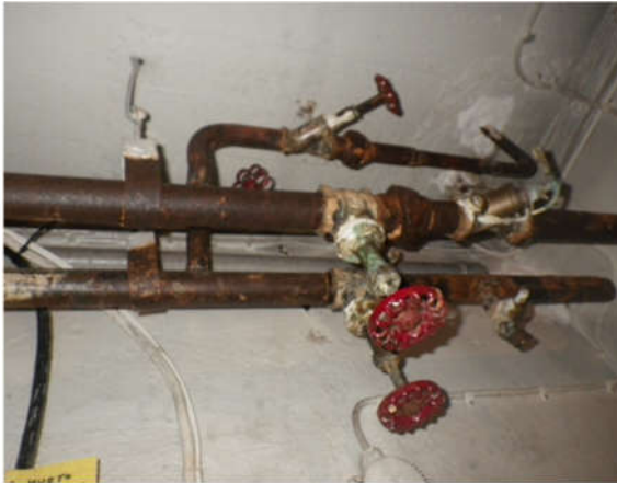
Lämmitysverkoston huonokuntoisia sulkuja.
