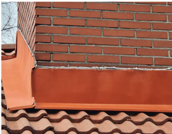
Pellityksen liitos vaikuttaa epätiiviiltä.
