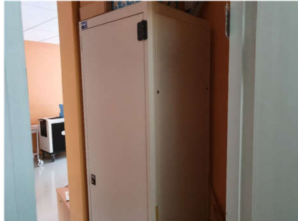
Pääkoulun lukittu telekaappi.
