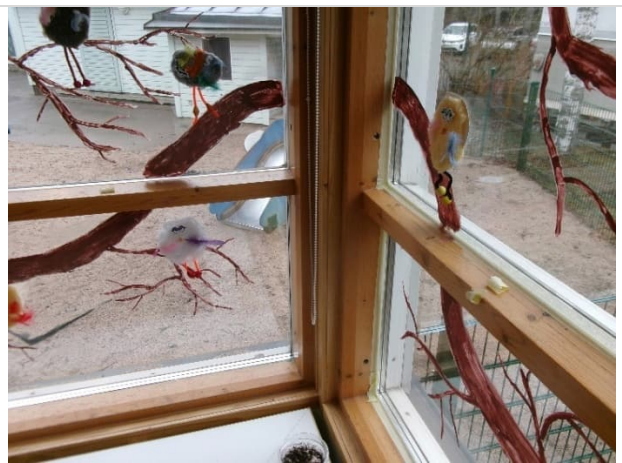
Kuva 35. Lämpölasikkunoita teipattu ja lämpökuvauksessa havaittiin ilmavuotoa lasin ja karmin välistä.
