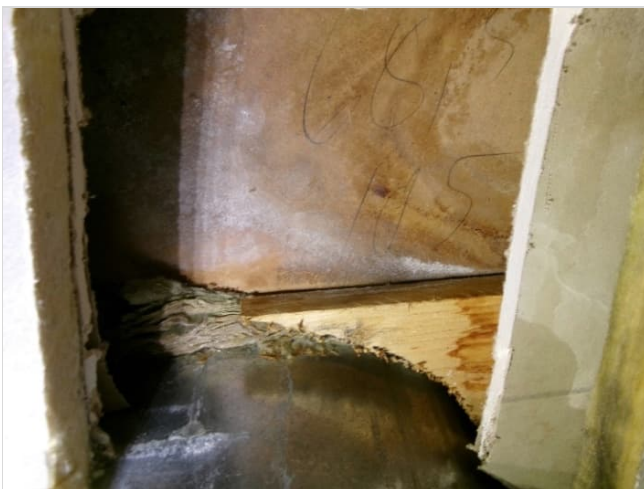
Kuva 61. RA3 avauksessa havaittiin aistinvaraisesti puukuitulevyn sisäpinnassa kosteusvaurio.
