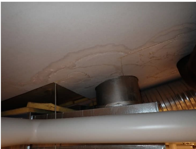
Kuva 59. Ilmanvaihtokonehuoneessa havaittiin vanhoja vesivuotojalkia jäteilmakanavien yläpohjan läpivientien ympärillä.
