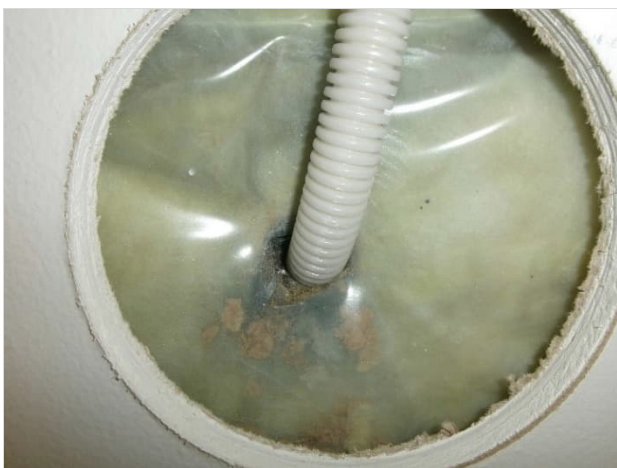
Kuva 44. RA7 ulkovaalaisimen johdotuksen läpiviennin tiivistämättä höyrysulkuun.
