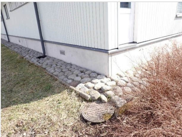
Kuva 34. Maanpinta kallistuu pois päin rakennuksesta.
