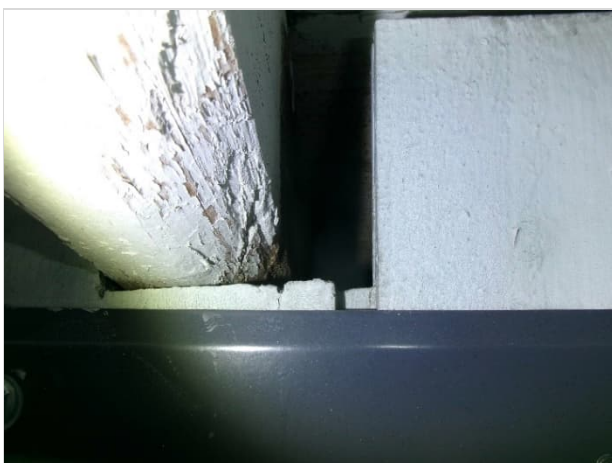
Kuva 79. Raitisilmasäleikön kohdalla kattorakenteessa isoja rakoja, mistä puuttuu pieneläinverkko.
