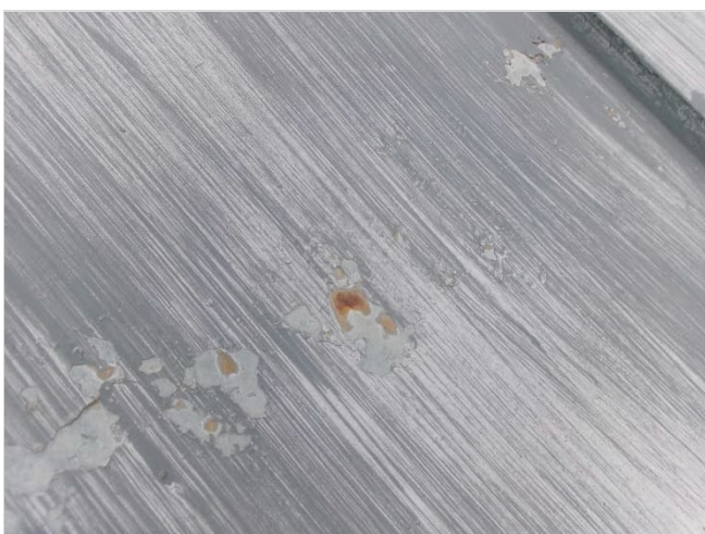
Kuva 75. Lähikuvaa peltikatteen korroosiosta.
