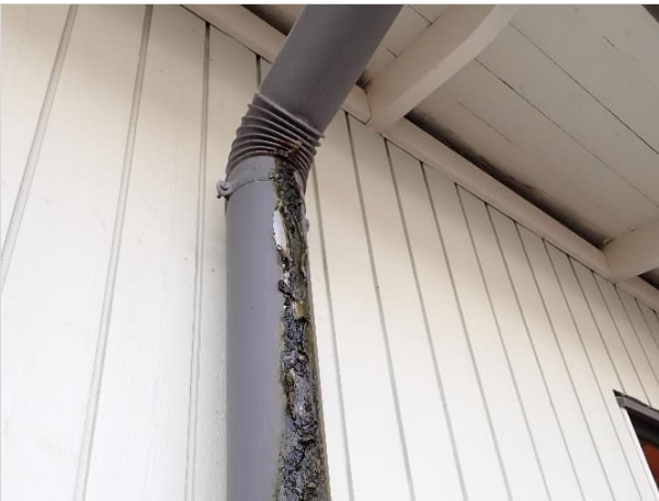
Kuva 38. Syöksyputkissa ja sadevesikouruissa korroosion aiheuttamia vesivuotoja.
