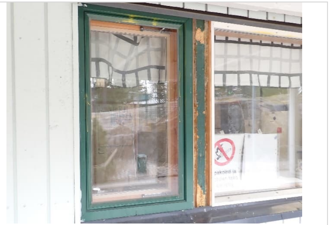
Kuva 27. Keittiön kohdalla ikkunoiden välistä irronnut vuorilauta.
