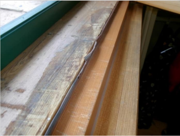
Kuva 36. Ikkunoiden tiivisteitä rispaantunut rikki.
