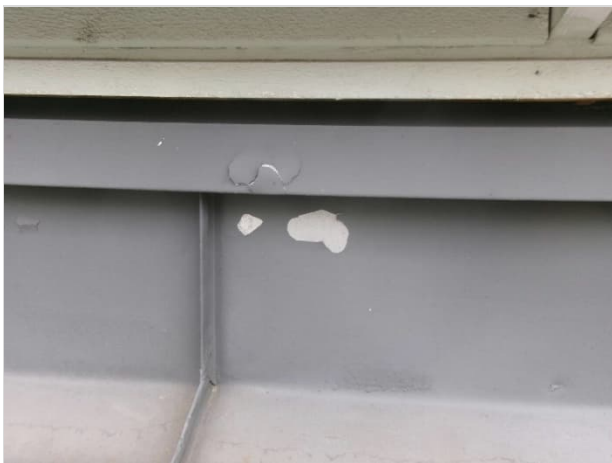
Kuva 77. Maalipinta on hilseillyt ja irronnut. Tuuletusraosta ei havaittu pieneläinverkkoa.
