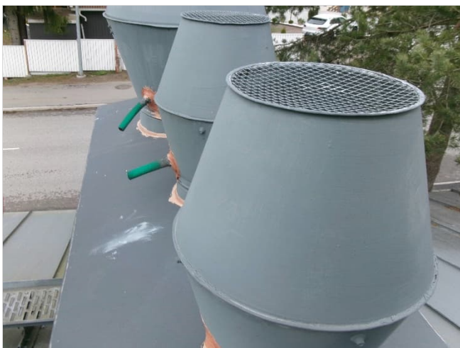
Kuva 73. Jäteilman ulospuhallushajottimiin ja laatikkoon on tehty tiivistyskorjauksia.
