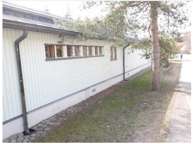
Kuva 33. Kadun puolella julkisivu hyvässä kunnossa. Vuotava syöksytorvi kastelee ulkoseinää.
