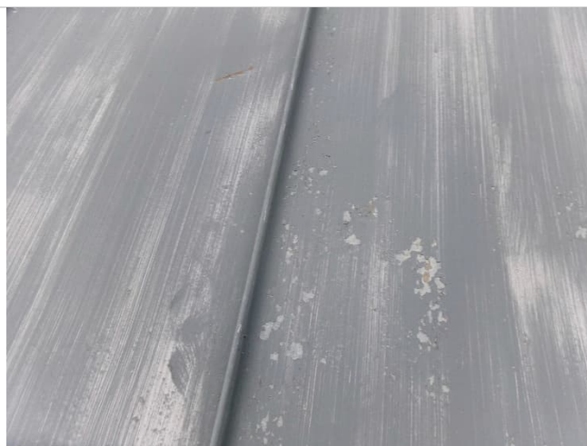
Kuva 74. Peltikatteessa oli jonkin verran pistemäistä korroosiota.
