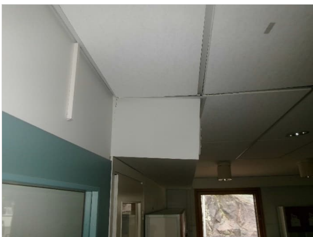
Kuva 67. Tilassa käytävä 19 kotelo on osin irronnut kiinnityksistä ja roikkuu. Kuvassa näkyvillä alaslaskettu katto avattavin villalevytyksin.
