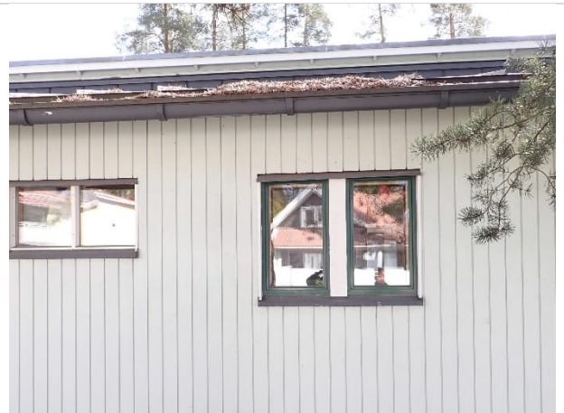
Kuva 39. Tienpuoleinen sadevesikouru tukkeutunut karikkeesta pesuhuoneen 15 kohdalla.
