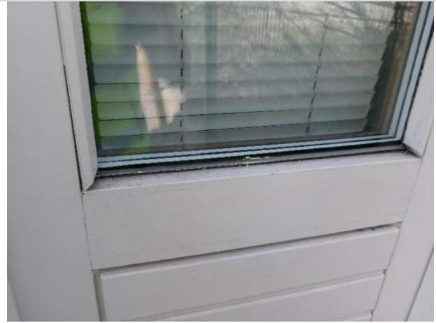
Kuva 37. Ryhmähuone 16 hätäpoistumistieoven ikkunalista irronnut.
