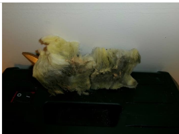
Kuva 45. RA7 tiivistämättömän läpiviennin kohdalla ilmavuoto liannut mineraalivillan. Lievä poikkeava hajutummentuman kohdalla.
