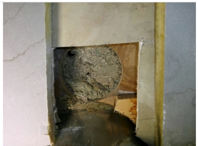
Kuva 62. RA3 puhallusvillasta otettiin mikrobinäyte M4, jossa ei havaittu poikkeavaa mikrobikasvua.
