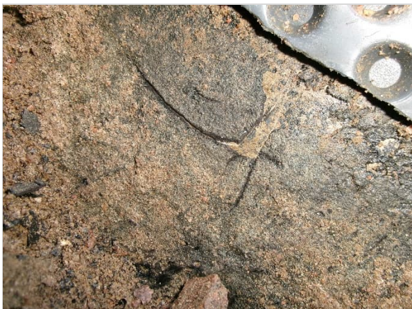
Kuva 5. Koekuopasta 1 havaittiin patolevyn päättävän liian aikaisin paljastaen bitumisivelyn. Bitumisivelyn kunto oli heikohko.
