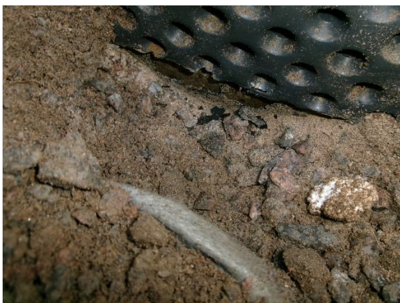
Kuva 7. Patolevyä koputellaessa bitumisively irtosi sokkelista. Geokangas sorakerrosten välissä noin 50 cm syvyydessä.
