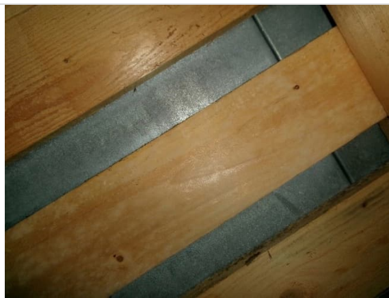
Kuva 64. RA4 kautta kuvattiin yläpohjaa. Peltikatteen alta puuttui aluskate.
