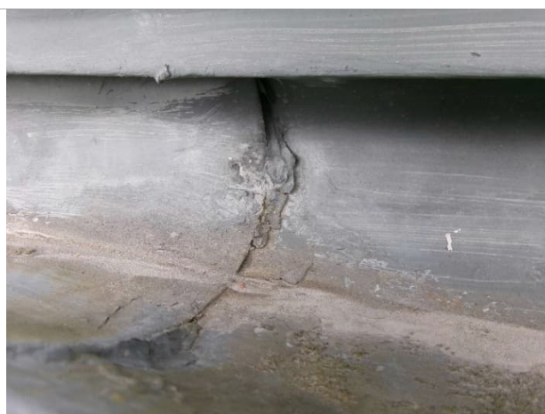
Kuva 82. Sadevesikourujen liimaukset ovat alkaneet irtoamaan.
