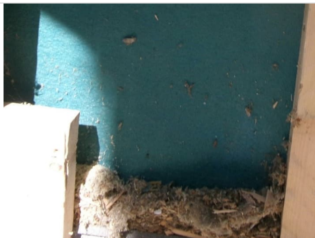
Kuva 43. RA15 kohdalla ilma-alaan oli tippunut puhallusvillaa ja purua.
