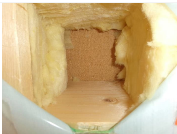
Kuva 47. Rakenneavaukset olivat hyväkuntoisia, puhtaita ja hajuttomia, lukuun ottamatta RA7.
