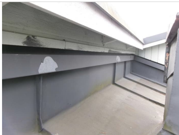
Kuva 78. Maalipinta on hilseillyt ja irronnut.
