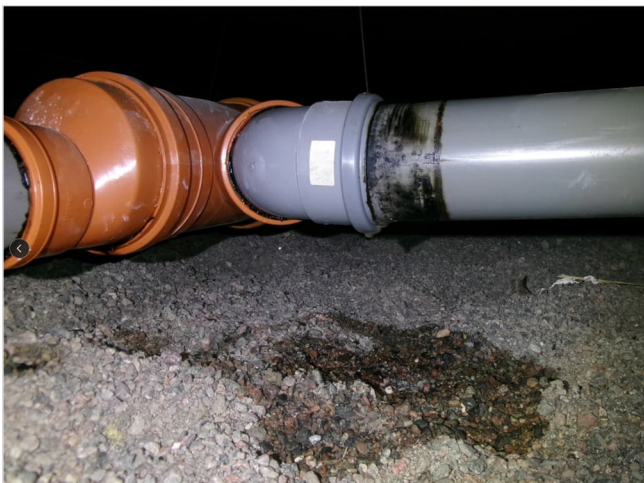
Kuva 84. Putkiliitos auki (pesuhuoneen 07 alla).
