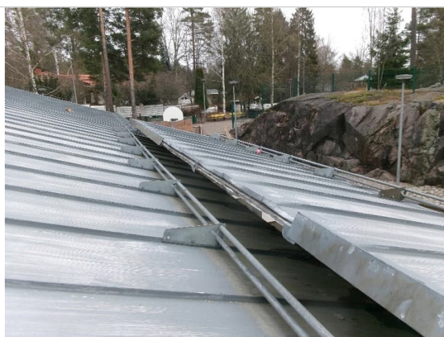
Kuva 76. Sisäänkäyntikatoksesta oli reunapelti irronnut.
