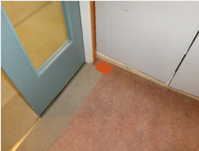
Kuva 16. Keittiön vanhan vesivahingon kohdalta otettiin vanhasta linoleumimatosta näyte M9 mikrobiviljelyä varten. Lattiapäällysteissä on yleisesti havaittavissa tavanomaista kulumaa. Liimakerroksessa ei havaittu kosteuden aiheuttamaa notkistumista tai poikkeavaa hajua
