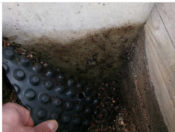
Kuva 8. Rakennuksen koillisnurkalla patolevyn takana ei ollut bitumisivelyä. Patolevyn taakse oli päässyt maa-ainesta ja sokkeli oli märkä.
