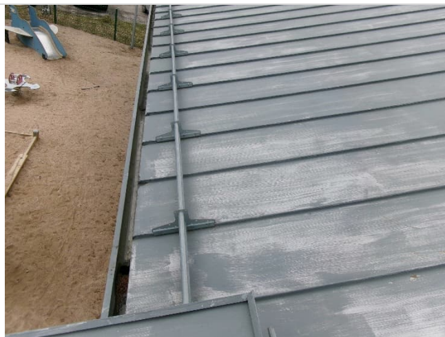
Kuva 72. Peltikatteen maalipinta on erittäin kulunut.
