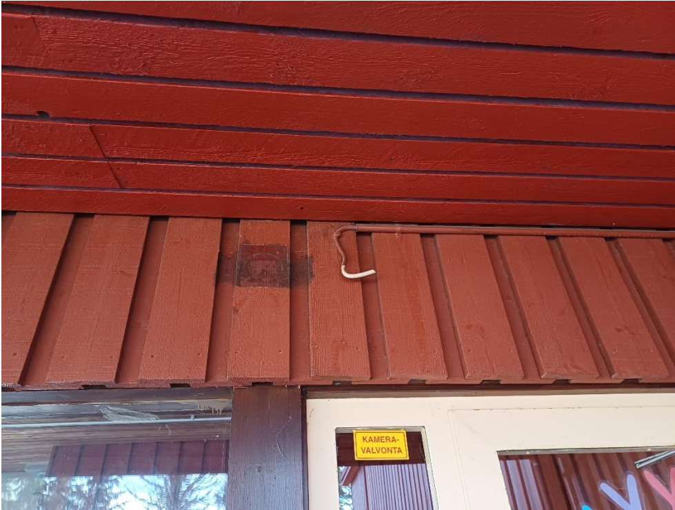
Kuva 4.6. Ulkoseinistä poistettujen valaisinten sähköjohdotukset on jätetty purkamatta.
