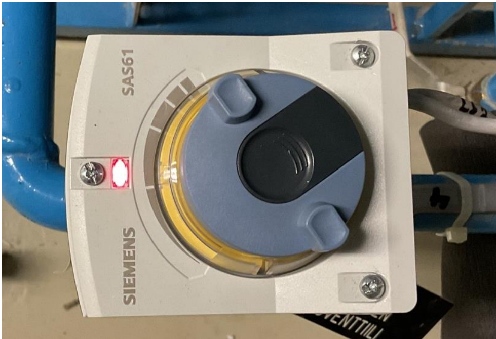
Kuva 6.2. Patteriverkoston venttiilimoottori vikatilassa, korjaus tilattu.
