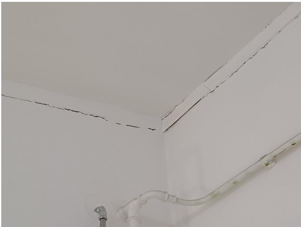
Kuva 4.4. Rakenneliittymien ratkeamia on runsaasti koko rakennuksessa.
