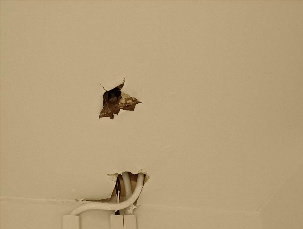
Kuva 4.2. 150 Eteinen, tilan yhteydessä olevan sähkökeskuksen alakatossa on reikä, sekä sähköjohtojen läpiviennit eivät ole tiiviitä.
