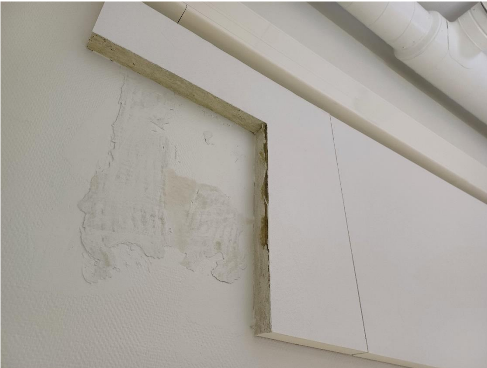
Kuva 4.3. 157 Lepohuone, seinään kiinnitetyn akustointilevyn leikatun reunan pintakäsittely on rispautunut.
