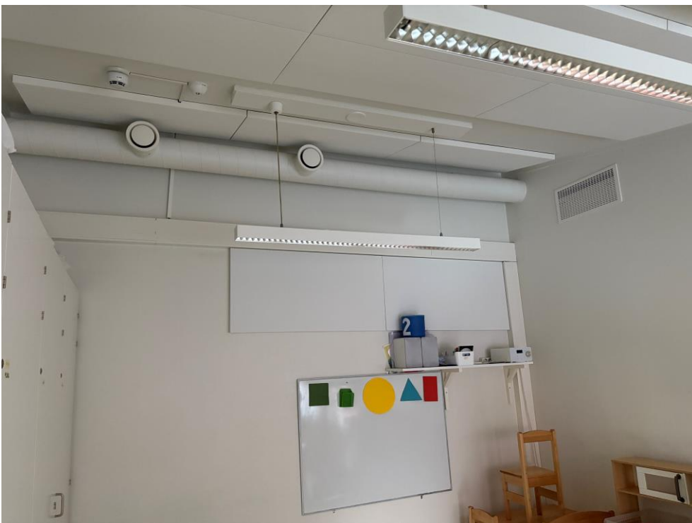
Kuva 5.2. 161 tilan lepohuoneessa on ilmanvaihdon tuloilmapäätelaite suunnattu poistoilmapäätelaitteita kohti. Ilmanvaihto ei huuhtelee tehokkaasti koko tilaa.
