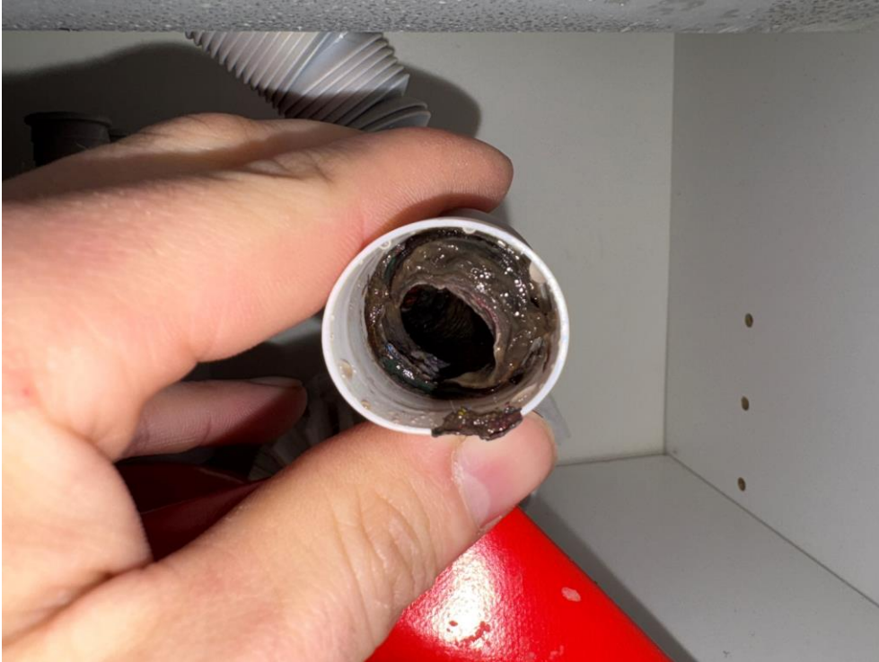
Kuva 5.1. Ryhmähuoneiden ylivuotoputkiin on kertynyt likaa, mikä aiheuttaa maakellarin ja viemärin hajua tiloihin.
