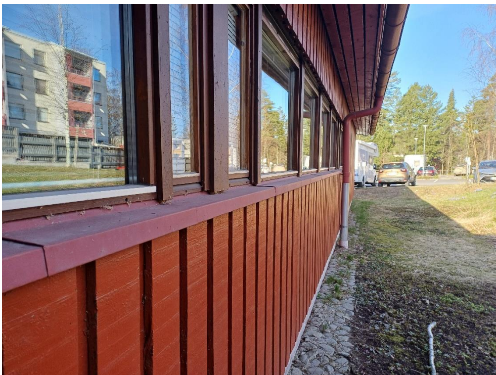
Kuva 4.5. Ikkunoiden vesipeltien kaadot eivät ole riittäviä.
