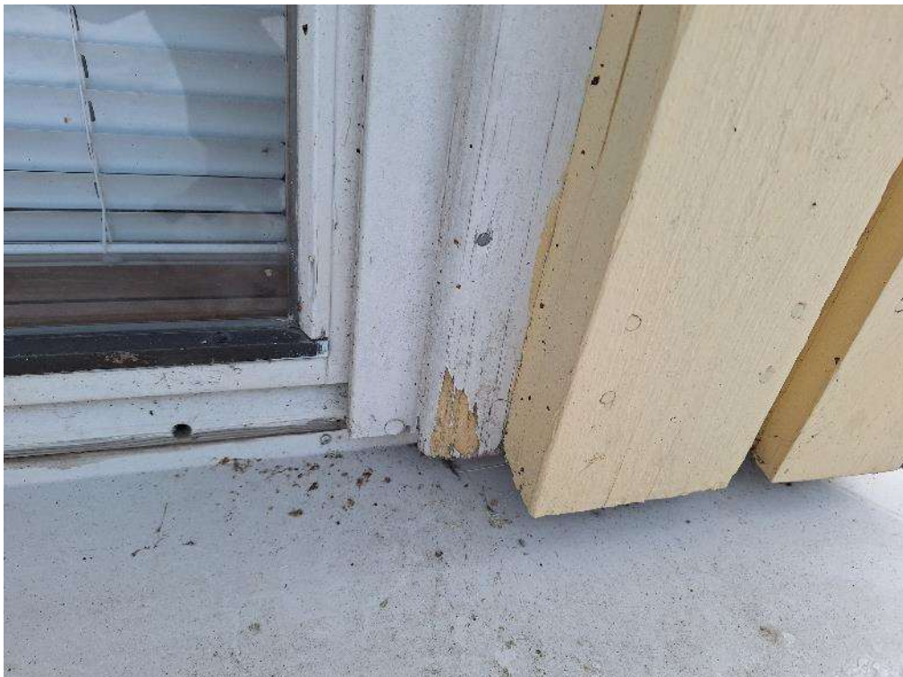
Kuva 3. Ikkunoiden maalissa (näyte 2) ei havaittu asbestia, mutta havaittiin raja-arvot ylittävä määrä raskasmetalleja ( arseenia ja kuparia ).
