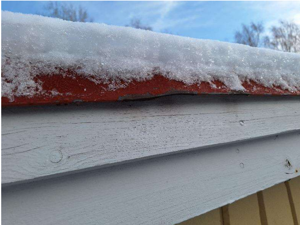
Kuva 6. Räystäspellitysten maalissa (näyte 5) ei havaittu asbestia, mutta havaittiin raja-arvot ylittävä määrä raskasmetalleja ( sinkkiä ).
