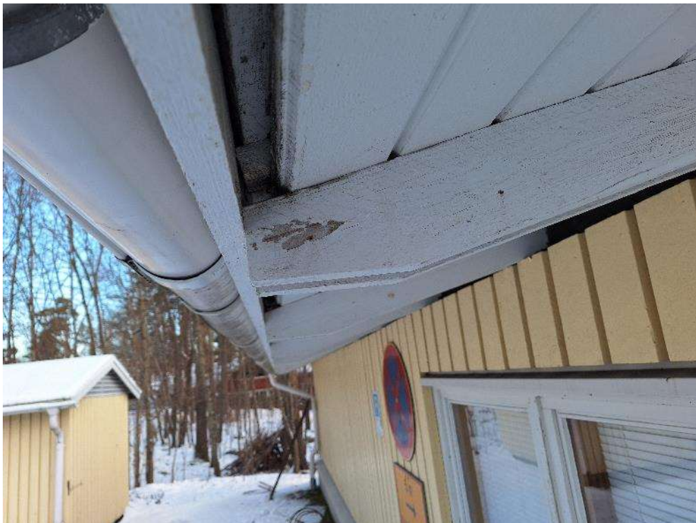
Kuva 5. Räystäslautojen maalissa (näyte 4) ei havaittu asbestia, mutta havaittiin raja-arvot ylittävä määrä raskasmetalleja ( sinkkiä ).
