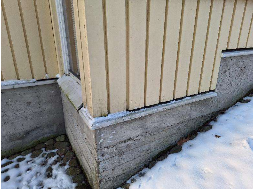
Kuva 2. Julkisivun maalissa (näyte 1) ei havaittu asbestia, mutta havaittiin raja-arvot ylittävä määrä raskasmetalleja ( sinkkiä ).
