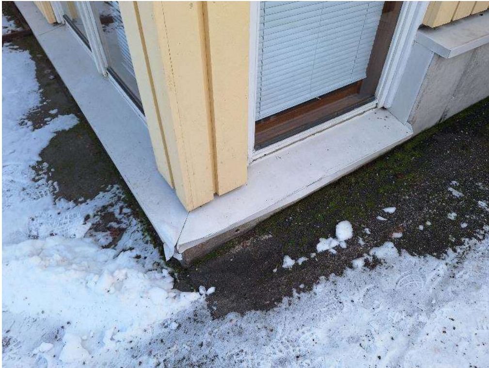
Kuva 4. Vesipeltien maalissa (näyte 3) ei havaittu asbestia, eikä raskasmetalleja
