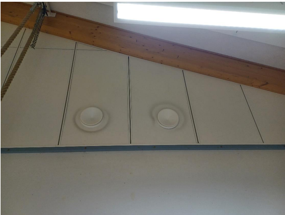
Kuva 4.3. 120 Monitoimitila, akustointilevyjä on likaantunut IV-tuloilmapäätelaitteiden ympäriltä.
