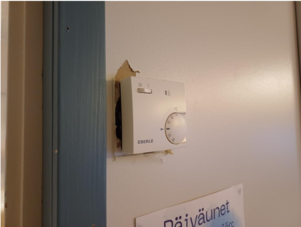
Kuva 4.12. Lämpötilatermostaattisäädin on osittain irti seinästä tiloissa.
