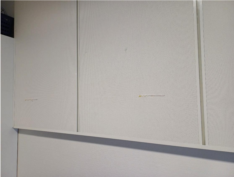
Kuva 4.2. 106 Leikkitila, seinään asennetuissa akustointilevyissä on viiltojätkiä.
