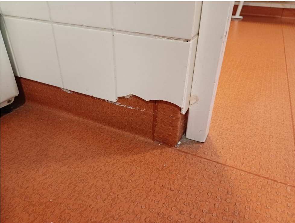
Kuva 4.7. 144 WC-tila/Pesuhuone, seinälaattoja on rikkoutunut alareunoistaan.
