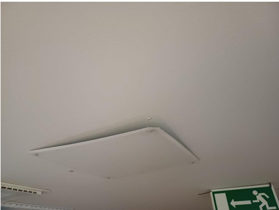
Kuva 4.11. 149 Aula, tarkastusluukkujen kansien kiinnitykset eivät ole tiiviitä.
