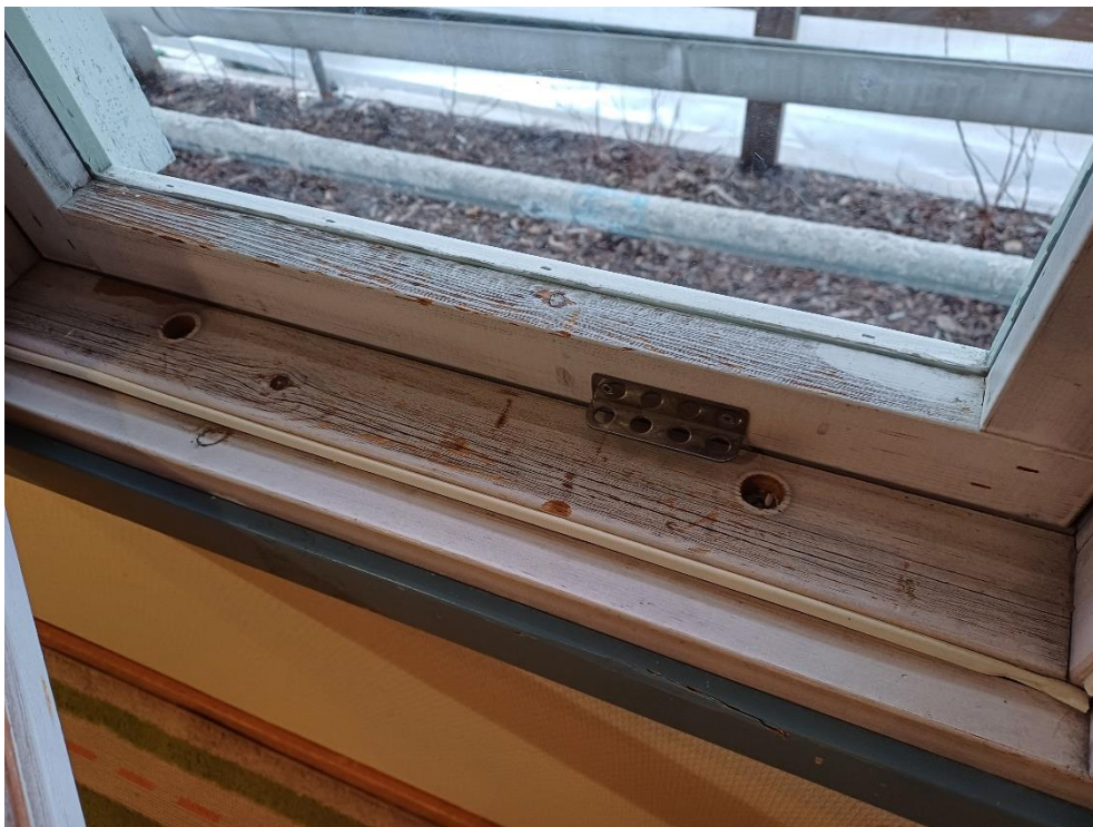
Kuva 4.14. Ikkunarakenteet tarvitsevat kauttaaltaan huoltokunnostuksen.
