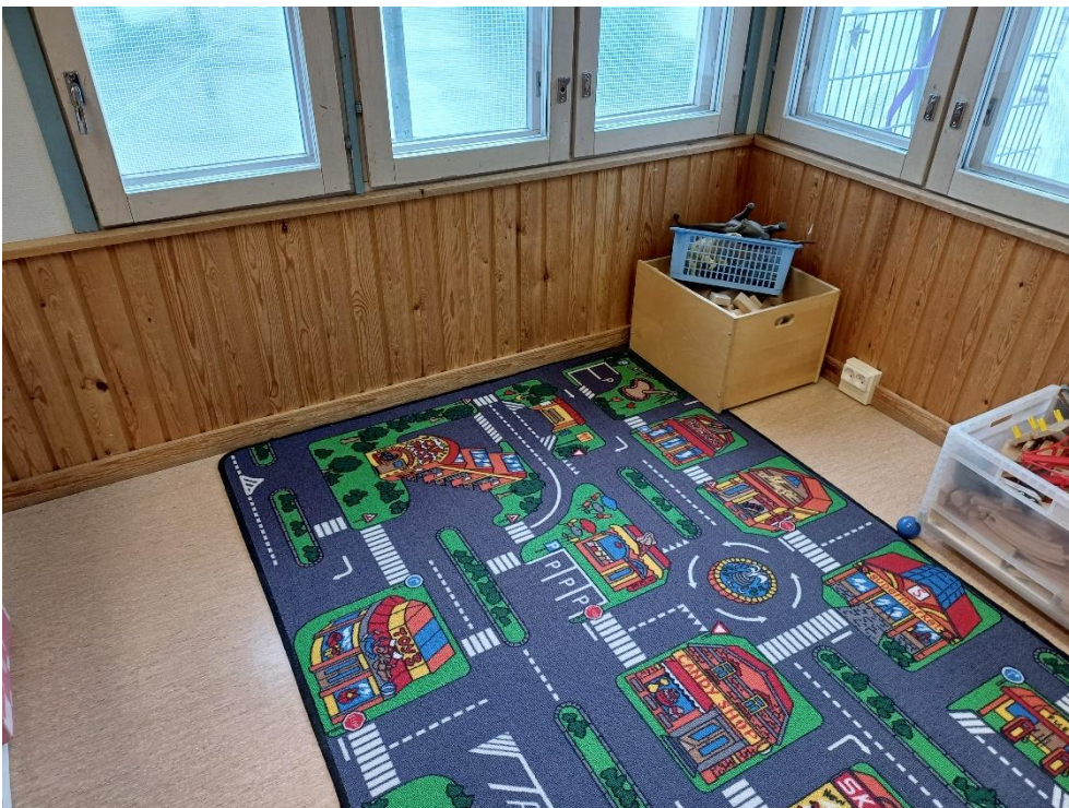
Kuva 4.13. Seiniin on asennettu paljon puolipanelointia, minkä takana lattia-seinäliittymien tiiveys on epävarma.
