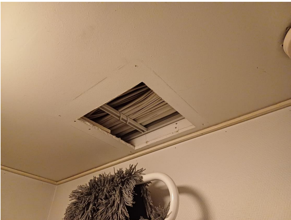
Kuva 4.5. 128 Siivouskomero, alakatosta puuttuu tarkastusluukun kansiosa.
