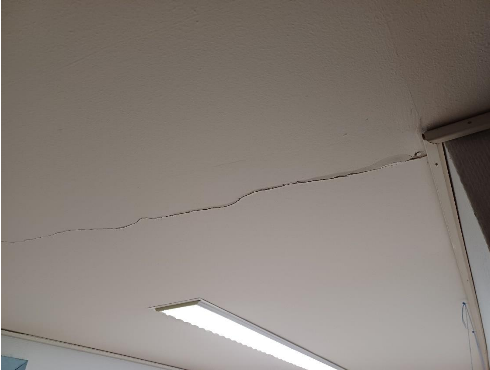
Kuva 4.10. 149 Aula, alakattolevytyksen halkeama.
