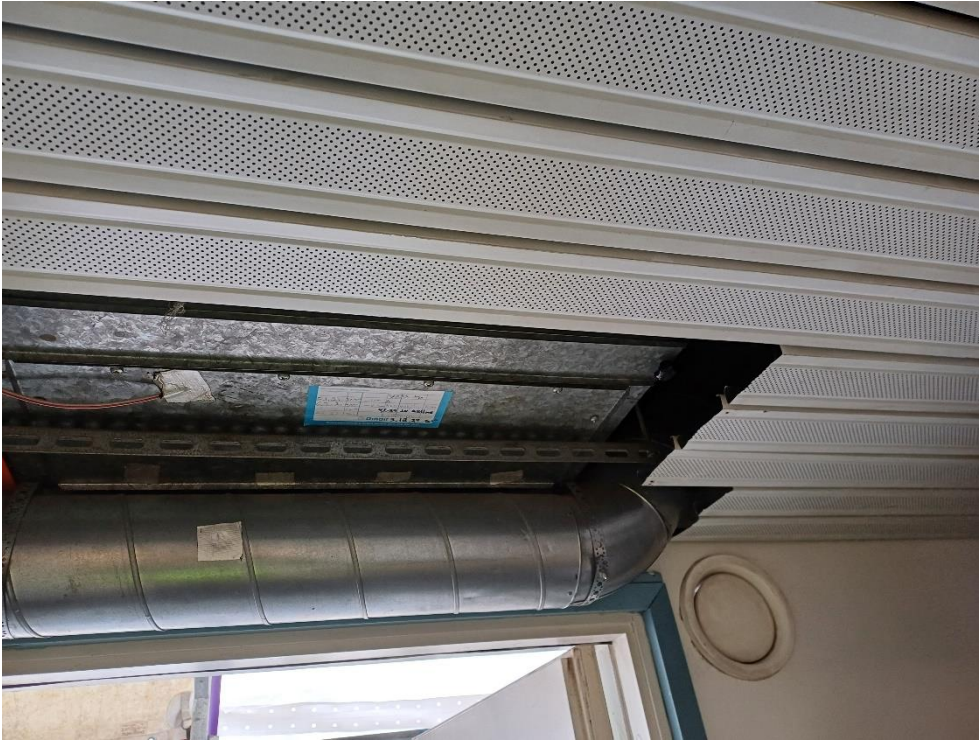
Kuva 4.4. 121 Tuulikaappi, alakaton säleiköstä puuttuu peitelevy.
