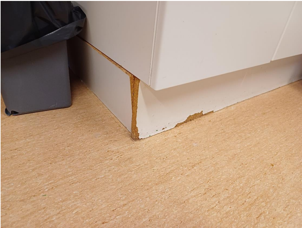
Kuva 4.1. 102 Leikkitila, alakaapiston sokkelilevyssä on kosteuden aiheuttama vaurio.
