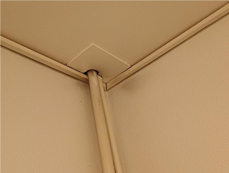
Kuva 4.6. 132 WC-tila, vesijohtojen kattoläpivienneistä on ilmavuotoja.
