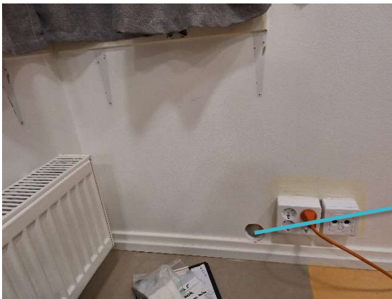
Kuva 31 Rakennusvaus tilan 05 alakulmaan, ikkunan alapuolelle.
