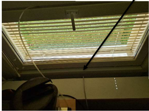
Jatkuvaa ja selvää ilmavuotoa ikkunan alaosa
