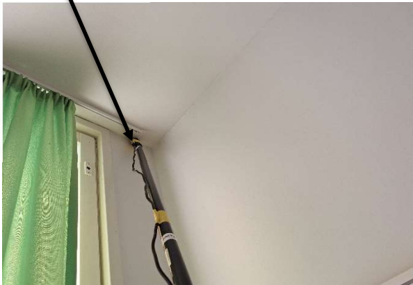
Lievää vuotoa yläpohjan ja ulkoseinän liittymästä.
