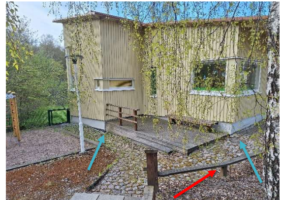
Kuva 9 Rakennuksen koillispääty. Maanpinta kaataa pihalta kohti rakennusta. Sala-ojakaivot on merkitty sinisillä nuolilla ja pintavesikaivo punaisella.
