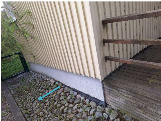
Kuva 10 Rakennuksen koillispäätyyn on tehty hieman vastakaatoa rakennuksesta poispäin.
