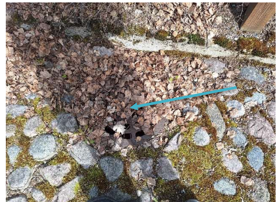
Kuva 11 Sadevesikaivo on lehtien peitossa lähellä matalaa aitaa.
