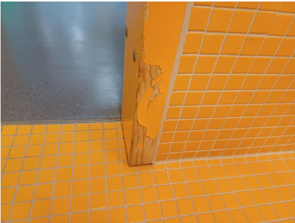
Kuva 4.4. WC-tilojen ovilistoituksissa on kosteusvaurioita.
