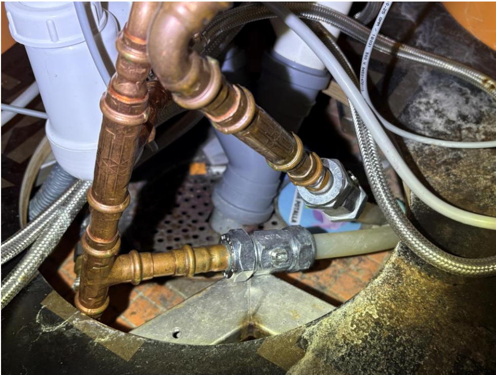
Kuva 5.3. Pesuhuoneiden allaskaappien sisällä olevien lattiakaivojen pesu on hankalaa tilan ahtauden takia. Lattiakaivo vesiputkien ja viemäreiden alla.
