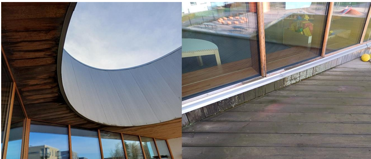
Kuva 4.10. 2.Kerroksen terassin valoaukon kautta tuleva sadevesi kastelee ympäröiviä rakenteita.
