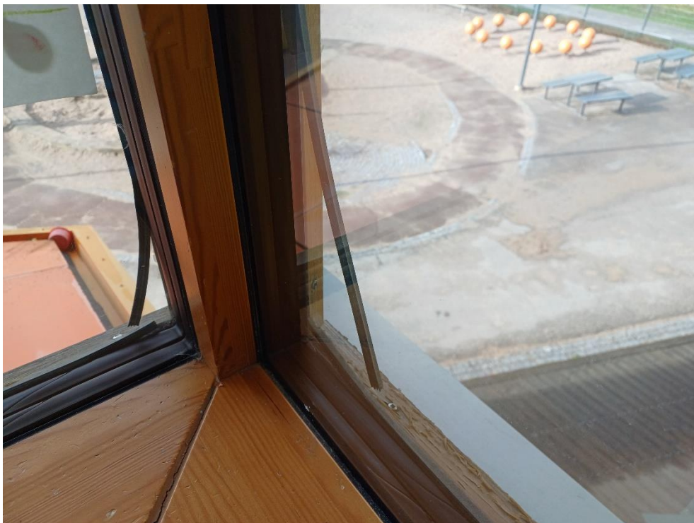
Kuva 4.9. Kiinteiden ikkunoiden ulkopuolen tiivisteitä irtoilee useista ikkunoista, jolloin sadevesi pääsee kastelemaan ikkunan karmirakenteita.
