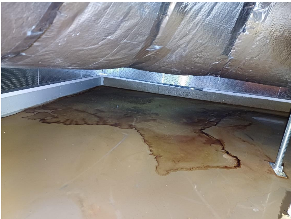
Kuva 4.7. IV-konehuoneen lattiassa on runsaasti vanhoja vesivuotojälkiä.
