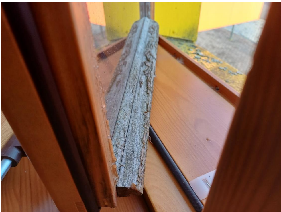
Kuva 4.8. Tuuletusikkunoiden ulkopokista, tippalistojen pintakäsittely hilseilee irti.
