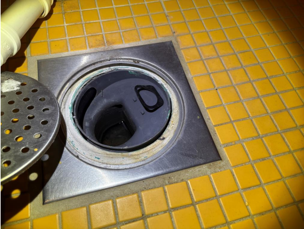
Kuva 5.1. Lattiakaivojen vesilukkojen osat ovat irti useassa lattiakaivoissa.
