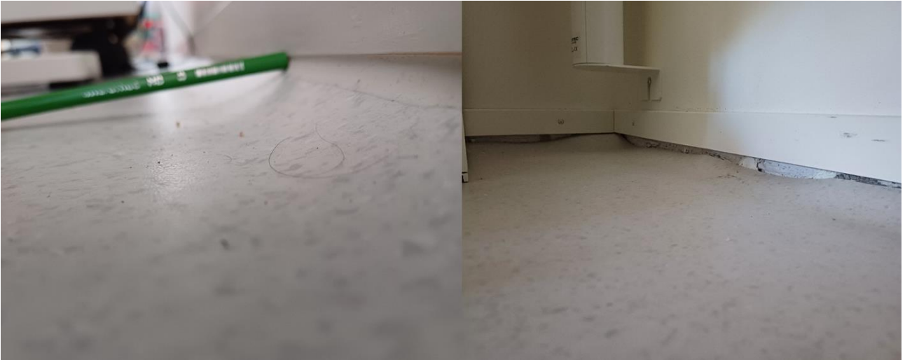
Kuva 4.5. Lattiat ovat yleisesti painuneet alaspäin molempien kerrosten osalla.
