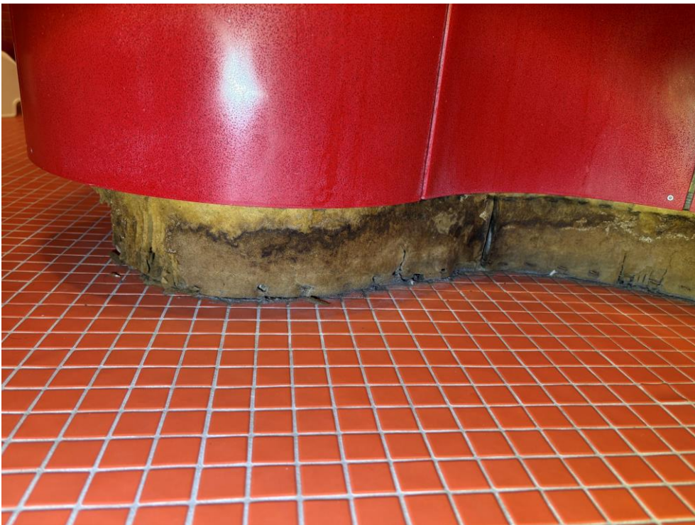
Kuva 5.2. Pesuhuoneen 121 allaskaapin alaosat ovat kosteudesta vaurioituneet.
