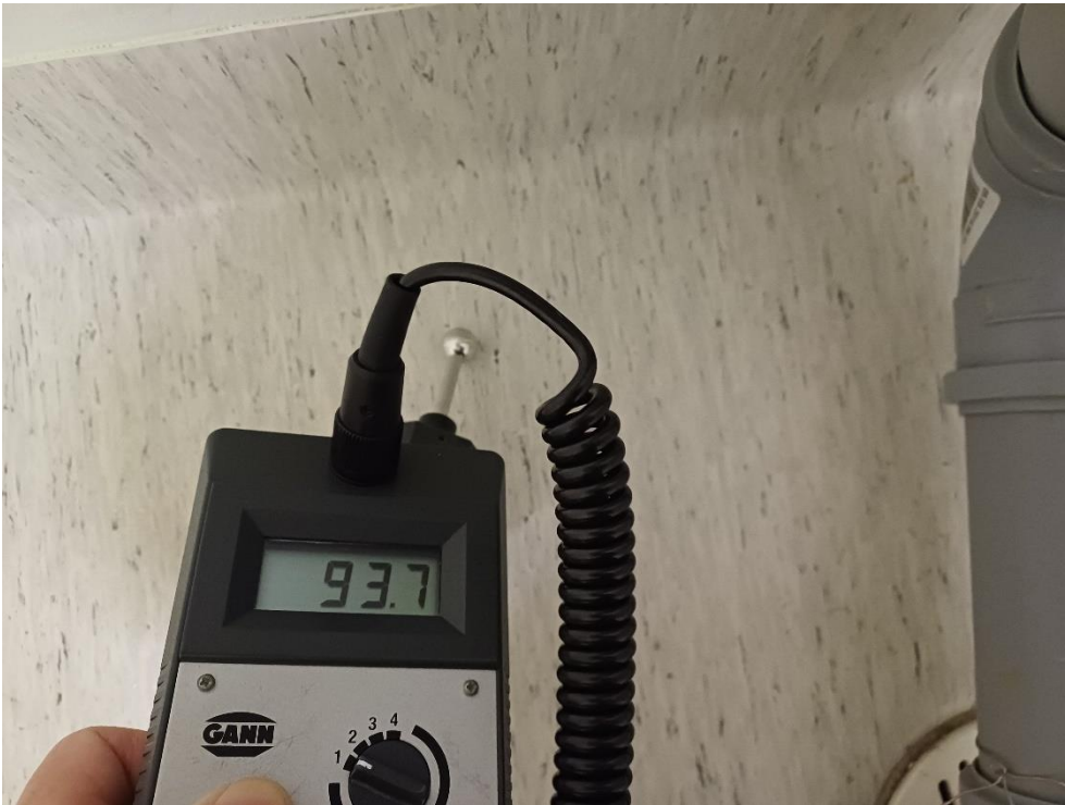
Kuva 4.3. 223 Siivouskomero, lattiasta mitattiin pintakosteudenosoittimella kohonneita vertailuarvoja.
