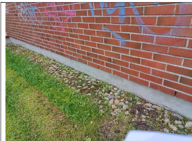
Koulun takapihan sokkeliä on paikattu.
