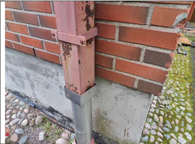
Rakennusten vedenpoistoa, vanha osa syökytorvea alkanut ruostua.
