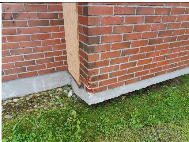
Erkkerin kulmassa tiiliä murtunut ja tummia jälkiä.
