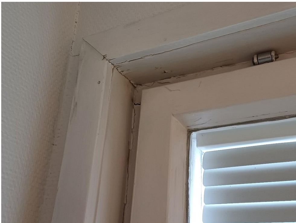
Kuva 4.11. Vanhan puolen ikkunat tarvitsevat kauttaaltaan huoltokunnostuksen tai ikkunoiden uusimisen.
