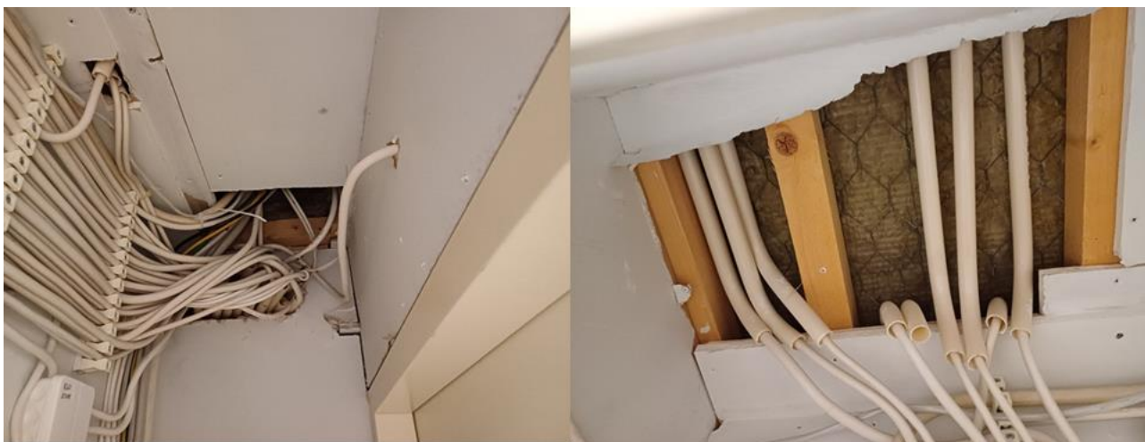
Kuva 4.4. 112 Tekniikkatila, avoimia läpivientejä eristetiloihin, sekä alakaton levytystä on irti missä mineraalivillaa näkyvissä.
