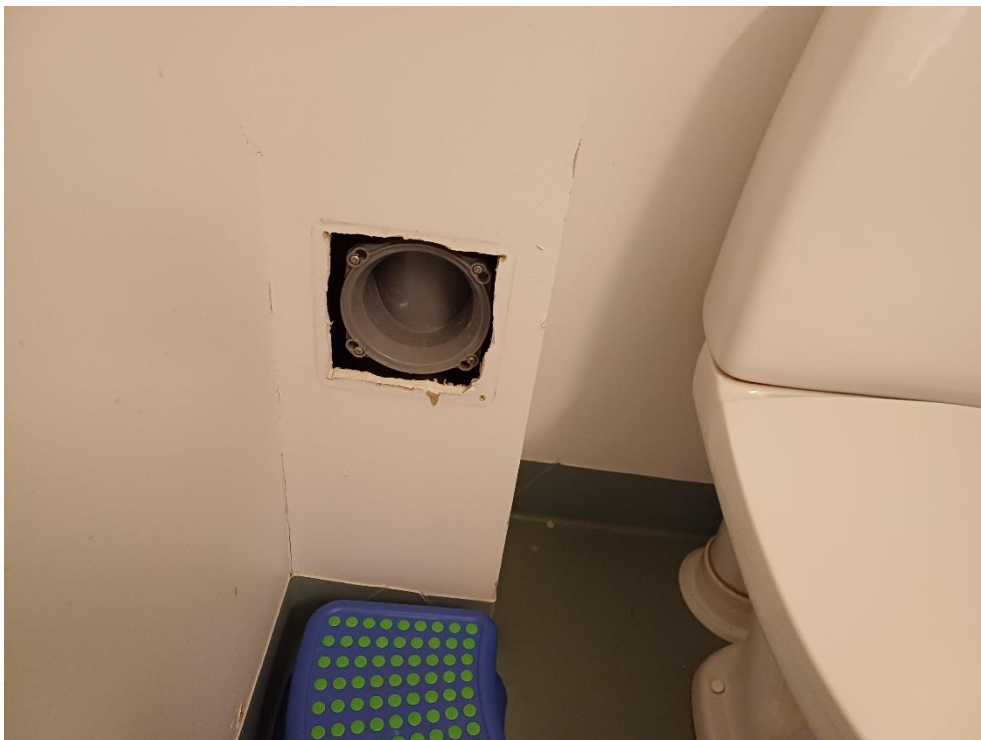
Kuva 4.3. 110 WC-tila, putkikotelon tarkastusluukun kansiosa puuttuu.
