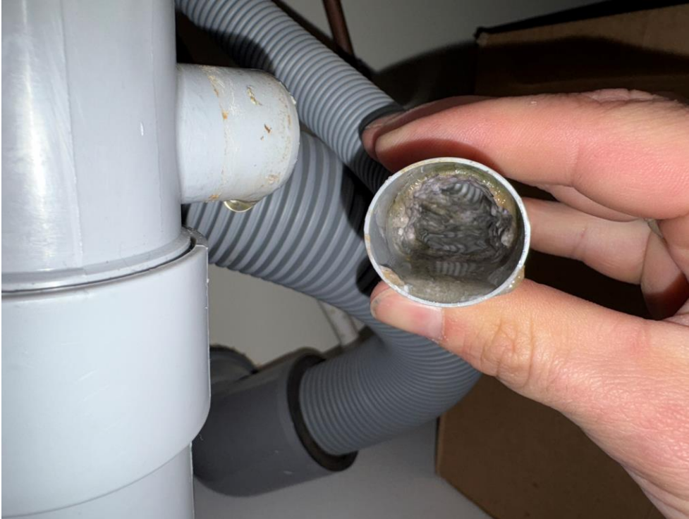
Kuva 5.1. Ryhmähuoneiden pesualtaiden ylivuotoputket paikoitellen likaiset. Lika pinnoilla saattaa aiheuttaa maakellarintapaista hajua sisätiloihin.
