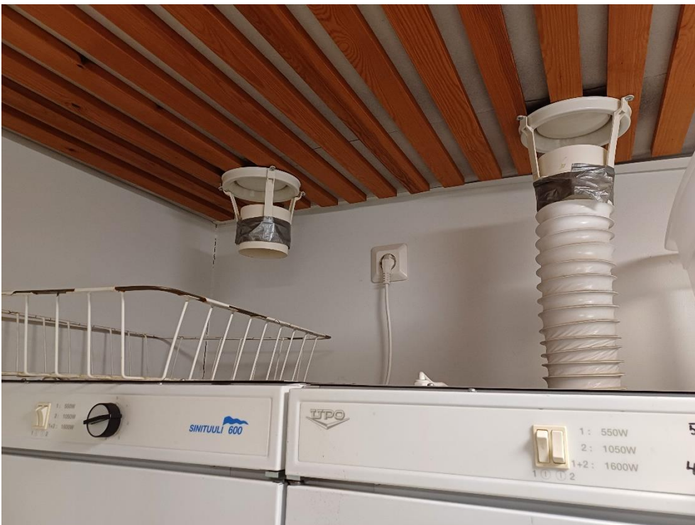
Kuva 4.6. 127 Kuraeteinen, kuivauskaapin poistoilmaletku on irti kiinnikkeistään.
