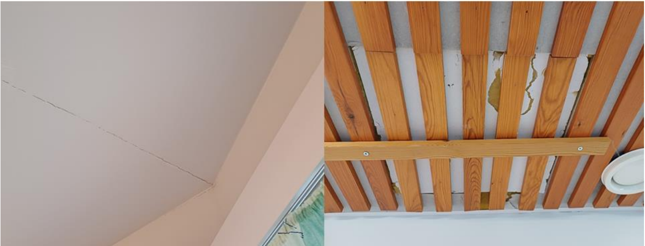
Kuva 4.7. 133 Vesileikki, alakaton levysauma on ratkennut auki, alakaton rimoituksen päällä olevissa akustointilevyissä on pintavaurioita.
