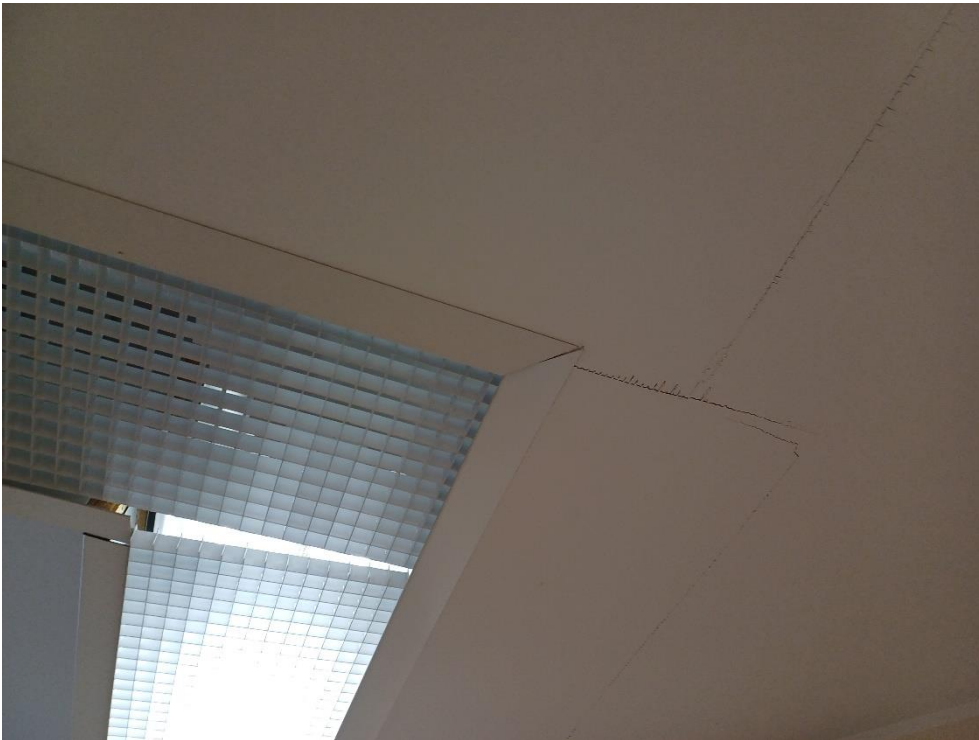
Kuva 4.5. 125 Aula, kattoikkunan ympäristössä on alakaton levysaumojen ratkeamia.
