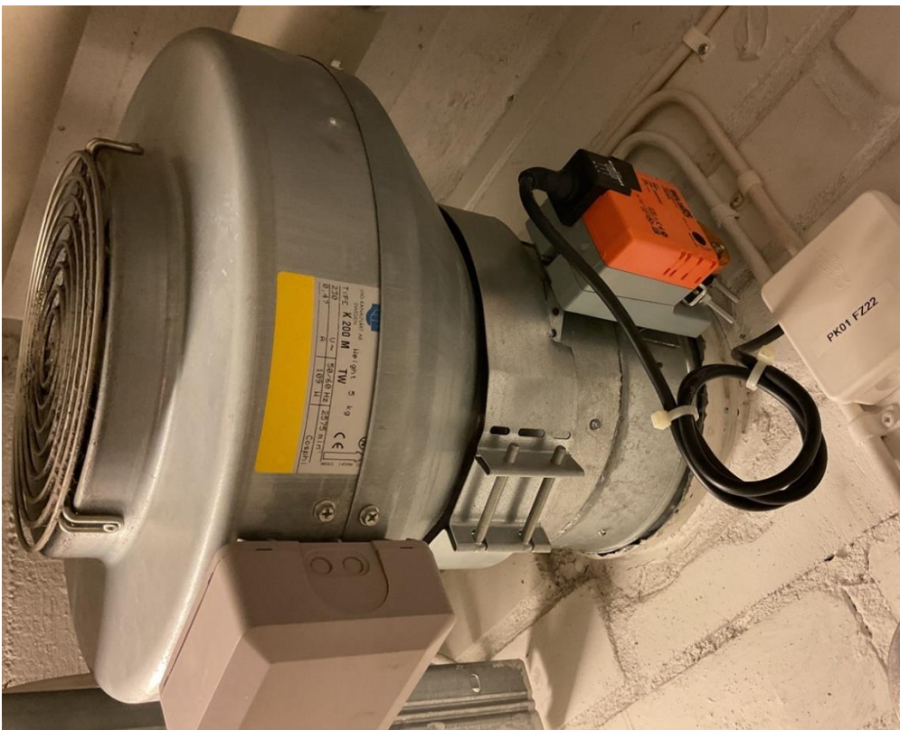
Kuva 6.2. Lämmönjakohuoneen poistoilmapujallin ei pyöri, vaikka ohjaus on KÄY.
