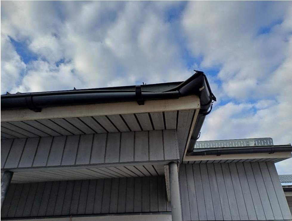
Kuva 4.13. Henkilökunnan/keittiön sisäänkäynnin luona on sadevesikourun vaurio.
