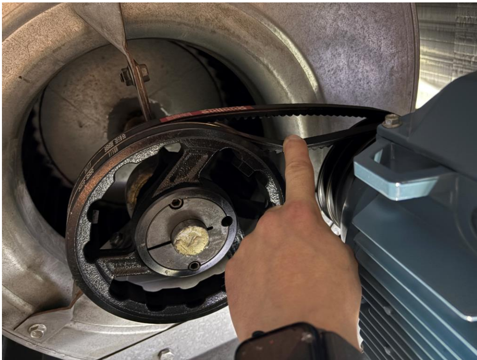
Kuva 5.3. Tuloilmapuhaltimen hihna löysällä.
