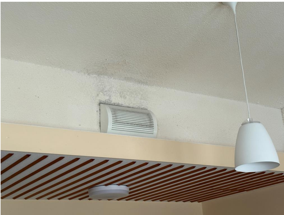
Kuva 5.2. Tuloilmapäätelaitteiden edessä oleva hylly kerää huonepölyä. Pöly jää myös helposti kiinni akustopinnoitettuun kattoon.
