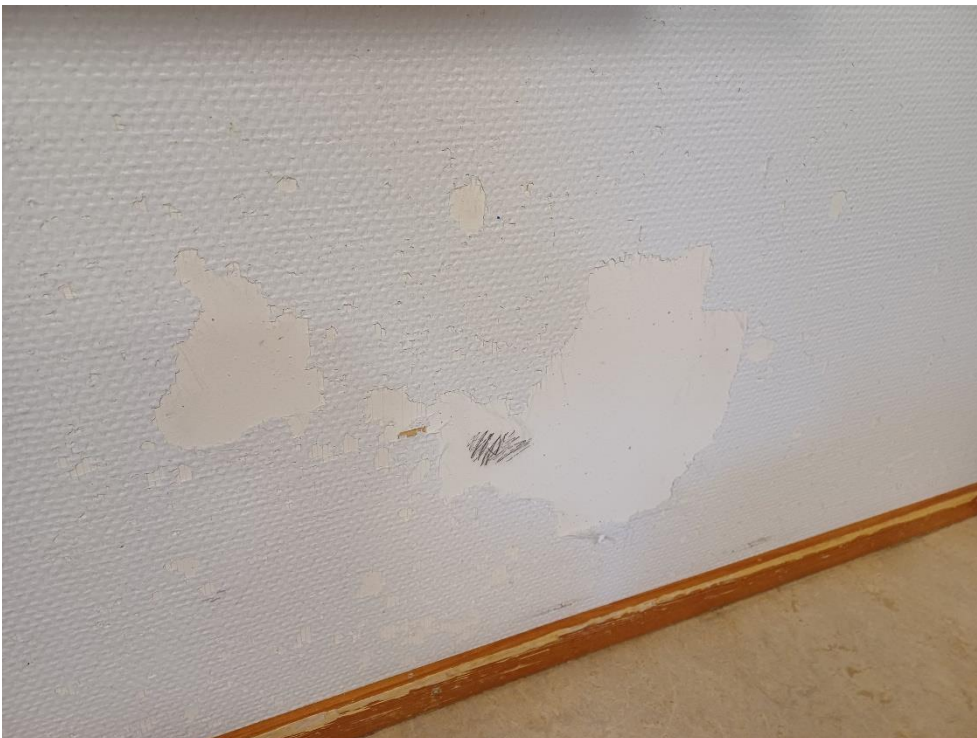
Kuva 4.2. Tilat 106, 107 ja 122, seinäpinnoitteena käytetty lasikuitutapetti on kulunutta ja irtoilee paikoittain.
