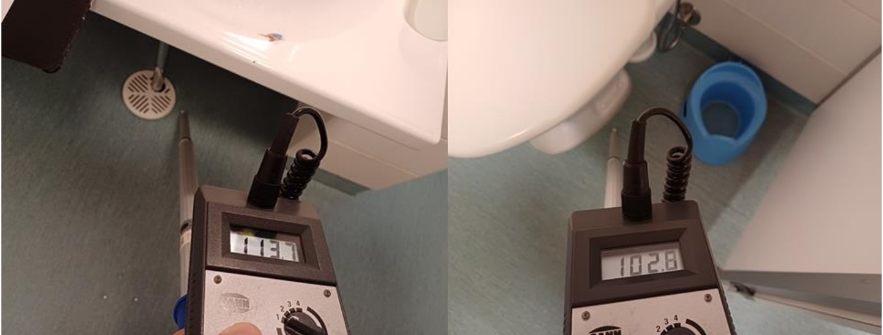
Kuva 4.1. 012 WC-tila lapset, lattiakaivon ja wc-pöntön ympäristöstä mitattiin pintakosteudenosoittimella kohonneita vertailuarvoja.
