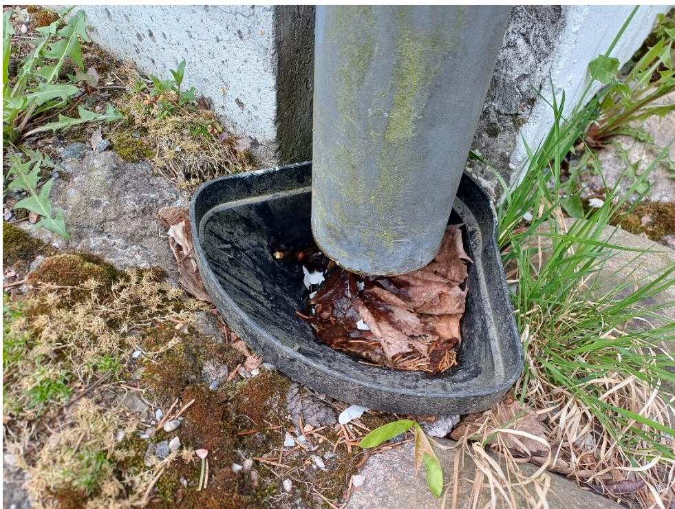
Kuva 4.12. Osa sadevesisyöksyjen kerääjäsuppiloista on takapihan puolella tukkiutunut puiden lehdistä.
