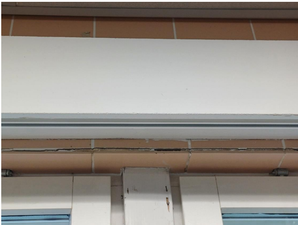
Kuva 4.9. 145 Keittiö, seinälaatoituksen saumojen ratkeilua ikkunoiden yläpuolella.
