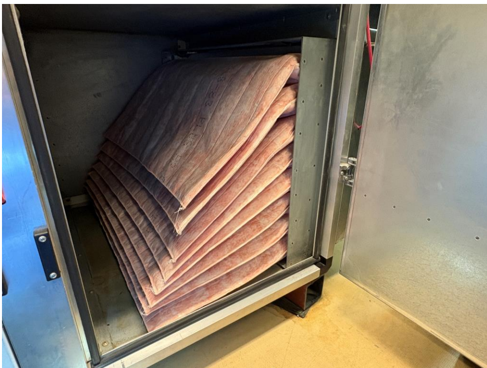
Kuva 5.4. Tuloilman suodattimet asennettu väärin. suodatinpussien tulisi olla pystyasennossa.
