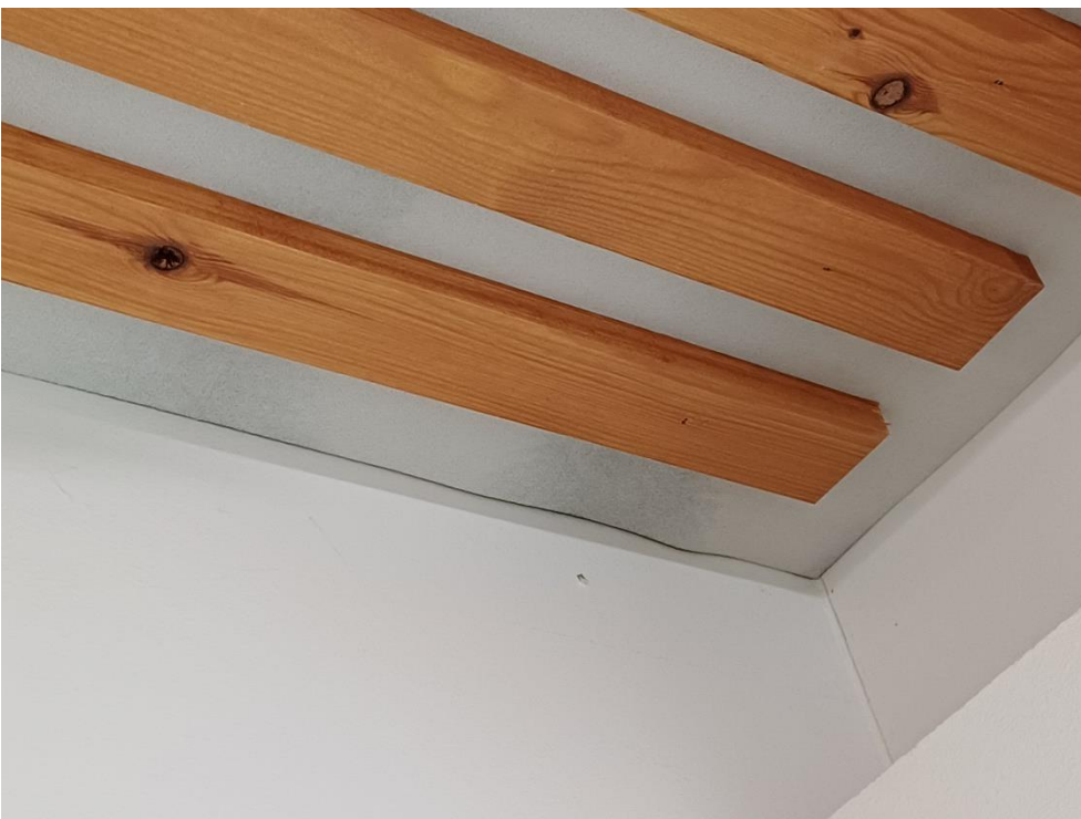
Kuva 4.8. 134 WC-tila, alakaton akustointilevyissä on ilmavuotojälkiä.
