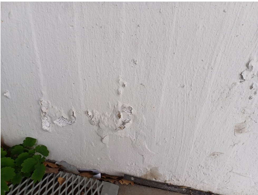
Kuva 4.14. Henkilökunnan/keittiön sisäänkäynnin kohdalla on sokkelirakenteissa kosteuden aiheuttamaa rapautumaa.
