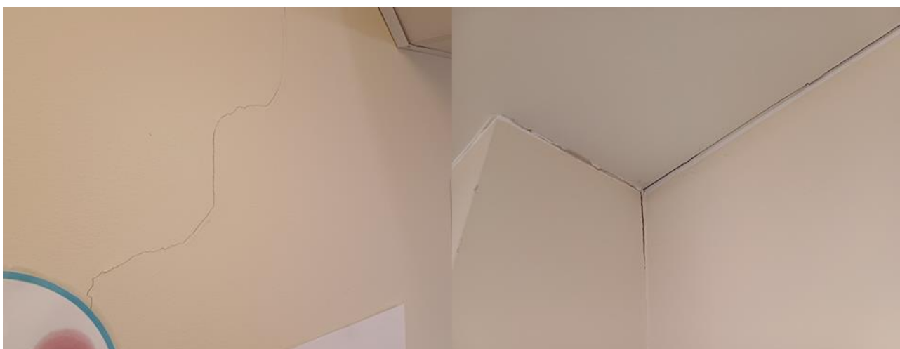
Kuva 4.10. Halkeamia sekä rakenneliittymien ratkeamia on runsaasti 2krs. alueella.
