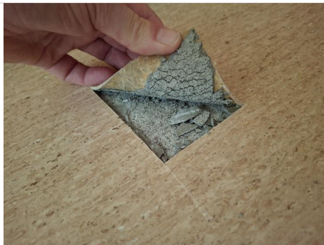
Kuva 22. Leikkitilan 142B VK4:ssa tasoite jäi muovimaton pintaan kiinni ja se oli murenevaa.
