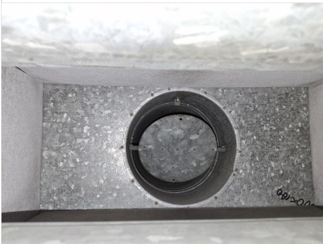
Kuva 65. Ilmanvaihtokanavien säätöpellit ovat vanhanaikaiset.
