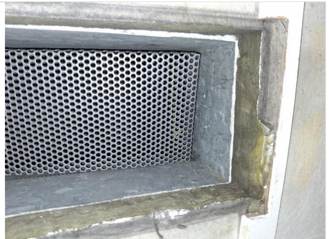
Kuva 64. Tuloilmakanavien päätelaitteissa havaittiin avonimia mineraalivillapintoja, joista voi irrota mineraalikuivia sisäilmaan.
