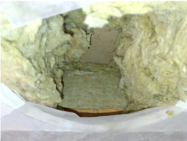
Kuva 16 Tuulensuojalevyn alaosassa havaittiin kosteusjääkiä. Ulkopuolella sokkelin pintaan tiputteli sadevesikourusta vettä.
