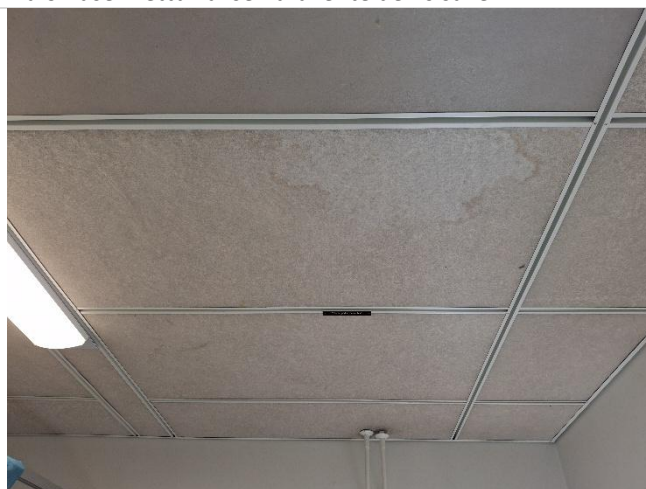
Kuva 45. Wc-tilassa 140 havaittiin alas laskulevyssä kosteusjälkiä vesisulkujen kohdalla, sulut oli uusittu.
