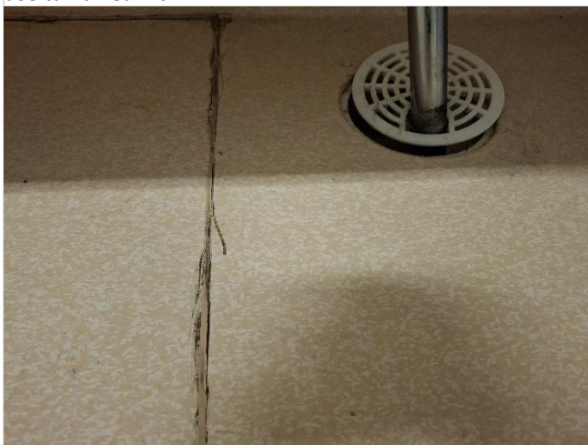
Kuva 15. Useassa kosteassa tilassa havaittiin puutteita muovimattojen saumoissa, kuva wc-tilasta 158.
