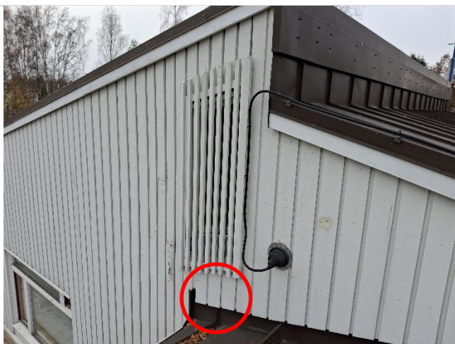
Kuva 55. Ulkoseinän rakenneavaus RA15, jossa havaittiin mikrobivaurio (M14), tehtiin sisäpuolelta ympyröityyn kohtaan. Ulkoseinän paneloinnin maalipinta kupruili.
