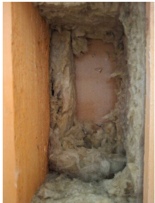
Kuva 33 Tuulensuojalevystä tulee useita nauloja lävitse.
