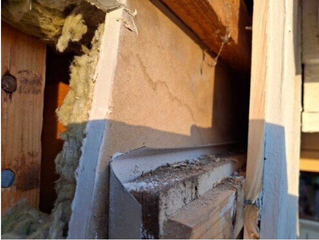
Kuva 21 Vettä on päässyt vuotamaan ikkunan yläpellityksen molemmin puolin.
