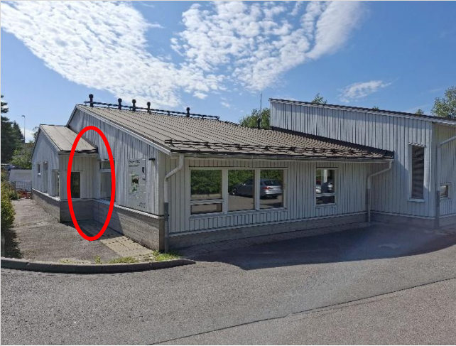
Kuva 9. Päädyssä sijaitsevan erkkerin kattosadevedet ohjautuvat sadevesikourusta ulkoseinään päin. Sokkeli ja ulkoseinän alaosan rakenteet ovat kastuneet.
