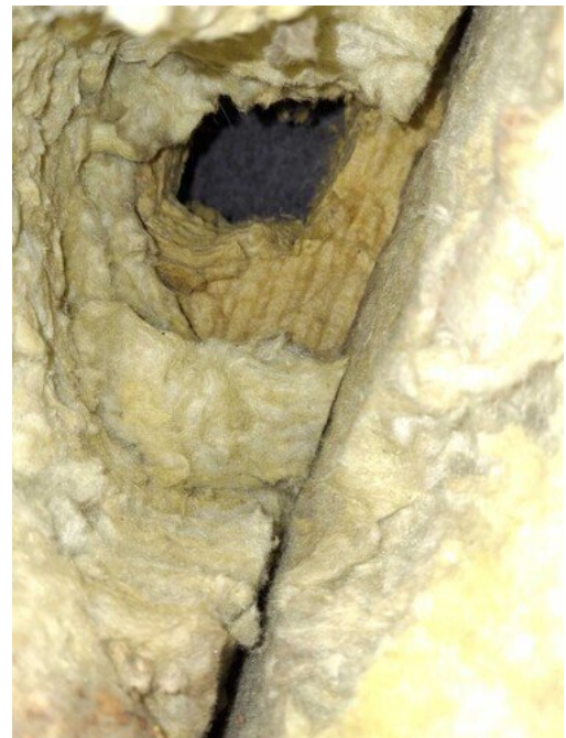
Kuva 42 Lämmöneristekerrosten päällä oli ilmarako ja aluskate.
