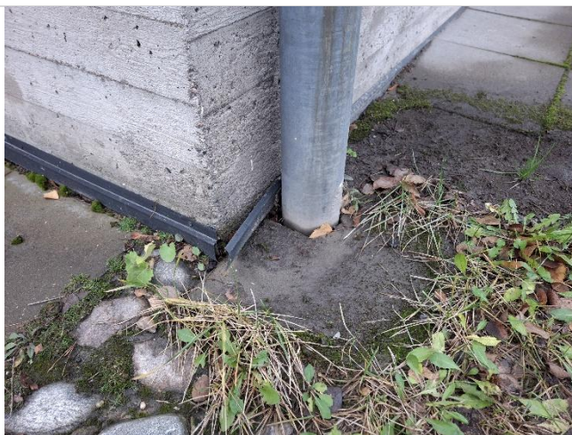
Kuva 8. Rakennuksen sokkeliin kohdistuu paikoin sade- ja hulevesien vuoksi ylimääräistä kosteusrasitusta.
