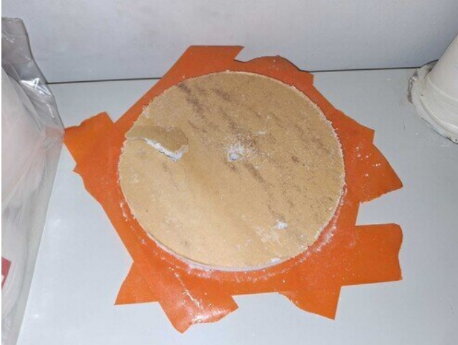
Kuva 39 Kipsilevyssä hieman värjäytymää takapinnalla.
