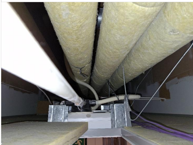
Kuva 42. Käytävien kohdalla katot on alas laskettu mineraalivilla levyin. Tilassa on runsaasti mineraalikuitulähteitä.
