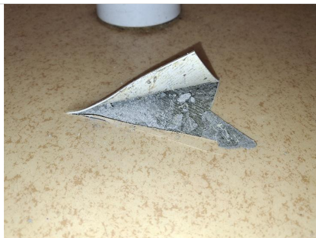
Kuva 18. Pukuhuoneessa 123 VK2 muovimaton liima jäi ta-soitteeseen, joka oli murenevaa. Liima oli tahmeaa.
