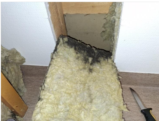
Kuva 31. Mineraalivilla lämmöneristeissä havaittiin runsaasti ilmavuotojälkiä etenkin ulkoseinä-lattialiitoksien kohdalla. Kuva rakenneavaus RA1:stä tilasta 103. Lämmöneristeen sisäpinnasta kerätyssä materiaalinäytteessä MA1 havaittiin mikrobikasvua.
