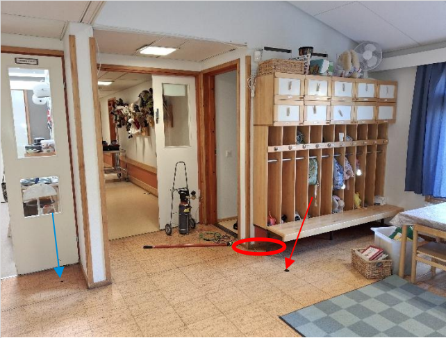
Kuva 11. Aulatilassa 138 (MA2) merkkiaine kulkeutui alapohjalaatan alta pieneltä alalta väliseinäliittymän kohdalta. Sinisen nuolen kohdalla oli laatan reunavahvistus.
