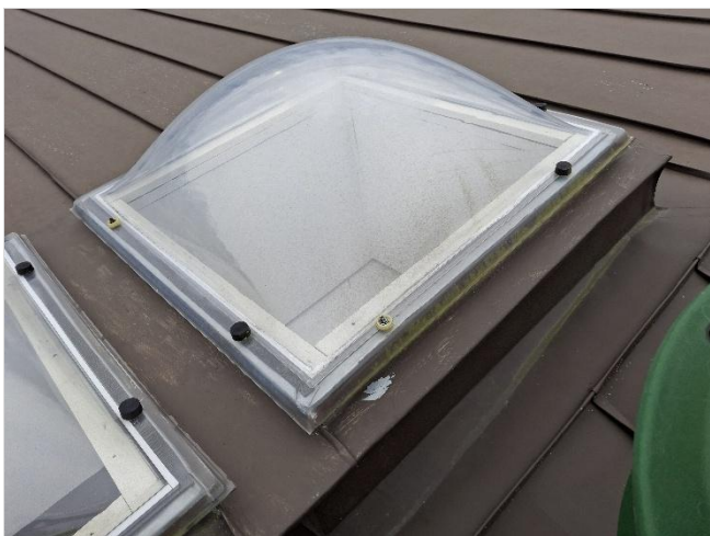
Kuva 52. Kattokuvut olivat kohtalaisen hyvässä kunnossa. Vuotojälkiä ei havaittu. Kiinnikkeiden suojakumeja on irronnut.
