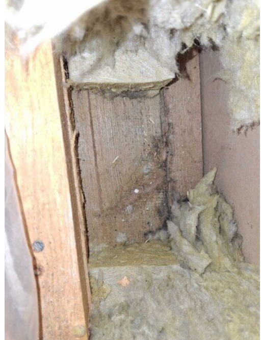
Kuva 31 Vuotoilmaa on tullut alaohjauspuiden välistä.
