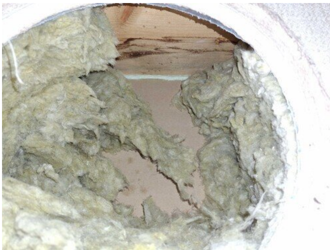
Kuva 18 Ikkunan alaohjauspuun alla havaittiin vanhoja kosteusjälkiä.
