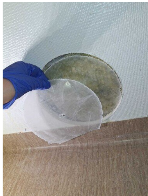
Kuva 15 Kohdassa oli tuplahöyrynsulku.
