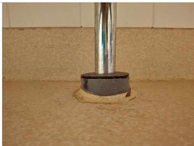
Kuva 14. Märkätiloissa muovimattojen läpivienneissä havaittiin puutteita.
