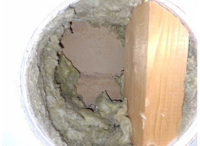
Kuva 25 Tuulensuojalevy hieman rikki. Levyssä on tummentumaa ja villoissa kohdassa, jossa on ilmavuoto on tummentumaa.
