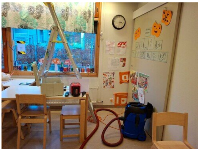
Kuva 10 Rakenneavaukset RA5 ja RA6 sijoitettiin erkkerin viereen sisänurkkaan kohtaan, jossa havaittiin kattosadevesien pääsevän kastelemaan ulkoseinärakenteita.
