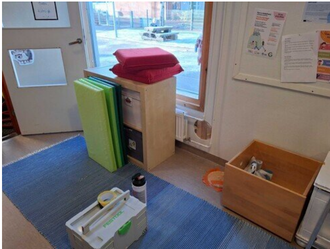
Kuva 26 RA13 tehtiin ikkunan alle seinän alaosaan. Kohdassa oli 3 vierekkäistä runkopuuta.
