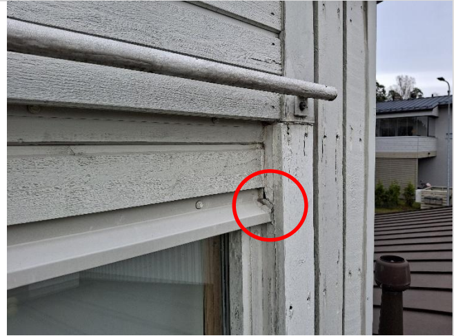
Kuva 36. Ikkunapellitysten tiiviydessä havaittiin puutteita. Kuva parven ikkunoista.
