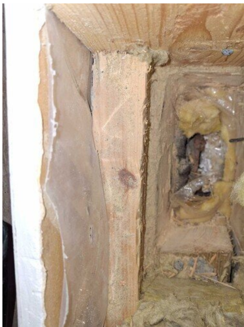
Kuva 3 Höyrynsulkumuovi loppuu lattianrajan kohdalla ja on auki alaosasta.
