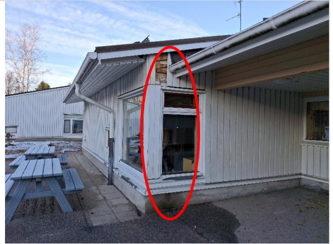
Kuva 10. Tilan 137 ulkokulmassa sadevesikourun päästä tip-puu vettä ulkoseinärakenteita päin.
