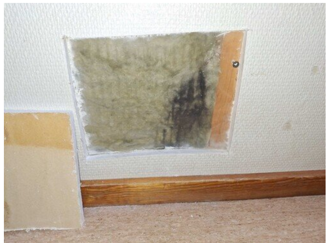
Kuva 35 Lämmöneristeissä havaittiin erittäin paljon ilmavuotoon viittaavia tummentumia.
