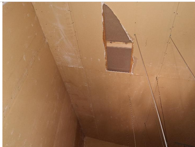
Kuva 47. Katon kipsilevytyksissä oli reikiä. Kuva on eteisestä 153.
