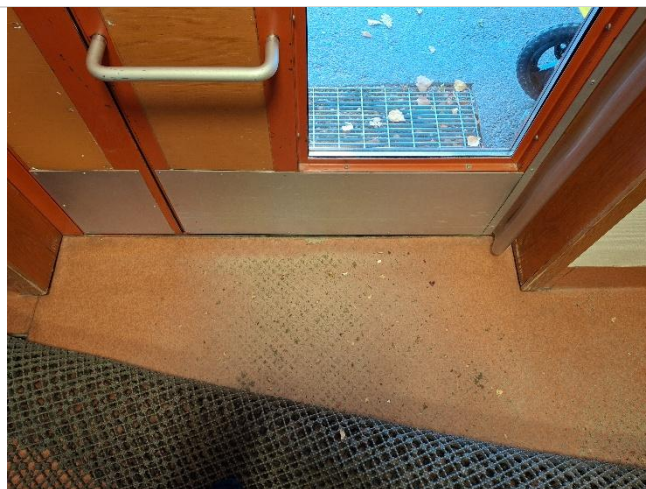
Kuva 16. Kuraeteisten muovimatot olivat kuluneita, kuva tilasta 112. Useissa kuraeteisissä havaittiin pienillä aloilla poikkeavia pintakosteusarvoja.
