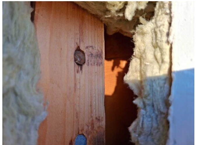
Kuva 20 Eristeet olivat huonosti asennettu rakenneliitoksen kohdalla.
