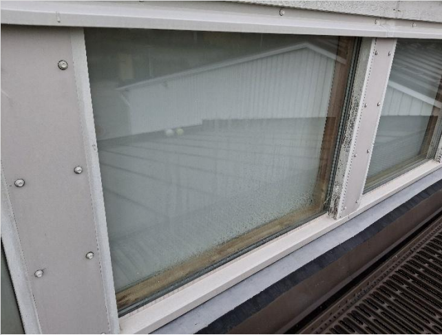
Kuva 35. Parven ikkunoiden ulkolasin sisäpintaan on tiivistynyt kosteutta. Kuvassa tilanne 31.10.2024, ko. lasi oli alareunasta rikki.
