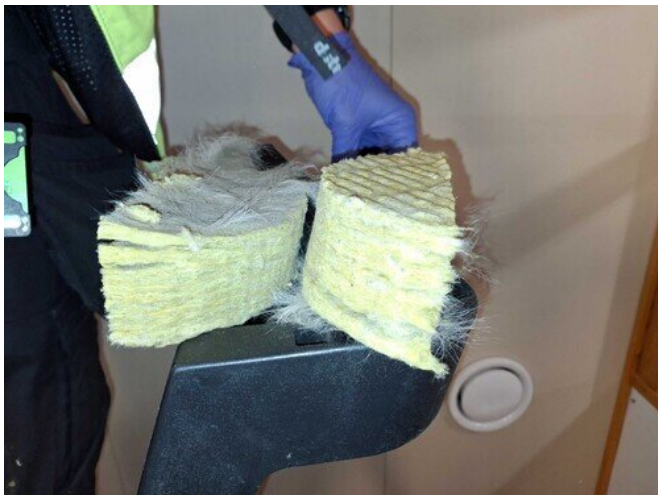
Kuva 43 Lämmöneristeet olivat hyväkuntoiset.
