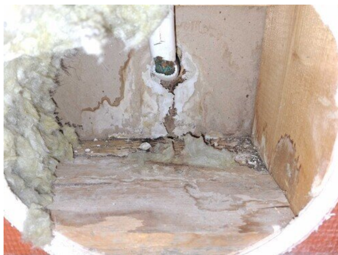
Kuva 48 Kipsilevyssä, alaohjauspuussa ja eristevillassa havaittiin vaurioita.
