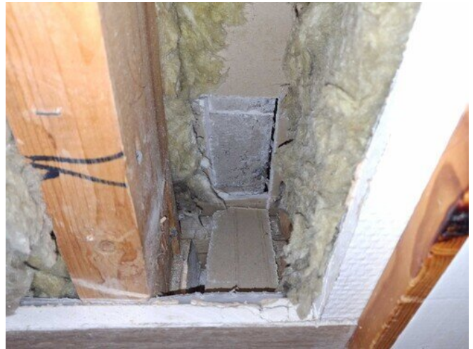
Kuva 13 Tuulensuojalevyn ja sokkelin välissä ei ollut ilmarakoa.
