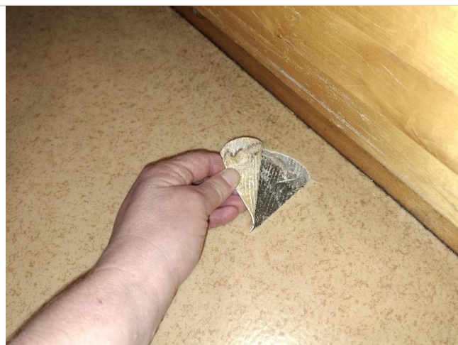
Kuva 20. Käytävän 191 muovimatto oli kohdassa VK3 vaurioitunut. Keittiön vastaisen seinän sisällä kulkee kupariputki ja sen läpivienti, seinärakenteen alaosassa (RA16) oli vanhan vesivahingon jälkiä, johon muovimaton vaurioituminen viittaa.
