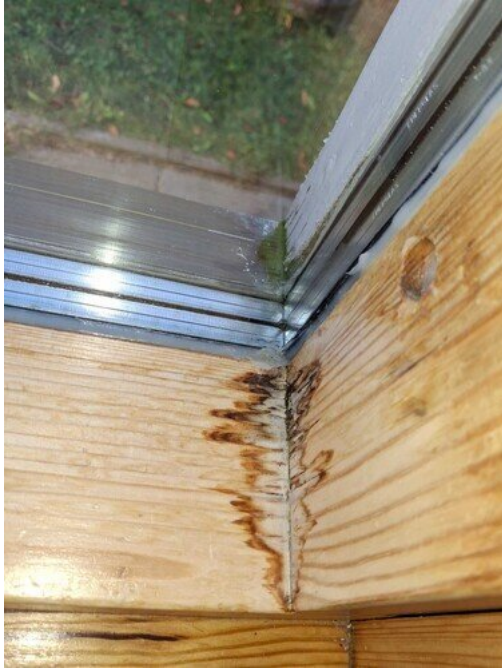
Kuva 5 RA1 kohdalla ikkunan ulkopuitteessa kasvoi sammalta ja puuaines oli lahonnutta. Sisäpuolella oli kosteusjälkiä. Ikkunan pintaan todennäköisesti tiivistyy vettä, kun huoneessa levätään ja tiiviit verhot ovat ikkunoiden edessä.
