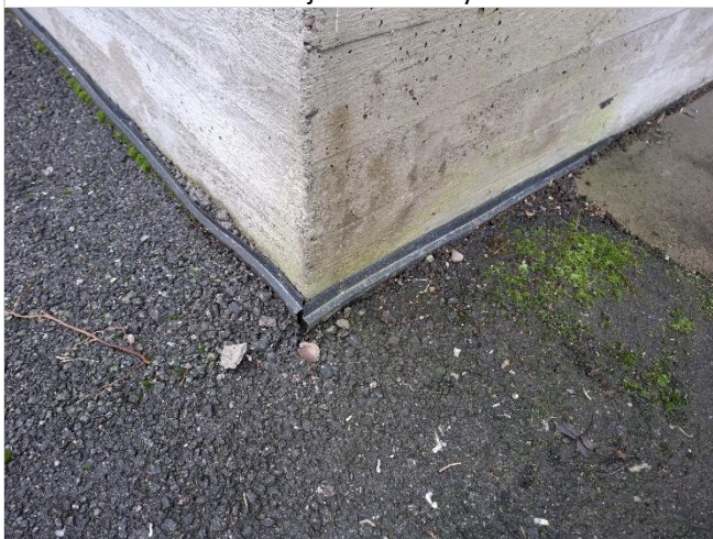
Kuva 7. Sokkelin vedeneristeen yläpeitelista on useista kohdista irti alustasta.
