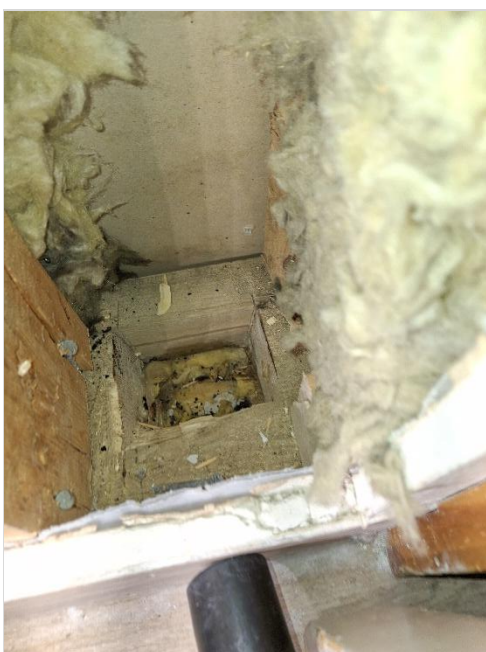
Kuva 33. Rakenneavaus RA6 tehtiin tilan 162 ulkoseinän alaosaan. Ulkopuolella havaittiin, että kattoliitoksessa sadevesikourun päästä tiputteli vettä ulkoseinälaudoitusta päin. Tuulensuojalevyn alaosa, alaohjauspuun alaosa ja sen alla oleva villakaistale olivat märät. Materiaalinäytteissä MA6 ja MA7 havaittiin mikrobikasvua.
