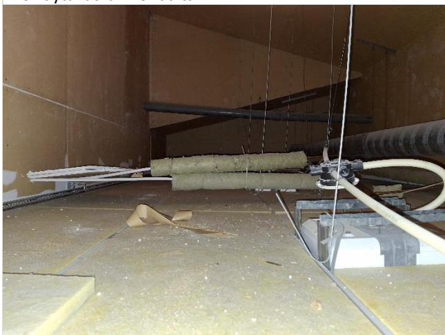
Kuva 48. Käytävän alas laskujen päällä havaittiin paljon epäpuhtauksia.
