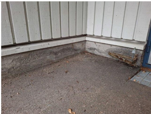
Kuva 4. Betonisokkelin pinta oli paikoin rapautunut.
