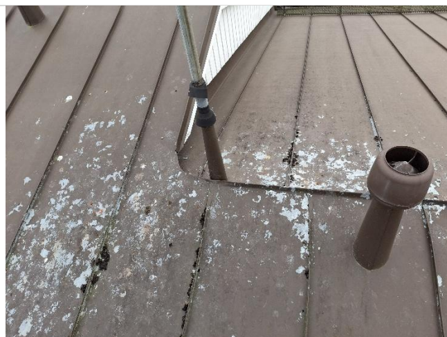
Kuva 51. Vesikaton maalipinta oli paikoin irronnut, todennäköisesti linnun ulosteet vaikuttaneet asiaan.
