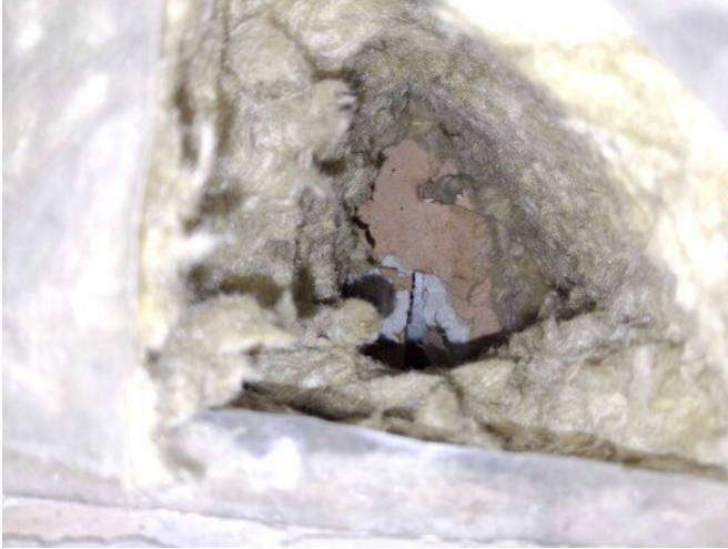
Kuva 8 Tuulensuojalevyssä oli halkeama, kohdassa on mahdollisesti sauma.
