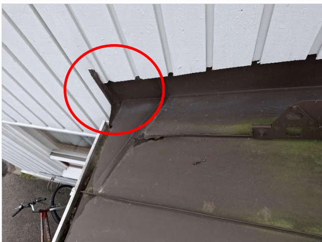
Kuva 54. Ulkoseinän rakenneavaus RA3, jossa havaittiin mikrobivaurio (M3), tehtiin sisäpuolelta ympyröityyn kohtaan. Pellitys oli kiinni haljenneessa tuulensuojakipsilevyssä ja sisäpuoleisessa kipsilevyssä oli hieman pullistumaa.
