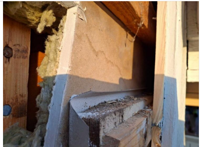
Kuva 30. RA 11 kohdalla vesikourun päästä tiputellut vesi oli kastellut tuulensuojalevyä ja julkisivulaudoituksen rakenteita. Lämmöneristeestä kerätyssä materiaalinäytteessä M11 ei ollut mikrobikasvua. Rännivesi kasteli myös sokkelia ja seinän alaosaan tehdystä rakenneavauksesta RA7 kerätyssä näytteessä MA6 havaittiin analyysissä mikrobikasvua.
