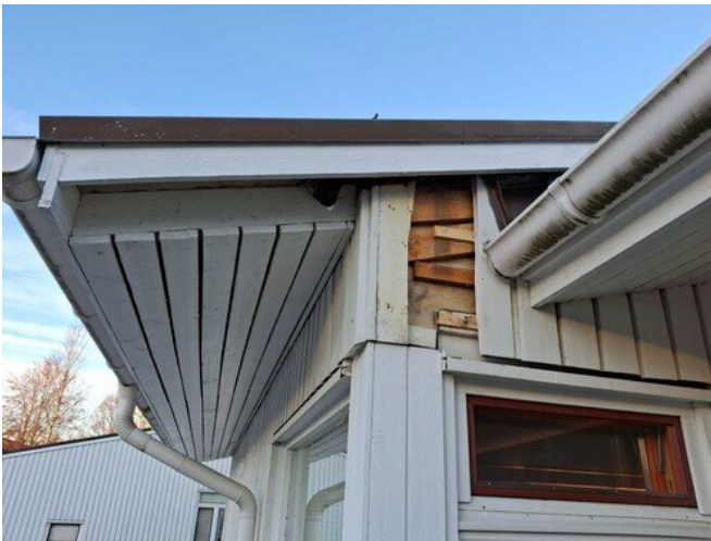
Kuva 19 Vesikourun pää on vuotanut vettä ulkoseinän rakenteisiin.
