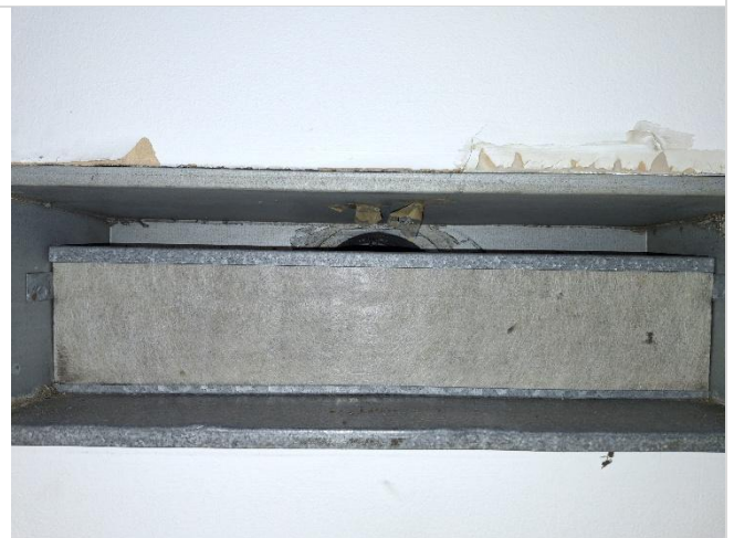
Kuva 66. Iv-kanavan sisällä (edessä näkyvän suodattimen takana) oli irrallinen säätöpelti ja likainen äänenvaimennin.
