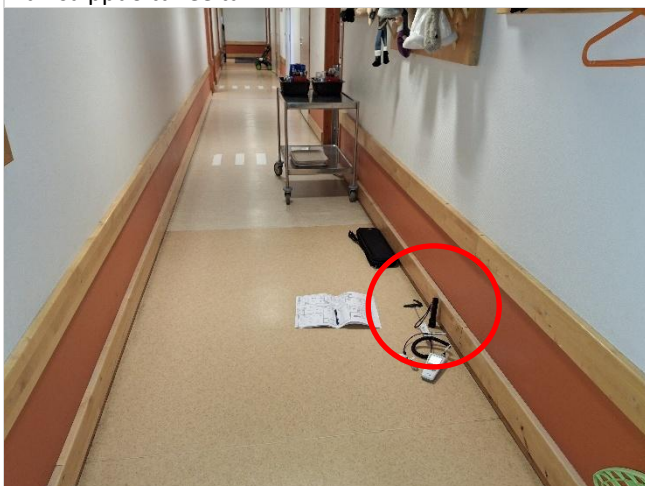
Kuva 19. Käytävään 191 on vaihdettu osa muovimattoja keittiön siivouskomerossa sattuneen vesivahingon jälkeen (vaaleampi muovimatto). Viiltomittaus VK3 tehtiin vanhalle osalle. Muovimaton alla havaittiin normaali suhteellinen kosteus 56,1 % RH, 20,2 °C, 9,8 g/m 3 .
