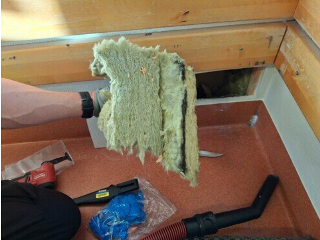
Kuva 30 Lämmöneristeen alapinnassa oli tummentumaa alaohjauspuiden liitoksen kohdalla.
