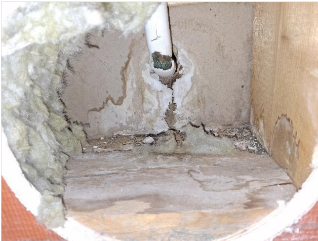
Kuva 37. Käytävään 191 keittiön vastaiseen väliseinään tehdyn rakenneavauksen RA16 kohdalla havaittiin vanha kuivunut vaurio.
