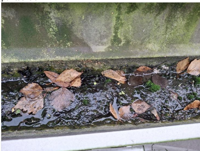
Kuva 50. Vesikourut olivat olleet pitkään puhdistamatta, kuvassa tilanne 31.10.2024.
