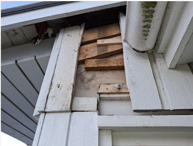
Kuva 29. Rakenneavaus RA11 tehtiin rakennuksen ulkopuolelta katon ja ulkoseinän liitokseen (tila 137). Ulkoseinärakenteen tuuletus ei toteudu ja tuulensuojalevytyksen ulkopinnassa havaittiin mikrobikasvustoa.
