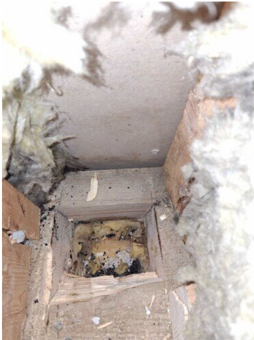
Kuva 12 Alaohjauspuun alle on päässyt vettä. Tuulensuojalevyn alaosa oli märkä.
