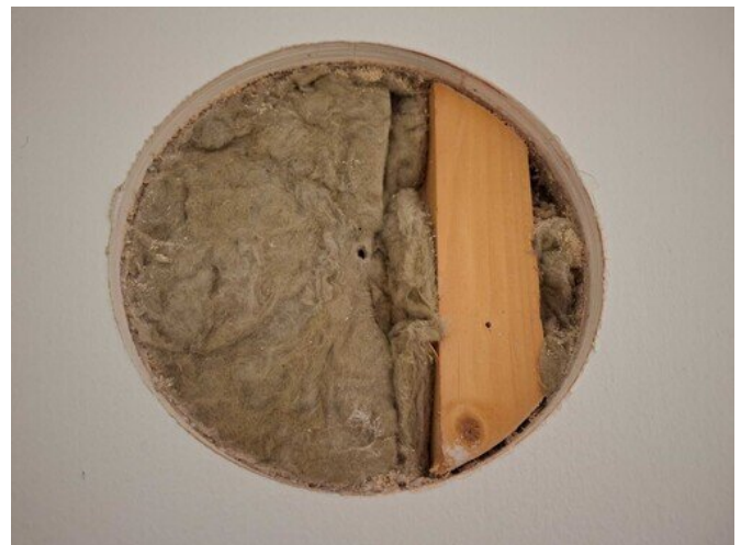
Kuva 23 Villojen asennuksessa puutteita. Tilkitty pienillä paloilla.
