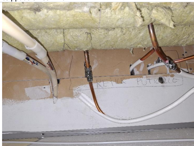
Kuva 43. Käytävien kohdalla kulkee talotekniikkaa. Vesiputkia on asennettu väliseinärakenteiden sisälle.
