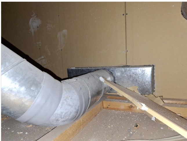
Kuva 46. Osassa tiloja katot on alas laskettu kipsilevytyksin, levyjen päällä havaittiin runsaasti epäpuhtauksia. Kuva on 146 käytävän kohdalta.
