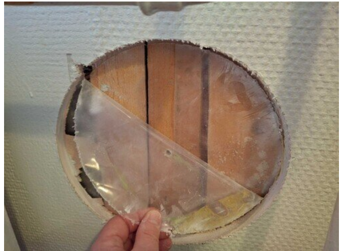
Kuva 27 Kolme vierekkäistä runkotolppaa. Höyrynsulku limittyi. Avauksesta ei nähty oliko lämmöneristettä runkotolppien takana.
