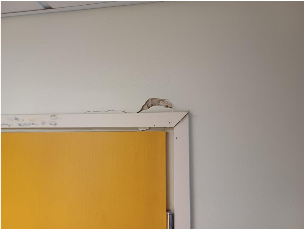
Kuva 4.5. 136 tekninen työ, käytävän puolella on seinän pintarappaus irtaillut oven yläpuolella.
