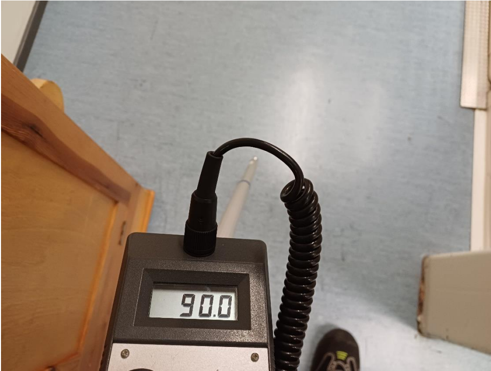
Kuva 4.2. 123 käytävä, lattiasta hissin ympäristössä, mitattiin pintakosteudenosoittimella kohonneita vertailuarvoja.
