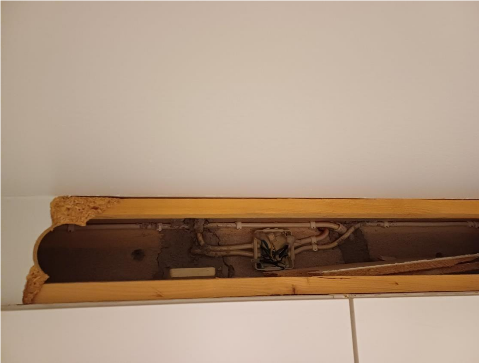
Kuva 4.8. 407 kylpyhuone, kaapiston yläsokkelilevy on osittain irrotettu.
