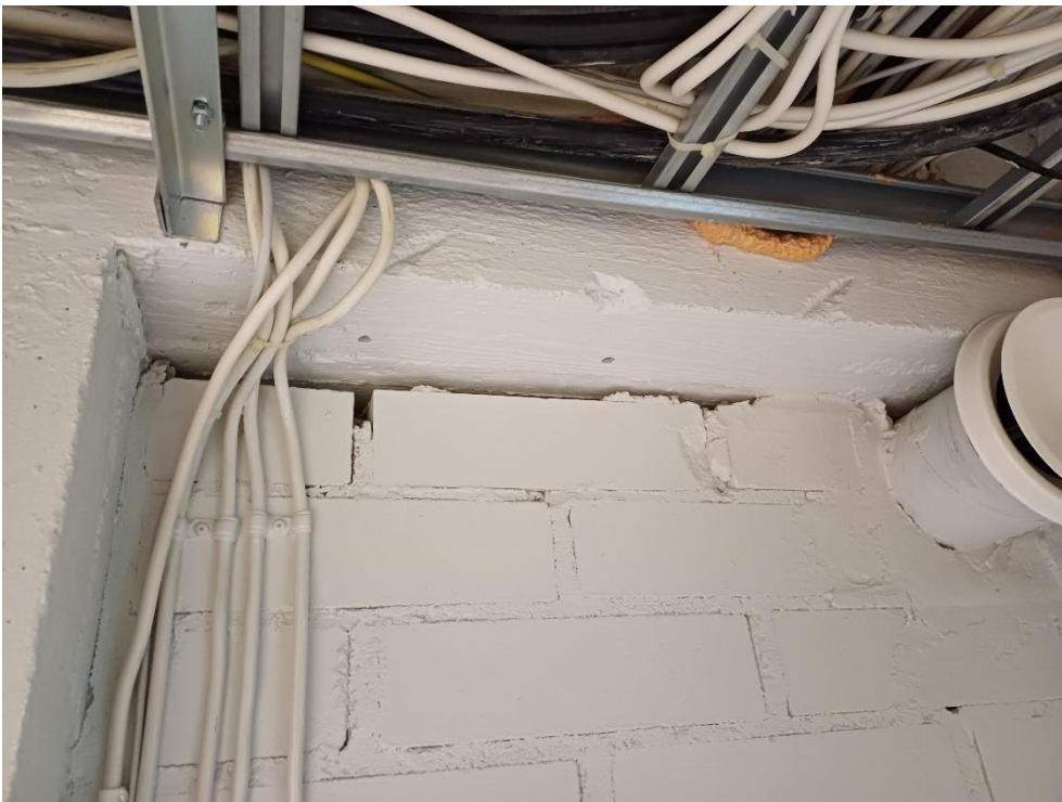
Kuva 4.3. 124 sähköpääkeskus, rakenneliittymät eivät ole tiiviitä ympäröiviin tiloihin.
