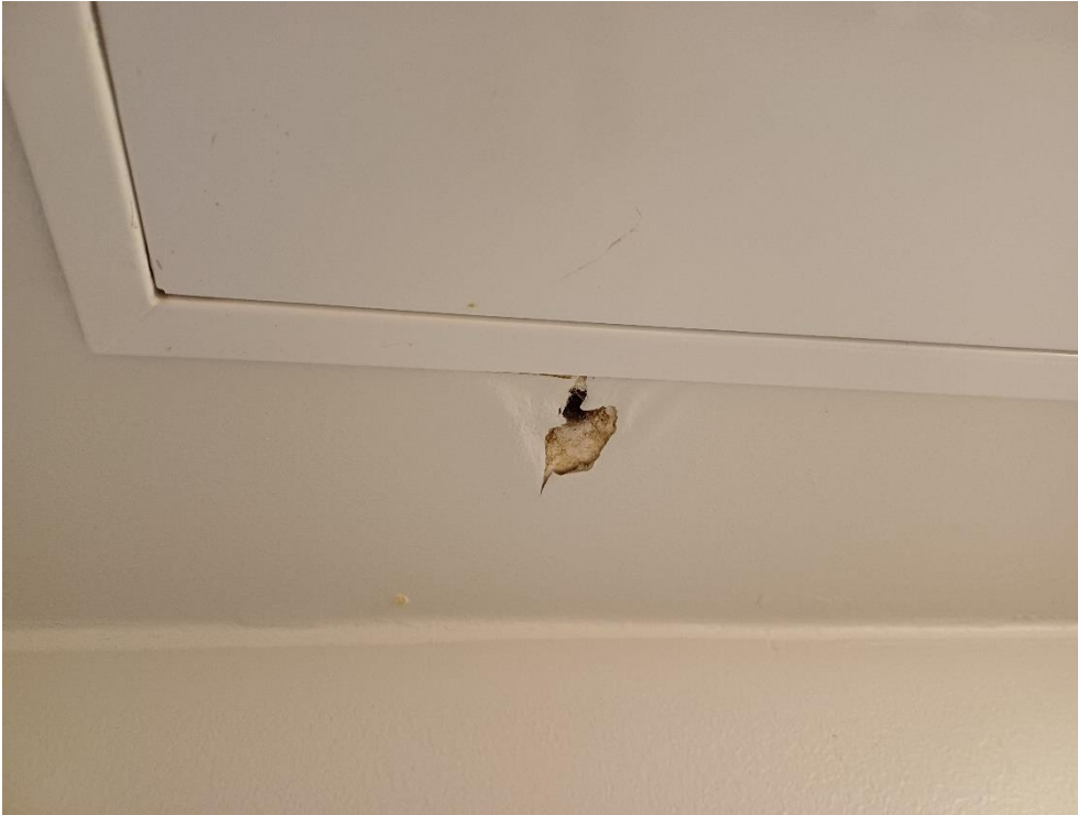
Kuva 4.4. 125 siivouskeskus, alakatossa tarkastusluukun vieressä on vanha kosteusvauriojälki.
