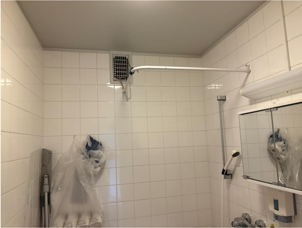
Kuva 5.1. Oppilashuollon tiloissa (erillinen rakennus) on ainoastaan painovoimainen poistoilmanvaihto wc tilojen kautta.
