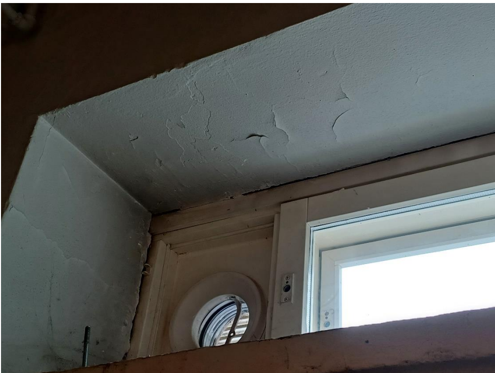
Kuva 4.1. 002 kattilahuoneessa on mm. avoimia ikkunaliittymiä, joista eristetilän kautta saattaa kulkeutua sisäilmaa heikentäviä hajuja tms. yläpuolella sijaitsevaan käsityöluokkaan 143.
