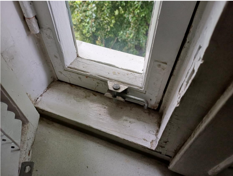
Kuva 4.7. Asuntola, ikkunat tarvitsevat kauttaaltaan huoltokunnostuksen.
