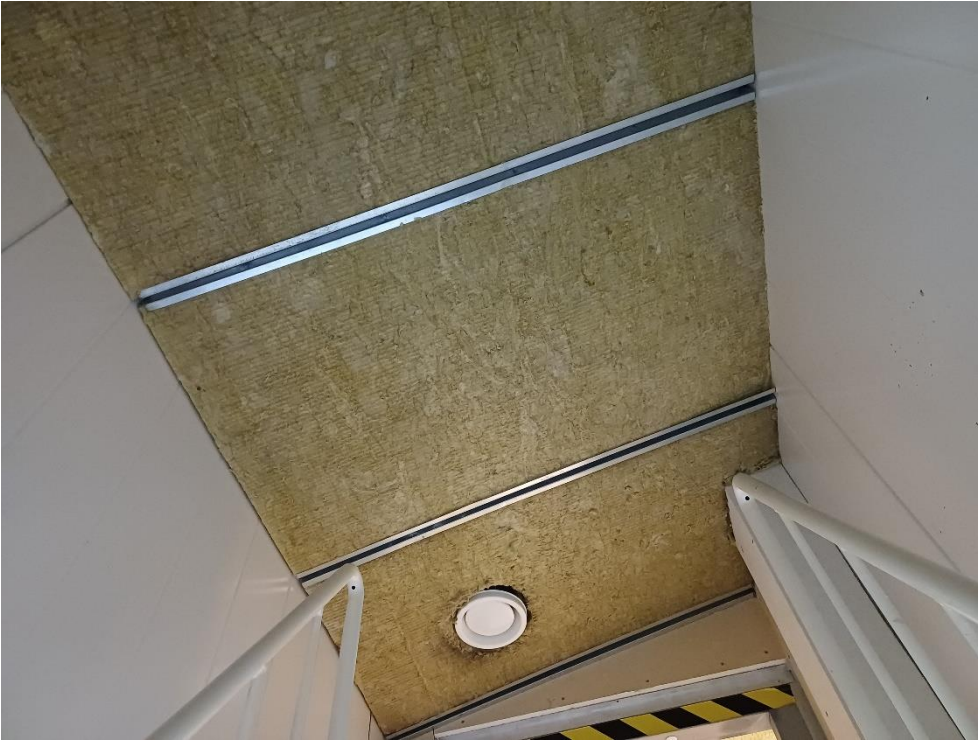
Kuva 4.6. IV-konehuoneeseen johtavan portaikon yläosan alakatossa on pinnoittamattomia mineraalivillalevyjä.
