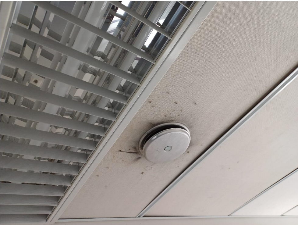
Kuva 4.11. 201 porrashuone, alakaton akustointilevy on likaantunut IV-venttiin ympäriltä.
