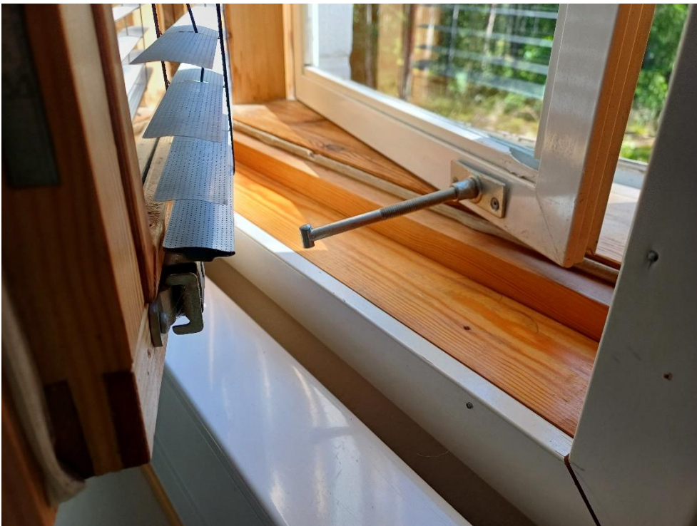
Kuva 4.17. Tuuletusikkunoiden aukipitolaitteita on rikkoutunut tai irti kiinnikkeistään molemmissa rakennuksissa.
