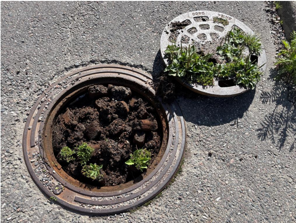
Kuva 5.1. Pihan sadevesikaivon sihti täynnä roskaa, tämä estää veden pääsyn kaivoon.
