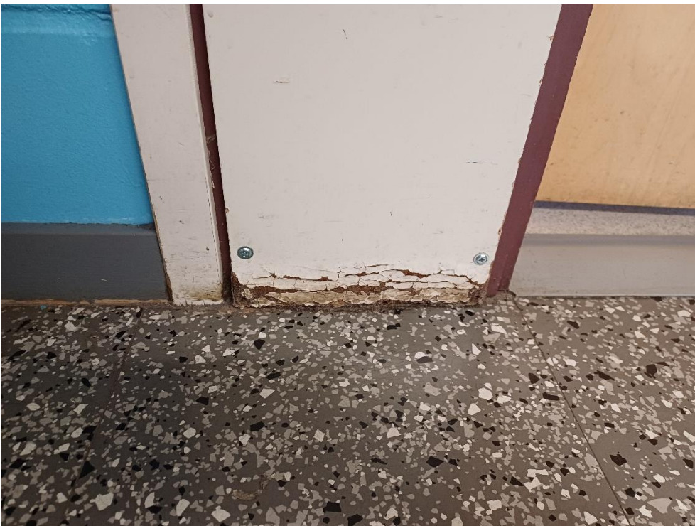
Kuva 4.7. Pohjakerroksen alueella on väliovissa sähköpielien alaosien kosteusvaurioita.
