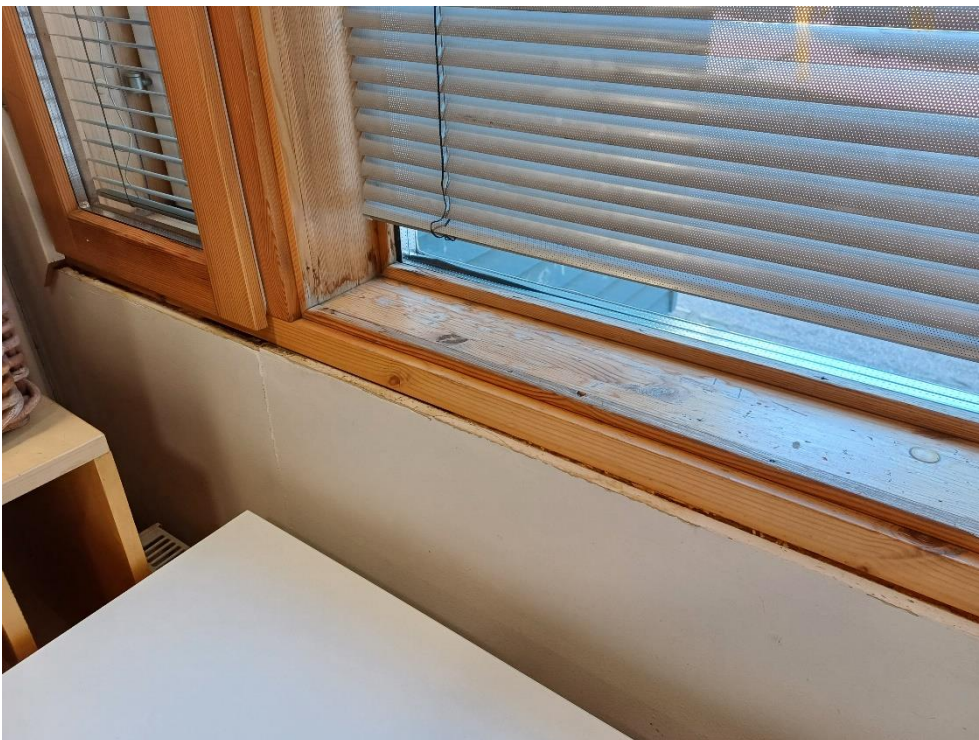
Kuva 4.19. 11 käytävä, ikkunan alapuolinen peitelista puuttuu.
