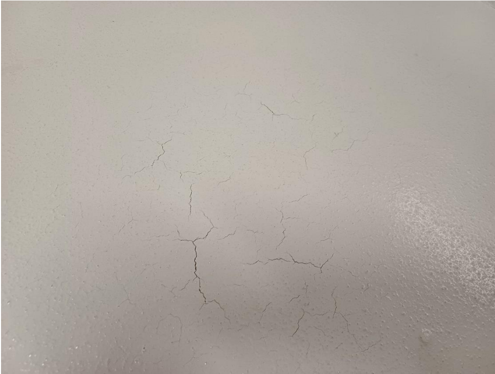
Kuva 4.4. 026 pesuhuone, lattiapinnoitteessa on runsaasti halkeamia.
