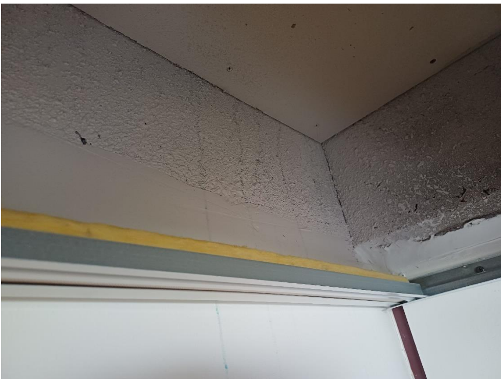
Kuva 4.1. 002 liikuntasalin vasemmanpuoleisen parioven vieressä, on seinässä valumajälkiä.
