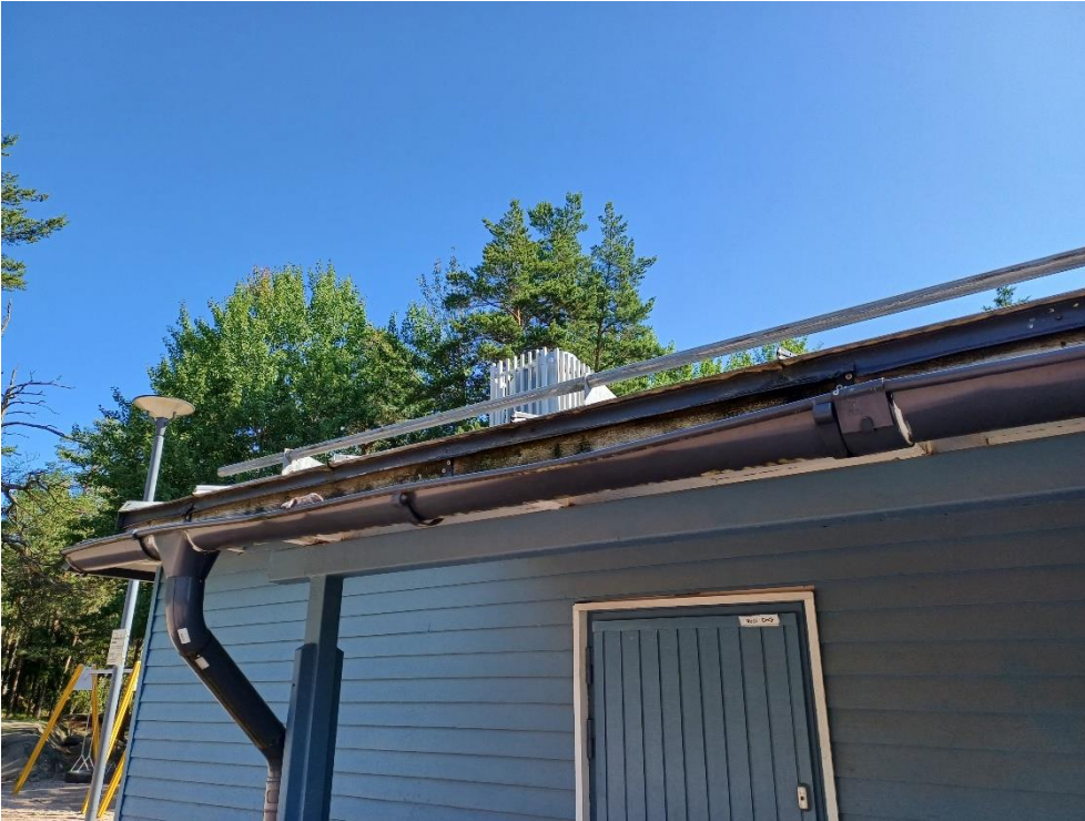
Kuva 4.20. Sisäänkäyntikatoksen sadevesikourussa on painaumia.
