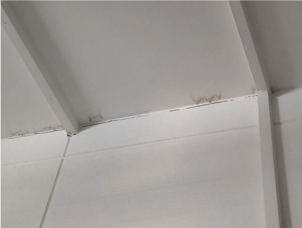
Kuva 4.18. Lisärakennuksessa on rakenneliittymien ratkeamia kaikissa luokkatiloissa.
