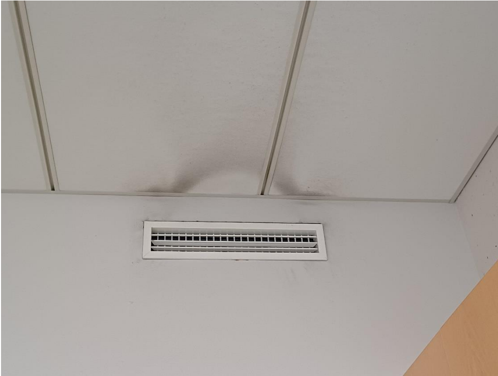
Kuva 4.14. 208 tekstiilityö, akustointilevyjä on likaantunut tuloilmapäätelaitteen kohdalla.
