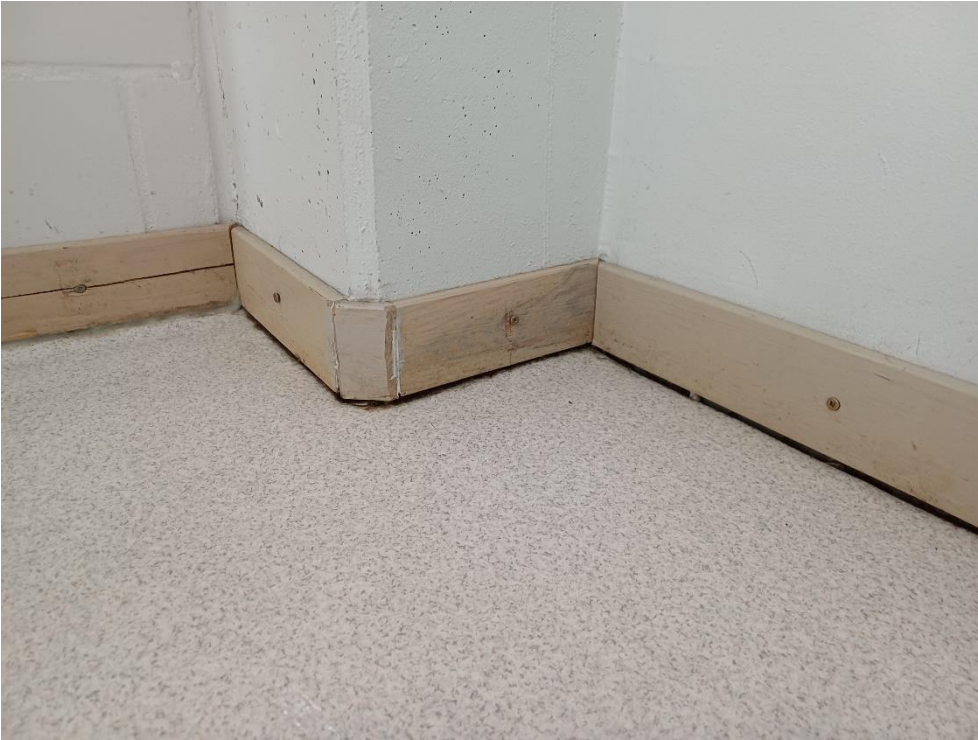
Kuva 4.6. Lattia on painunut alapäin tiloissa 049, 050, 051 ja 052.
