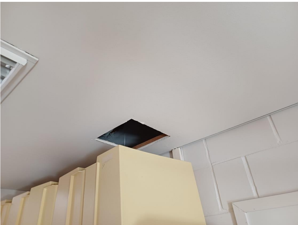
Kuva 4.13. 208 tekstiilityö, alakatossa olevan tarkistusluukun kansi puuttuu.
