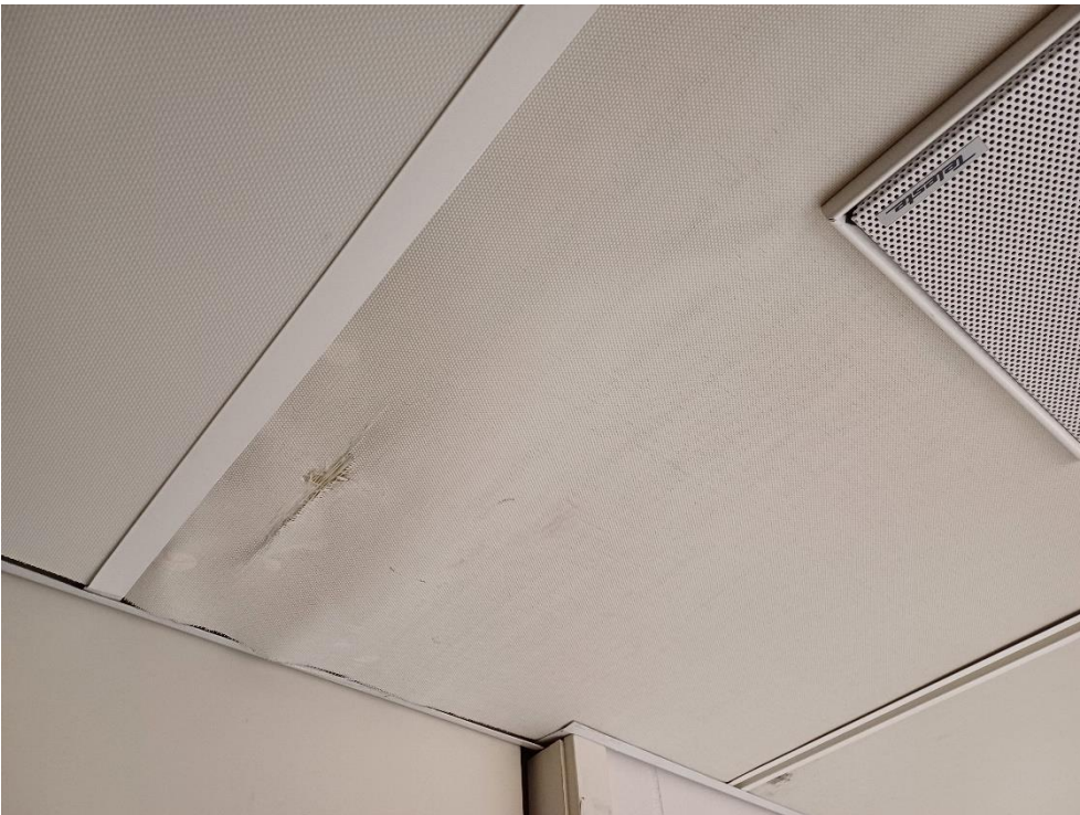
Kuva 4.3. 022 käytävä, alakaton akustointilevy on vaurioitunut.
