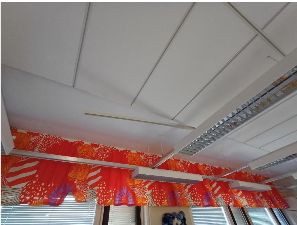
Kuva 4.15. 208 tekstiilityö, kattoon asennettujen akustointilevyjen reunalista on irtoamassa.
