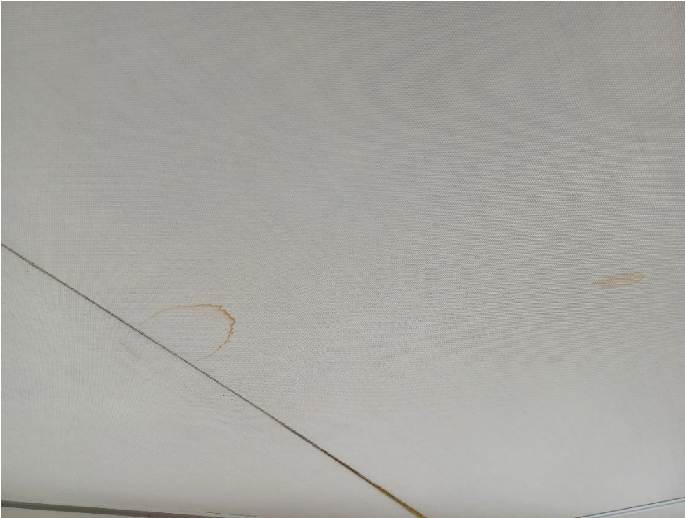
Kuva 4.12. 202 käytävä, alakaton akustointilevyissä on kosteuden aiheuttamia jälkiä.
