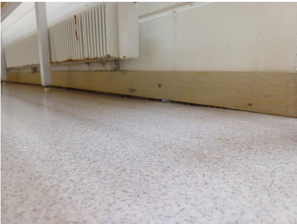
Kuva 4.5. 030 pukuhuone, lattia on painunut alaspäin.
