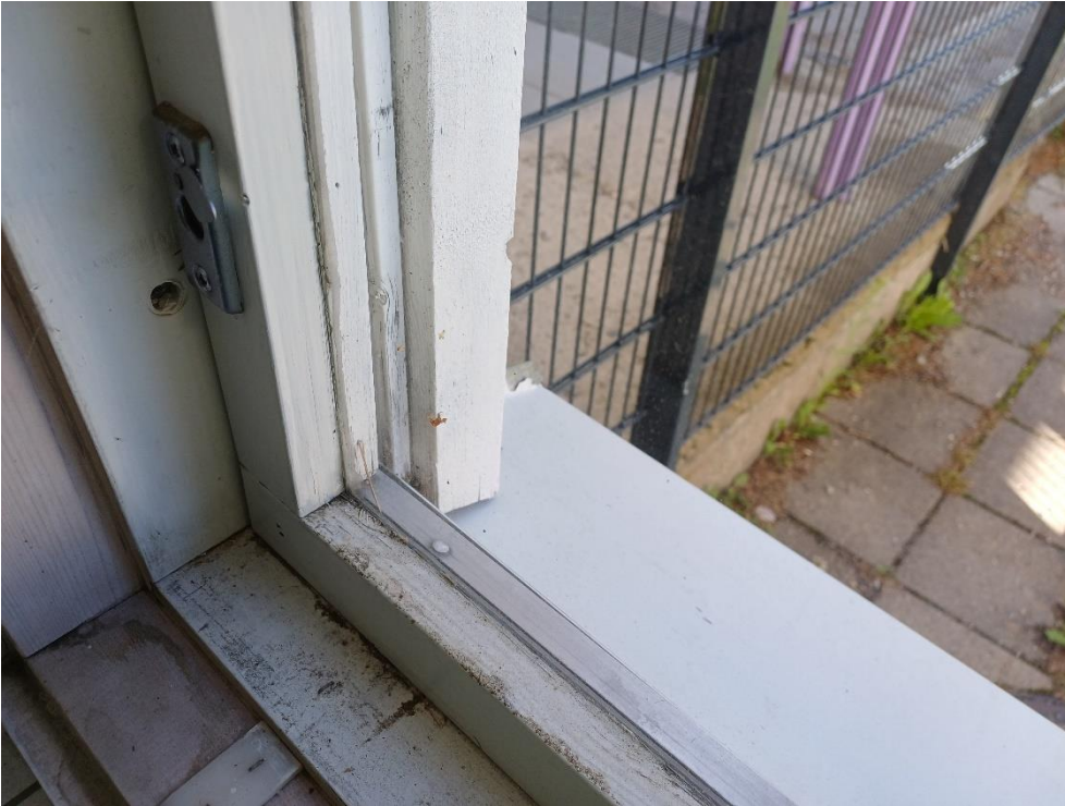
Kuva 4.8. 102 tuulikaapin 103 vieressä olevan ikkunan ulkopoka on juuttunut, eikä sulkeudu tiiviisti.
