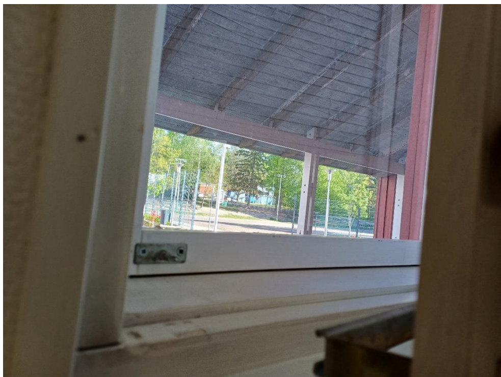
Kuva 4.6. C207 terveydenhoitaja, tuuletusikkunan aukipitolaite on rikkoutunut.
