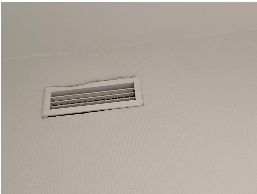
Kuva 4.3. C207 terveydenhoitaja, poistoilmapäätelaitteen kiinnitys seinäpintaan ei ole tiivis.
