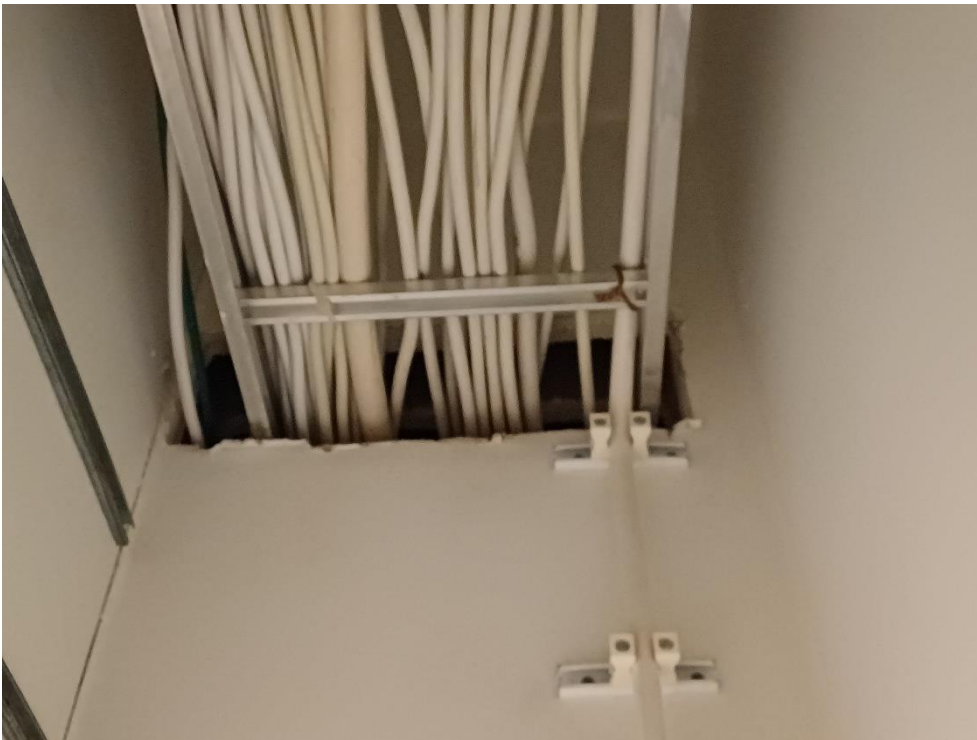
Kuva 4.1. C201A tekniikkatila, sähköjohtojen läpiviennit eivät ole tiiviitä.
