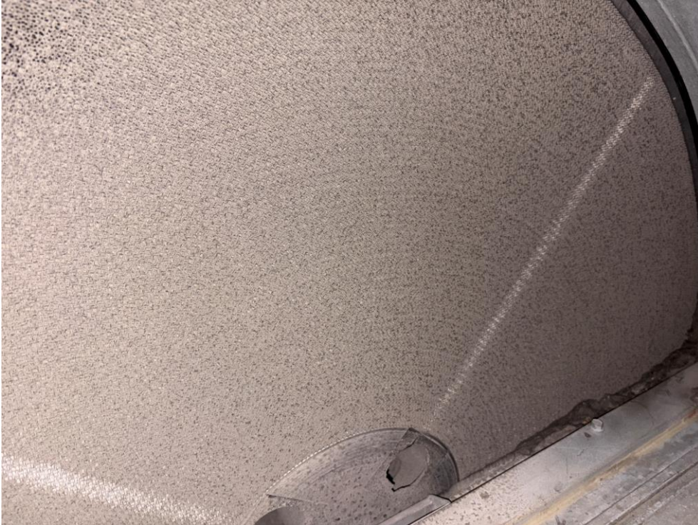
Kuva 5.1. Ilmanvaihtokoneen TK02 pyörivä lämmöntalteenottokenno on likainen.
