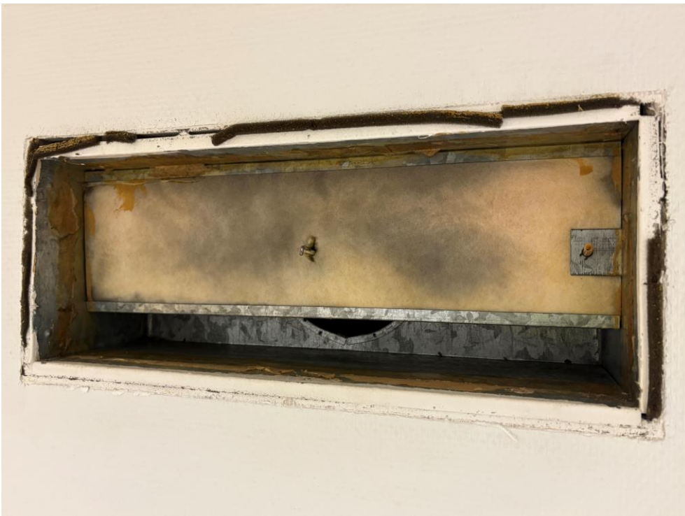
Kuva 5.2. Tuloilman päätelaitteiden sisällä on äänenvaimennuksena käytettyä villaa. Rikkoutunut villapinta saattaa päästää kuituja sisäilmaan.
