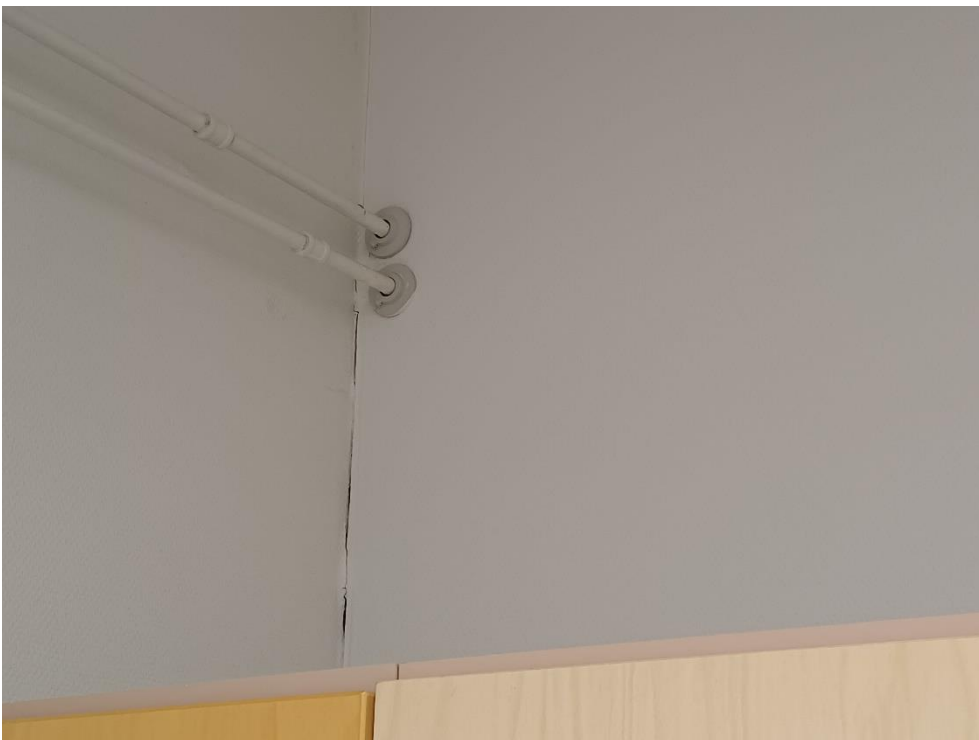
Kuva 4.5. C207 terveydenhoitaja, rakenneliittymien ratkeamia.
