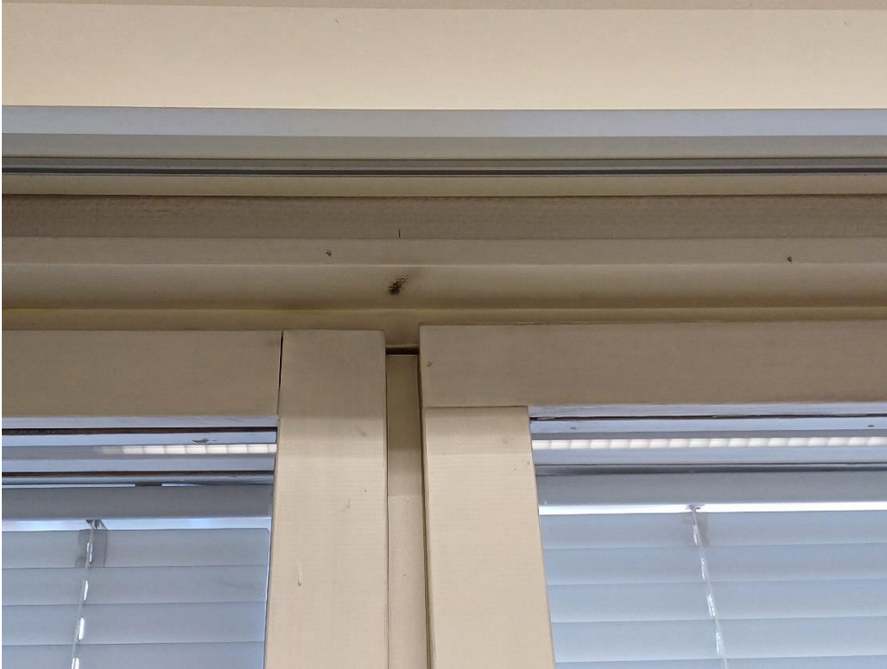
Kuva 4.4. C207 terveydenhoitaja, ikkunakarmi-seinäliittymät sekä ikkunan karmirakenne eivät ole tiiviitä.
