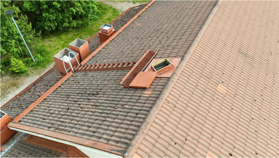
Kuva 5.2. Katon huoltoluukku on pois paikaltaan.
