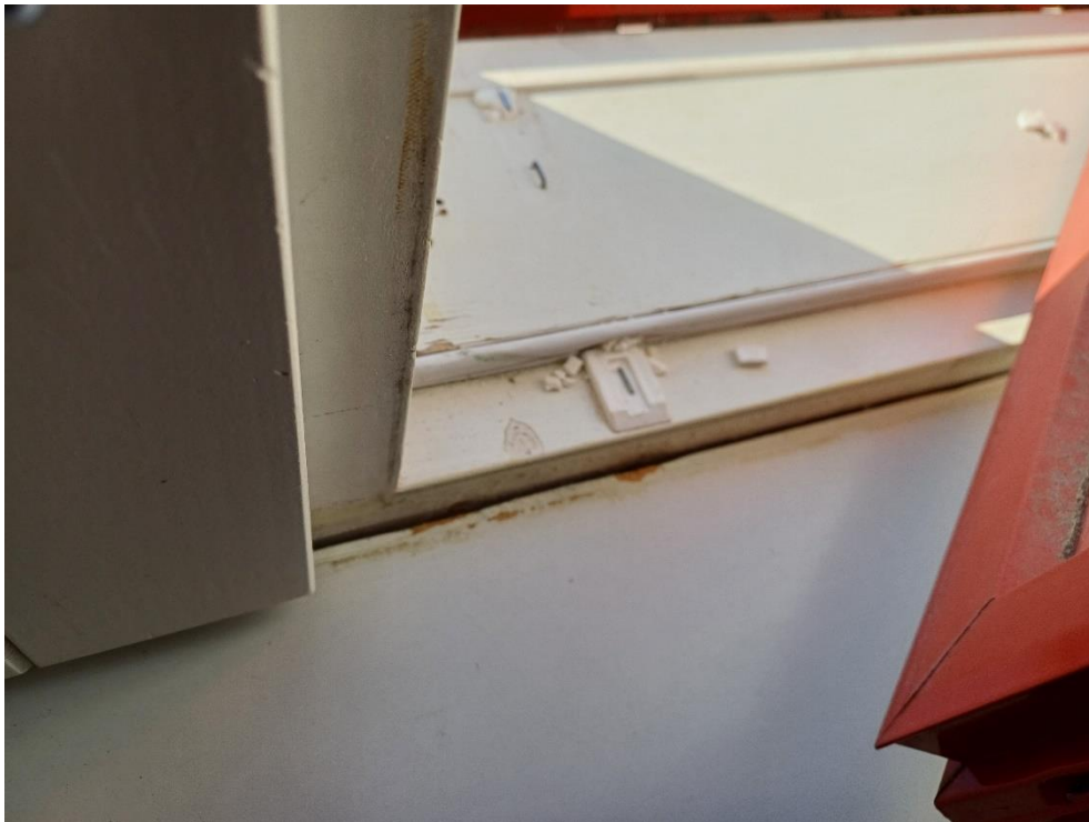
Kuva 4.1. 005 ja 006 ikkunakarmi /ikkunapenkkien liitokset eivät ole tiiviitä.
