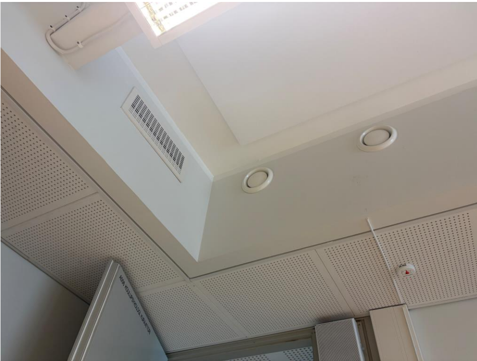
Kuva 5.3. Tulo ja poistoilmapäätelaitteet ovat lähekkäin toisiaan tilassa A006.
