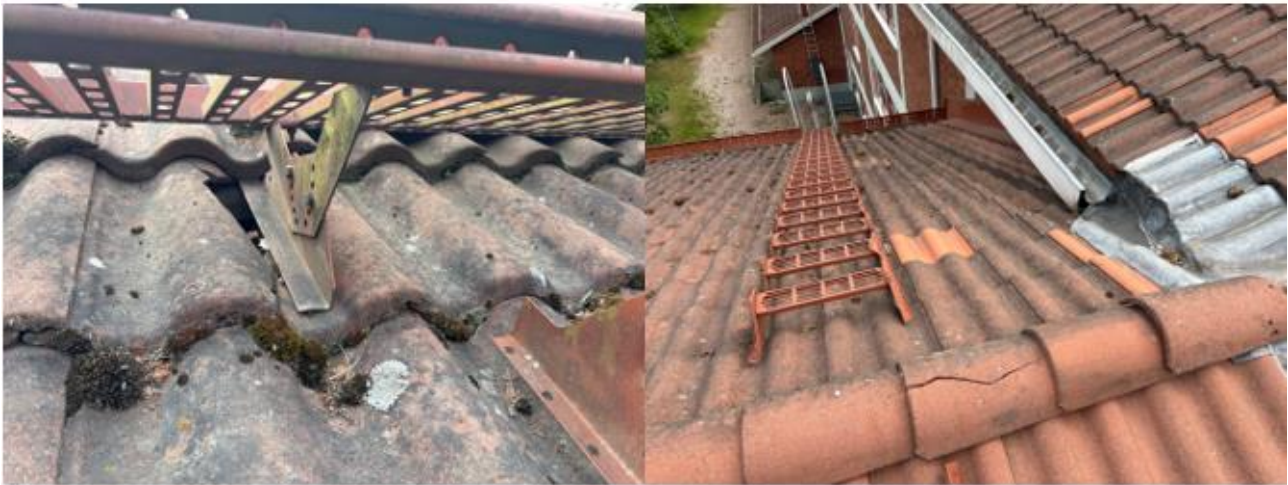
Kuva 4.3. Kattotiiliä havaittu olevan halki 2 kpl.
