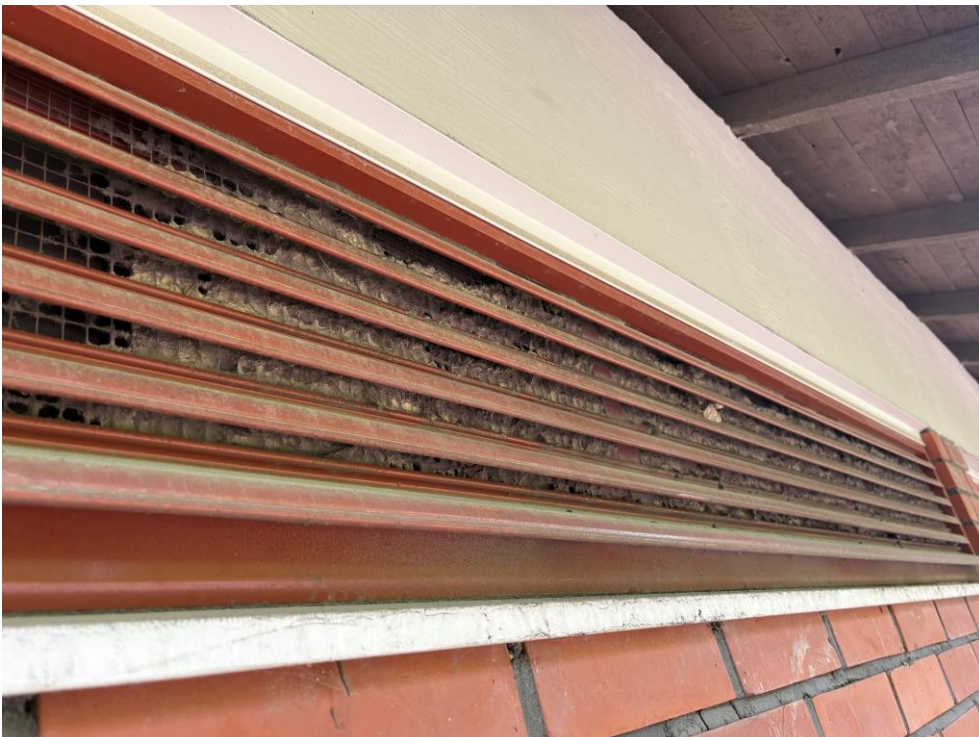
Kuva 5.1. Ilmanvaihtokoneen TK2 (tekstiilityö ja taideluokka) raitisilmasäleikkö on tukossa lehdistä ja muusta roskasta.
