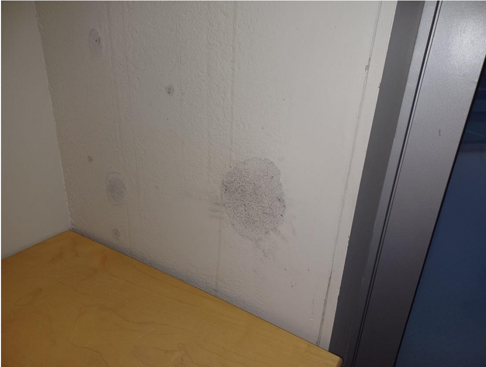
Kuva 4.2. 102 Aula, seinämaalaa irtoilee paikoittain.
