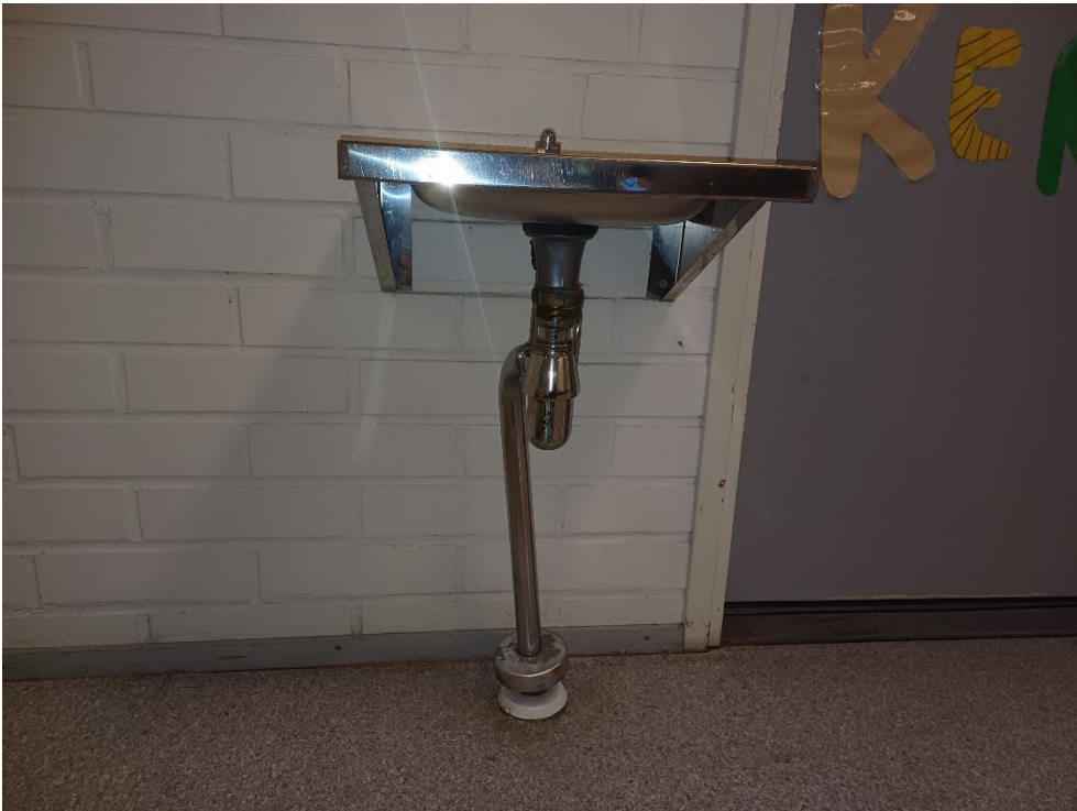
Kuva 4.1. 102 Aula, juomavesipisteen viemäröinnin kannakointi on puutteellinen.
