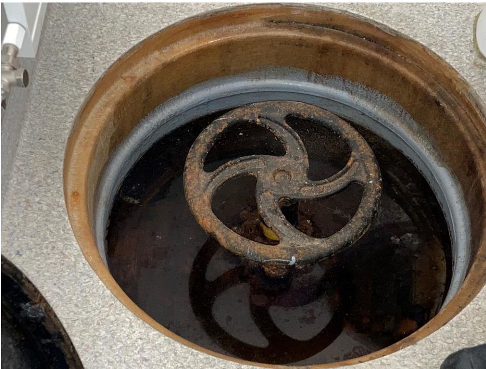
Kuva 5.1. Väestönsuojan sulkuventtiilikaivon pohjalla on vettä, vesi kaivossa ruostuttaa venttiiliä ja saattaa pidemmän päälle alkaa haisemaan.
