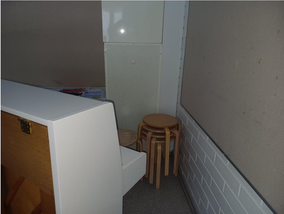
Kuva 5.2. Luokka 111 tuloilmapäätelaitteiden edessä on kalusteita, jotka haittaavat tuloilmaa huuhtelemasta luokkatilaa suunnitellulla tavalla.
