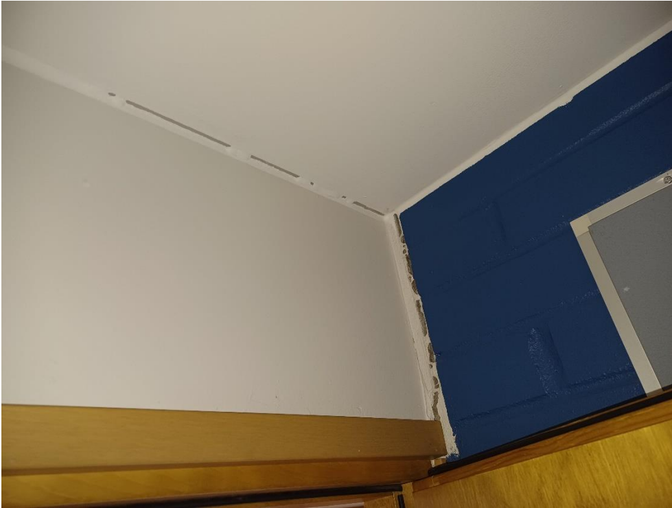
Kuva 4.6. Laajennusosan alueella on halkeamia ja rakenneliittymien ratkeamia lähes kaikissa tiloissa.
