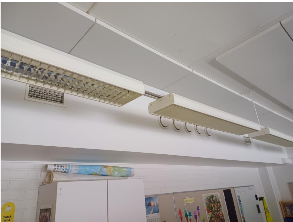
Kuva 5.3. Luokka 110 Kattovalaisimien kotelot on asennettu siten, että ne haittaavat ilmankiertoa tulo- ja poistoilmapäätelaitteiden osalla.
