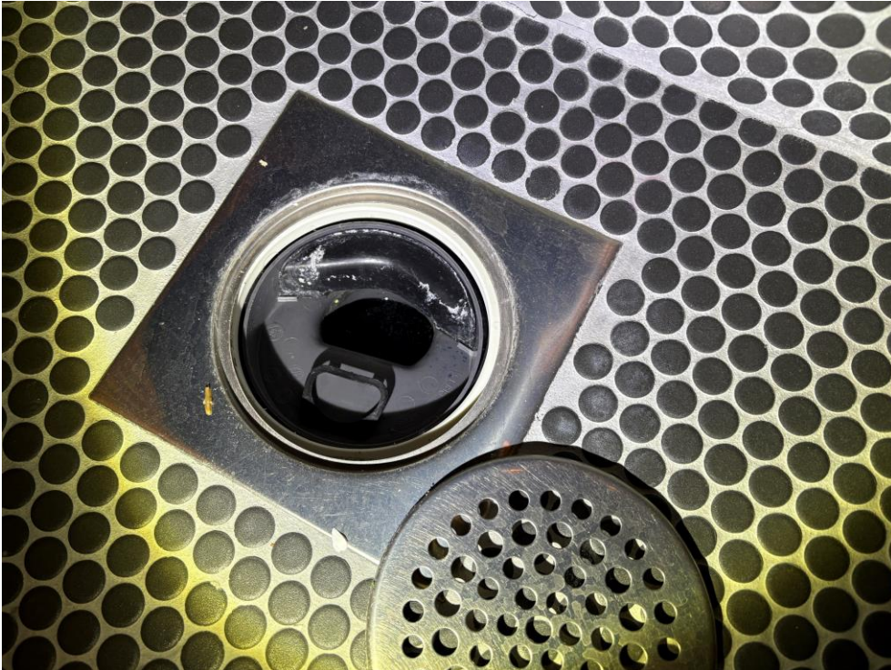
Kuva 5.1. Lattiakaivo ei ole paikallaan lasten wc tilassa 235. Kaivon kautta pääsee tilaan viemärinhajua.
