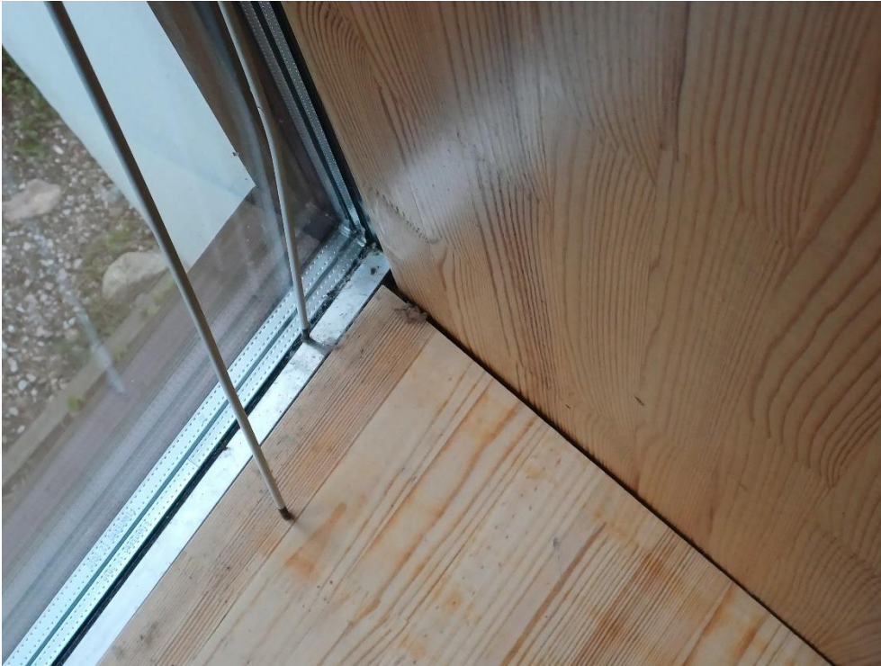
Kuva 4.4. Sisäpihan puoleisissa ikkunarakenteissa on rakoja, joista saattaa olla ilmayhteys eristetilaan.
