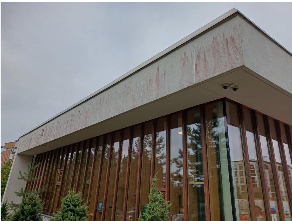
Kuva 4.7. Julkisivussa on paikoitellen viherleväkasvustoa.
