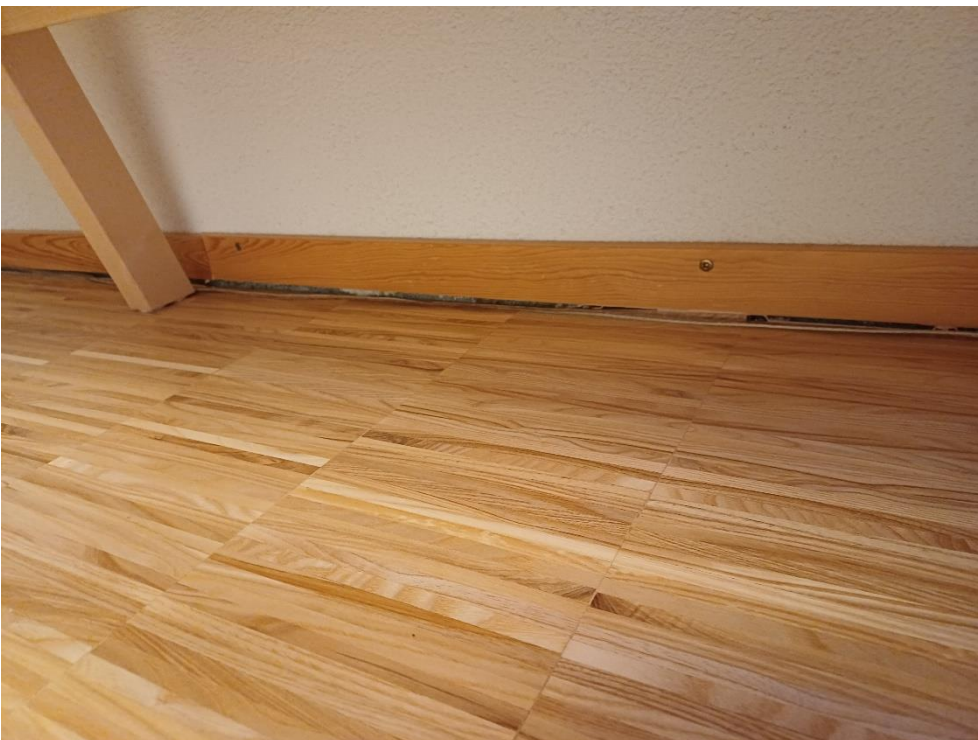
Kuva 4.3. Parkettilattian-jalkalistojen välissä on kaikissa tiloissa rakoja, joista saattaa olla ilmayhteys ulkoseinärakenteisiin.
