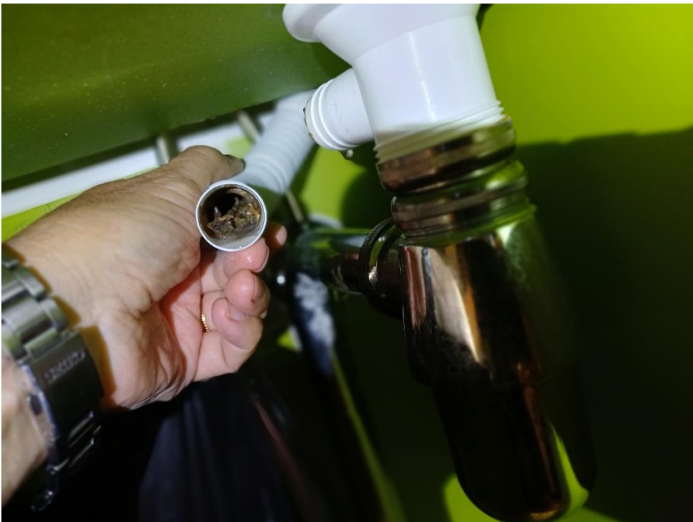
Kuva 5.6. Ryhmähuoneiden yhteydessä olevien pesutilojen vesipisteiden ylivuotoputkissa on runsaasti sakkaa, joka saattaa aiheuttaa tunkkaista maakellarimaista hajua tiloihin.
