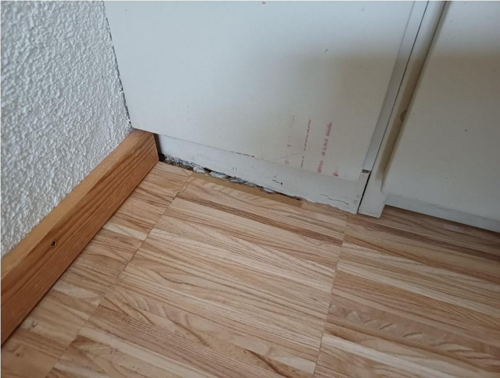
Kuva 4.2. 238 Ryhmähuone, jalkalistan osa puuttuu.
