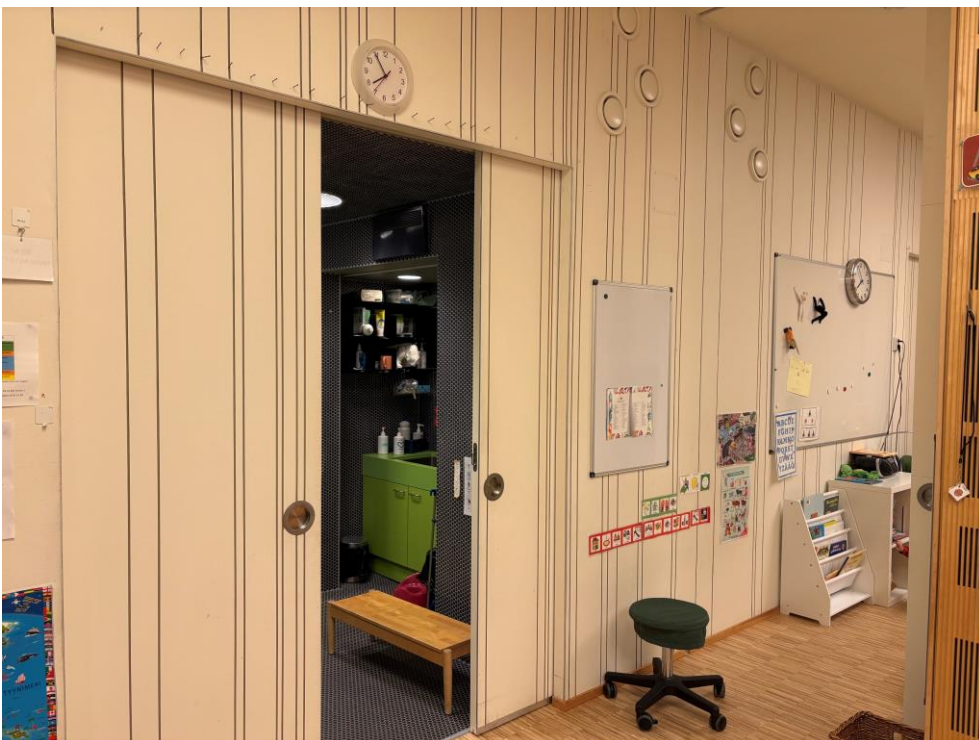
Kuva 5.2. WC tilat ryhmähuoneissa ovat havaintojen mukaan pääosin auki, jolloin hajut wc tiloista voi päästä leviämään ryhmähuoneiden puolelle.
