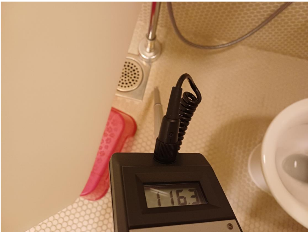
Kuva 4.5. Ryhmähuoneiden yhteydessä olevien pesutilojen lattiosta mitattiin pintakosteudenosoittimella kohonneita vertailuarvoja. Kohonneet pintakosteudet johtuvat todennäköisesti tilojen runsaasta käytöstä.
