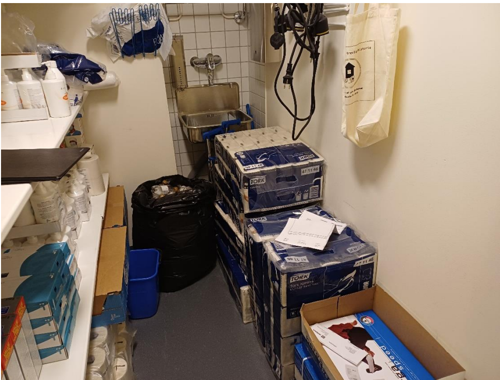
Kuva 4.1. 232 Siivouskomero, on otettu varastointikäyttöön. Tilassa olevan vesipisteen alla on lattiakaivo, joka kuivuessaan saattaa aiheuttaa viemärinhajua viereisiin tiloihin.
