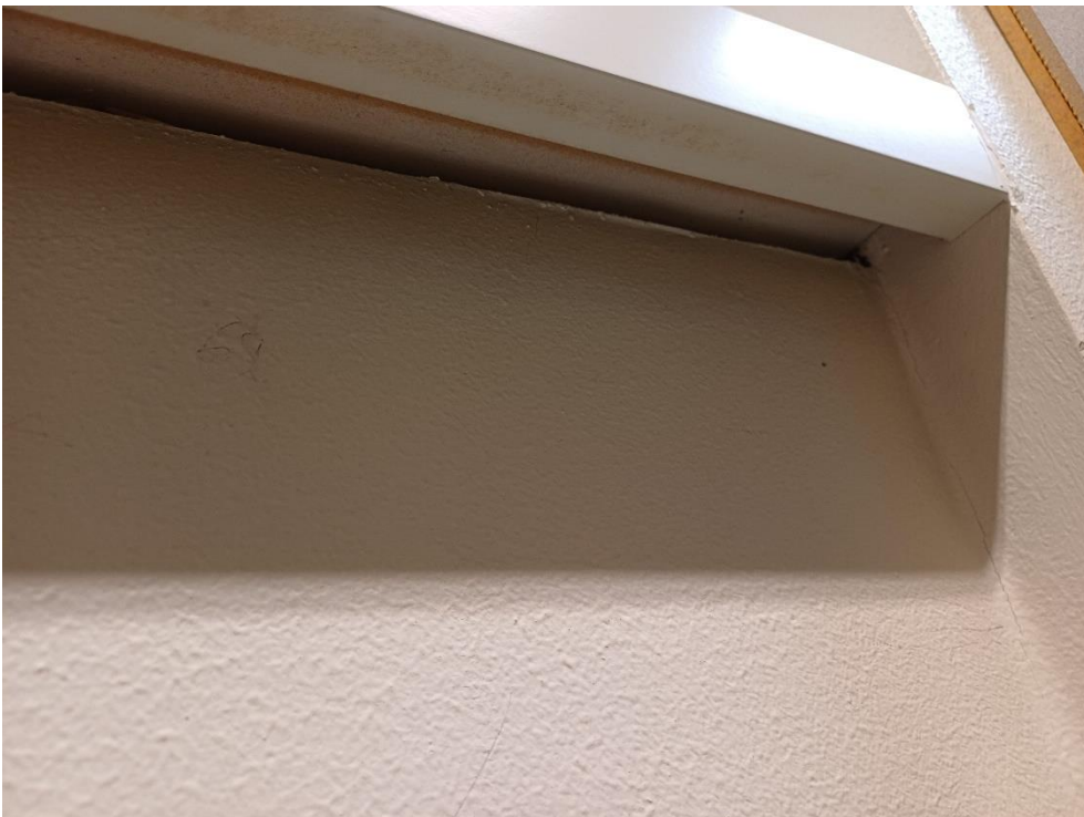
Kuva 4.5. A024, Ikkunapenkkien liitokset alapuolen seinärakenteisiin eivät ole tiiviitä.
