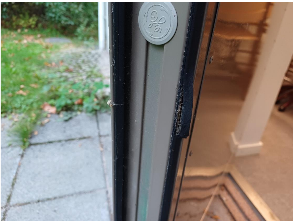
Kuva 4.3. Ulko-oven tiivisteet ovat kuluneita.
