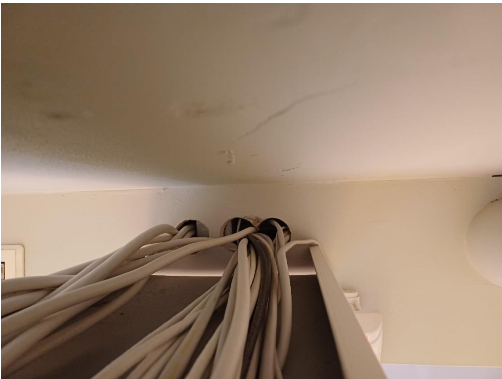
Kuva 4.1. A023, Sähkökaapeleiden läpiviennit rakenteisiin eivät ole tiiviitä.
