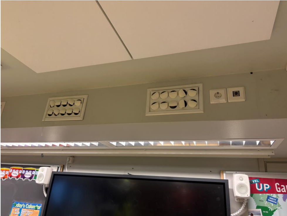
Kuva 5.1. Tuloilmapäätelaitteiden heittokuviot olivat sekaisin eikä tuloilma jakaantunut tasaisesti luokkahuoneeseen.
