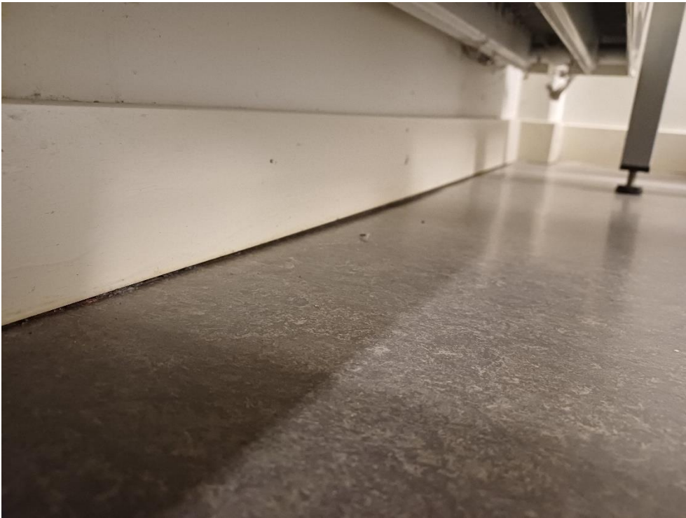
Kuva 4.2. Lattia on painunut hieman alaspäin ulkoseinän osalla.
