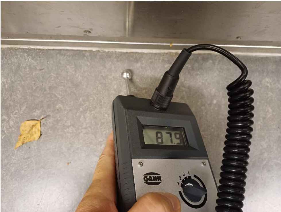
Kuva 4.4. Ulko-oven kohdalla lattiasta mitattiin pintakosteudenosoittimella hieman kohonneita kosteuksia.
