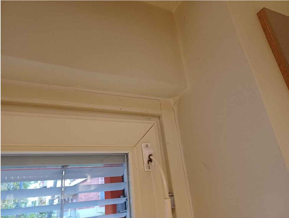
Kuva 4.6. Ikkunoiden ympärillä olevien tiivistyksien kittaukset rakoilevat.
