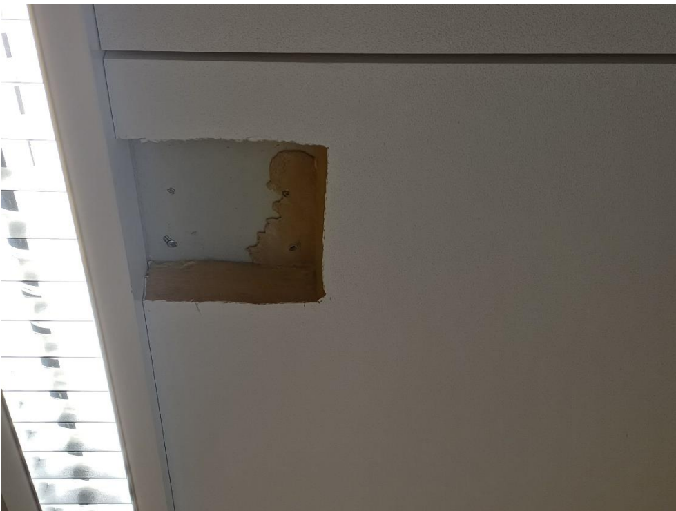
Kuva 4.7. Katon akustointilevyssä on pinnoittamatonta mineraalivillaa näkyvissä poistetun laitteen kohdalla.
