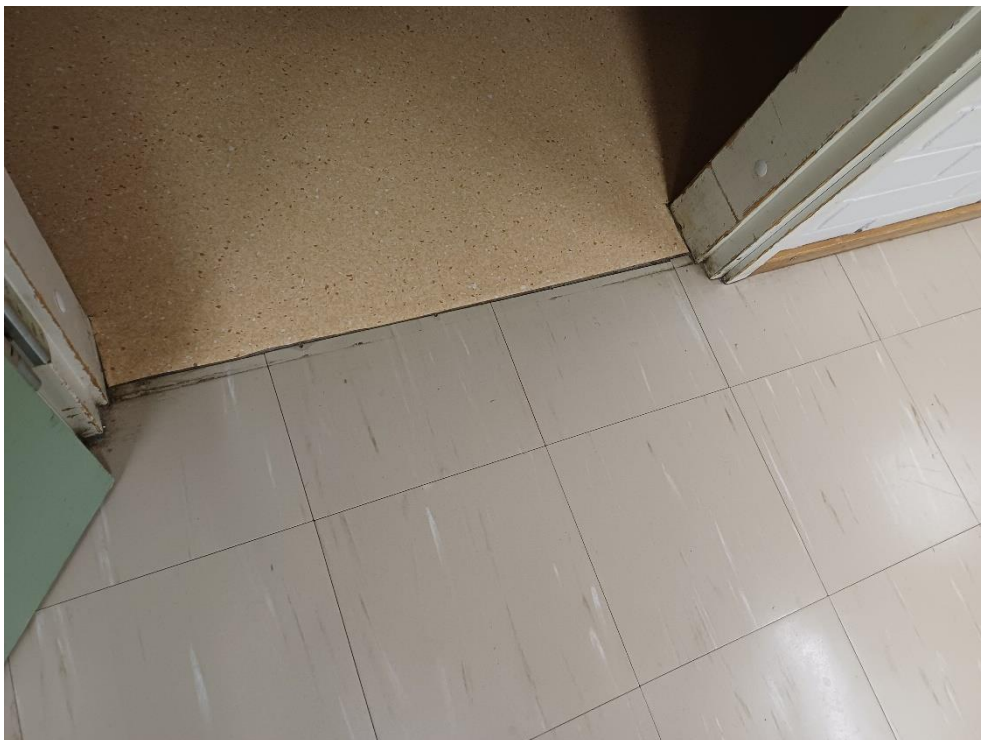
Kuva 4.11. 232 Siivouskomero, oviaukosta puuttuu kynnysosa.
