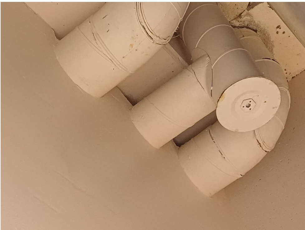
Kuva 4.2. 125 IV-konehuone, osa ympäröiviin tiloihin johtavista läpivienneistä eivät ole tiiviitä.
