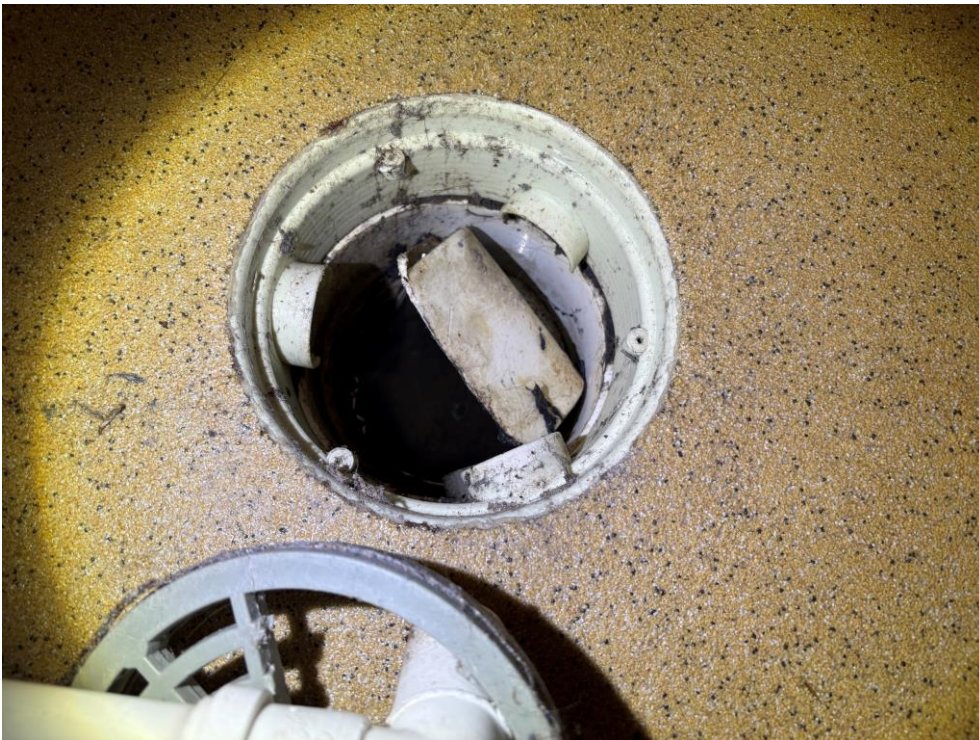
Kuva 5.1. Lattiakaivon hajulukko rikki siivouskeskuksessa 147.
