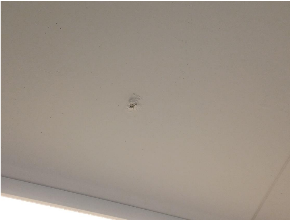
Kuva 4.7. 207 Monistamo, katossa on vanha pieni kosteusjälki.
