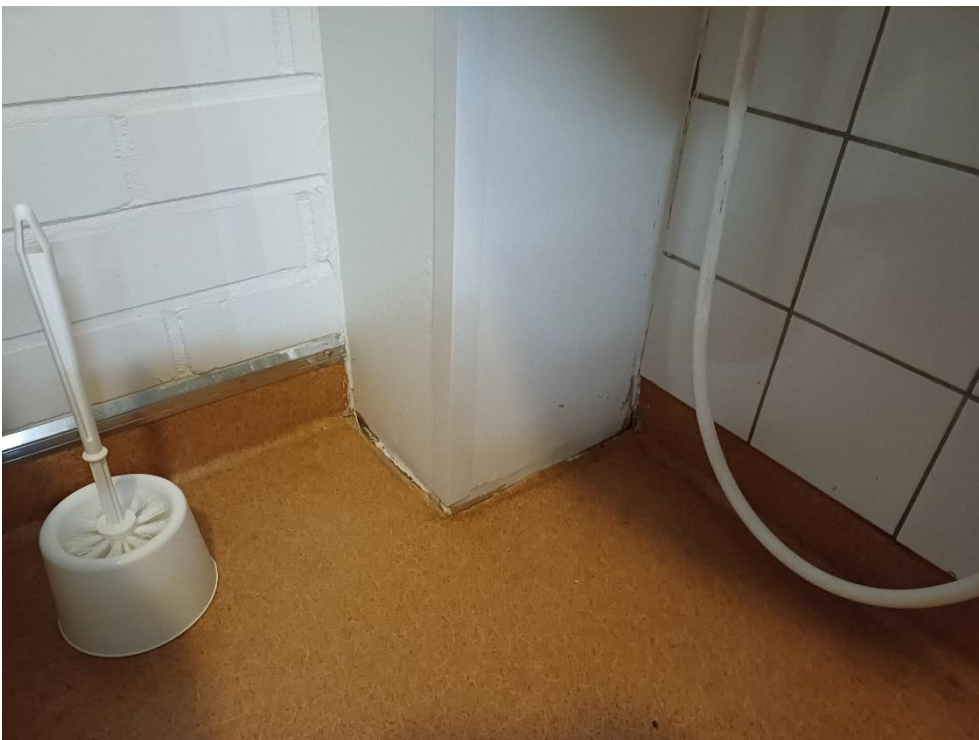
Kuva 4.8. 210 WC-tila, lattiamaton ylösnosto puuttuu pilarin ympäriltä.
