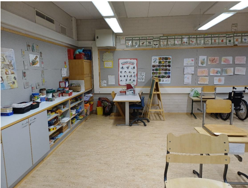
Kuva 4.14. Luokkatiloissa on runsaasti ilmoitustauluja, joista aistinvaraisesti irtoaa hajuja, mikä saattaa heikentää sisäilman laatua.
