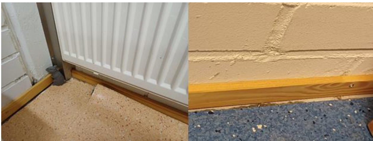
Kuva 4.12. 1. Kerroksen alueelle on asennettu lattiamatto, jonka alapuoli on koneellisesti tuulettuva. Lattiamatto on kutistumisen johdosta irtoillut reunakittauksista, eikä lattiamaton alapuolen tuuletus enää toimi suunnitellulla tavalla.
