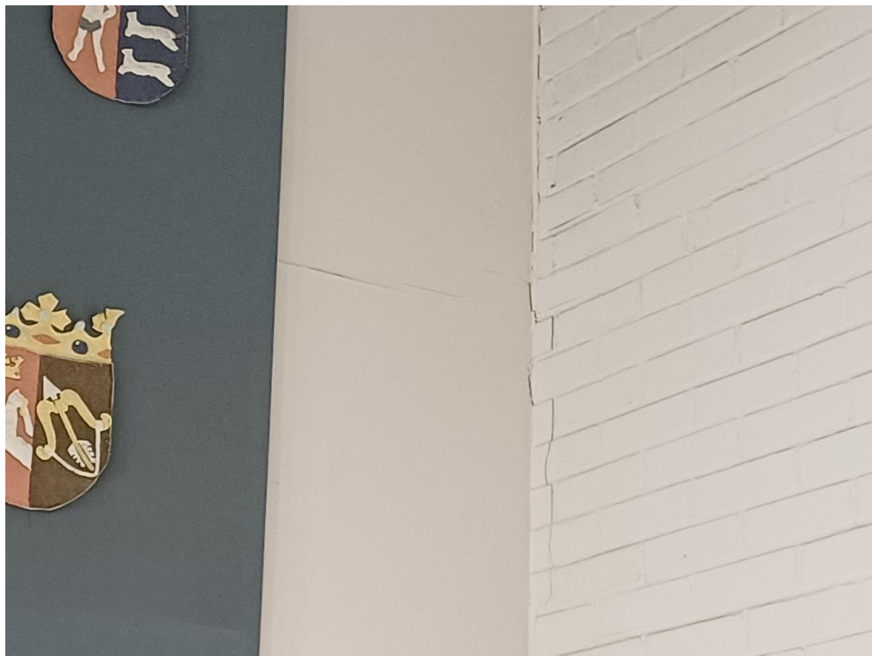
Kuva 4.9. 222A Porrastila, seinähalkeamia.
