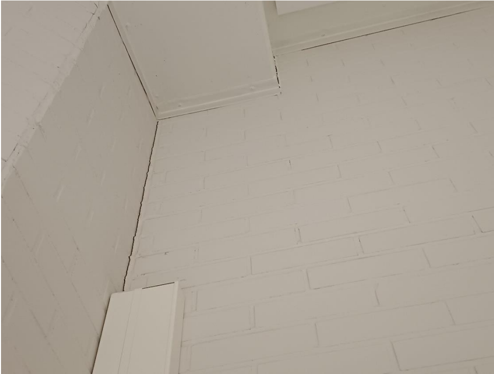
Kuva 4.5. 138 WC-tila & 221 Luokka, rakenneliittymien ratkeamia.
