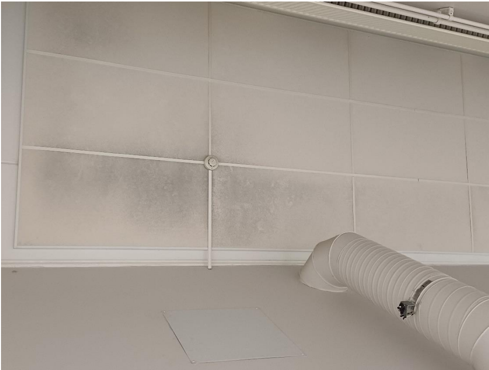
Kuva 4.13. 2. Kerroksen käytävä, kattoon asennetuissa akustointilevyissä on tummentumia.
