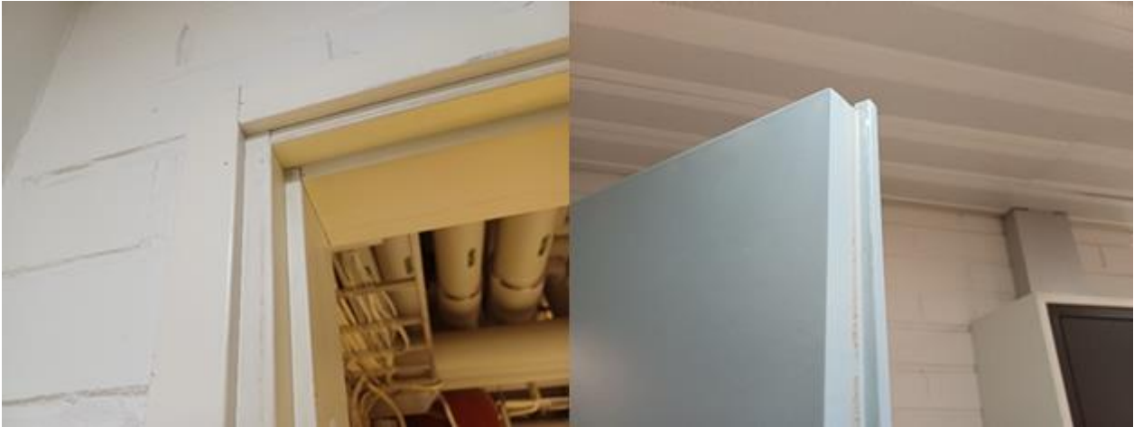
Kuva 4.3. 128 Lämmönjakohuone, käytävän ovesta puuttuvat tiivisteet, mistä syystä oviraoista voi käytävälle kulkeutua sisäilmaa heikentäviä hajuja.
