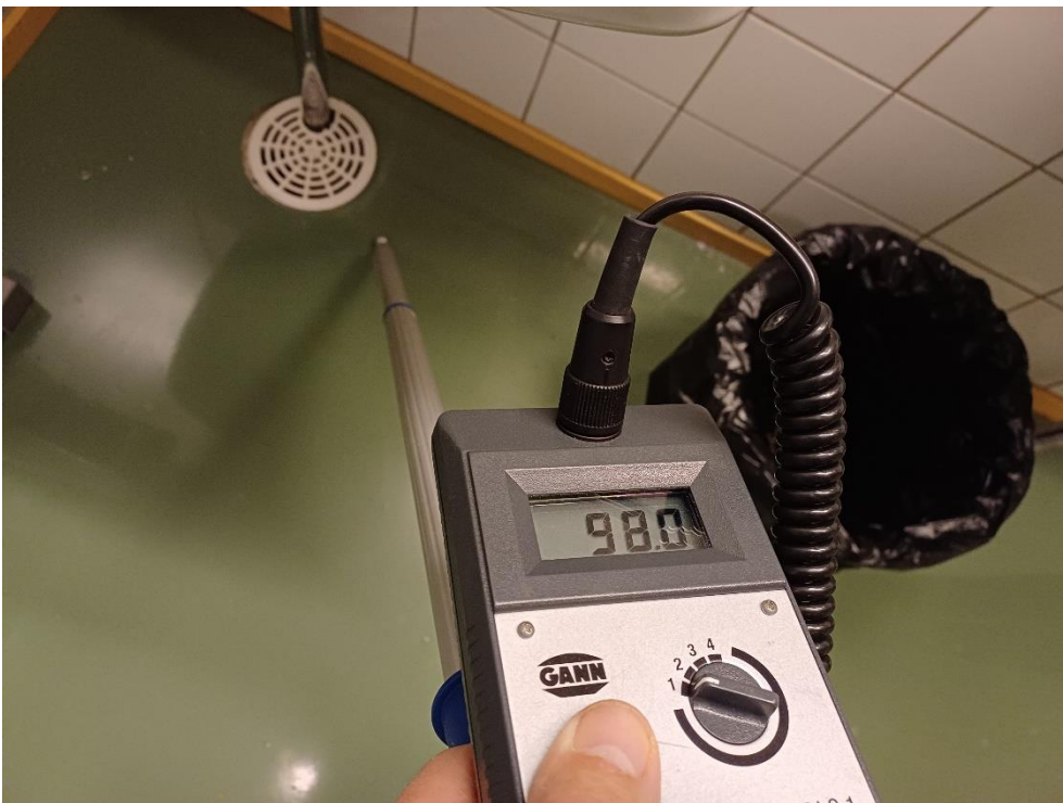
Kuva 4.6. 157 Teknisentilan eteinen, lattiakaivon ympäristöstä mitattiin pintakosteudenosoittimella kohonneita vertailuarvoja.
