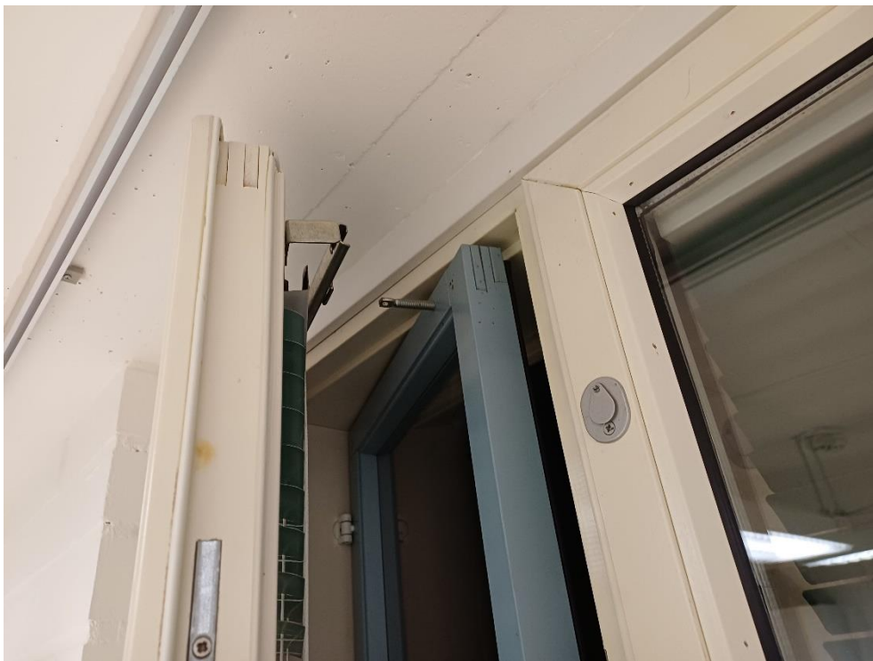
Kuva 4.15. Tuuletusikkunoiden aukipitolaitteita on rikkoutunut tai irti kiinnikkeistään.
