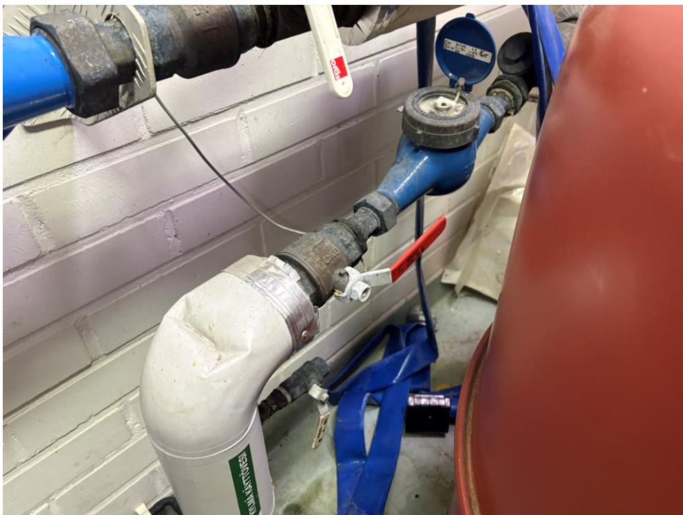
Kuva 5.5. Vesimittarin sulun yksi liitos vuotaa ja tihkuttaa hieman.
