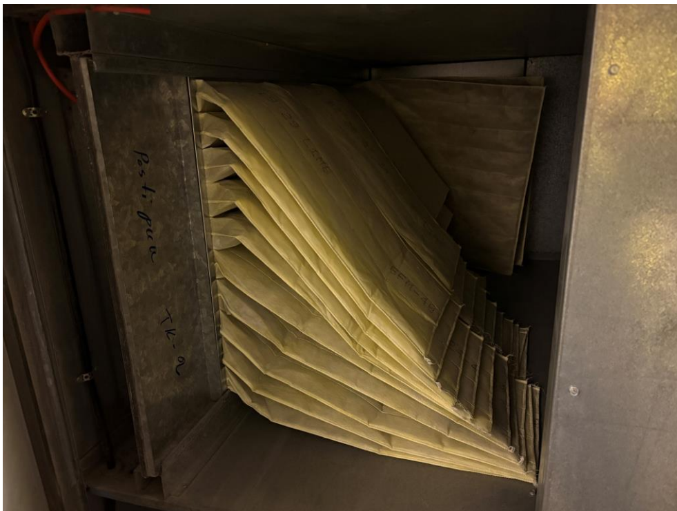
Kuva 5.4. Liikuntasalin ilmanvaihtokoneessa TK2 on väärällä luokituksella olevat tuloilman suodattimet, lisäksi tuloilman suodatin on asennettu vaakaan, kun sen tulisi olla pysty asennossa.
