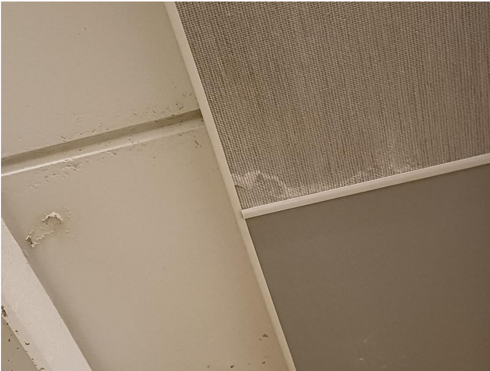
Kuva 4.2. 262 Katossa, sekä kattoon asennetussa akustointilevyssä on vanhoja kosteuden aiheuttamia jälkiä.
