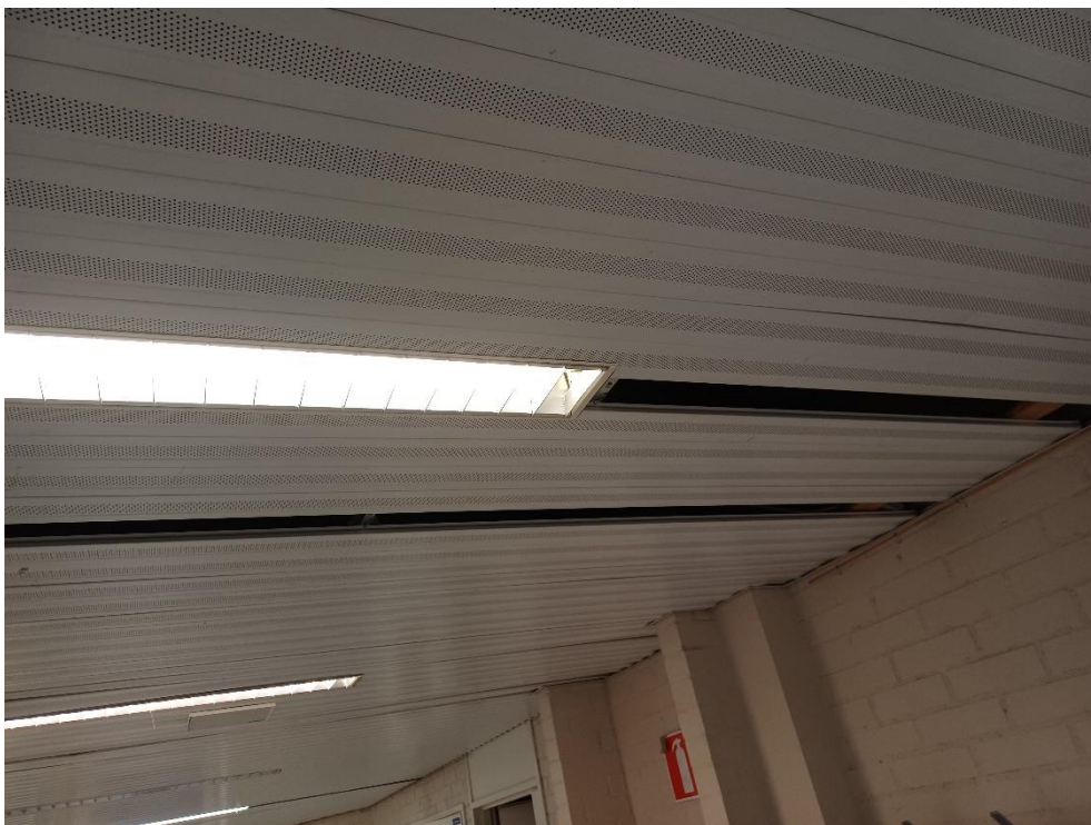
Kuva 4.7. 1. ja 2. kerroksen käytävien alakatoista puuttuu kattosäleitä.
