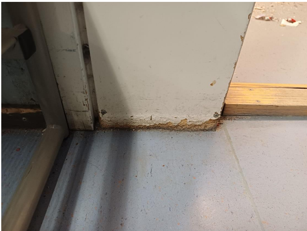
Kuva 4.6. Luokkatilojen käytävöissä on sähköpielien alaosat vaurioituneet liiallisen veden käytöstä lattiapesun yhteydessä.
