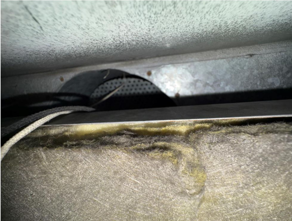
Kuva 5.2. Tuloilmanvaihdon paineentasauslaatikoissa oleva äänenvaimennuslevyssä on paikoin vaurioitunut. Äänenvaimentimista saattaa tuloilman mukaan päästä villakuituja.
