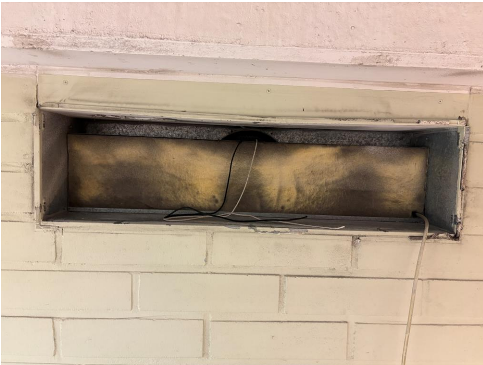
Kuva 5.1. Tuloilmanvaihdon paineentasauslaatikoissa oleva äänenvaimennuslevyssä on paikoin vaurioitunut. Äänenvaimentimista saattaa tuloilman mukaan päästä villakuituja.
