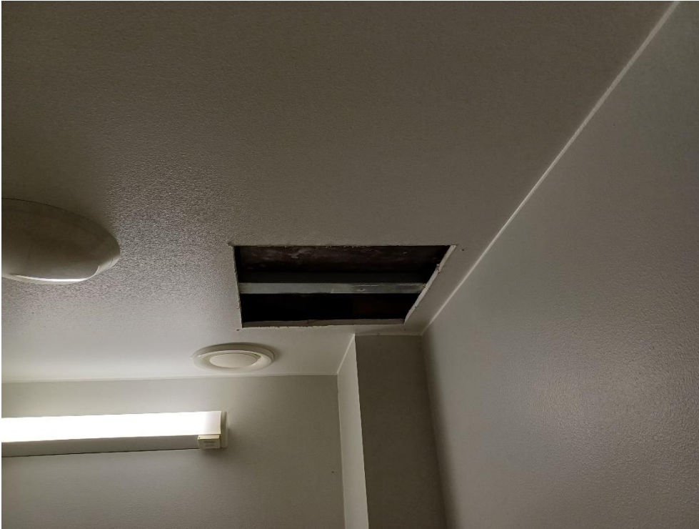
Kuva 4.8. 205 WC-tila, alakattoon tehdyn tarkastusluukun kansiosa puuttuu.
