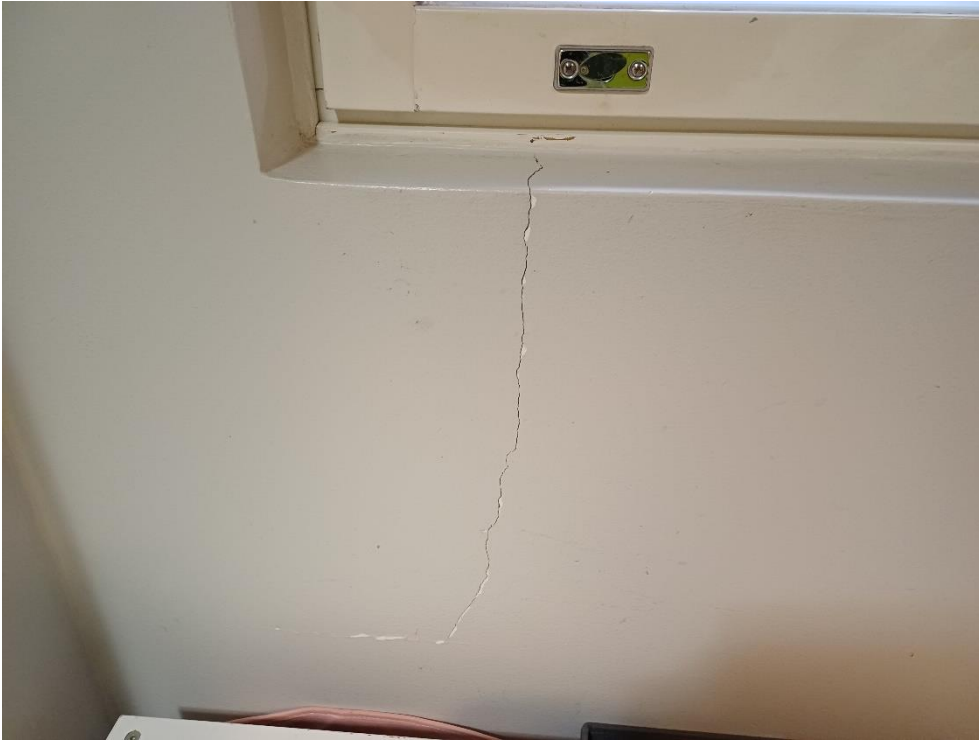
Kuva 4.14. Rakenneliittymien ratkeamia sekä seinähalkeamia on useissa tiloissa.
