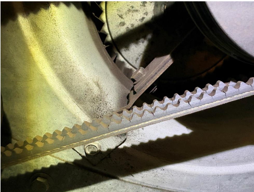
Kuva 5.1. Ilmanvaihtokoneen TK1 puhaltimen hihnat ovat kuluneet ja vaihtokunnossa.
