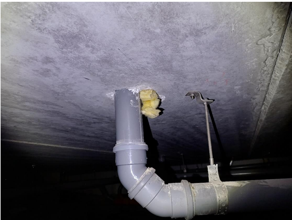
Kuva 4.3. Alapohjatila, ylöspäin johtavien läpivientien tiivistys on puutteellinen.
