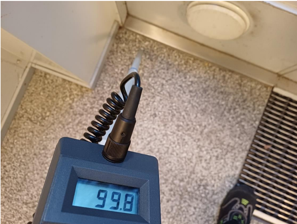
Kuva 4.4. 122 Porrashuone, lattiasta mitattiin pintakosteudenosoittimella kohonneita vertailuarvoja.
