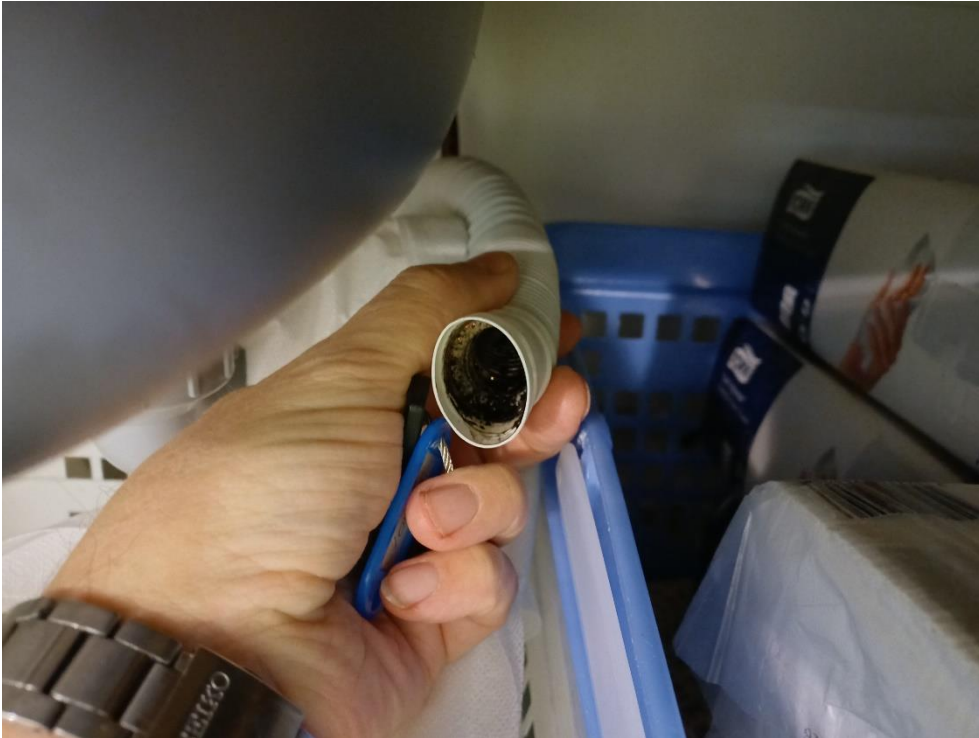
Kuva 4.16. Ryhmätilojen vesipisteiden ylivuotoputkiin on kertynyt sakkaa, joka saattaa aiheuttaa tunkkaista hajua.
