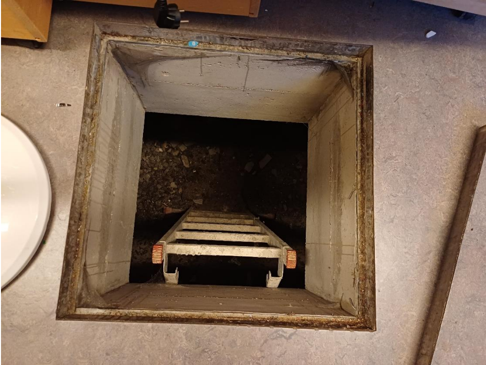
Kuva 4.2. 109 Varasto, alapohjan kulkuluukusta puuttuu tiivistys.
