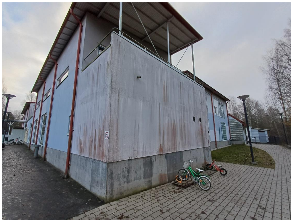
Kuva 4.18. Julkisivuissa on viherleväkasvustoa.
