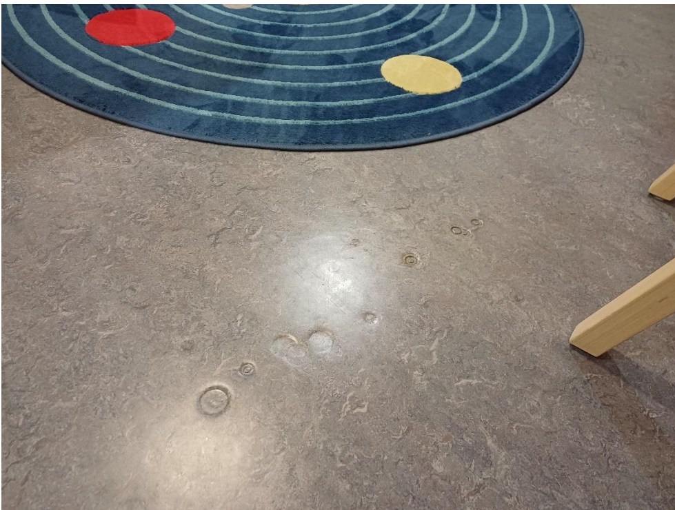
Kuva 4.13. Lattiapinnoitteissa on kalusteiden aiheuttamia painaumia.
