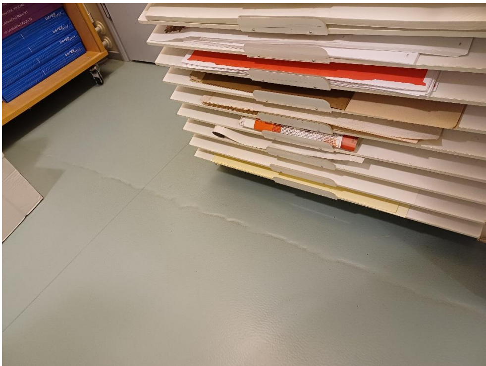
Kuva 4.10. 219 Taukotila, betonihalkeama lattiapinnoitteen alla.
