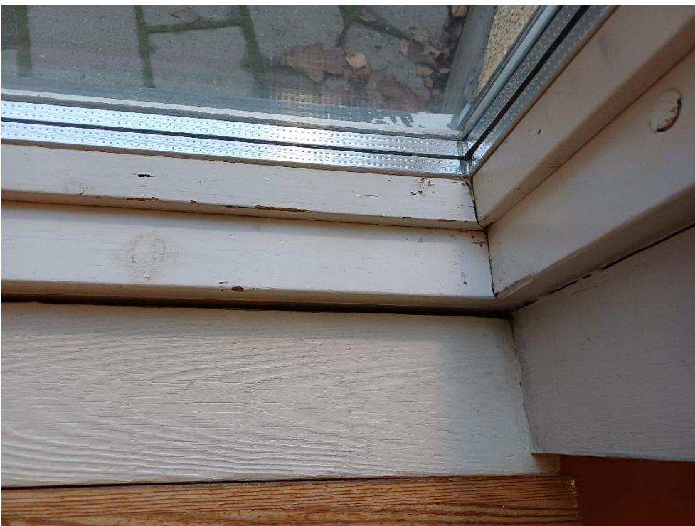
Kuva 4.1. 102–104 Käytävätilat, ikkunakarmi-pielirakenteiden liittymät eivät ole tiiviitä.
