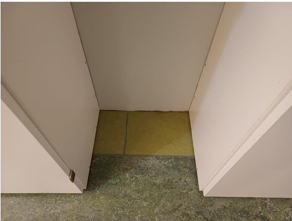
Kuva 4.15. Sänkykaappien asennuksen yhteydessä on jalkalistoja jäänyt kiinnittämättä.
