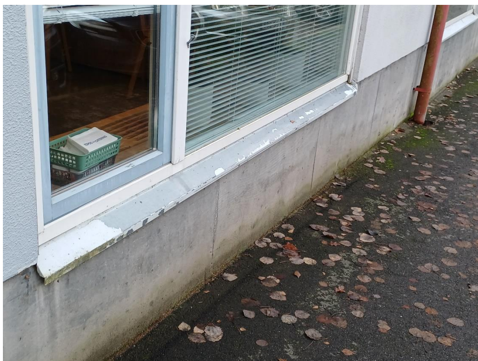
Kuva 4.19. Ikkunoiden vesipeltien maalipinta irtoilee paikoittain.
