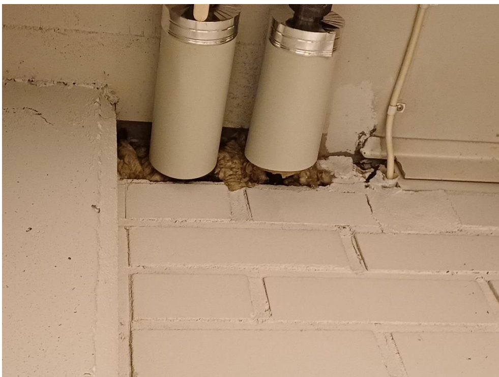
Kuva 4.7. 140 Lämmönjakohuone, viereisiin tiloihin johtavien läpivientien tiivistys on puutteellinen.
