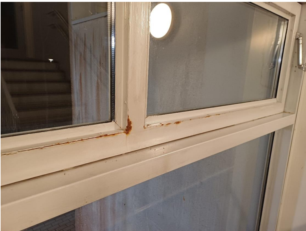
Kuva 4.9. 218 Porrashuone, teräsrakenteisissa ikkunakarmeissa on alkavaa ruostumista.
