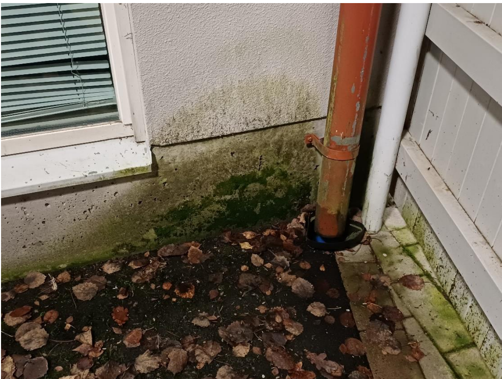
Kuva 4.21. Sadevesisyöksyjen roiskevesi kastelee paikoittain sokkelirakenteita.
