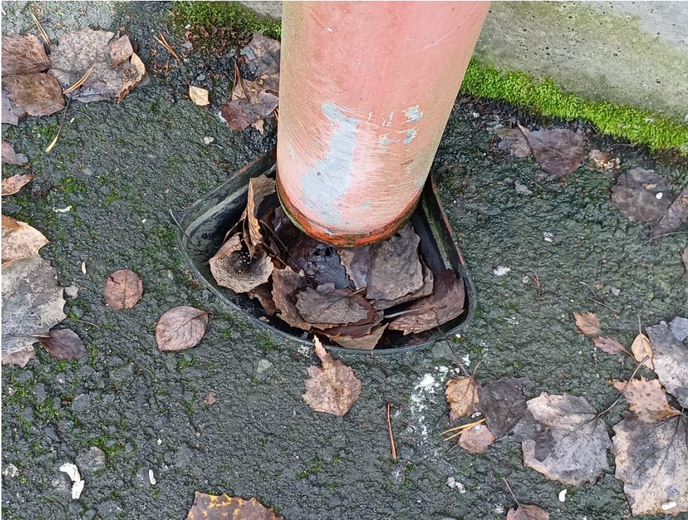
Kuva 4.20. Sadevesisyöksyjen keräääsuppiloihin on kertynyt puiden lehtiä.
