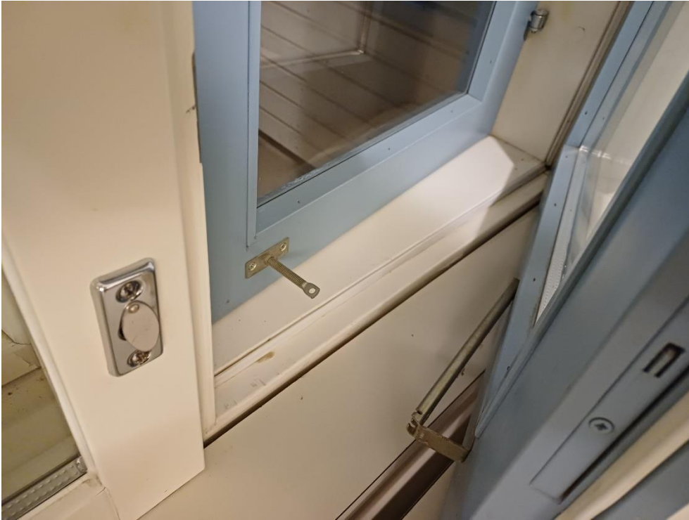
Kuva 4.12. Tuuletusikkunoiden aukipitolaitteita on rikkoutunut tai irti kiinnikkeistä.
