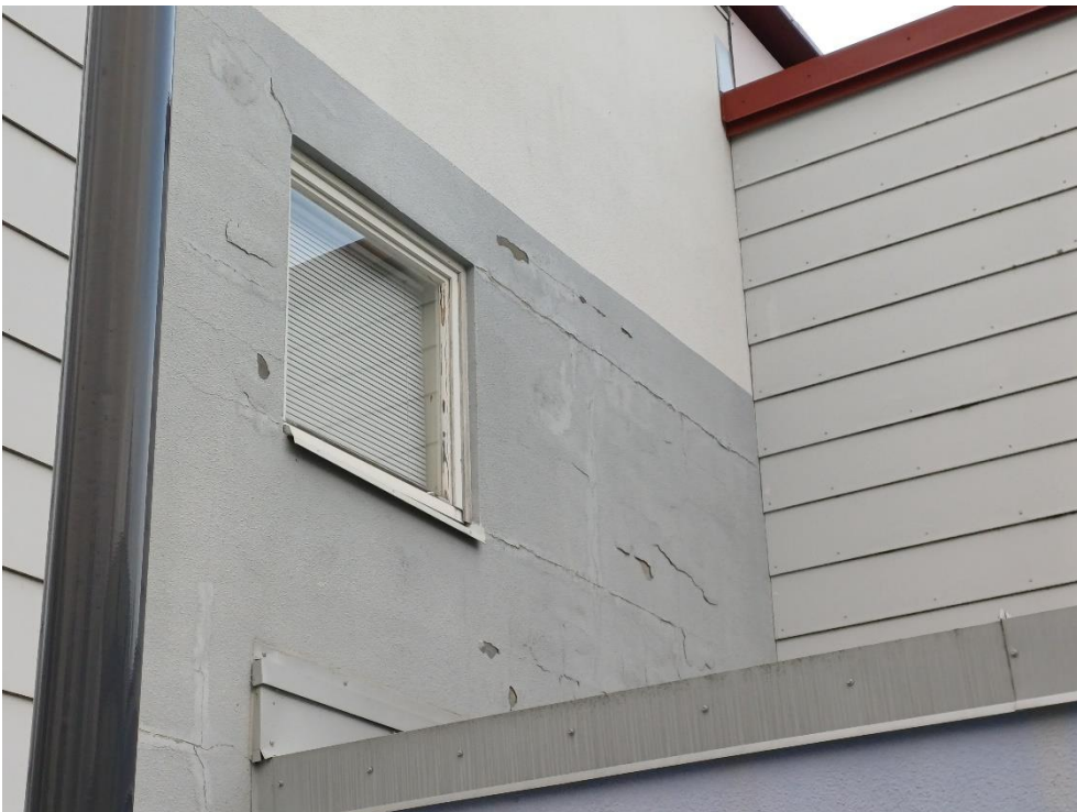
Kuva 4.17. Julkisivurakenteissa on halkeamia sekä pinnoitteen rapautumista.
