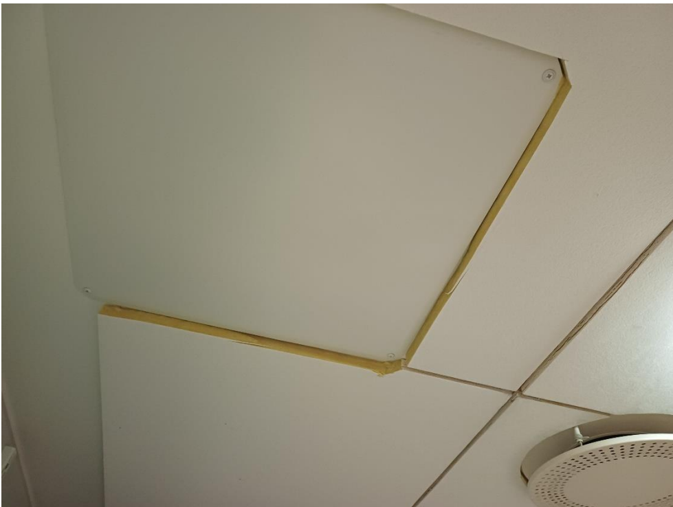
Kuva 4.5. 132 Eteinen, alakaton akustointilevyissä on pinnoittamattomia leikkauspintoja.
