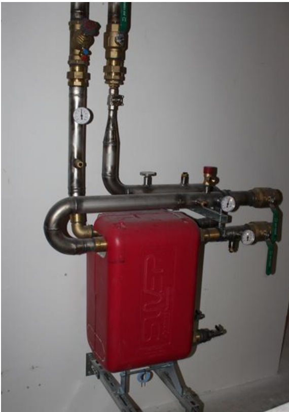
Kuva 12A.1. Jäähdytysjärjestelmän lämmönvaihdin.
