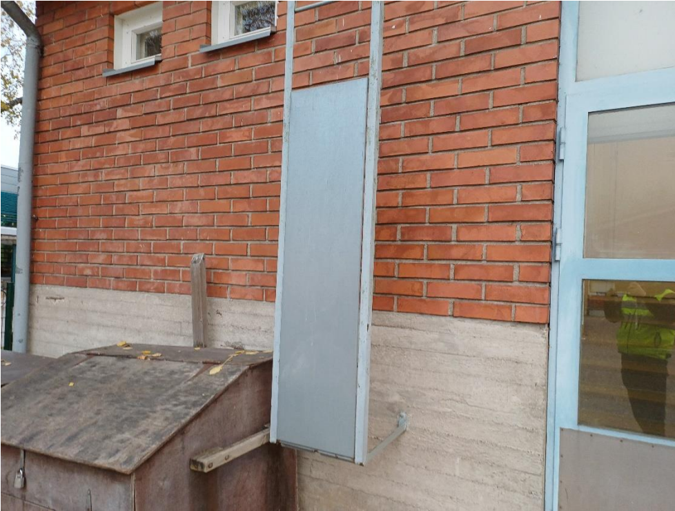
Kuva 4.13. Katolle johtavien tikkaiden nousuestettä ei ole lukittu paikoilleen.
