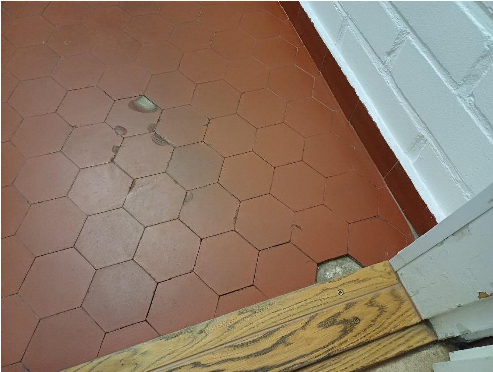
Kuva 4.3. 107 WC-tila, lattialaatoituksessa on vaurioita ja osa lattialaatoista on irti pohjasta "kopoja".
