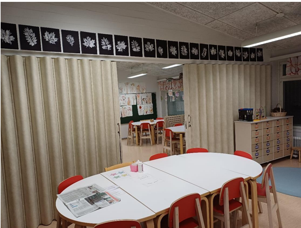
Kuva 4.8. Tilojen 124–125 väliin on asennettu vinyylipintainen paljeovi, minkä tyyppisestä materiaalista on muissa kohteissa aistinvaraisesti haihtunut hajua, joka on heikentänyt sisäilman laatua.
