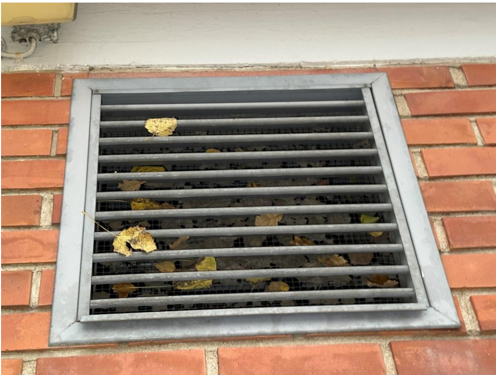
Kuva 5.4. Keittiön ilmanvaihtokoneen raitisilmasäleikössä lehtiä.
