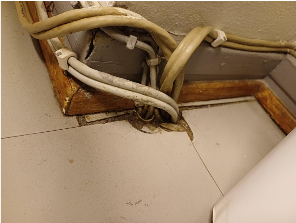
Kuva 4.4. 113 Toimisto, alaspäin johtavien sähköputkien päitä ei ole tiivistetty.
