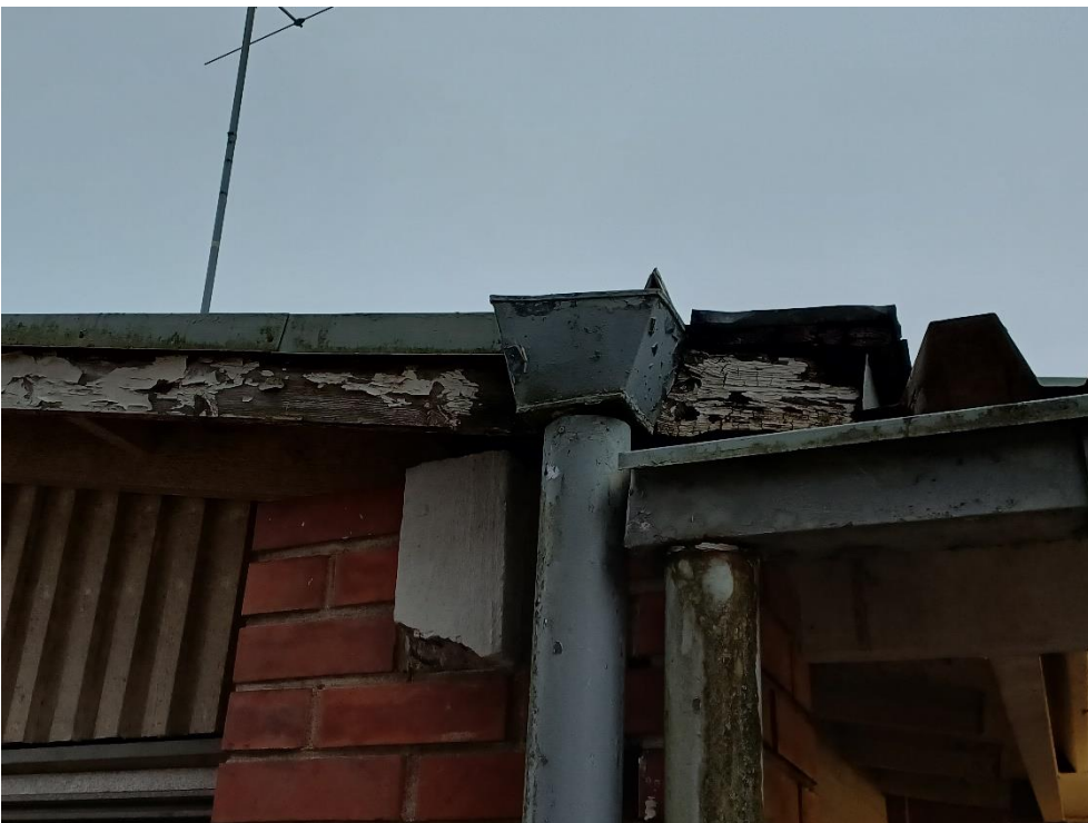
Kuva 4.10. Räystäslaudoituksissa on maalivaurioita sekä lahoja osia.
