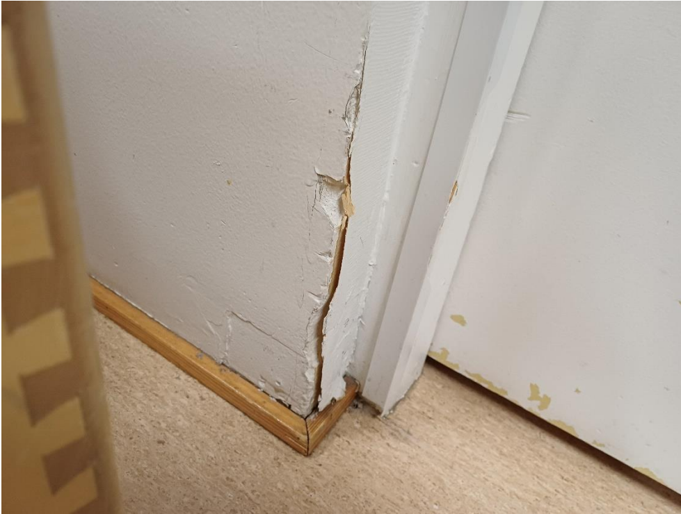
Kuva 4.7. 124 Leikkitila, seinäpinnoitteen vaurio.
