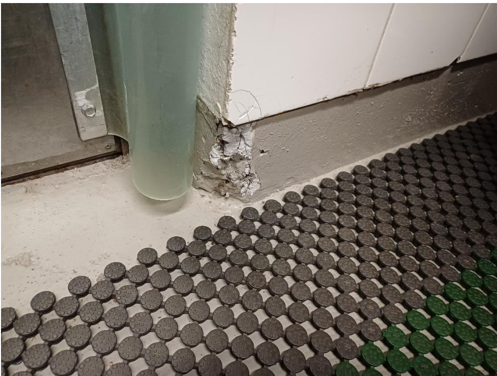
Kuva 4.2. 101 Kuraeteinen, lattiapinnoitteen vaurioita.
