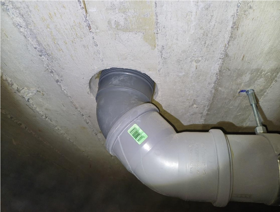
Kuva 4.9. Ryömintätila, ylöspäin johtavat läpiviennit eivät ole tiiviitä.
