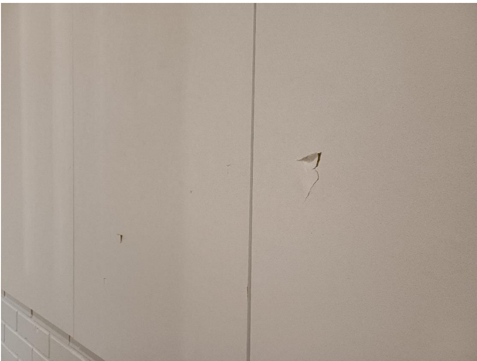
Kuva 4.6. 122 Leikkitila, parvelle johtavien portaiden kohdalla, on seinään kiinnitettyjen akustointilevyjen pintoja rikkoutunut.
