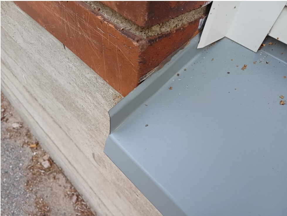
Kuva 4.12. Ikkunapellityksien päätytaitteet on jätetty teräviksi.
