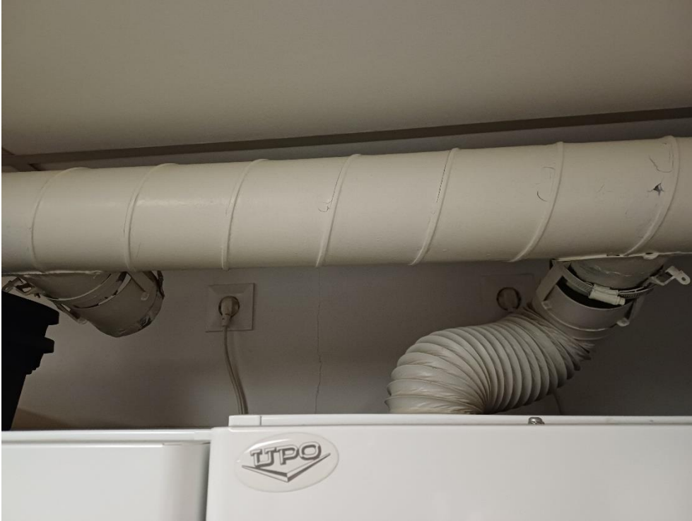
Kuva 4.1. 101 Kuraeteinen, kuivauskaapin poistoilmaletku on irti kiinnikkeestä.
