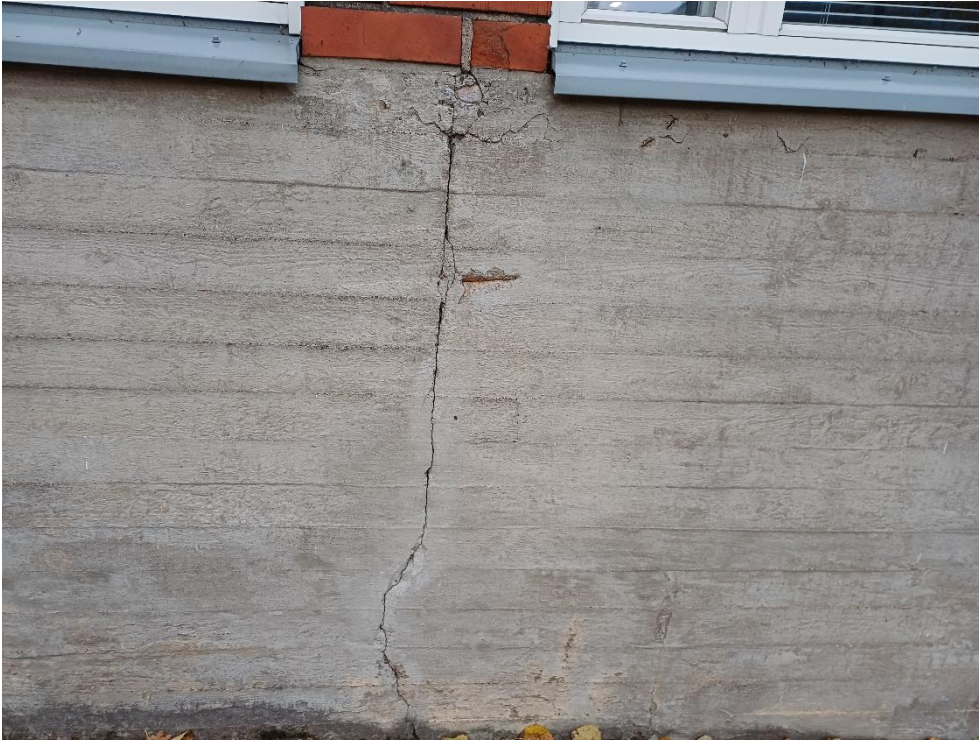
Kuva 4.11. Betonisokkelissa on halkeamia sekä liian lähelle valupintaa asennettuja betonirautoja on tullut esiin.
