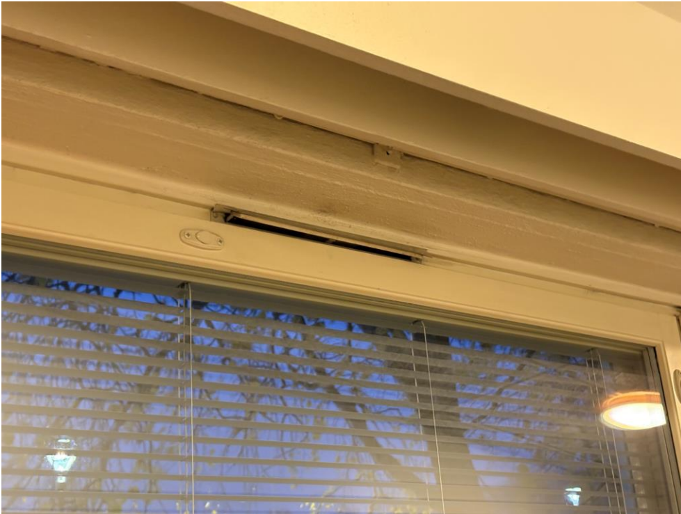
Kuva 5.1. Poistoilmanvaihdon tarvitsema korvausilman saanti puutteellinen useassa tilassa.
