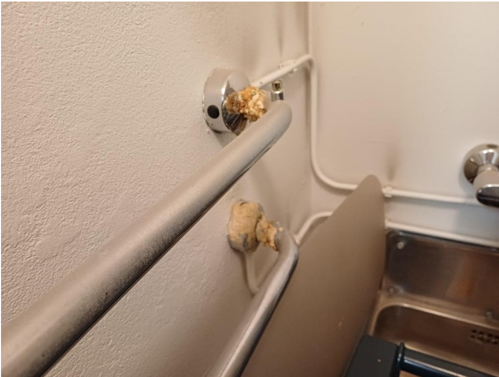
Kuva 4.5. 119 Siivouskomero, rättipatteri vuotaa seinäkiinnityksen kohdista.
